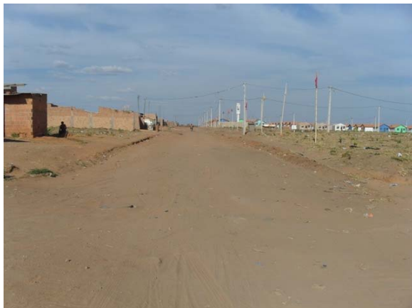
Foto 1: Área Crítica 1 – área de enxurrada entre a Rua Itabuna e a Rua Seabra.
