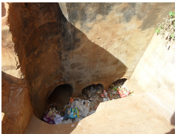
Foto 4: Entrada tripla de tubulações de concreto da Rua Joaquim de Carvalho com bastante lixo.
