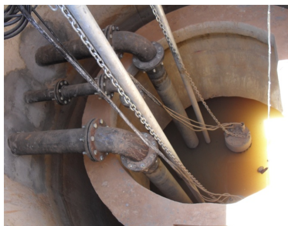
Foto 4: Conjuntos de motobombas instalados e preparados para realização de testes
