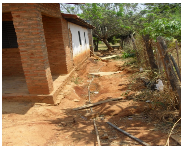
Foto 4: Local próximo a área que sofre processo de erosão na Rua 31 de Março que alivia o escoamento de parte destas águas para o Riacho de Tabocas.
