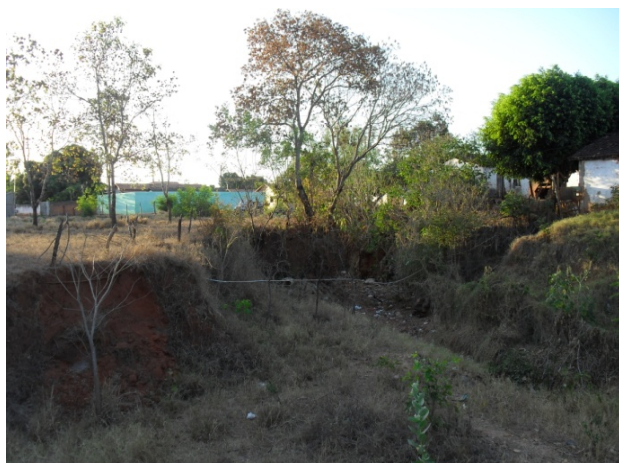
Foto 5: Área Crítica 1 - vista de outro ângulo do processo erosivo existente no terreno natural ao final da Rua São Sebastião.
