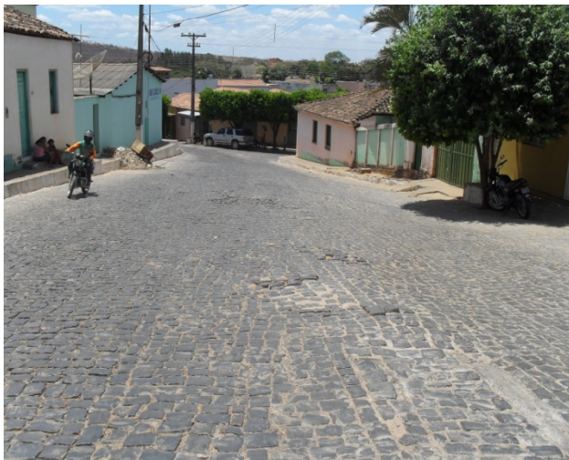
Foto 7: Área Crítica 4 - trecho final da Rua José Ferreira marcado por processo erosivo do pavimento.
