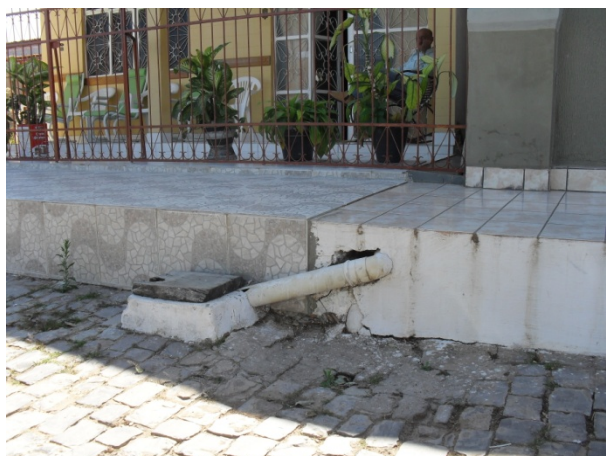
Foto 3: Ligação domiciliar na caixa de passagem da rede de esgoto antiga.
