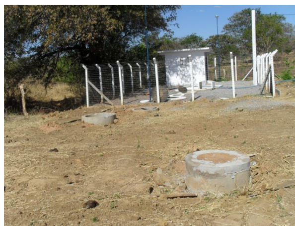
Foto 6: Poço de visita de chegada na EEE intermediária do novo SES implantado via CODEVASF.
