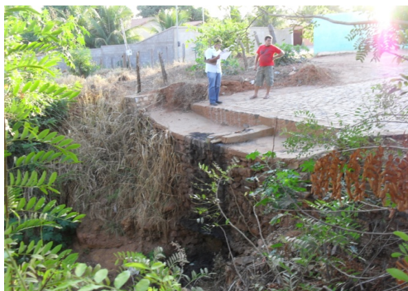
Foto 4: Vista de outro ângulo do lançamento de esgoto no local erodido ao final da Rua São Sebastião.
