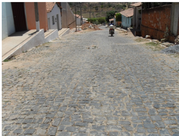
Foto 11: Área Crítica 3 - Rua Luiz Viana. Área crítica por conta de erosão.
