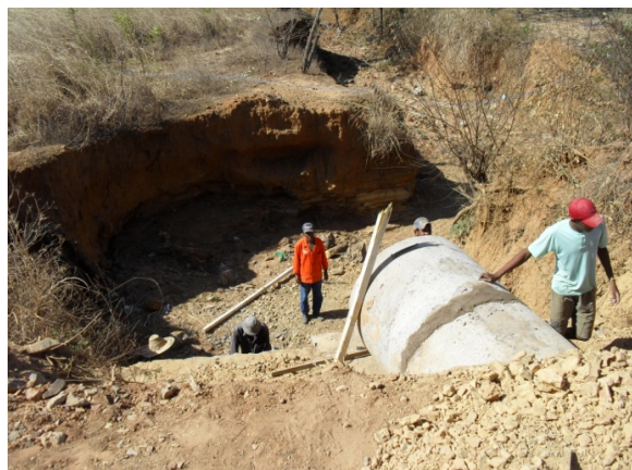
Foto 6: Erosão provocada por conta da chuva. Homens executando um serviço para melhorar a drenagem e não prejudicar a pista.
