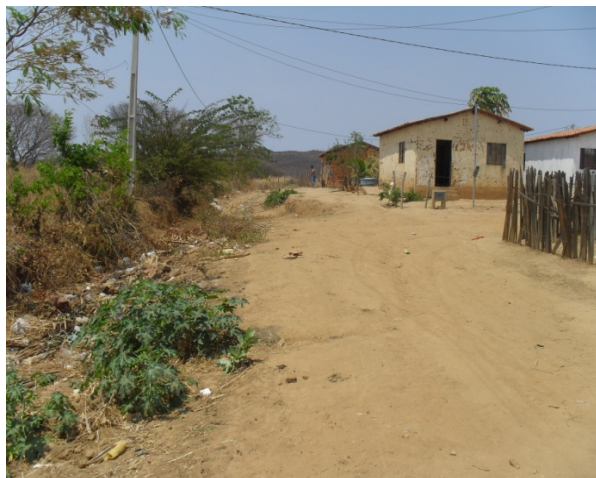
Foto 1: Área Crítica 3 - Rua 31 de Março (próximo das casas populares). Área crítica por conta de erosão.
