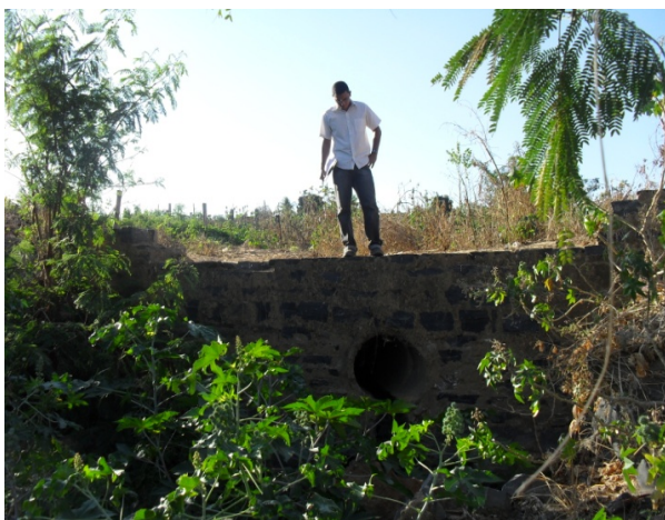
Foto 11: Ponto de lançamento da galeria circular de drenagem que transporta esgoto sanitário e águas pluviais. Tubulação de concreto de 800 mm de diâmetro. Início na Rua Capitão M. Nascimento.
