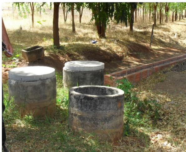
Foto 1: Poços de visita e caixa de areia na entrada da ETE.
