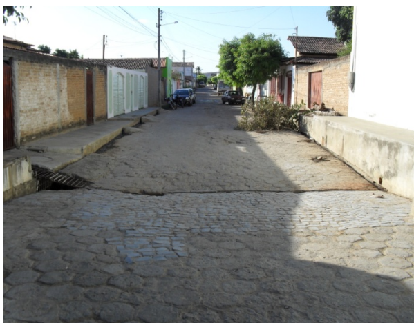
Foto 3: Área Crítica 2 - Rua Francisco Coimbra. Área crítica por conta da ocorrência de alagamento.
