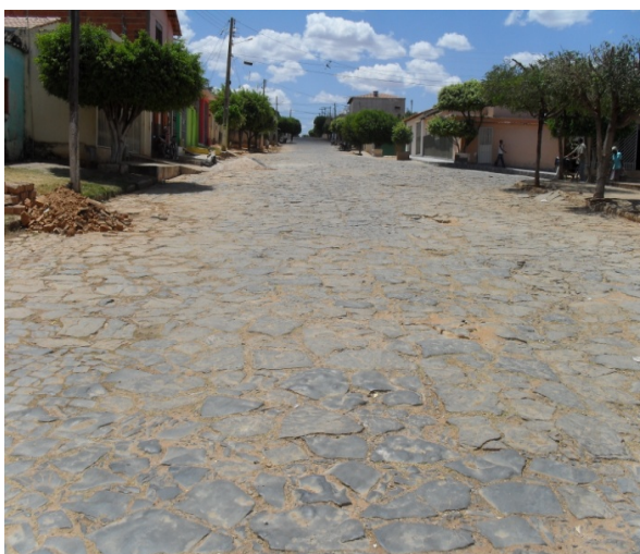
Foto 7: Área Crítica 4 - Rua 7 de Setembro. Área crítica por conta de erosão do pavimento.
