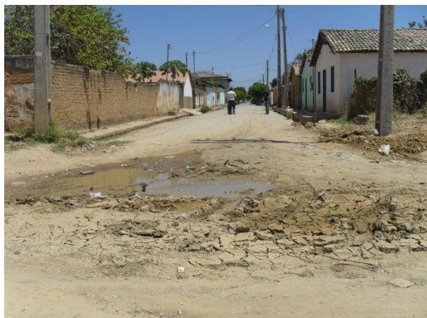
Foto 5: Área Crítica 2 - Rua Sebastião Barros. Área crítica por conta da ocorrência de alagamento.
