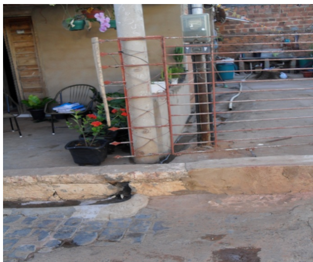
Foto 7: Área Crítica 3 - Travessa da Rua 7 de Setembro. Lançamento de esgoto secundário na rua favorece o processo erosivo na pavimentação da área crítica.
