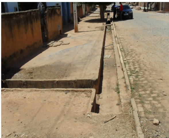
Foto 5: Área Crítica 3 - Rua Doutor Fragoso. Área crítica por conta de alagamento mesmo possuindo dispositivos de drenagem.
