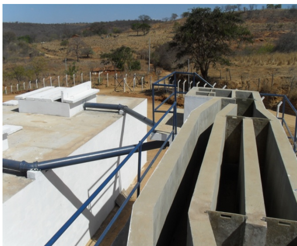
Foto 7: Vista da Caixa de areia dupla com by pass seguida de 2 DAFA's
