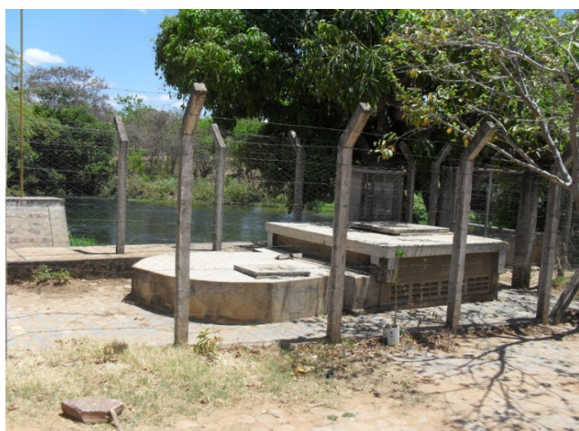
Foto 3: Estação elevatória de esgoto localizada na margem do Rio Correntina.
