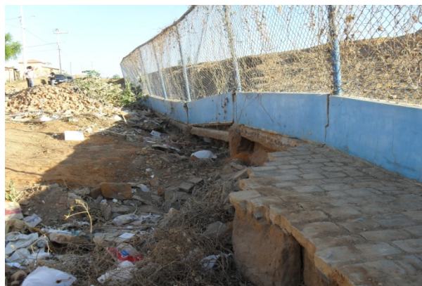
Foto 16: Muro da Escola Municipal Agnelo da Silva Braga com a estrutura comprometida devido ação erosiva das águas pluviais.
