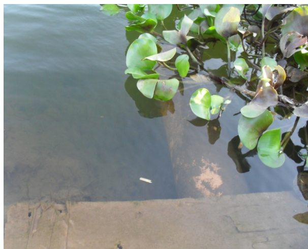
Foto 8: Emissário da ETE submerso pelas águas do Rio Corrente.
