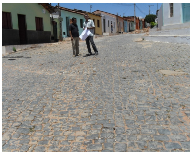
Foto 13: Área Crítica 4 - Rua Presidente Costa e Silva. Área crítica por conta de erosão.
