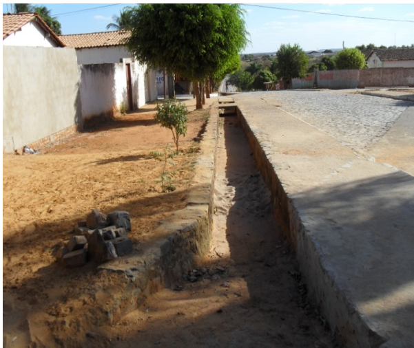
Foto 19: Avenida Plácido Cardoso. Canaleta de drenagem que canaliza as águas pluviais e as direciona para a galeria retangular enterrada e posteriormente se conecta no canal de macrodrenagem.
