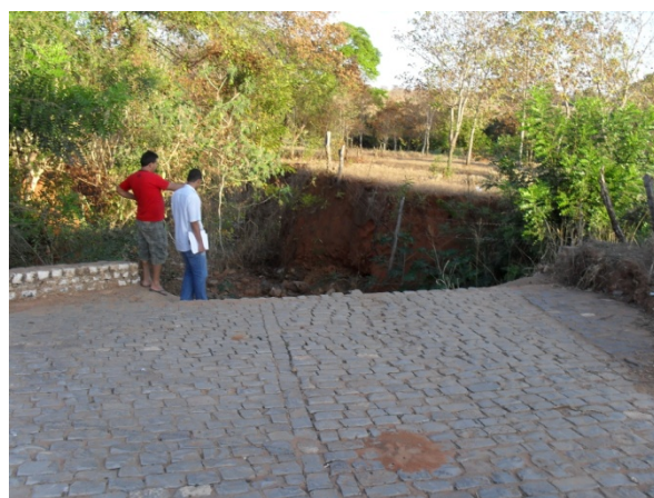
Foto 4: Área Crítica 1 - final da Rua São Sebastião. Término da erosão da pavimentação e início de processo erosivo no terreno natural.
