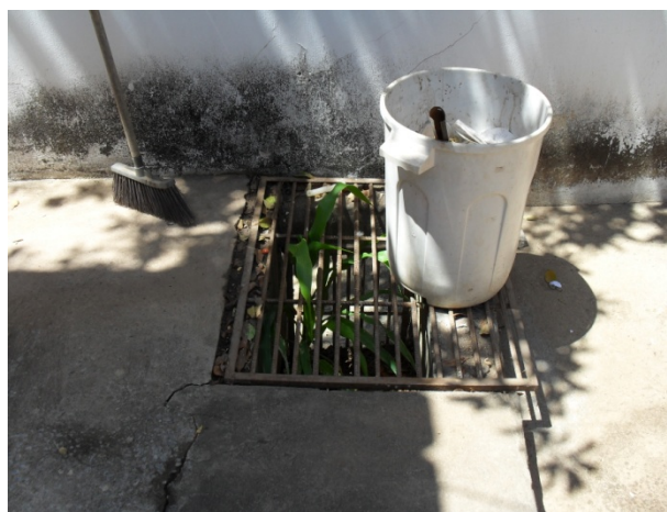
Foto 4: Dispositivos de drenagem implantados dentro de residências para facilitar o escoamento das águas pluviais por dentro dos lotes.
