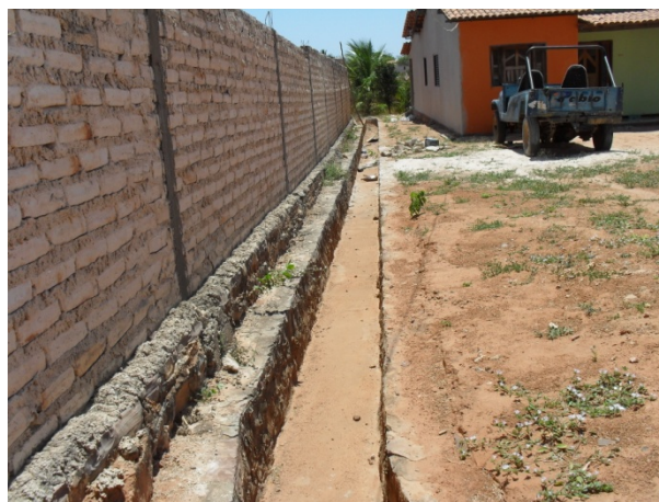
Foto 12: Canaleta construída por um morador para facilitar o escoamento das águas pluviais provenientes da Rua Rui Barbosa.
