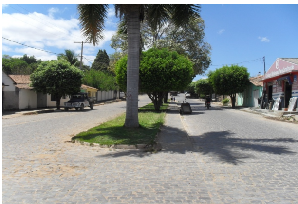
Foto 5: Área Crítica 3 - Avenida Professor Lauro Araújo. Área crítica por conta de erosão do pavimento.
