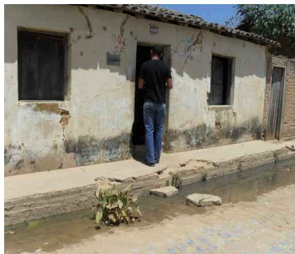
Foto 2: Rua Sebastião Barros. Esgoto a céu aberto.
