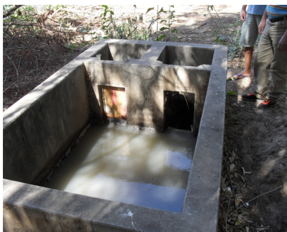
Foto 4: Dispositivo de entrada do esgoto na estação de tratamento de esgoto.
