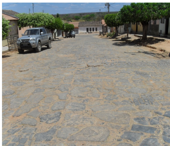
Foto 8: Área Crítica 4 - Trecho final da Rua 7 de Setembro. Área onde o processo erosivo na pavimentação é mais intenso.
