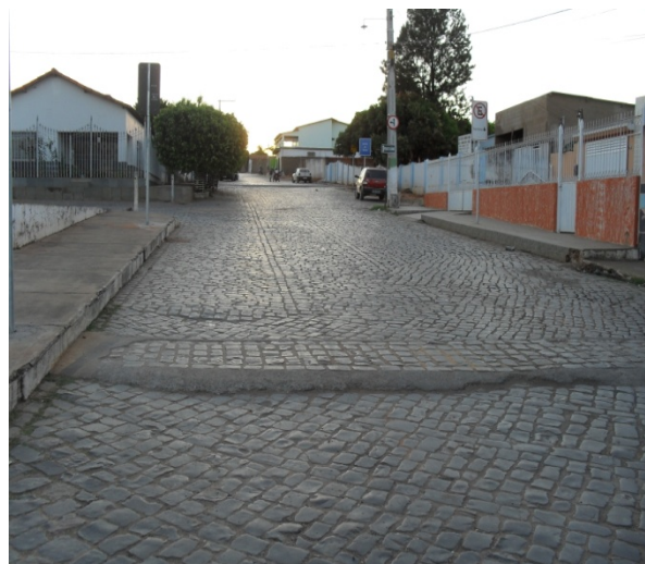
Foto 8: Área Crítica 4 - Rua Atílio Lopes. Área crítica por conta de erosão na pavimentação.
