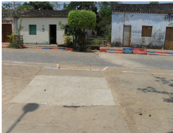
Foto 9: Praça Castro Alves área crítica por conta de alagamento. Dispositivo de drenagem que conduz as águas pluviais de outras ruas de um lado para o outro da praça.
