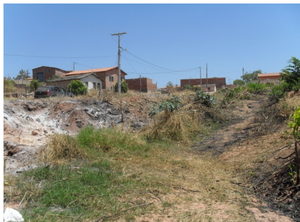
Foto 10: Visão por outro ângulo da erosão localizada no início da Rua Monsenhor Montalvão.
