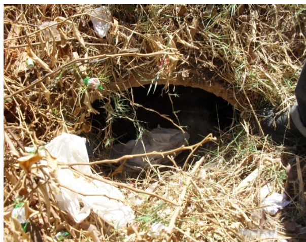
Foto 16: Ponto de lançamento da rede de microdrenagem da Rua do Posto Novo. Galeria circular de concreto de 600 mm de diâmetro quase totalmente obstruída.
