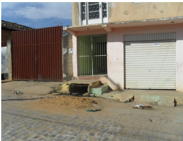
Foto 5: Área Crítica 2 - bueiro que favorece a passagem das águas pluviais da Rua Francisco Coimbra para a Rua José Leopoldo Lima
