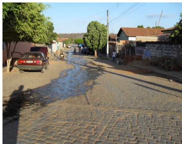
Foto 6: Área Crítica 3 - Rua 7 de Setembro. Área crítica de erosão na pavimentação.
