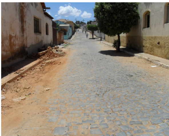
Foto 3: Área Crítica 2 - Rua Visconde de Rio Branco. Área crítica por conta de erosão no pavimento.
