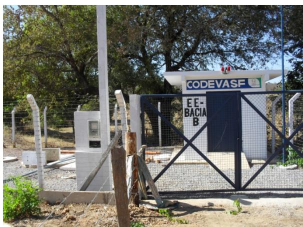
Foto 5: Estação Elevatória de esgoto intermediária do novo SES implantado via CODEVASF.
