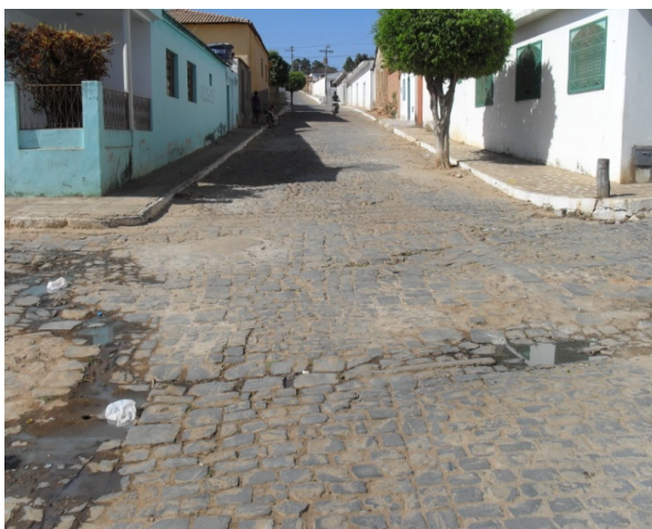
Foto 15: Área Crítica 7 - Rua Vicente de Paula. Área crítica por conta da ocorrência de erosão no pavimento.
