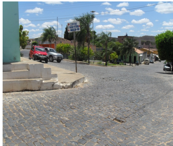
Foto 8: Área Crítica 4 - Praça Felipe Santos (final da Rua José Ferreira). Área crítica por conta de erosão do pavimento.
