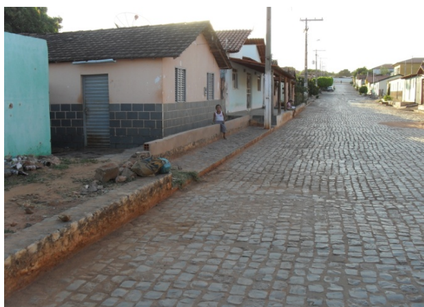
Foto 3: Área Crítica 1 - Rua São Sebastião. Área crítica por conta de chuva de enxurrada e erosão.
