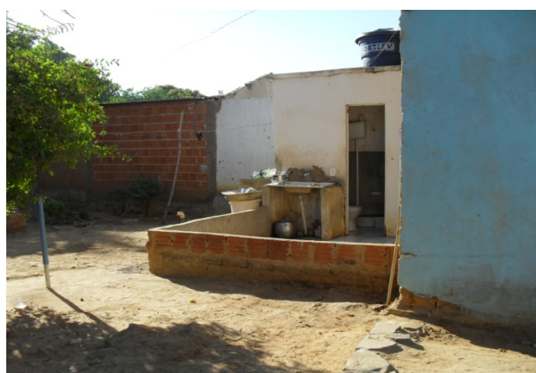
Foto 10: Área Crítica 4 - proteção feita pelos moradores para evitar que as águas pluviais acumuladas invadam suas residências. Rua Paulo Rabelo Nunes.
