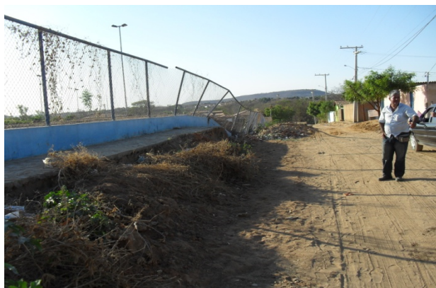
Foto 15: Rua Renata Borges, região próxima da Escola Municipal Agnelo da Silva Braga. Área crítica marcada por erosão.
