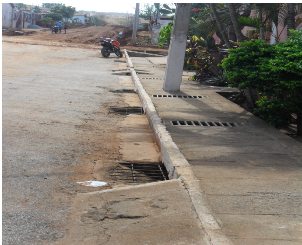
Foto 1: Rua Joaquim de Carvalho. Dispositivos de drenagem que lançam numa canaleta de concreto enterrada em área de baixada. Seção de 80 cm X 40 cm.
