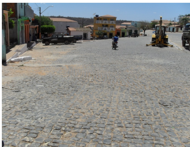
Foto 7: Área Crítica 1 - Praça João Durval Carneiro - área crítica por conta de erosão.
