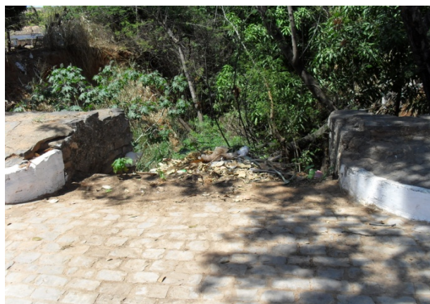
Foto 8: Final da Rua José Domingos Ferreira. Vista de outro ângulo da erosão.
