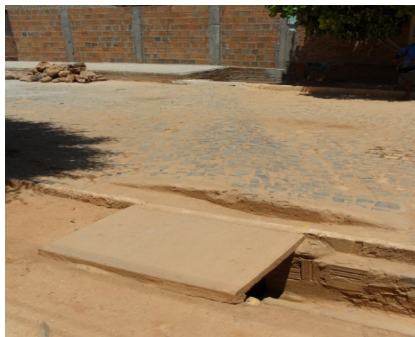
Foto 6: Área Crítica 3 - Rua Doutor Fragoso. Passagem das águas pluviais do sistema de drenagem por debaixo da pista que às vezes obstrui e causa transtornos aos moradores locais.
