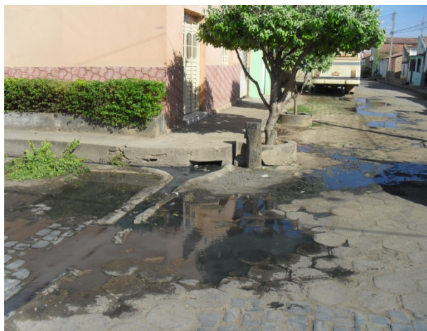
Foto 1: Rua Chico Xavier. Esgoto secundário a céu aberto. Situação recorrente em diversas ruas da cidade.
