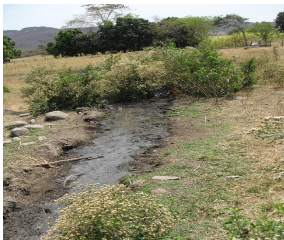
Foto 2: Esgoto sanitário correndo a céu aberto em propriedade particular. Trecho em que a rede coletora está danificada.
