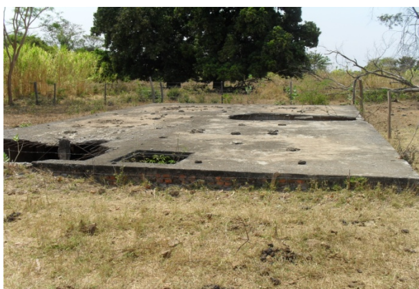
Foto 3: Recipiente (tipo fossa) onde os esgotos sanitários provenientes da rede coletora eram normalmente despejados em péssimas condições e atualmente inutilizado.
