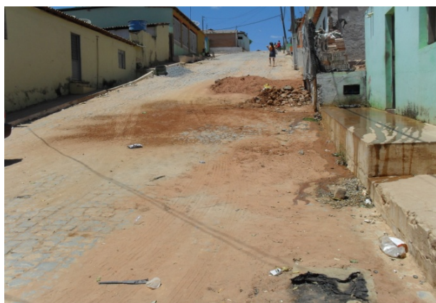
Foto 9: Área Crítica 2 - Rua Nozinho Araújo. Área crítica por conta de erosão.
