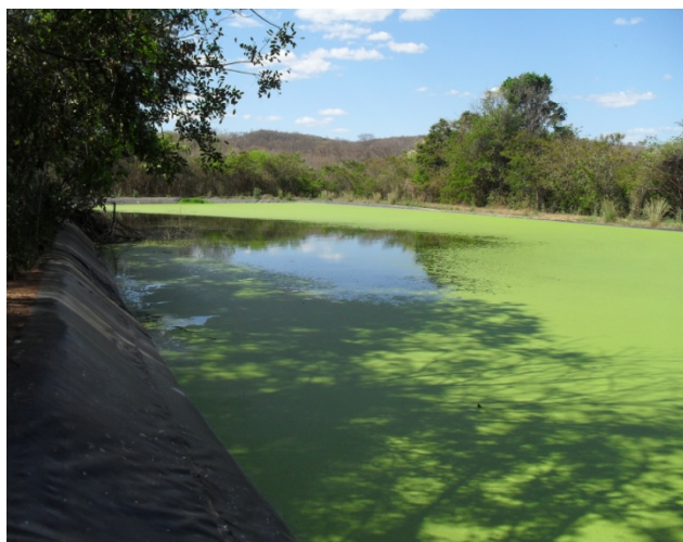
Foto 7: Lagoa facultativa com indício de eutrofização. Falta de manutenção evidente da unidade de tratamento.
