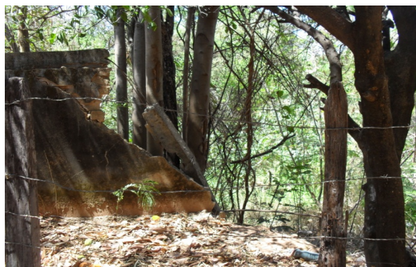
Foto 6: Muro quebrado no fundo de um terreno particular da Rua Getúlio Vargas por conta de desmoronamento (erosão).
