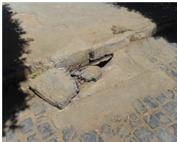
Foto 2: Área Crítica 1 - Rua Lucrécio Novais. Caixa coletora com grelha obstruída com concreto. Ação de uma moradora local.
