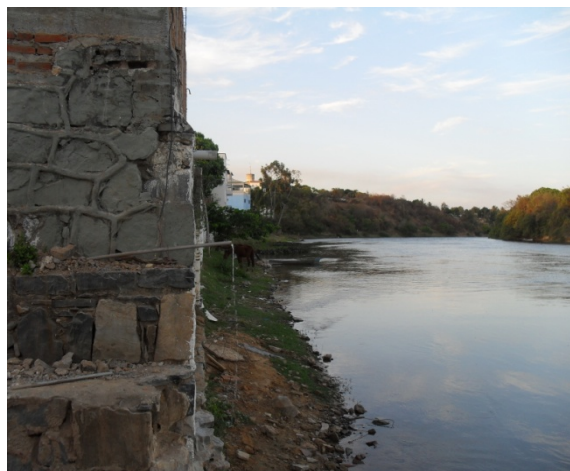
Foto 2: Lançamento direto de esgoto sanitário no Rio Corrente.
