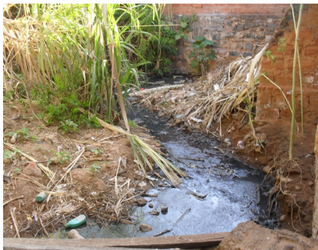
Foto 1: Trecho em que a galeria de seção retangular 1m x 1m passa por dentro de um terreno particular e despeja os esgotos sanitário e águas pluviais para que eles alcancem o rio.
