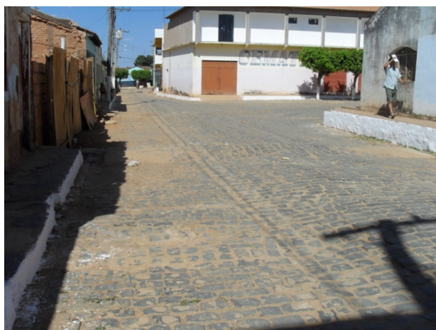
Foto 19: Área crítica 7 - Rua Joaquim Firmino. Área crítica por conta de erosão.
