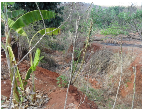
Foto 6: Terreno natural erodido por conta das águas pluviais.
