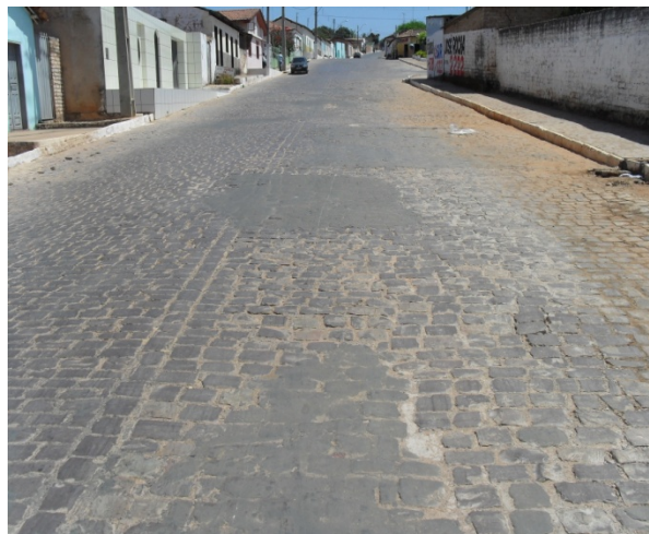
Foto 2: Área Crítica 1 - Rua Getúlio Vargas. Área crítica por conta de erosão.
