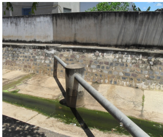
Foto 2: Tubulação de chegada da rede de esgotamento existente na estação elevatória de esgoto.
