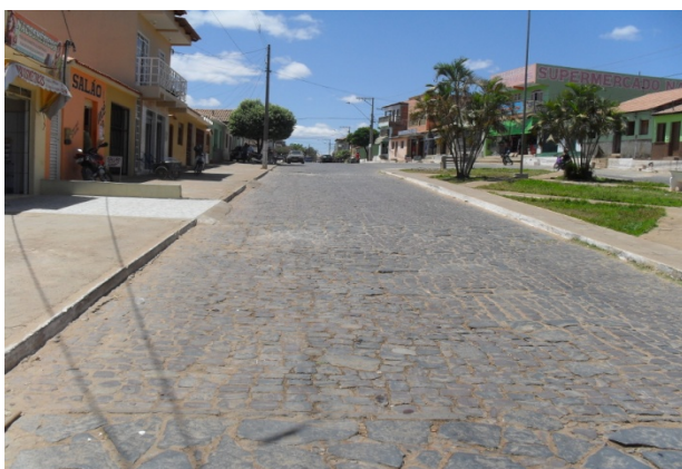
Foto 3: Área Crítica 2 - Praça Raimundo Sales. Área crítica por conta de erosão do pavimento.
