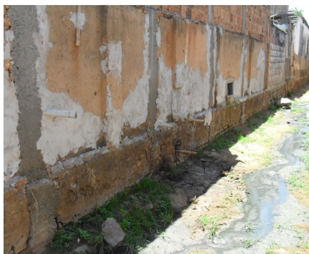
Foto 4: Esgoto a céu aberto num beco próximo da estação de tratamento de esgoto abandonada.
