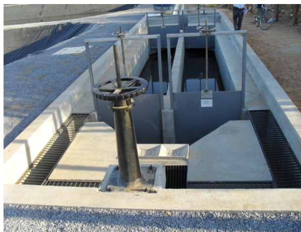
Foto 6: Mecanismo de entrada dos efluentes da ETE. Gradeamento seguido de caixa de areia e medidor de vazão tipo Calha Parshall.
