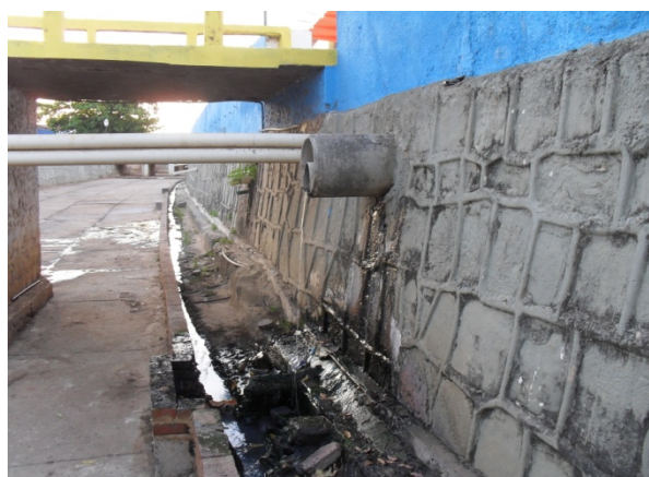
Foto 4: Lançamento difuso de redes coletoras de diferentes materiais e diâmetros ao longo do trecho canalizado do Riacho das Lages.
