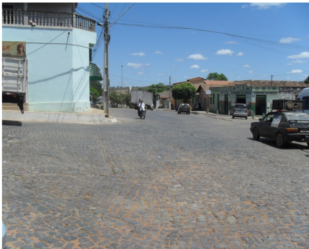
Foto 1: Área Crítica 1 - Avenida Tancredo Neves, trecho final. Área crítica por conta de erosão do pavimento.
