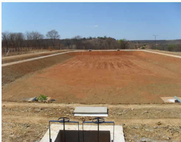
Foto 9: Mecanismo de manobra para o controle da entrada dos esgotos sanitários nas lagoas facultativas.
