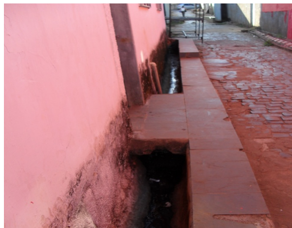
Foto 10: Canaleta de drenagem recebendo esgoto secundário das residências.
