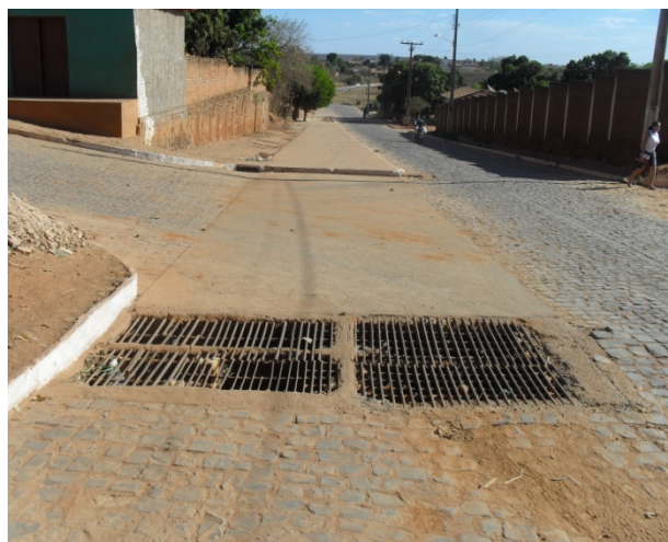
Foto 18: Início do canal de macrodrenagem em galeria retangular enterrada com seção de 2m X 1m.
