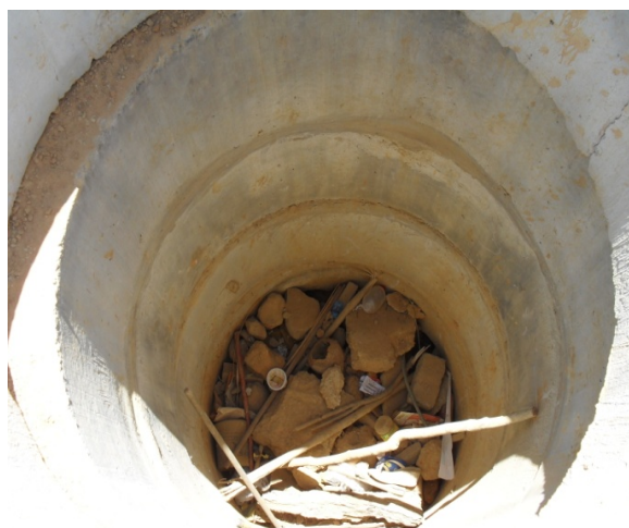
Foto 4: Poço de visita em mau estado de conservação. Lixo doméstico e outros materiais foram encontrados no interior das estruturas.
