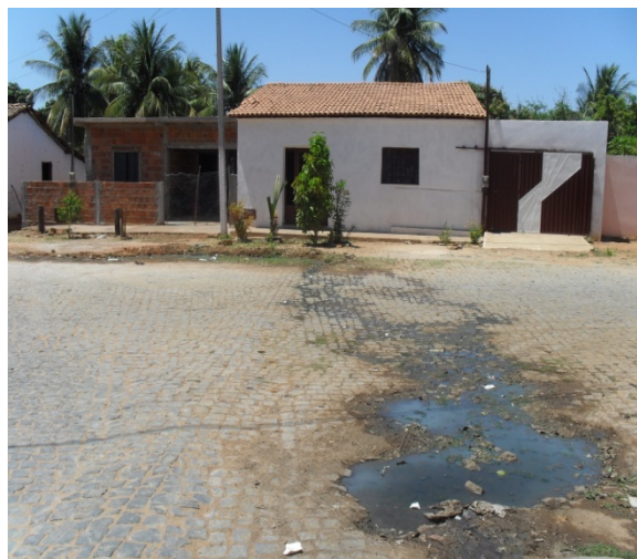
Foto 2: Rua São Miguel. Um dos trechos de maior acúmulo de esgoto secundário na sede do município.
