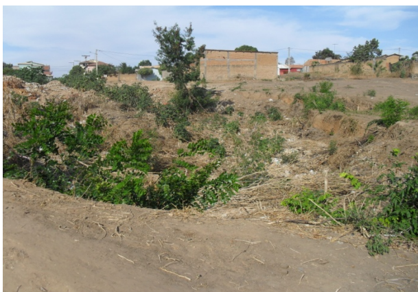
Foto 7: Erosão provocada pelas águas pluviais oriundas principalmente da Rua José Leopoldo Lima e da Rua Capitão Carlos Queiroz
