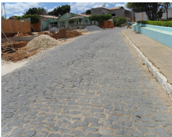
Foto 11: Área Crítica 5 - Praça Alkimin. Área crítica devido à ocorrência de erosão no pavimento.
