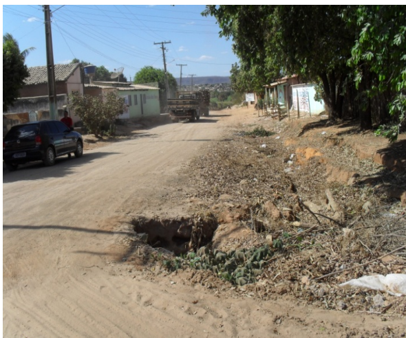
Foto 9: Rua Alto da Vitória. Área que sofre com as águas pluviais devido ocorrência de erosão
