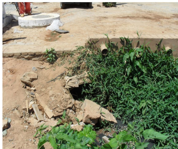
Foto 2: Ponto de lançamento de esgotos sanitários e águas pluviais da galeria mista de macrodrenagem. Tubulação de concreto de 1000 mm de diâmetro.
