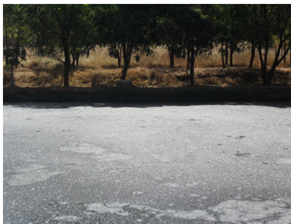
Foto 3: Lagoa de estabilização com entrada de esgoto na superfície. Muito lixo e muita gordura na superfície.
