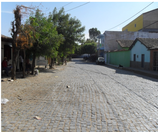
Foto 1: Área Crítica 1 - Rua Humberto de Campos (feirinha). Área crítica por conta da ocorrência de alagamento.
