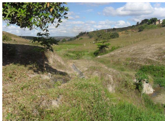
Foto 6: ETE construída a cerca de 13 anos, composta por DAFA, está destruída. Funcionou por cerca de 2 anos. Saída com muita vegetação e mau cheiro.
