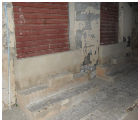
Foto 36: Rua Quintino Bocaiúva. Área crítica por conta da ocorrência de alagamento. Área crítica 12.
