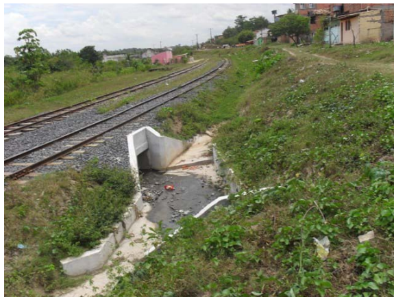
Foto 8: Ponto de lançamento de drenagem e esgoto – tubo de concreto DN 300 mm – lança em caixa e galeria de travessia da linha férrea e escoamento para terreno até o Rio Aramari (drenagem com presença de esgoto primário).
