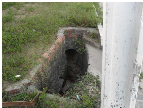
Foto 18: Rua Baixa da Areia – Bairro Vila do Conde – ponto de drenagem com tubo de concreto DN 500 mm e 02 bocas de lobo abertas que lançam em fundo do quintal. Feito pelo morador e sem recursos para concluir obra.
