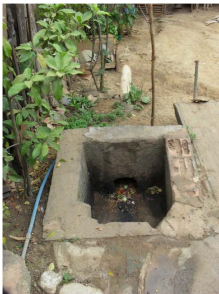
Foto 1: Rua Tiradentes - ponto de lançamento de esgoto e drenagem – tubo PVC DN 150 mm – fundo de casa com caixa e saída para terreno a céu aberto.
