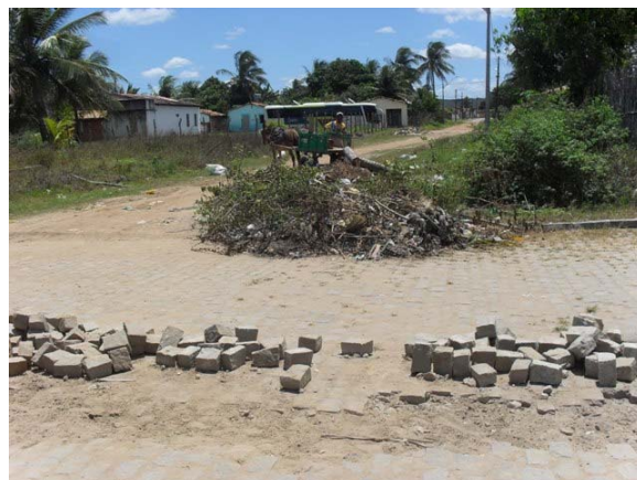
Foto 2: Área Crítica 1 – Av. Santo Antonio, Rua Agripino Brito e adjacências – área de enchente e inundação ribeirinha.
