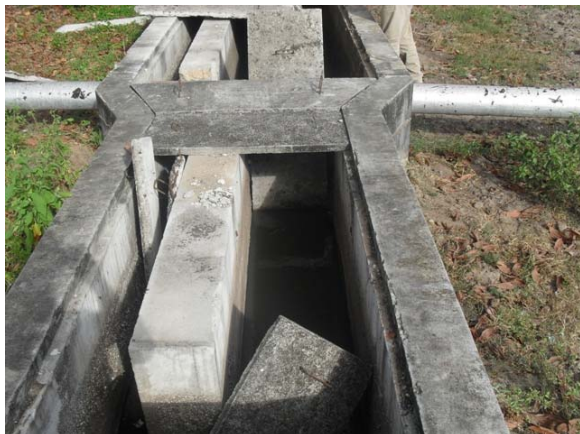
Foto 13: ETE Petrolar – Caixa de Areia / Grade.
