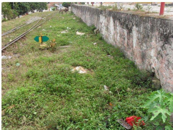
Foto 17: Ponto de lançamento de drenagem com tubo de concreto de DN 300 mm e lançamento de esgoto com tubo de concreto de DN 300 mm – galeria atravessa a linha férrea – não dá visão para a saída, mas o lançamento escoar para a represa do Rio Aramari.
