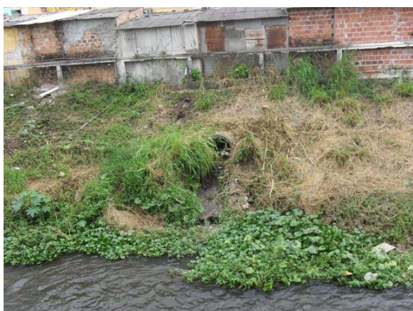
Foto 3: Pontos de lançamento direto de esgoto no corpo receptor e trechos do Rio Catu – a jusante da ponte.
