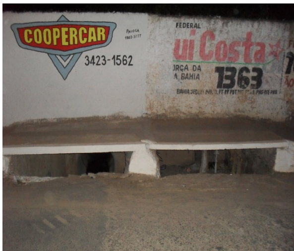
Foto 37: Rua Quintino Bocaiúva. Detalhe dos dispositivos de drenagem responsáveis por escoar um grande volume de contribuição superficial que converge para área baixa ilustrada.
