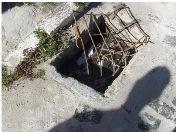
Foto 5: Caixa de drenagem com presença de esgoto – danificada e entupida causando alagamento quando chove.
