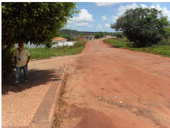
Foto 3: Ponto onde passa o Riacho Romã – canalizado por tubo de concreto DN 1.000 e passa pelo fundo de mais ou menos 25 casas.
