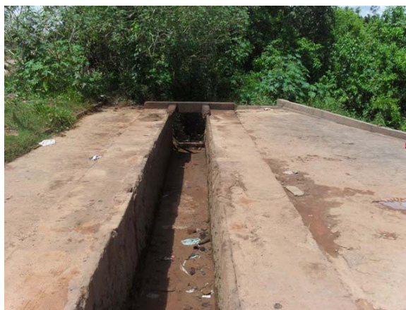
Foto 10: Ponto de lançamento final de drenagem e esgotos em terreno – lava jato lançando óleo no Rio Quiricó.
