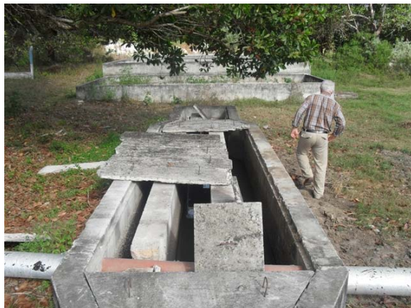
Foto 14: ETE Petrolar – Caixa de Areia – leitos de secagem.
