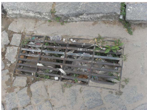
Foto 3: Caixa de drenagem mostrando o lixo acumulado.
