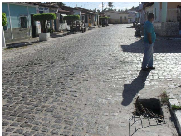
Foto 1: Área Crítica 1 – Rua Helena de castro, Rua 15 de Novembro e Travessa Severino Vieira – área de enxurrada – caixas de drenagem entupidas e escoando esgoto secundário – tubo PVC DN 200 mm.
