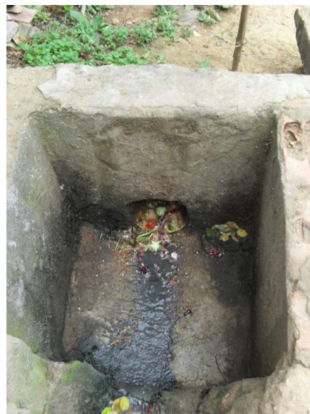
Foto 2: Rua Tiradentes - ponto de lançamento de esgoto e drenagem – tubo PVC DN 150 mm – fundo de casa com caixa e saída para terreno a céu aberto.
