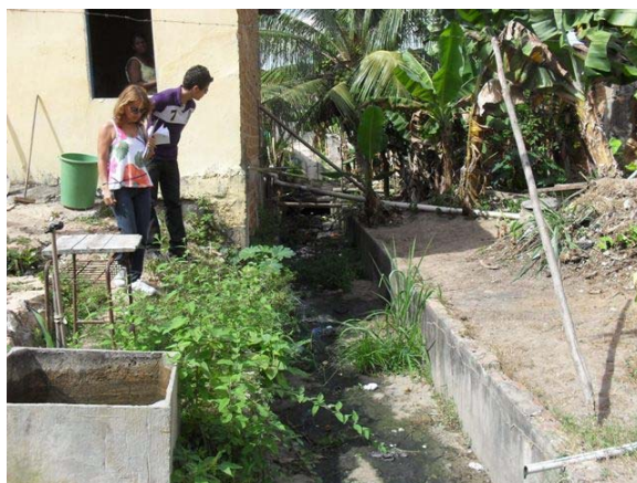
Foto 12: Rua da Baixinha com a Rua da Bica – ponto de lançamento de drenagem e esgotos – saída de Canal com parte destruída - escoamento para área aberta e vai por infiltração para o Rio Inhambupe.
