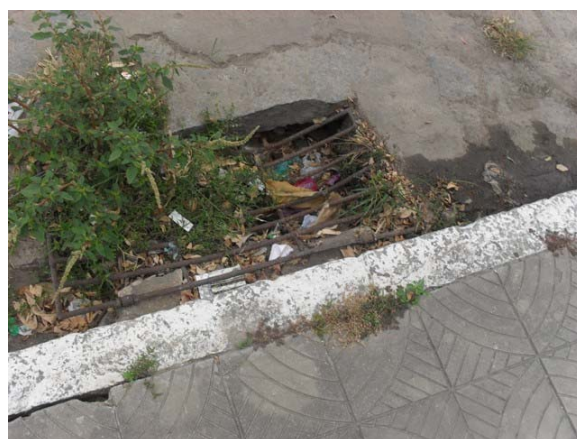
Foto 4: Área Crítica 2 – Praça Duque de Caxias – área de enxurrada – caixas de drenagem cheias de lixo.
