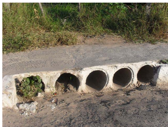
Foto 16: Drenagem da Rua Simões Filho – 5 tubos de concreto DN 300 mm atravessando o passeio para área aberta – drenagem deslocado do ponto onde surgiu a erosão para cerca de 40 m a frente.
