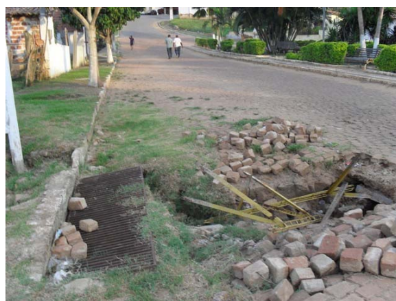
Foto 4: Área Crítica 2 – Praça Jardim do Éden – área de enxurrada.
