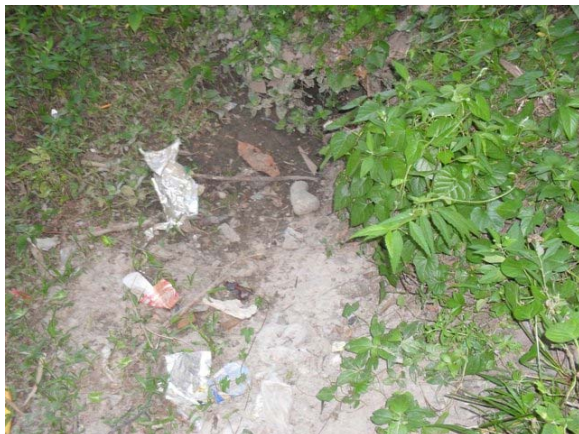
Foto 11: Av. Campos – Bairro Vila do Conde – ponto de lançamento de esgoto no fundo de quintal – tubo de concreto DN 300 mm – casa sem sanitário.
