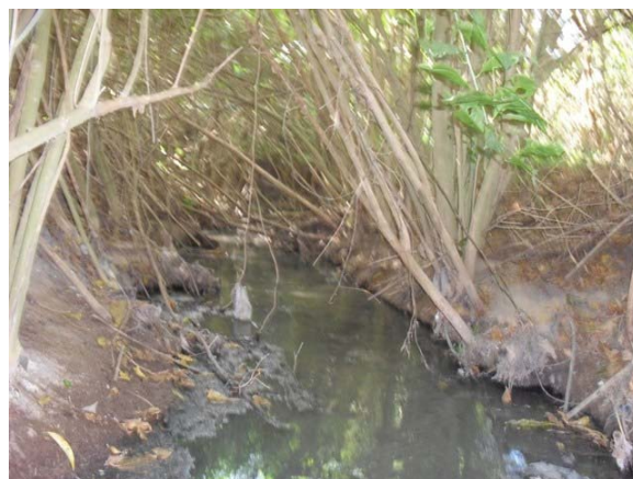
Foto 8: Ponto de lançamento de esgoto e drenagem – tubo de concreto DN 600 mm – lança em terreno particular e escoamento através de vala até o Rio Inhambupe.
