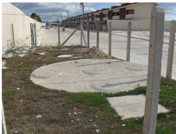
Foto 10: ETE Conjunto Parque Jardim – DAFA / Caixa de Areia / Grade.
