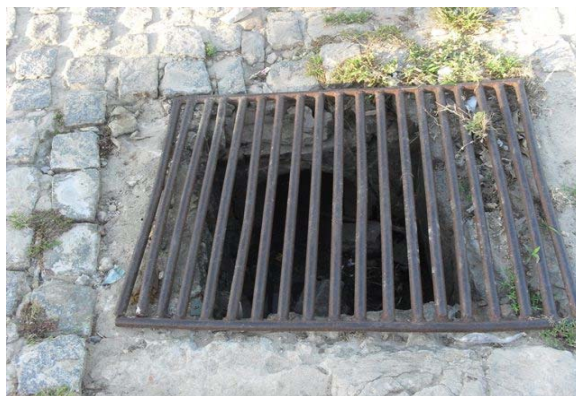
Foto 14: Av. Campos – Bairro Vila do Conde – boca de lobo com esgoto secundário e muito lixo – problemas de entupimento e o ponto de lançamento é no fundo de quintal com tubo de concreto DN 300 mm.
