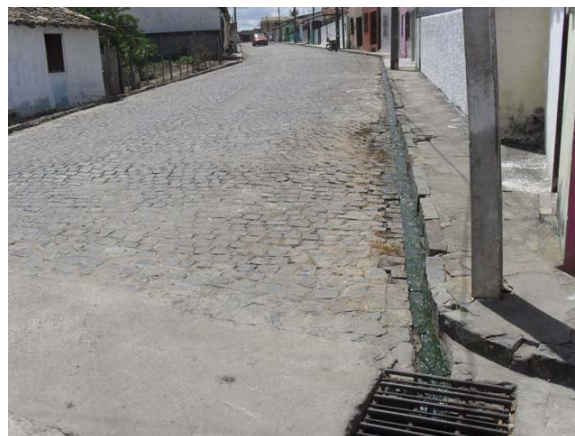
Foto 6: Área Crítica 2 – Rua Marquês de Abrantes – mostra as bocas de lobo com lixo, esgoto primário e secundário.
