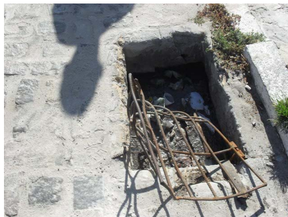
Foto 2: Área Crítica 1 – Rua Helena de castro, Rua 15 de Novembro e Travessa Severino Vieira – área de enxurrada – caixas de drenagem entupidas e escoando esgoto secundário – tubo PVC DN 200 mm.
