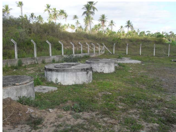
Foto 26: ETE Nova Brasília – Caixa de Areia / DAFA.
