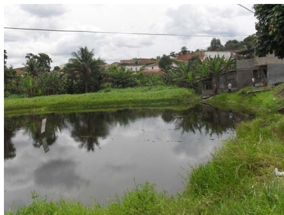
Foto 16: Ponto de lançamento de drenagem e esgotos primário e secundário – tubo de concreto de DN 300 mm – mostra o lançamento dentro do mato e a vista da represa com vegetação própria da presença de esgoto.
