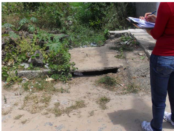
Foto 1: Av. São Roque - ponto de lançamento de esgoto e drenagem – saída em vala numa área particular com muito lixo e vegetação.
