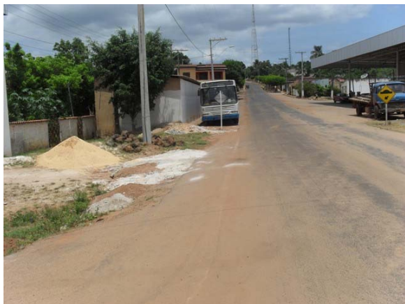
Foto 1: Área Crítica 1 – Loteamento Santa Maria – Rua Sem Saída (denominação do mapa) não tem drenagem e sofre enxurradas.
