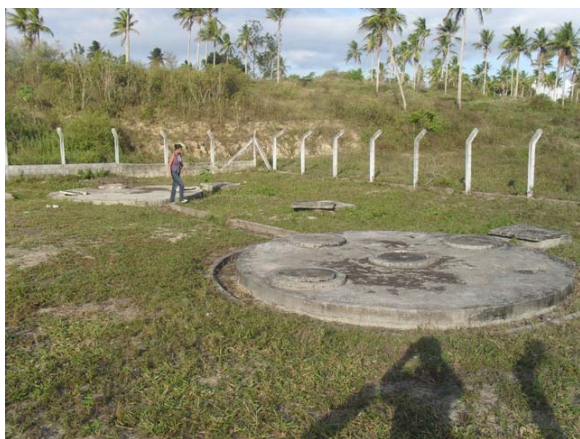
Foto 27: ETE Nova Brasília – Caixa de Areia / DAFA.
