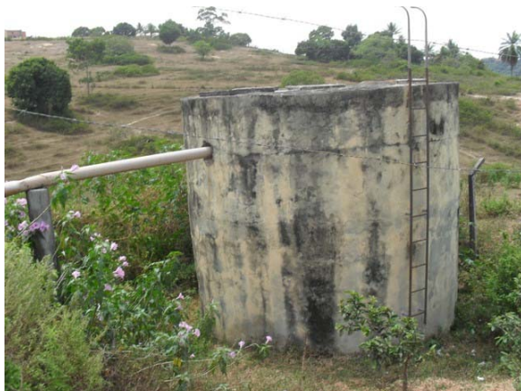
Foto 21: Bairro Bom Viver – Baixa da Guia – sistema separador e DAFA inoperante, funciona como passagem – chega rede PVC DN 150 mm no DAFA e sai DN 150 mm.
