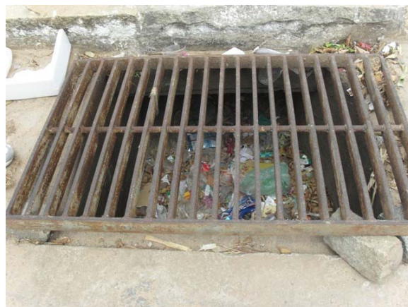
Foto 2: Rua José Inácio – caixa de drenagem (2 unidades).
