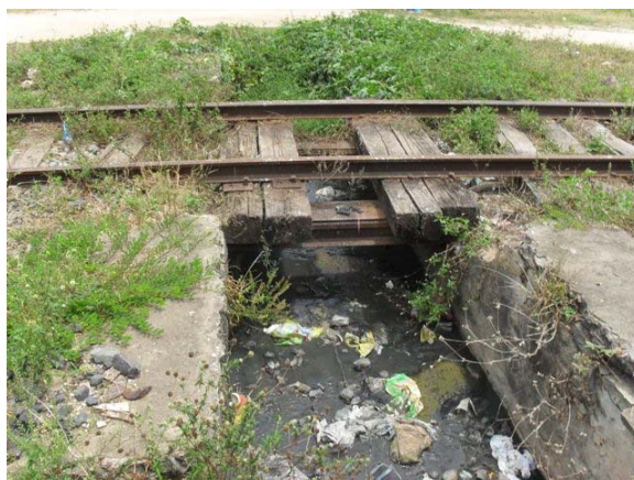
Foto 10: Ponto de lançamento de drenagem com esgoto primário e secundário – tubo de DN 600 mm que escoar pelas caixas e galeria da linha férrea lançando em terreno e escoando para o Rio Aramari.
