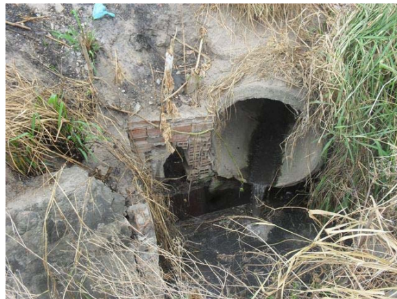
Foto 6: Canaleta ao longo da BR-101 (0,60 x 0,80 m) – mais ou menos 1 km de comprimento – caindo para ponto de escoamento de esgoto.
