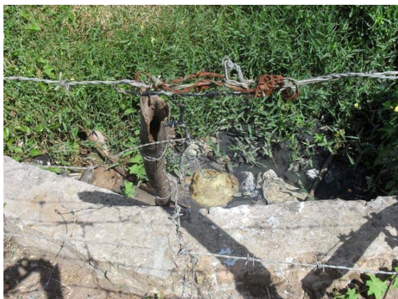
Foto 13: Rua Antonio de Carvalho – ponto de lançamento de drenagem e esgoto – tubo de concreto DN 600 mm – lança em terreno da Prefeitura e segue através de vala sem revestimento e infiltra até a Lagoa dos Patos.
