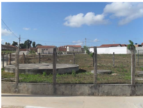
Foto 9: ETE Conjunto Tropical – DAFA / Caixa de Areia / Grade.
