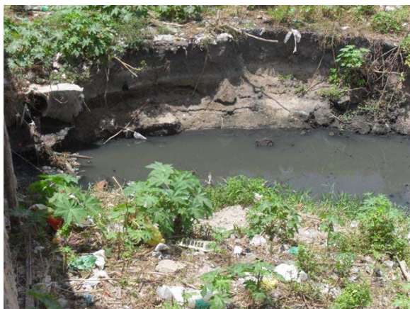
Foto 5: Área Crítica 1 – Rua José Ponciano – pontos de rede com saída para o Riacho que está bastante sujo com esgotos e lixo.
