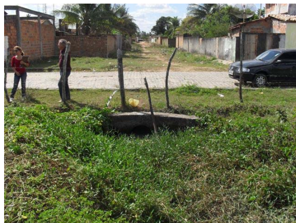
Foto 6: Rua Antonio de Carvalho – ponto de lançamento de esgotos e drenagem – tubo de concreto DN 600 mm – lança em terreno da Prefeitura e segue através de vala sem revestimento e infiltra até a Lagoa dos Patos.
