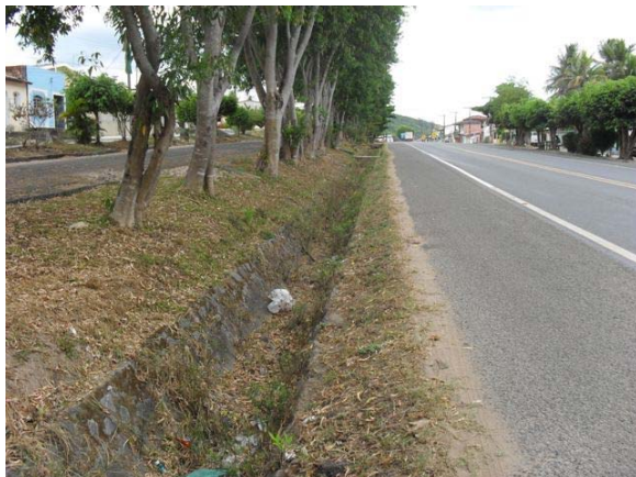
Foto 5: Canaleta ao longo da BR-101 (0,60 x 0,80 m) – mais ou menos 1 km de comprimento – caindo para ponto de escoamento de esgoto.
