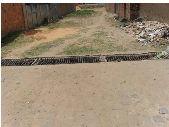
Foto 7: Av. Iderbal Gomes de Cerqueira – saída com tubo de concreto DN 600 mm até o Canal – tubos de chegada não funcionam e não atendem no período das chuvas fortes.
