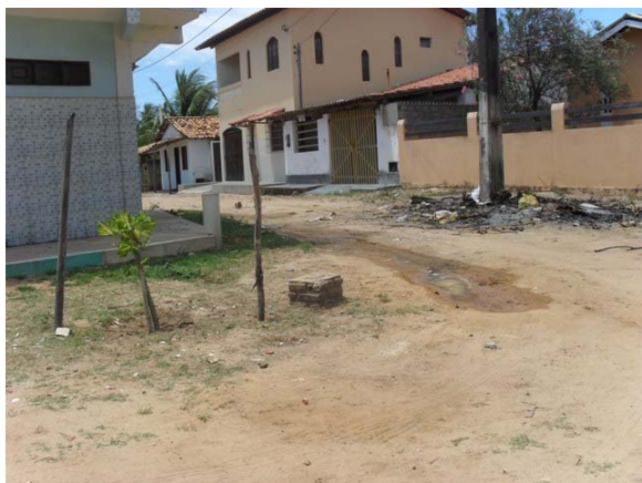
Foto 3: Ponto de lançamento de esgoto a céu aberto.
