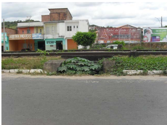
Foto 1: Ponto de lançamento de esgoto e drenagem – galeria atravessa as 2 pistas e a ferrovia em tubo de concreto DN 1000 mm – lança no Rio Catu – forte mau cheiro.
