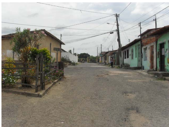
Foto 17: Bairro Pioneiro – escoamento dos esgotos através da Rua dos Nús – saída em tubo de concreto DN 800 mm em área particular – escoamento para o Riacho Rio Branco e daí para o Rio Una – caminhamento e saída para Canal a céu aberto provocando grande erosão.
