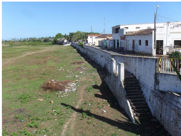
Foto 8: Av. Beira Rio – vários pontos difusos de lançamento de drenagem – tubo de concreto DN 300 mm.
