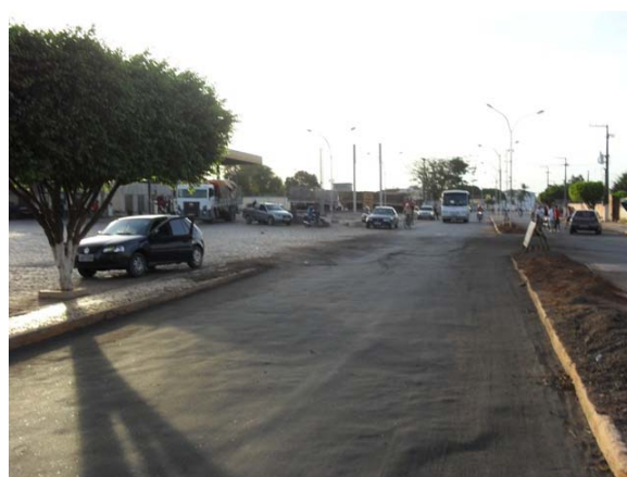
Foto 16: Área Crítica 9 – Rua Francisco Benjamin e Adjacências – área de alagamento.
