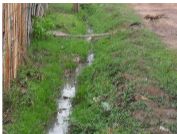
Foto 8: Bairro Nova Itanagra – ruas sem calçamento com valas sem revestimento abertas na lateral por onde escoam drenagem e esgotos. Muitas casas sem sanitário – necessidades são lançadas na vala.
