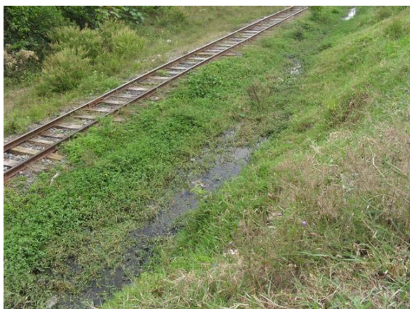
Foto 11: Ponto de lançamento de esgoto primário e secundário da rede separadora que não foi concluída – mostra Canal a céu aberto ao lado da ferrovia.
