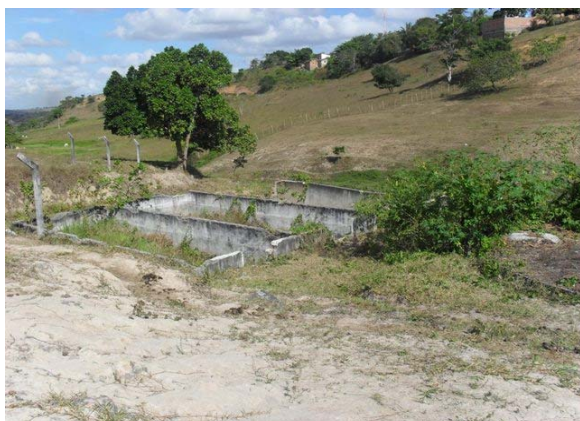
Foto 3: ETE construída a cerca de 13 anos – está destruída – funcionou por cerca de 2 anos.
