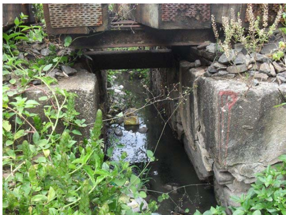
Foto 13: Ponto de lançamento de drenagem com esgoto primário e secundário – tubo de concreto DN 300 mm – galeria da linha férrea (0,50 x 0,30 m) – muito lixo e tubulação danificada que vai até a represa do Rio Aramari.
