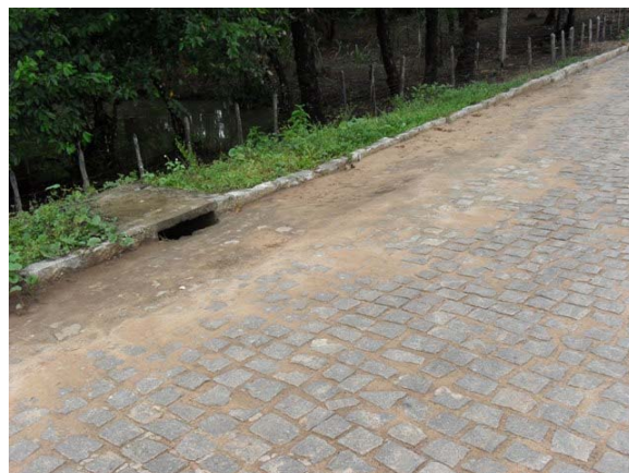
Foto 10: Ponto de lançamento de drenagem e esgoto secundário – Rua Padre Luiz Palmeira – caminhamento apenas nesta rua em tubo de concreto DN 400 mm – saída para vala sem revestimento em terreno e escoamento para o Bueiro seguindo para o Rio Sauípe.
