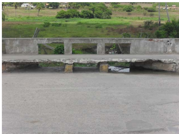
Foto 4: Área Crítica 1 – Rua José Ponciano – pontos de rede com saída para o Riacho que está bastante sujo com esgotos e lixo.
