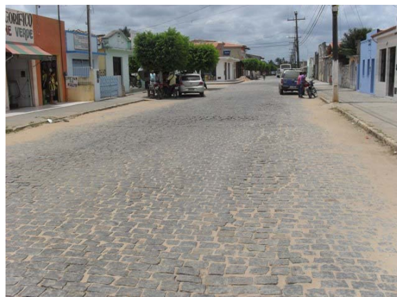
Foto 2: Área Crítica 1 – Rua Luiz Viana com a Rua João Bernardino de Sena – área de enxurrada.
