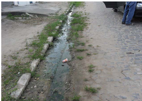
Foto 5: Av. São Francisco de Assis – esgoto secundário lançado a céu aberto.
