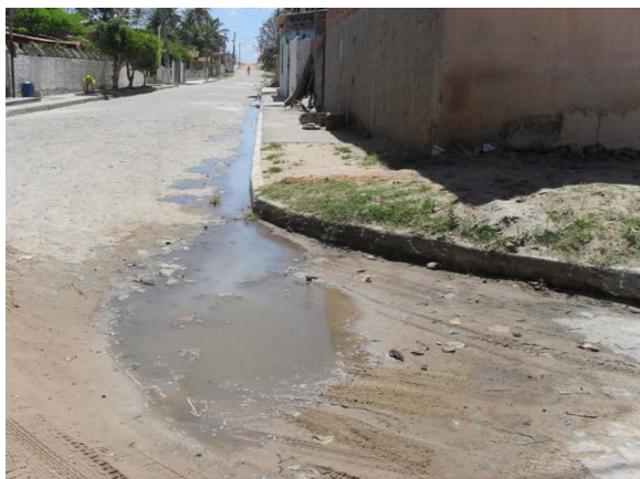
Foto 1: Rua São Domingos – lançamento de esgoto a céu aberto.
