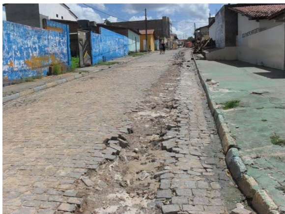
Foto 5: Rua Margem do Rio (Rua do Posto) – continuação da Rua Inácio Nascimento – lançamento de esgoto a céu aberto.
