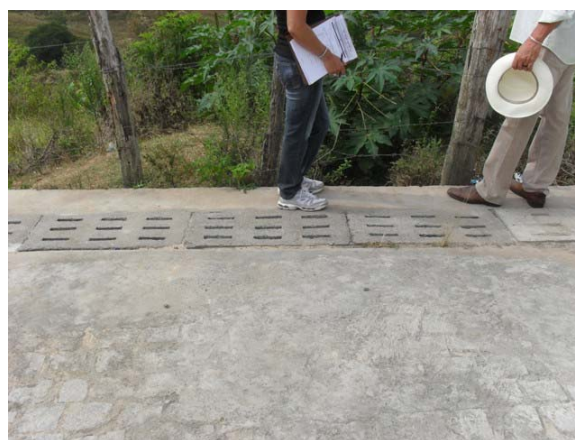
Foto 22: Bairro Fleming – sistema separador – saída em tubo de concreto DN 400 mm para terreno natural, drenagem escoar para o Riacho Riachão e vai até o Rio Una.
