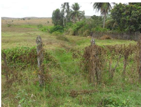
Foto 11: Ponto de lançamento final (drenagem + esgoto) – tubo de concreto DN 600 mm coberto pela vegetação – escoar através de vala sem revestimento até o Rio Inhambupe.
