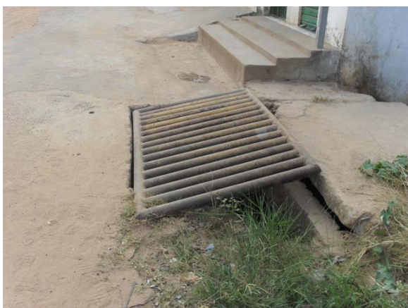
Foto 9: Rua Paraná – esgoto escoando a céu aberto por vala aberta que escoo para o Riacho. Muitas cobras, ratos, muriçocas, fortes odores e grande quantidade de lixo.
