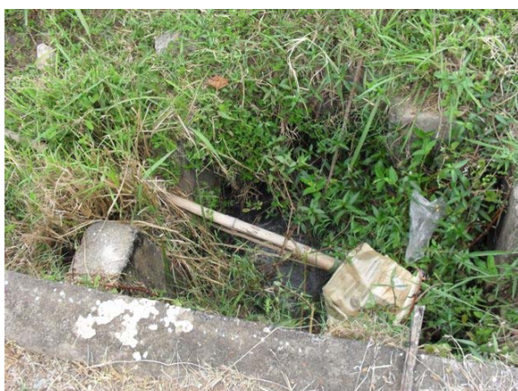
Foto 3: Ponto de lançamento de esgoto – tubo de concreto DN 300 mm – escoa para o Riacho Maleita – atravessa o bueiro da ferrovia.
