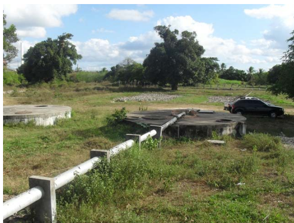
Foto 16: ETE Petrolar – DAFAs e Wetlands existentes e em funcionamento.
