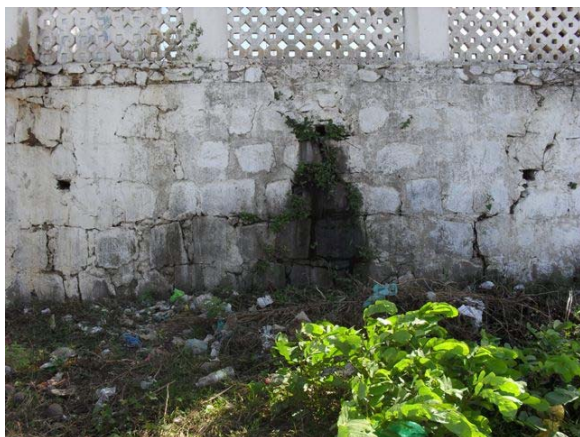
Foto 1: Ponto de lançamento de esgoto secundário e drenagem – escoamento pela margem do rio – saída em tubo PVC DN 200 mm e alguns pontos de lançamento direto no rio.
