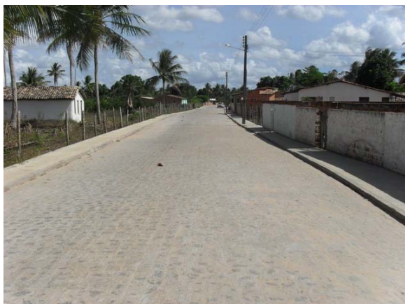
Foto 9: Área Crítica 3 – Rua Aristóteles José dos Santos – área de enxurrada.
