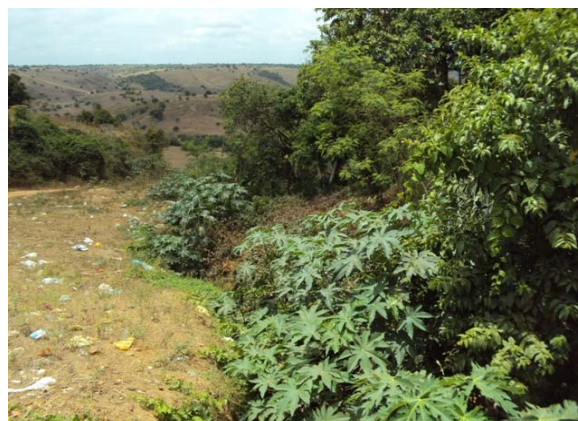
Foto 4: Ponto de lançamento de esgoto secundário – tubo PVC DN 150 mm – escoamento a céu aberto pela encosta.
