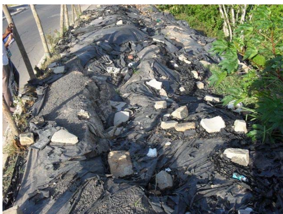
Foto 15: Rua Simões Filho, próximo a rotatória do Pioneiro – grande erosão com cerca de 30 m de profundidade – causada pelo antigo ponto de lançamento de drenagem.
