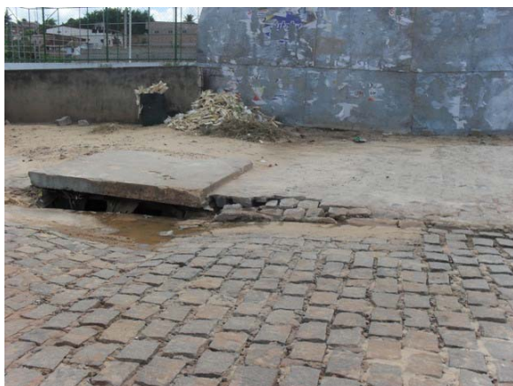
Foto 5: Caixas com abertura na guia.
