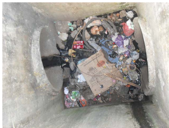
Foto 10: Estruturas abertas com muito lixo – boca de lobo escoando drenagem e esgotos.
