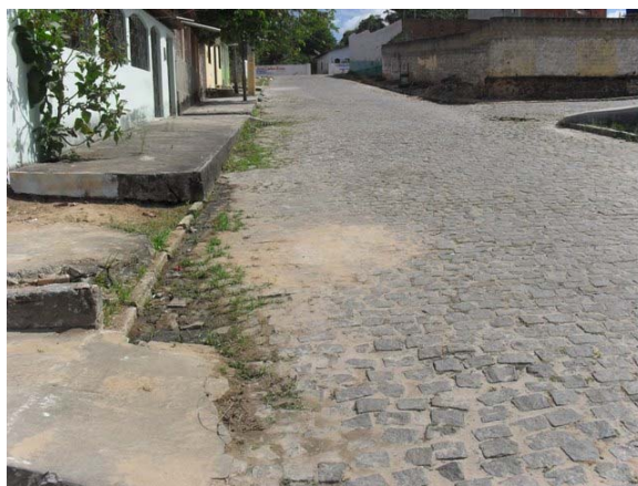
Foto 10: Rua Princesa Isabel – apresenta problemas de erosão. Águas descem em enxurrada arrancando paralelo – presença de pontos de esgoto a céu aberto.
