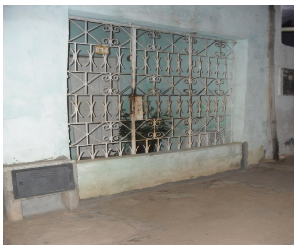
Foto 39: Rua Silva Jardim. Moradores locais constroem muretas na entrada de suas casas para conter a invasão das águas pluviais e minimizar os efeitos dos alagamentos que ocorrem no local.
