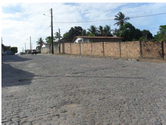
Foto 11: Final da Rua Santa Terezinha – mostrando as erosões ocasionadas pelas chuvas.
