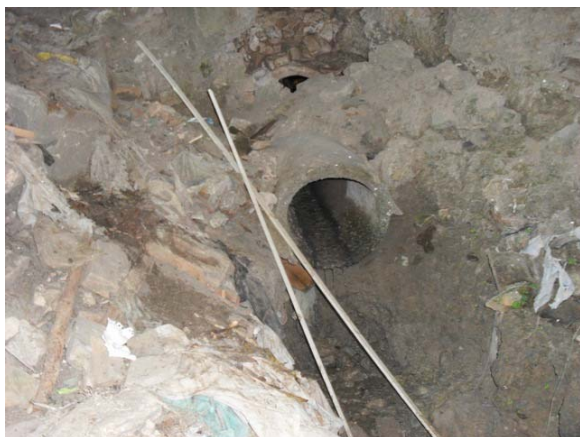
Foto 1: Ponto de lançamento de esgoto e drenagem (esgoto primário e secundário da lanchonete e salão de beleza) – saída no fundo de casa em terreno particular.
