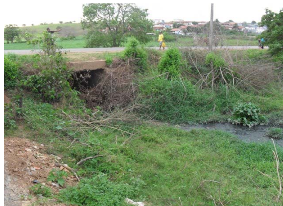
Foto 2: Ponto de lançamento de esgoto de parte da cidade – tubo de concreto DN 600 mm e lançamento final em terreno.
