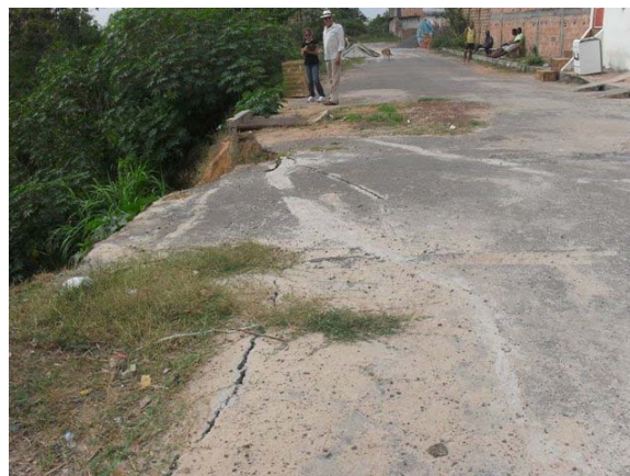
Foto 18: Bairro Planalto II – ponto de drenagem do bairro causou forte erosão – buraco de grandes dimensões (30 m profundidade, 50 m largura e 70 m comprimento).
