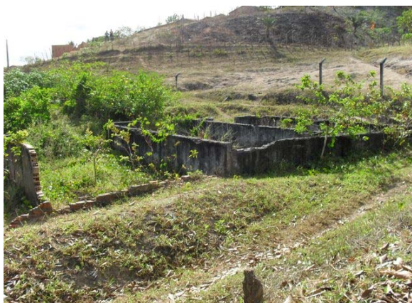
Foto 5: ETE construída a cerca de 13 anos, composta por DAFA, está destruída. Funcionou por cerca de 2 anos. Saída com muita vegetação e mau cheiro.
