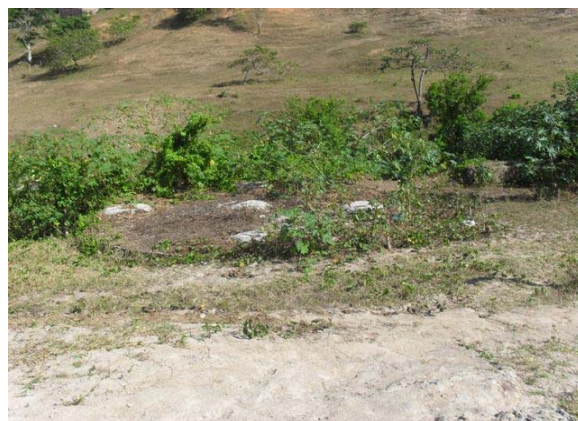
Foto 4: ETE construída a cerca de 13 anos – está destruída – funcionou por cerca de 2 anos – DAFA – saída com muito mato e mau cheiro.
