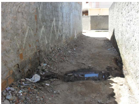
Foto 3: Travessa Antonio Vieira de Castro – pontos de lançamento de esgoto a céu aberto.
