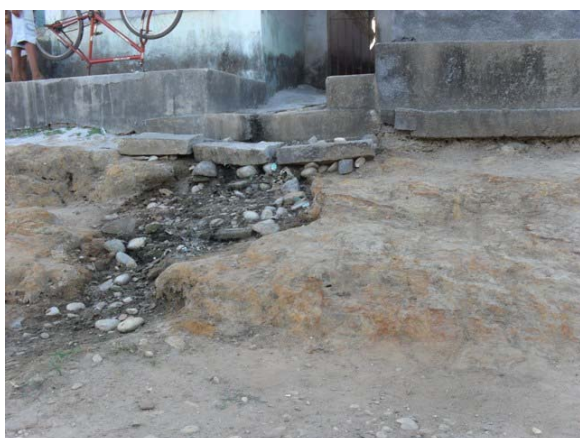
Foto 7: Bairro Vila do Conde – ponto de lançamento de esgoto a céu aberto – presença de muito lixo nas ruas.
