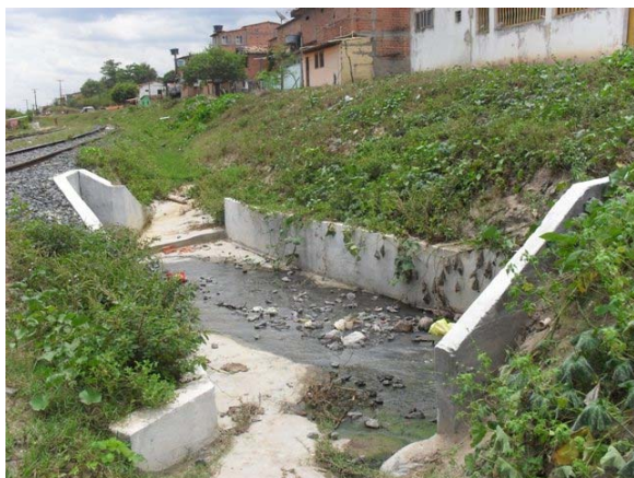
Foto 1: Ponto de lançamento de esgoto primário e secundário e drenagem - tubo de concreto de DN 300 mm – lança em caixa e galeria de travessia da linha férrea e escoamento para terreno em direção ao Rio Aramari.
