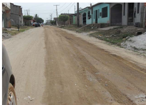
Foto 16: Estrada Velha de São Miguel – escoam os esgotos do Bairro Planalto I, Loteamento Santo André e Loteamento Boa Vista através de rede – cerca de 8.000 pessoas se servem desta rede.
