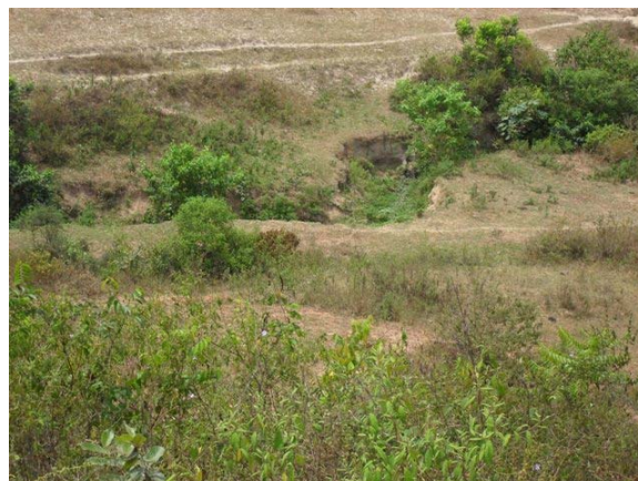
Foto 22: Bairro Bom Viver – Baixa da Guia – sistema separador e DAFA inoperante, funciona como passagem – chega rede PVC DN 150 mm no DAFA e sai DN 150 mm.
