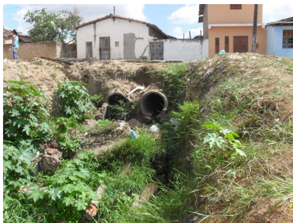
Foto 8: Área Crítica 4 – Grande erosão – paralela a Rua da Floresta.
