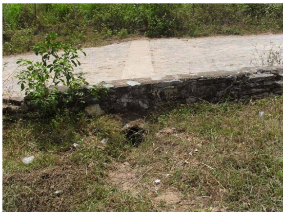
Foto 3: Ponto de lançamento final de drenagem – vem em tubo DN 400 e sai com DN 300 mm – esco para a lagoa.
