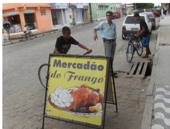
Foto 4: Av. Mário Andreaza – caixas de drenagem – exala mau cheiro de esgoto e presença de muito lixo.
