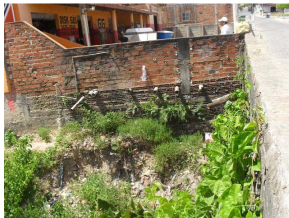
Foto 2: Riacho da Fonte Branca – vista da Rua Ladislau Azevedo – mostra lançamento de esgoto difuso e pontual.
