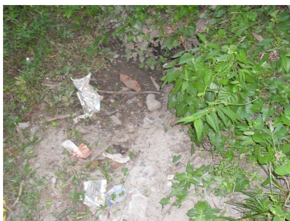
Foto 16: Av. Campos – Bairro Vila do Conde – boca de lobo com esgoto secundário e muito lixo – problemas de entupimento e o ponto de lançamento é no fundo de quintal com tubo de concreto DN 300 mm.
