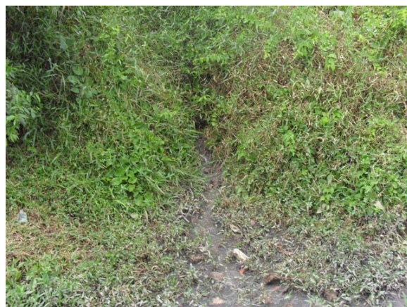
Foto 12: Ponto de lançamento de esgoto primário e secundário da rede separadora que não foi concluída – mostra Canal a céu aberto ao lado da ferrovia – está assoreado.
