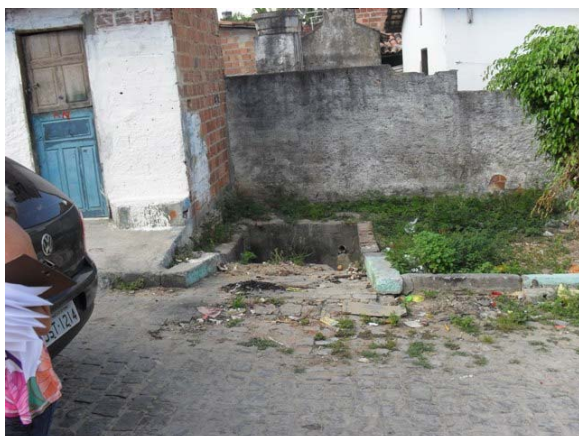
Foto 9: Estruturas abertas com muito lixo – boca de lobo escoando drenagem e esgotos.
