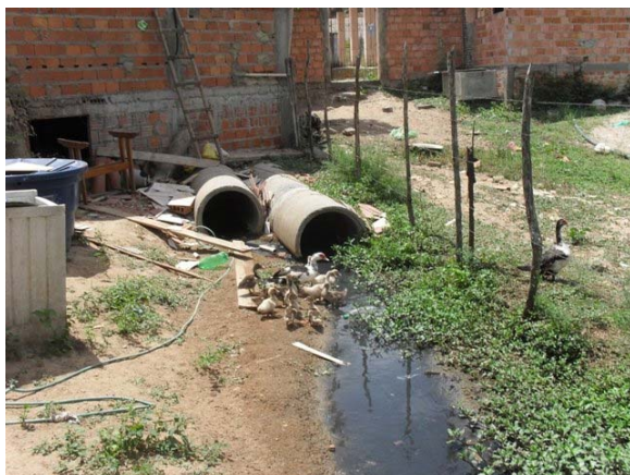
Foto 21: Galeria de drenagem com tubo de concreto de DN 300 mm com caixa de passagem pela linha férrea – escoamento no fundo de casa em 2 tubos de DN 300 mm e em vários pontos lançamentos difusos na represa do Rio Aramari.
