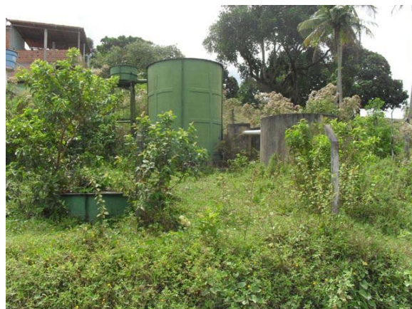
Foto 10: Ponto de lançamento de esgoto primário e secundário da rede separadora – mostra o DAFA que não chegou a ser concluído – não foi instalado as bombas e a saída escoa por infiltração por baixo da linha férrea para a represa.
