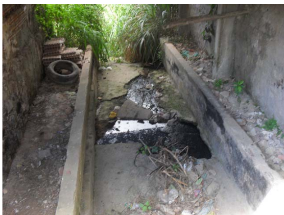
Foto 13: Rua da Baixinha com a Rua da Bica – ponto de lançamento de drenagem e esgotos – saída de Canal com parte destruída - escoamento para área aberta e vai por infiltração para o Rio Inhambupe.
