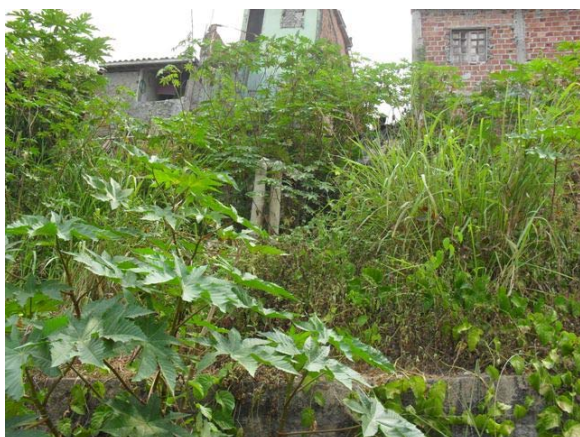
Foto 19: Bairro Pioneiro – escoamento dos esgotos através da Rua dos Nús – saída em tubo de concreto DN 800 mm em área particular – escoamento para o Riacho Rio Branco e daí para o Rio Una – caminhamento e saída para Canal a céu aberto provocando grande erosão.
