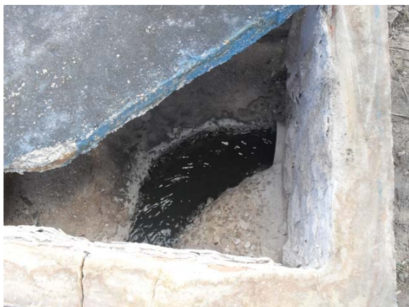
Foto 5: ETE Fonte dos padres – saída do efluente tratado.
