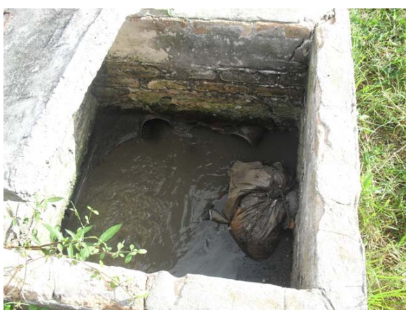
Foto 21: ETE Petrolar – Caixa de Passagem de esgoto para Wetland.
