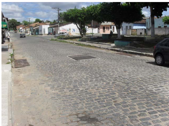
Foto 1: Área Crítica 1 – Av. Honório Borges – caixas de drenagem com muito lixo e escoamento de esgoto.
