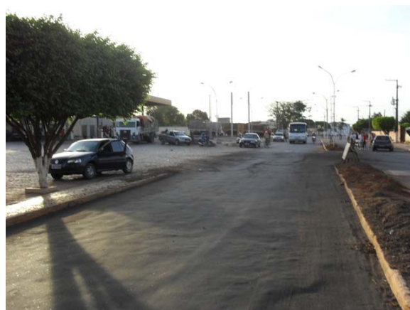
Foto 16: Área Crítica 9 – Rua Francisco Benjamin e Adjacências – área de alagamento.
