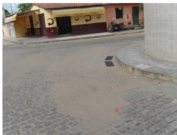
Foto 4: Área Crítica 2 – Rua José Maia com a Rua Otaciano Oliveira – área de enxurrada.
