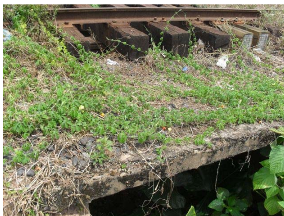
Foto 20: Galeria de drenagem com tubo de concreto de DN 300 mm com caixa de passagem pela linha férrea – escoar no fundo de casa em 2 tubos de DN 300 mm e em vários pontos lançamentos difusos na represa do Rio Aramari.
