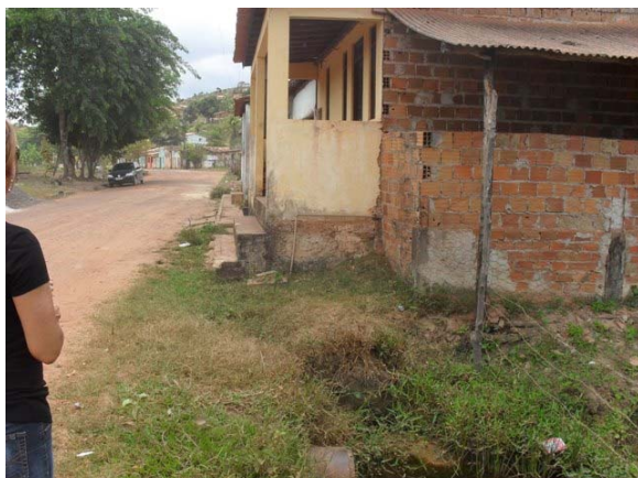
Foto 1: Ponto de lançamento de esgoto difuso e direto no Riacho Maleita - tubo de concreto DN 300 mm (provável, pois não está visível).
