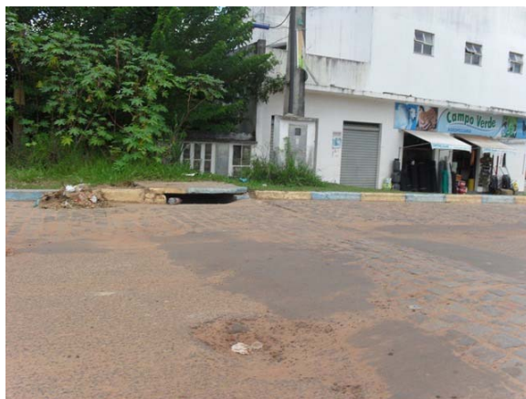
Foto 4: Caixas com abertura na guia.
