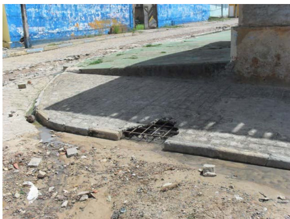
Foto 3: Rua Margem do Rio – fossa do colégio danificada e transbordando.
