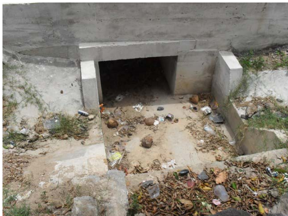
Foto 7: Caminhamento do Canal – parte sem revestimento e parte com revestimento - muito mato e assoreamento.
