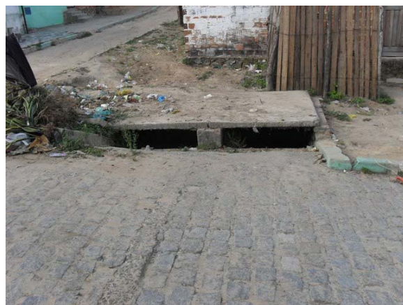
Foto 20: Estruturas abertas (boca de lobo) com muito lixo e com escoamento de drenagem e esgotos – muito lixo nas ruas.
