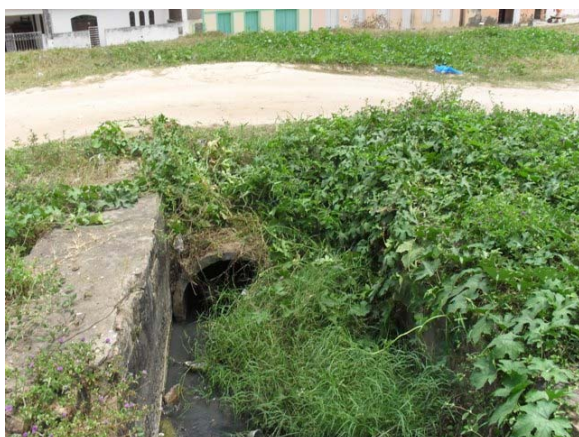
Foto 11: Ponto de lançamento de drenagem com esgoto primário e secundário – tubo de DN 600 mm que escoar pelas caixas e galeria da linha férrea lançando em terreno e escoando para o Rio Aramari.
