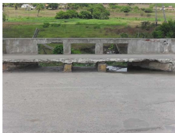
Foto 4: Área Crítica 1 – Rua José Ponciano – pontos de rede com saída para o Riacho que está bastante sujo com esgotos e lixo.
