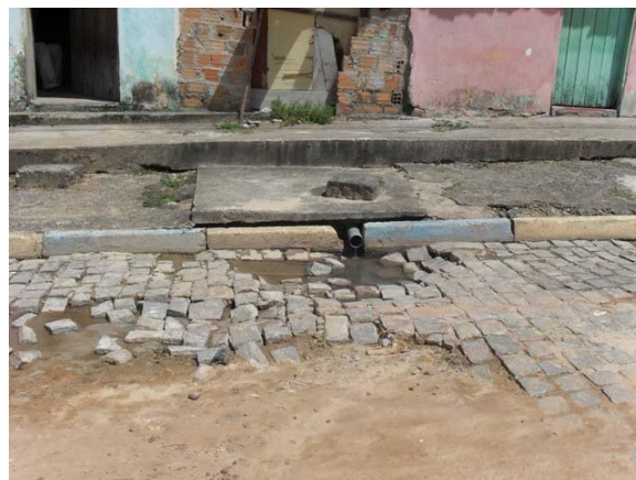
Foto 6: Rua Margem do Rio (Rua do Posto) – continuação da Rua Inácio Nascimento – lançamento de esgoto a céu aberto.
