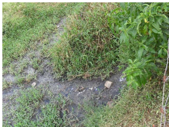
Foto 4: Ponto de lançamento de esgoto e drenagem – tubo PVC DN 200 mm – escoamento através de vala sem revestimento em terreno particular e segue para o Rio Inhambupe.
