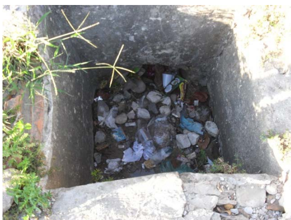
Foto 15: Av. Campos – Bairro Vila do Conde – boca de lobo com esgoto secundário e muito lixo – problemas de entupimento e o ponto de lançamento é no fundo de quintal com tubo de concreto DN 300 mm.
