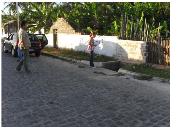
Foto 17: Rua Baixa da Areia – Bairro Vila do Conde – ponto de drenagem com tubo de concreto DN 500 mm e 02 bocas de lobo abertas que lançam em fundo do quintal. Feito pelo morador e sem recursos para concluir obra.
