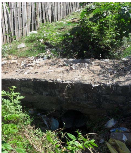
Foto 3: Rua Helena de castro – ponto de lançamento de esgoto secundário e drenagem em tubo de concreto DN 300 mm – muito lixo acumulado e muita vegetação.
