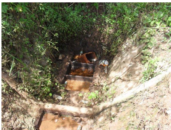
Foto 9: Ponto de lançamento final de drenagem e esgotos em terreno – não se vê a saída devido presença de muito mato.
