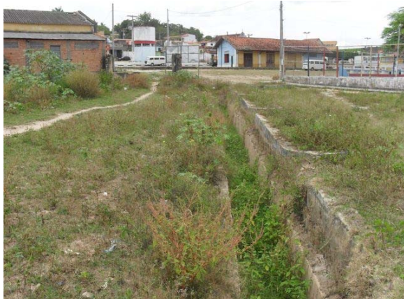
Foto 5: Caminhamento do Canal – parte sem revestimento e parte com revestimento - muito mato e assoreamento.
