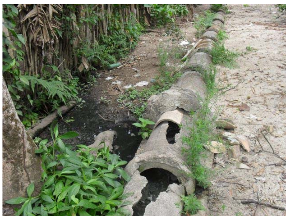
Foto 7: Ponto de lançamento de esgoto primário e secundário e drenagem – tubo de concreto DN 300 mm e galeria da linha férrea (0,50 x 0,30 m) – presença de muito lixo e tubulação que está danificada vai até a represa do Rio Aramari.
