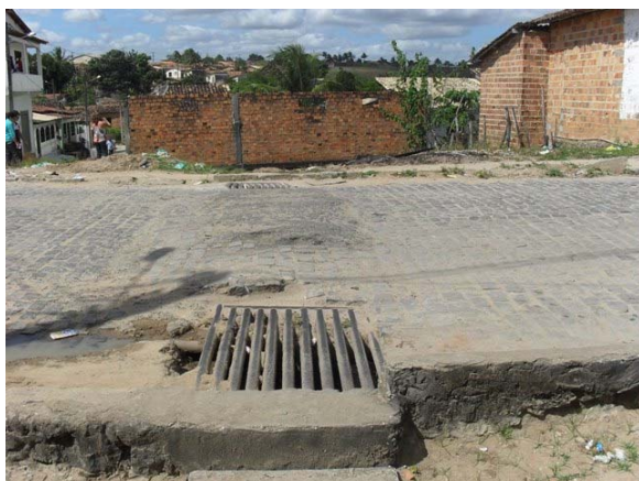
Foto 11: Rua da Baixinha com a Rua da Bica – ponto de lançamento de drenagem e esgotos – escoamento para área aberta e vai por infiltração para o Rio Inhambupe.
