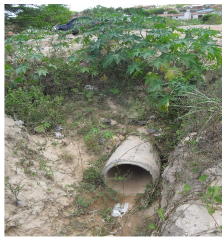
Foto 4: Avenida Rio Branco. Ponto de lançamento da rede de microdrenagem que contribui para lagoa da Cavada. Tubulação de concreto de 600 mm de diâmetro.
