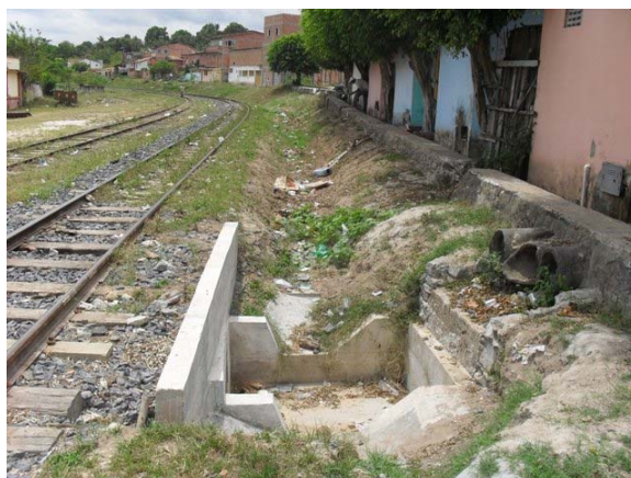
Foto 6: Caminhamento do Canal – parte sem revestimento e parte com revestimento - muito mato e assoreamento.
