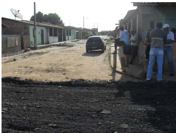
Foto 15: Área Crítica 8 – Rua da Palmeira – Bairro Carro Quebrado – área de enxurrada.
