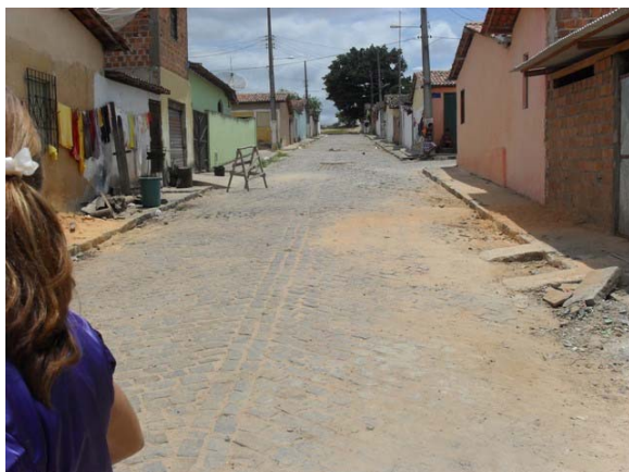
Foto 5: Av. Iderbal Gomes de Cerqueira – poço de visita com problemas freqüentes de entupimento.
