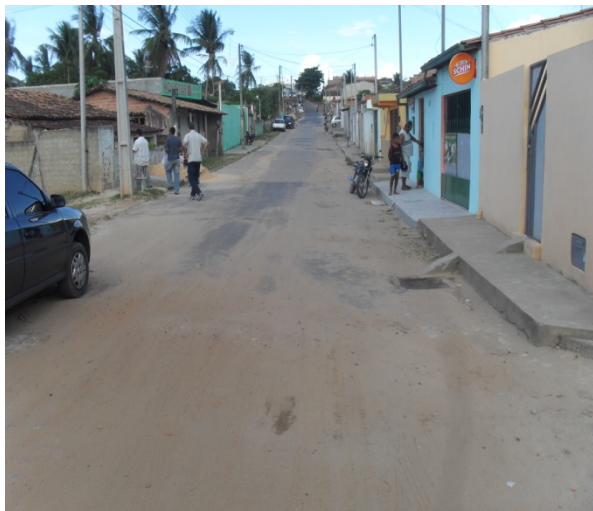
Foto 19: Rua Areia Branca. Área crítica por conta da ocorrência de alagamento. Área crítica 4.
