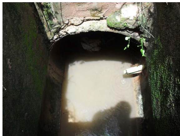
Foto 2: Canalização do Riacho Cantobá – tubo de concreto DN 1.000 mm com mais ou menos 320 m – caixas e caminhamento tem muitas ligações de esgoto clandestinas.
