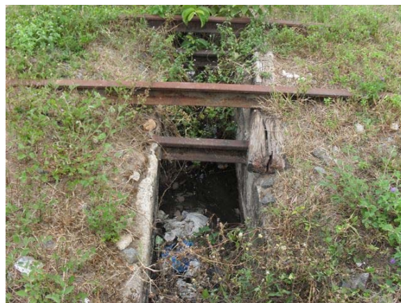
Foto 14: Ponto de lançamento de drenagem com esgoto primário e secundário – tubo de concreto DN 300 mm – galeria da linha férrea (0,50 x 0,30 m) – muito lixo e tubulação danificada que vai até a represa do Rio Aramari.
