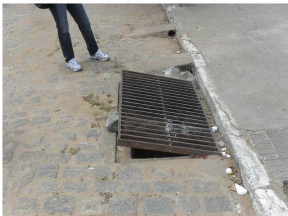
Foto 1: Rua José Inácio – caixa de drenagem (2 unidades).
