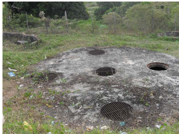
Foto 8: Bairro Beira Rio – estrutura de DAFA abandonada – nunca funcionou – tem cerca de 10 anos e foi implantada pela Urbis durante a implantação do conjunto habitacional.
