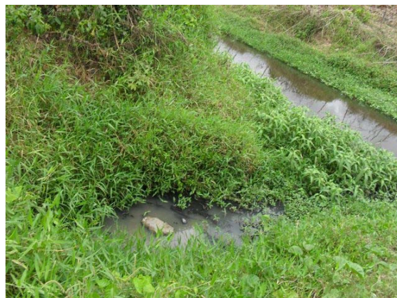
Foto 2: Ponto de lançamento de esgoto e drenagem – galeria atravessa as 2 pistas e a ferrovia em tubo de concreto DN 1000 mm – lança no Rio Catu – forte mau cheiro.
