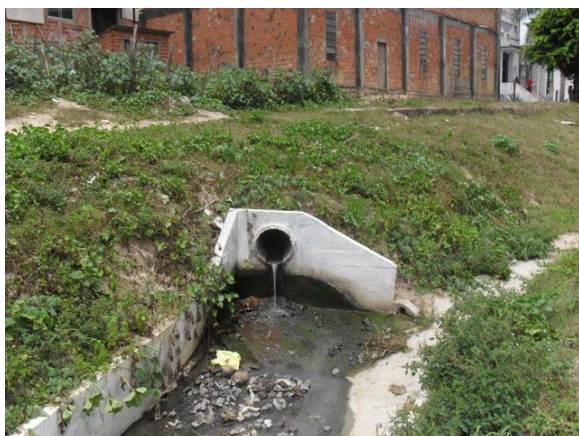
Foto 9: Ponto de lançamento de drenagem e esgoto – tubo de concreto DN 300 mm – lança em caixa e galeria de travessia da linha férrea e escoar para terreno até o Rio Aramari (drenagem com presença de esgoto primário).
