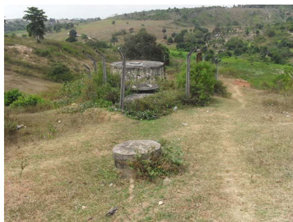
Foto 20: Bairro Bom Viver – baixa da Guia – sistema separador e DAFA inoperante, funciona como passagem – chega rede PVC DN 150 mm no DAFA e sai DN 150 mm.
