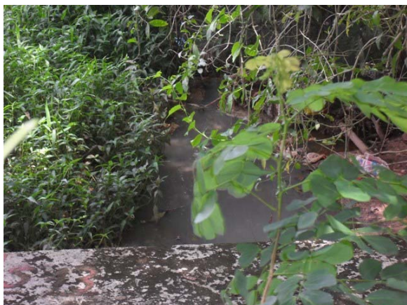
Foto 1: Conjunto Habitacional José Coelho - ponto de lançamento final de macrodrenagem – Tubo de concreto DN 1.000 com 117 m de extensão – sua canalização é para o Riacho Romã e possui ligações clandestinas de esgotos.
