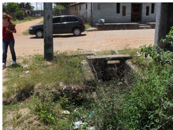
Foto 10: Continuação da vala citada na foto 9 após passar pelo fundo de quintais – direciona para o rio. Muito mato, lixo e odores – Ponto de lançamento da Rua Tio Pacheco com a Rua Padre Luiz Palmeiras.
