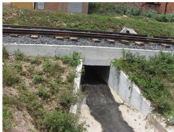
Foto 2: Ponto de lançamento de esgoto primário e secundário e drenagem - tubo de concreto de DN 300 mm – lança em caixa e galeria de travessia da linha férrea e escoamento para terreno em direção ao Rio Aramari.
