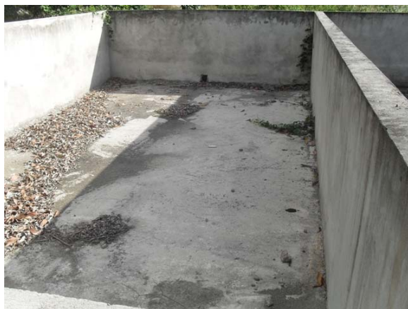
Foto 18: ETE Petrolar – leito de secagem novo (não está em operação).
