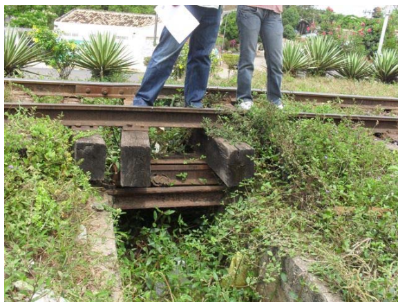
Foto 18: Ponto de lançamento de drenagem com tubo de concreto de DN 300 mm e lançamento de esgoto com tubo de concreto de DN 300 mm – galeria atravessa a linha férrea – não dá visão para a saída, mas o lançamento escoar para a represa do Rio Aramari.
