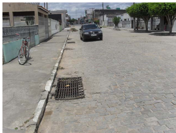
Foto 4: Caixa de drenagem.
