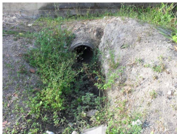
Foto 22: Ponto de lançamento de drenagem – tubo de concreto DN 600 mm – lançamento em terreno particular.
