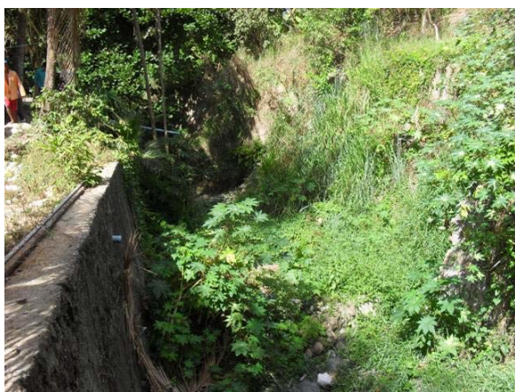
Foto 15: Rua da Baixinha com Rua da Bica – continuação da saída de drenagem – e tubos de concreto DN 600 mm – vista do Canal a céu aberto – trecho da contenção dos taludes destruída pela força das águas.
