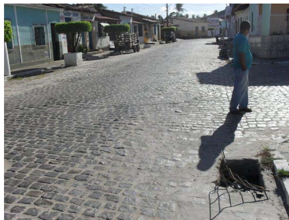
Foto 10: Rua Helena de Castro – drenagem está entupida e danificada, provocando alagamento da área.
