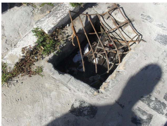
Foto 11: Rua Helena de Castro – drenagem está entupida e danificada, provocando alagamento da área.
