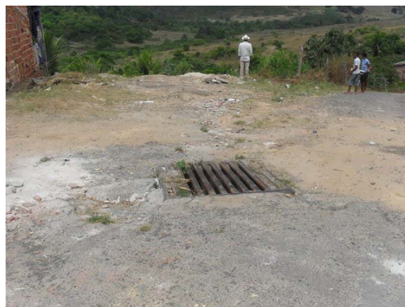
Foto 18: Bairro Pioneiro – escoamento dos esgotos através da Rua dos Nús – saída em tubo de concreto DN 800 mm em área particular – escoamento para o Riacho Rio Branco e daí para o Rio Una – caminhamento e saída para Canal a céu aberto provocando grande erosão.
