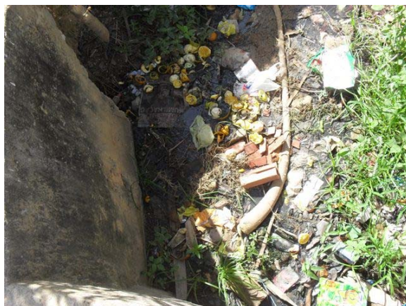
Foto 4: Área crítica 2 – Rua da Bica – área de enxurrada e lançamento de esgotos – situação gravíssima.
