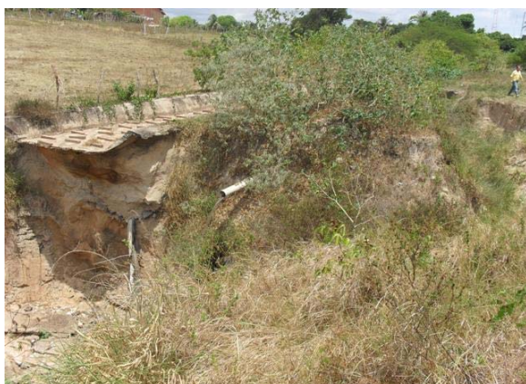
Foto 3: Lançamento de esgoto com tubo PVC DN 150 mm – sai do DAFA e lança no trecho erodido no mesmo ponto de lançamento das águas pluviais provocando o aumento da erosão – profundidade de mais de 10 m e 80 m de extensão.
