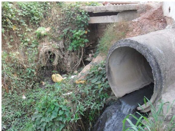
Foto 11: Rua Paraná – esgoto escoando a céu aberto por vala aberta que escoam para o Riacho. Muitas cobras, ratos, muriçocas, fortes odores e grande quantidade de lixo.
