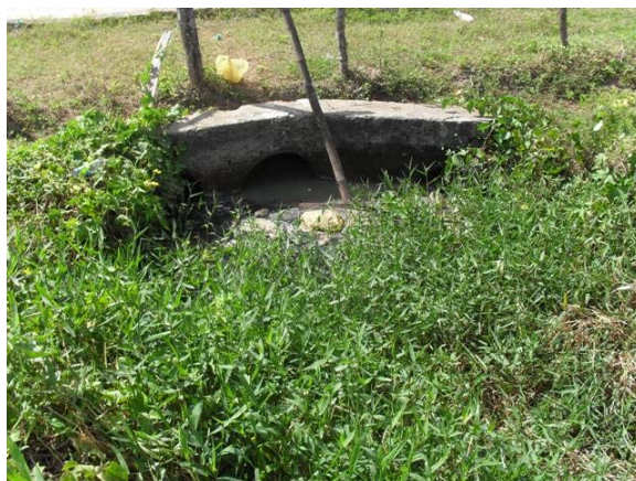
Foto 14: Rua Antonio de Carvalho – ponto de lançamento de drenagem e esgoto – tubo de concreto DN 600 mm – lança em terreno da Prefeitura e segue através de vala sem revestimento e infiltra até a Lagoa dos Patos.
