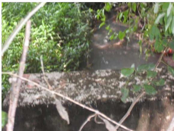
Foto 1: Conjunto Habitacional José Coelho - ponto de lançamento final de macrodrenagem – Tubo de concreto DN 1.000 mm com 117 m de extensão – sua canalização é para o Riacho Romã e possui muitas ligações clandestinas de esgotos.
