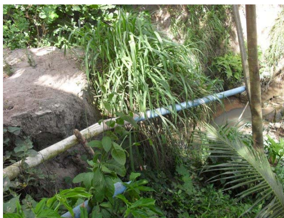
Foto 16: Rua da Baixinha com Rua da Bica – continuação da saída de drenagem – e tubos de concreto DN 600 mm – vista do Canal a céu aberto – trecho da contenção dos taludes destruída pela força das águas e tubo de descarga da EMBASA.
