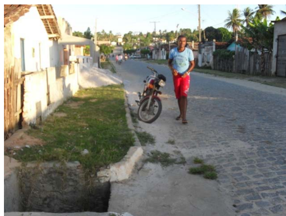
Foto 4: Área Crítica 2 – Rua Baixa da Areia – Vila do Conde – área de enxurrada – bocas de lobo abertas e feitas pelos moradores para que a saída das águas seja para além do terreno – tubo de concreto DN 500 mm.
