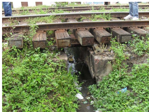
Foto 6: Ponto de lançamento de esgoto primário e secundário e drenagem – tubo de concreto DN 300 mm e galeria da linha férrea (0,50 x 0,30 m) – presença de muito lixo e tubulação que está danificada vai até a represa do Rio Aramari.
