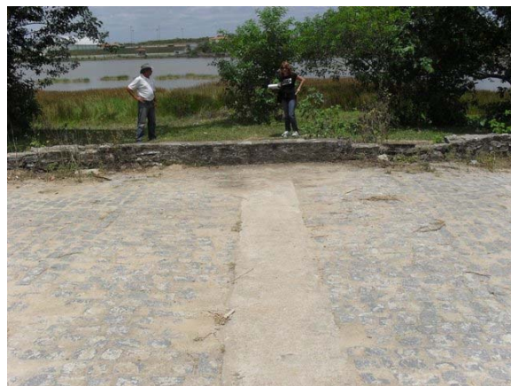
Foto 4: Ponto de lançamento final de drenagem – vem em tubo DN 400 e sai com DN 300 mm – esco para a lagoa.
