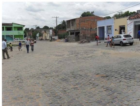
Foto 2: Área Crítica 1 – Rua Clemente Oliveira com a Rua da Trindade – área de enxurrada.
