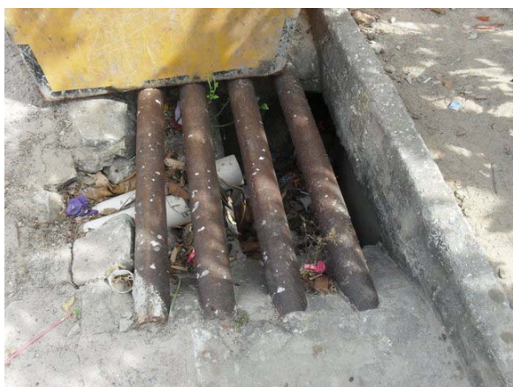
Foto 7: Ponto de lançamento de drenagem – tubo de concreto DN 300 mm – em terreno particular e segue para a nascente da Bica – mostra da última caixa com filete de água servida.
