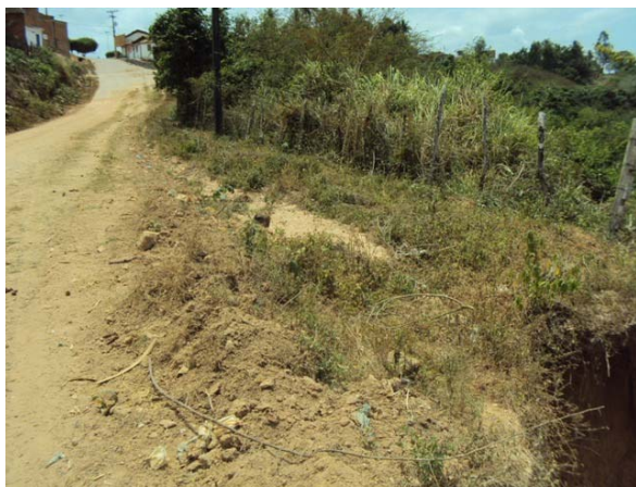
Foto 5: Ponto de lançamento de esgoto secundário e drenagem – tubo de concreto DN 600 mm – lança em terreno com muito lixo e vala natural decorrente da erosão (voçoroca).
