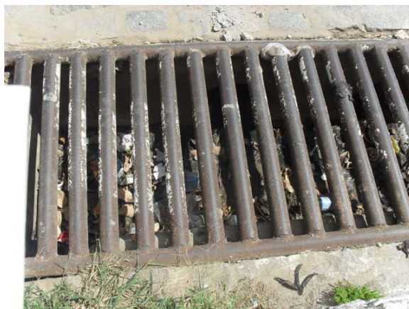
Foto 2: Área Crítica 1 – Av. Honório Borges – caixas de drenagem com muito lixo e escoamento de esgoto.
