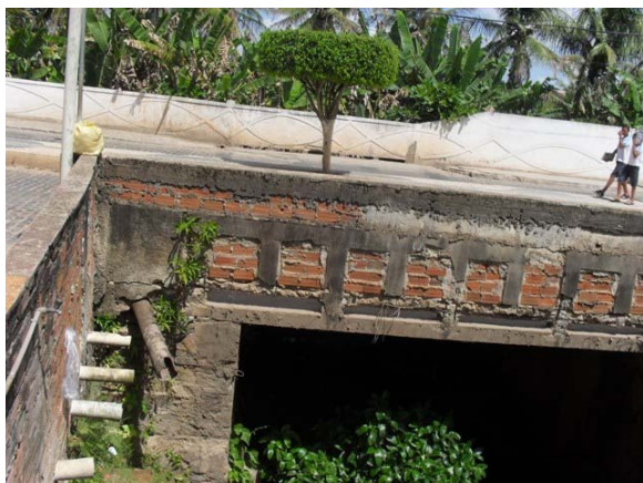
Foto 3: Riacho da Fonte Branca – vista da Rua Ladislau Azevedo – mostra lançamento de esgoto difuso e pontual – leito do riacho e pontilhão.
