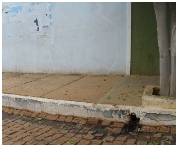
Foto 2: Residência lançando esgoto secundário diretamente na Avenida Cleriston Andrade.
