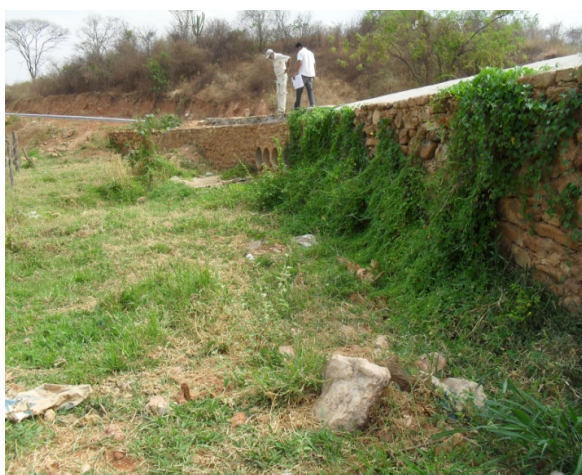
Foto 20: Bueiros de travessia do Riacho Boqueirão que se encontra com os demais riachos existentes após cruzar a Rua 2 de Julho.
