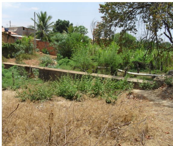
Foto 2: Chegada do outro coletor principal de esgoto existente. Tubulação de PVC de 300 mm de diâmetro.
