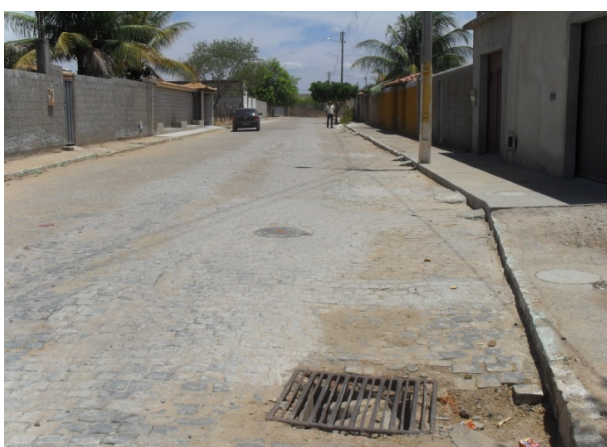
Foto 9: Rua Nelson de Castro. Rede de microdrenagem com problema de obstrução nas caixas coletoras.
