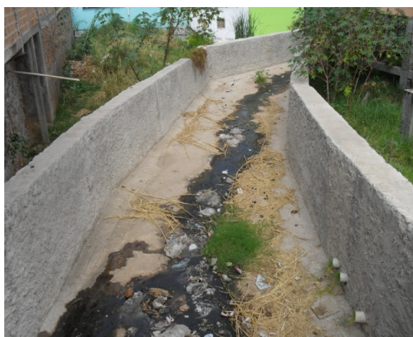
Foto 19: Riacho Boqueirão. Trecho em aberto do canal de macrodrenagem que passa por dentro de terrenos particulares - recentemente canalizado.
