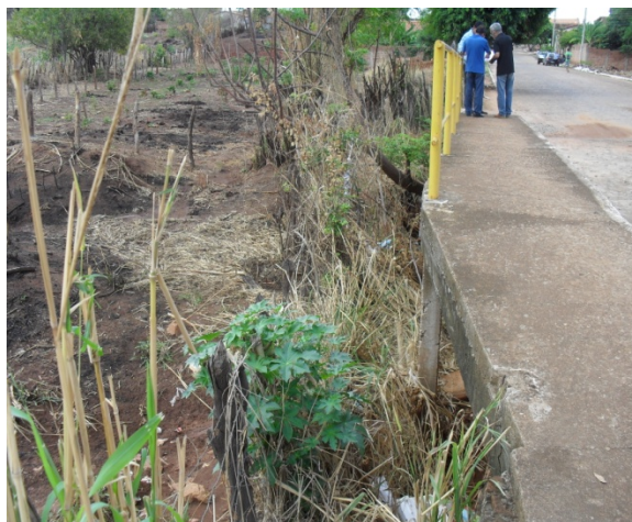
Foto 4: O canal de macrodrenagem tem trecho novamente coberto no cruzamento com a Rua João de Brito Leite.
