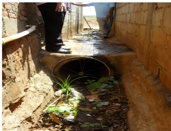
Foto 4: Trecho de galeria implantado pela prefeitura para coletar a água pluvial e evitar alagamento na proximidade do bueiro da BA-156.
