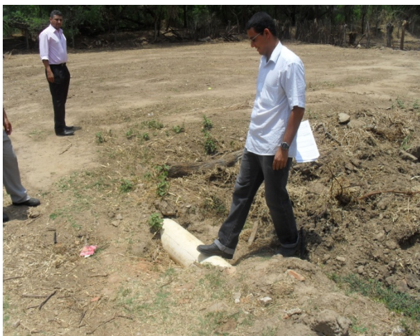
Foto 1: Chegada de um dos coletores principais de esgoto na Estação de Tratamento de Esgoto. Tubulação de PVC de 250 mm de diâmetro.
