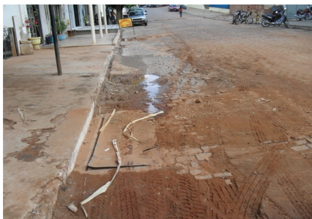
Foto 7: Rua Oliveira dos Brejinhos. Caixa coletora de águas pluviais conectada ao canal enterrado construído pela antiga mineradora e tampada com papelão.
