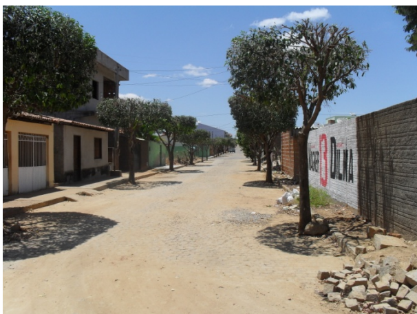
Foto 3: Área Crítica 1 - vista da Rua Henrique Cruzes no cruzamento com a Rua Deputado Henrique Brito. Área sujeita a erosão no pavimento.
