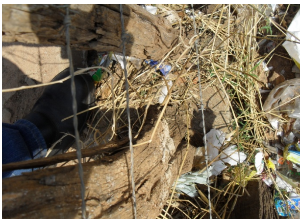
Foto 11: Área Crítica 1 - tubulação de concreto de 200 mm de diâmetro que favorece a drenagem das águas pluviais de um lado para o outro na Rua da Usina. Entrada completamente obstruída por causa do lixo.
