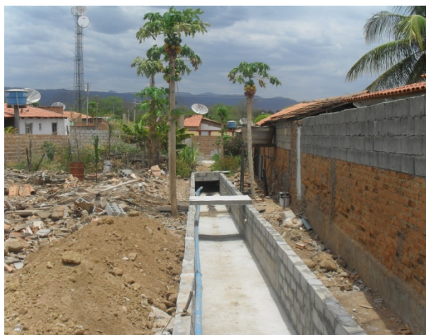
Foto 7: Trecho aberto do canal misto de macrodrenagem que passa por dentro de um lote residencial reconstruído recentemente por causa das últimas chuvas fortes.
