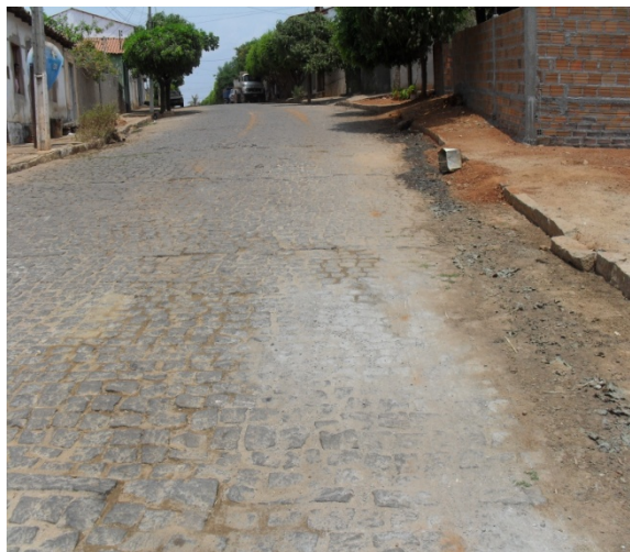
Foto 2: Área Crítica 2 - vista de outro ângulo da Rua Quincas Cruz.
