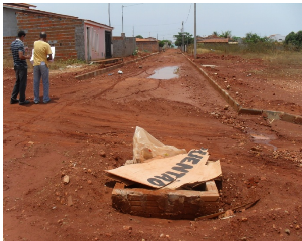
Foto 1: Rua com rede de microdrenagem implantada graças a um recurso federal que também contempla a pavimentação. Poço de visita ainda está sem a tampa.
