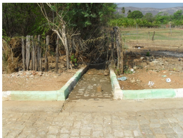
Foto 10: Área Crítica 1 - passagem tipo canaleta que facilita o escoamento superficial das águas da Rua da Usina.
