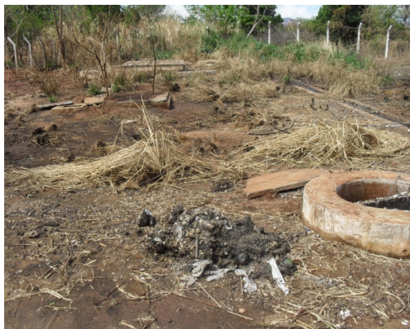
Foto 1: Visão geral da Estação de Tratamento de Esgotos. Unidades de concreto em mau estado de conservação.
