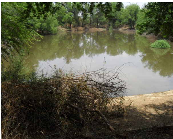
Foto 3: Unidade de tratamento. Lagoa Facultativa operando quase que no limite máximo. Período de chuva funciona como se fosse uma caixa de passagem.
