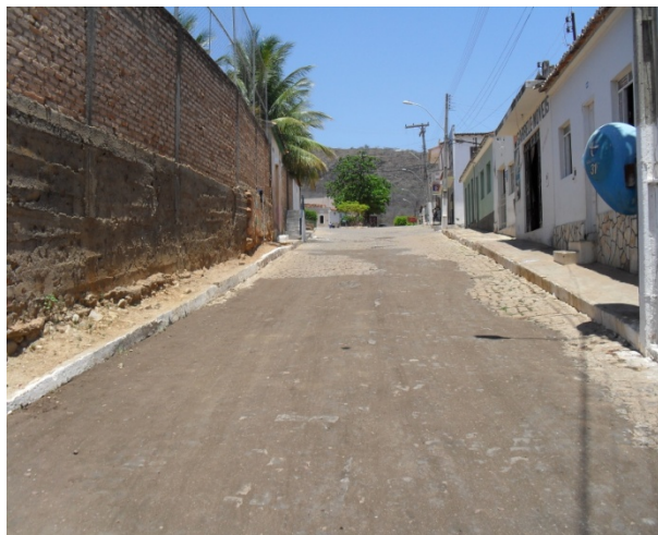
Foto 1: Área Crítica 3 - trecho final da Avenida Paramirim. Área crítica por conta da ocorrência de processo erosivo na pavimentação.
