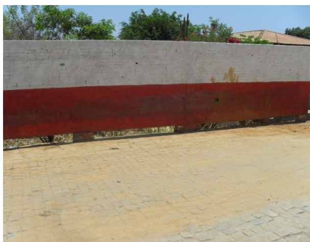
Foto 3: Muro em frente a Secretária Municipal de Saúde. As águas pluviais oriundas de outras ruas são condicionadas a passar por debaixo do muro.
