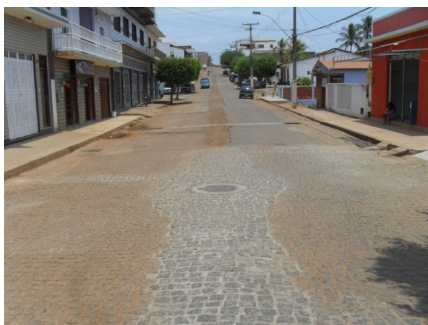
Foto 3: Área Crítica 1 - Avenida Botuporã. Área crítica por conta da ocorrência de alagamento causado pelas chuvas de enxurrada.
