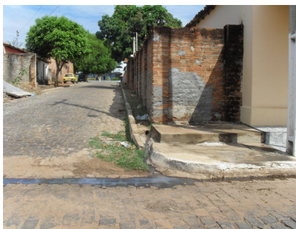
Foto 4: Esgoto secundário a céu aberto
