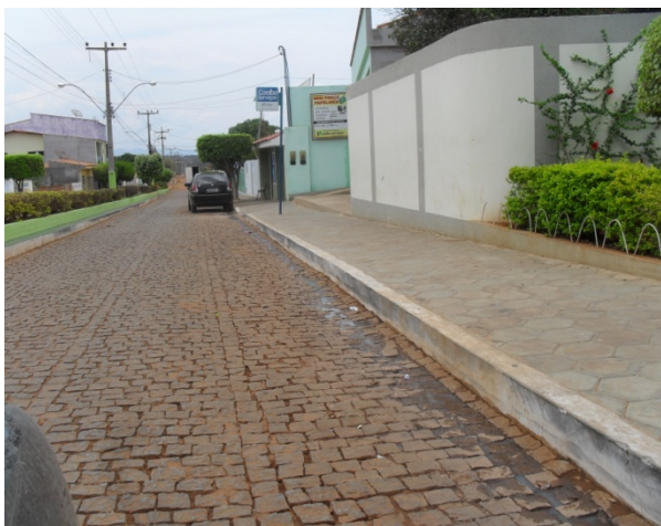
Foto 1: Avenida Cleriston Andrade. Esgoto secundário escoando a céu aberto pela sarjeta.
