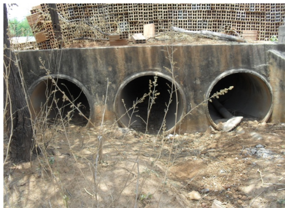
Foto 6: Travessia em bueiro tripla de tubulação em concreto de 1000 mm de diâmetro que favorece o escoamento natural das águas de uma área aberta até o riacho situado do outro lado da Avenida José Carlos Marques.
