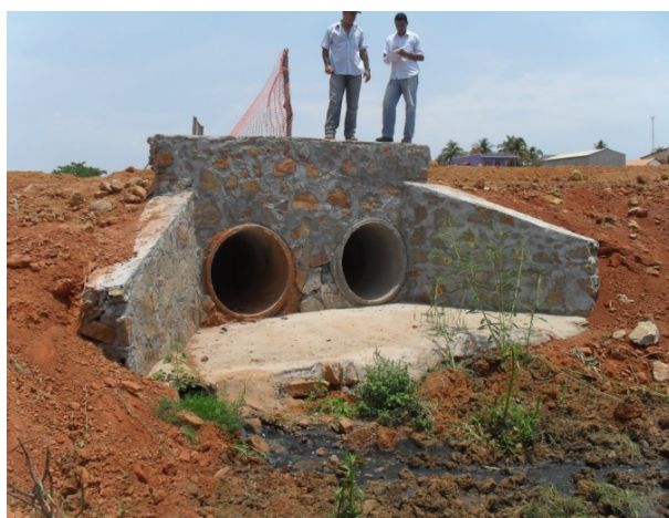
Foto 4: Ponto de lançamento de esgoto sanitário na Lagoa de Paramirim.
