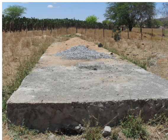
Foto 2: Unidade de tratamento do sistema de esgotamento sanitário existente, tipo filtro anaeróbico.
