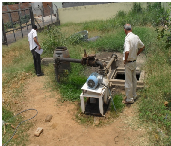
Foto 2: Equipamento da estação elevatória completamente exposto à ação do tempo, em contínuo funcionamento e sem equipamento reserva.
