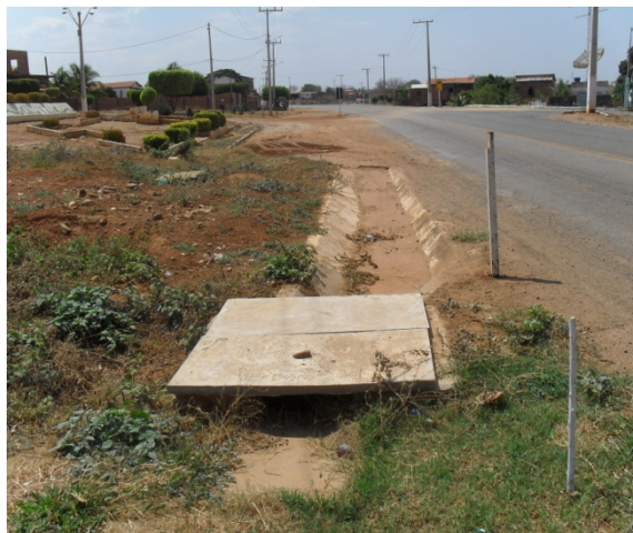
Foto 2: Valeta seguida de uma caixa coletora que capta as águas pluviais da região da rodoviária e as escoam por uma galeria subterrânea por de baixo da BA-156.
