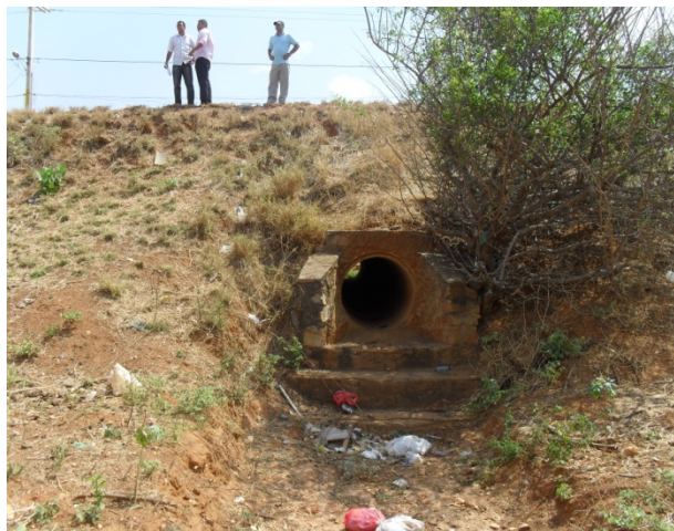
Foto 1: Bueiro de travessia que favorece o escoamento das águas pluviais de um lado para o outro da BA-156. Tubulação de concreto de 1000 mm de diâmetro.
