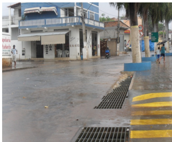
Foto 2: Área Crítica 1 - Avenida Flores da Cunha. Área crítica por conta da ocorrência de alagamento.
