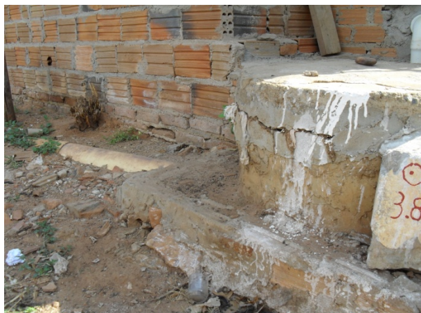
Foto 5: Poço de visita fissurado. Evidência de problema de sobrecarga na rede principalmente na época de chuva
