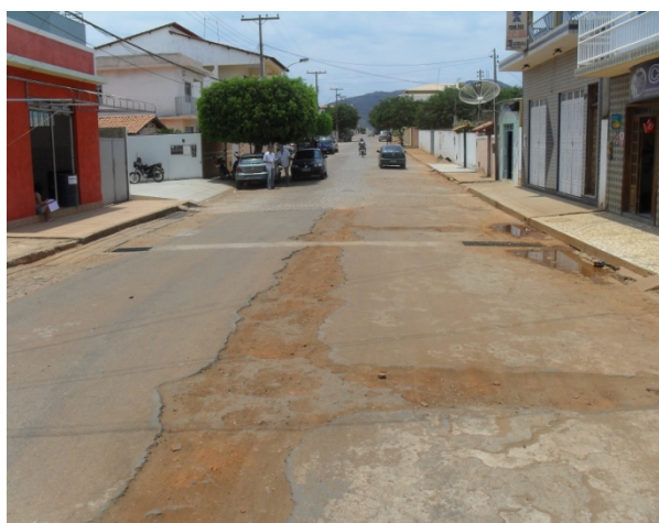
Foto 4: Área Crítica 1 - vista de outro ângulo da Avenida Botuporã.
