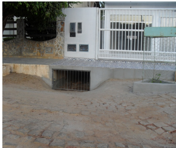
Foto 6: Avenida Nelson Caíres de Brito. Passagem de água por debaixo das casas.
