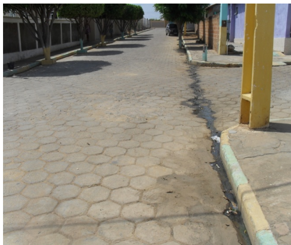
Foto 2: Rua Manoel Cândido Almeida. Esgoto secundário a céu aberto.
