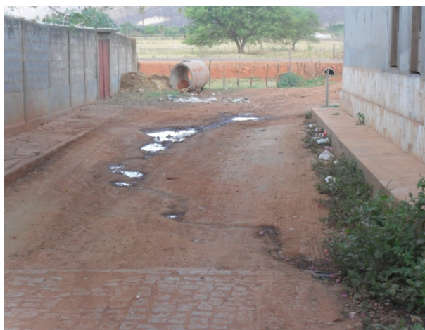
Foto 10: Esgoto a céu aberto numa rua próxima a Praça Santo Antônio.
