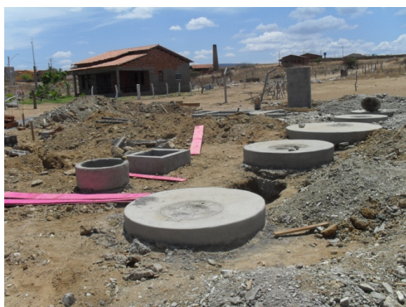
Foto 6: Visão de outro ângulo das estruturas pertencentes a EEE do novo SES.
