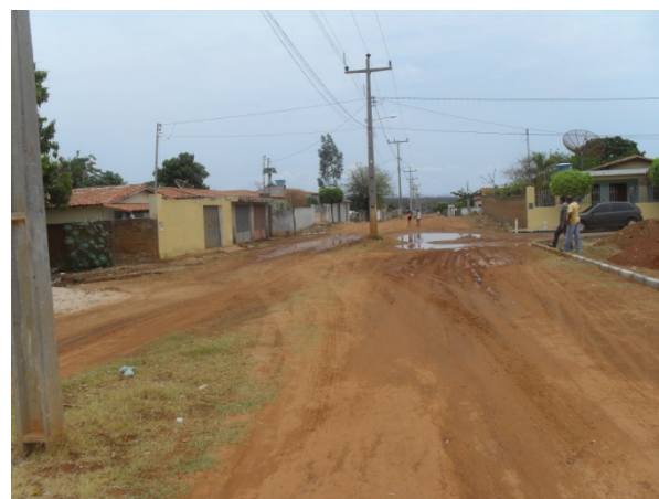
Foto 4: Avenida Cleriston Andrade. Obras locais interferem no escoamento natural das águas superficiais e provocam o surgimento de poças.
