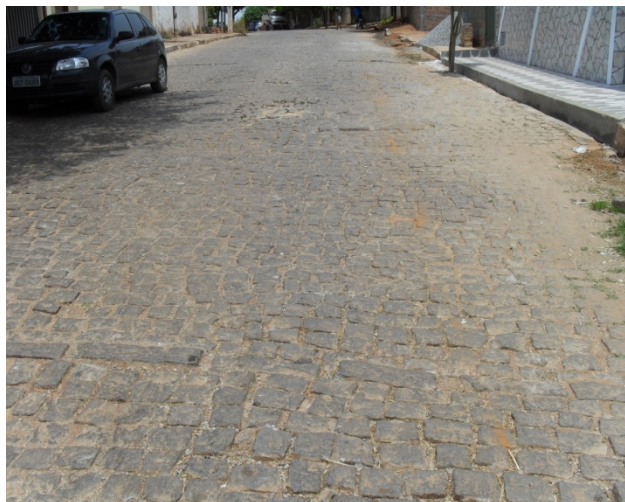
Foto 1: Área Crítica 2 - Rua Quincas Cruz. Área crítica por conta da ocorrência de processo erosivo na pavimentação.
