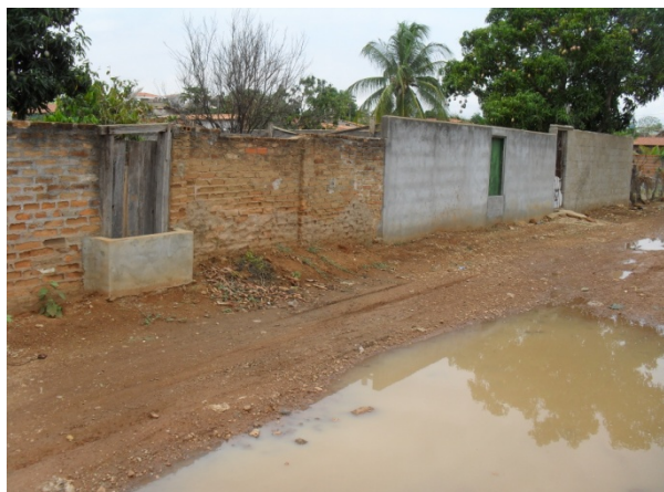
Foto 5: Área Crítica 1 - rua sem denominação vizinha a propriedade de José de Souza Pereira. Área crítica por conta da ocorrência de alagamento.
