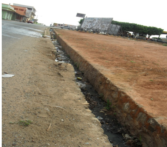
Foto 2: Valeta nas proximidades do posto de gasolina na entrada da cidade. Presença de lixo e esgoto secundário.
