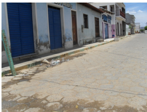
Foto 4: Avenida Dr. Aurélio Rocha. Um dos locais onde o esgoto corre a céu aberto na cidade.
