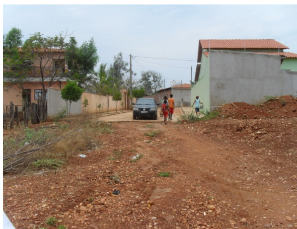
Foto 3: Área Crítica 2 - Rua Rosalvo Manoel Messias. Área marcada por ocorrência constante de processo erosivo.
