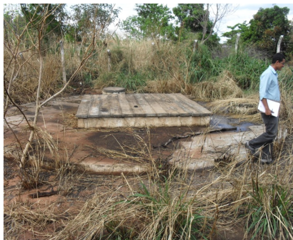
Foto 2: DAFA da Estação de Tratamento com estrutura bastante degradada devido à falta de manutenção.
