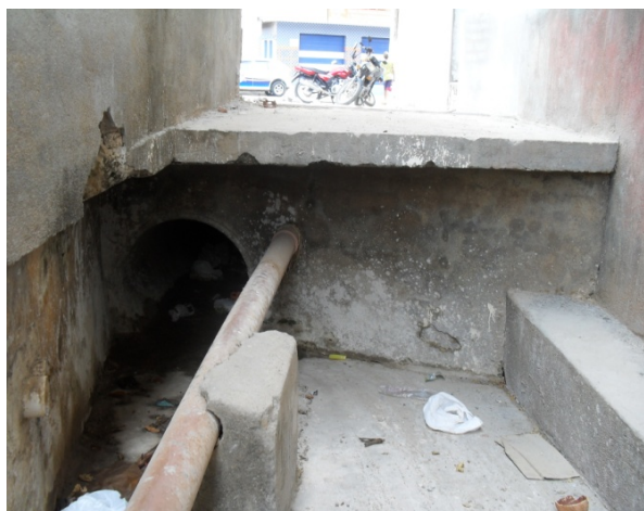
Foto 1: Avenida Flores da Cunha. Mudança de seção do canal de macrodrenagem - interfere no fluxo natural das águas pluviais e favorece a ocorrência de alagamento na região.
