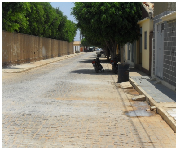
Foto 2: Avenida dos Pimentas. Esgoto secundário a céu aberto. Rede de esgotamento e ligações domiciliares do novo sistema de esgotamento sanitário já foram finalizadas.
