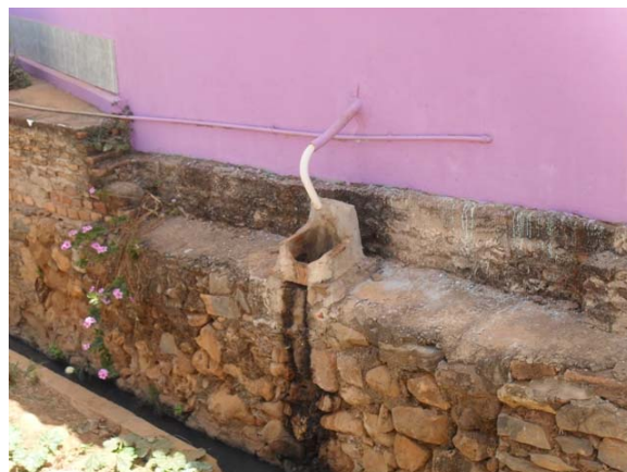
Foto 8: Lançamento de esgoto secundário direto em canaleta na rua.
