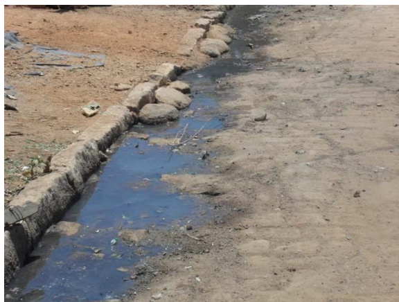
Foto 2: Rua Sete de Setembro – esgoto secundário lançado a céu aberto.
