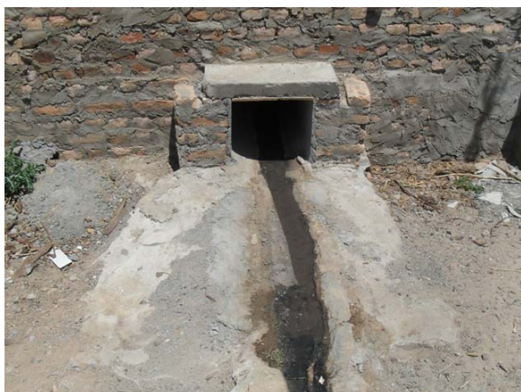
Foto 5: Esgoto a céu aberto – Rua Coronel Antônio Rodrigues Viana.
