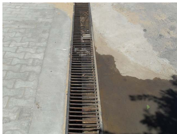
Foto 2: Calha com grelha – Rua Coronel Antônio Viana.
