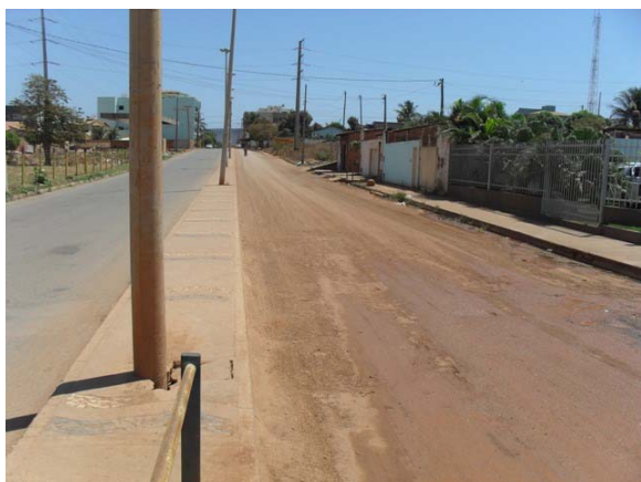
Foto 33: Área Crítica 5 – área de alagamento - Bairro Aratu - Rua Ruy Barbosa.
