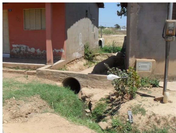
Foto 43: Área Crítica 8 – área de alagamento - Bairro Boa Sorte - Rua F.
