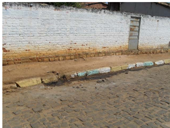
Foto 2: Lançamento de esgoto a céu aberto – Travessa Major Claro.
