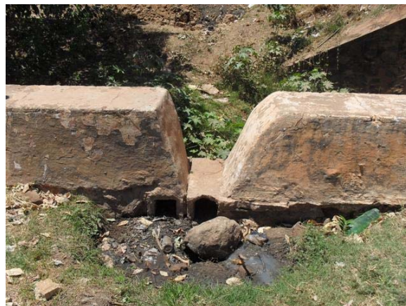
Foto 2: Ponto de lançamento de esgoto no Riacho Redenção.
