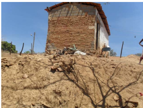
Foto 9: Área de erosão.
