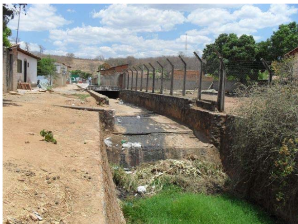
Foto 1: Rua do Canal – Canal recebendo contribuição direta de esgoto.
