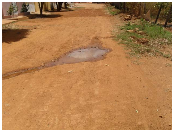
Foto 2: Rua Presidente Tancredo Neves – ponto de lançamento de esgoto a céu aberto.
