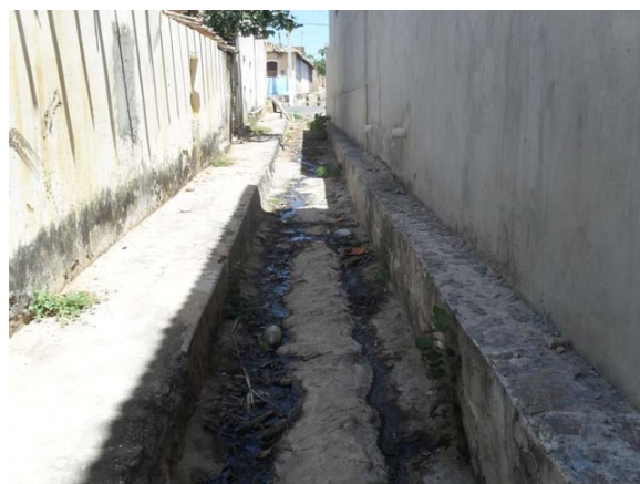
Foto 4: Esgoto a céu aberto – Rua Coronel Antônio Rodrigues Viana.
