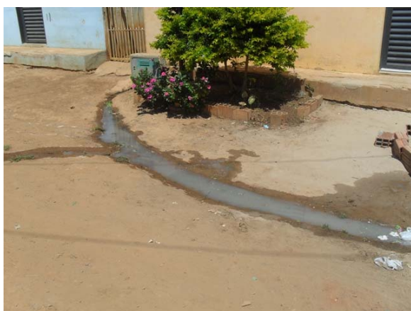
Foto 9: Esgoto a céu aberto – Casas Populares.
