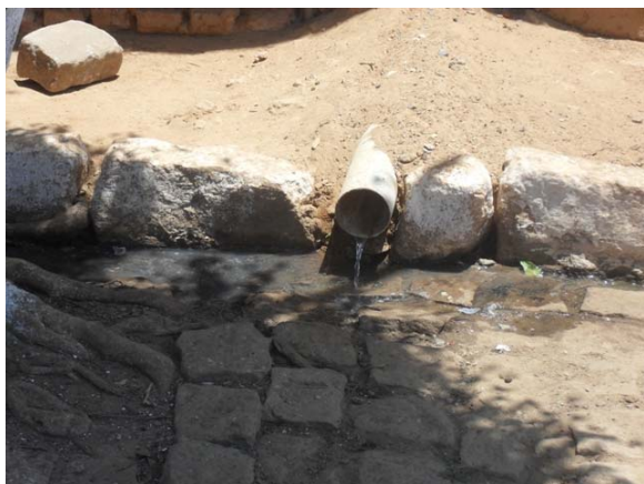
Foto 1: Rua Sete de Setembro – lançamento de esgoto secundário no leito da rua .
