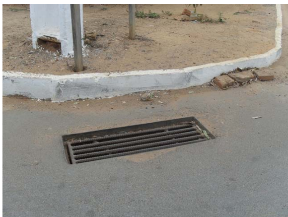
Foto 13: Área Crítica 2 – Loteamento JK.
