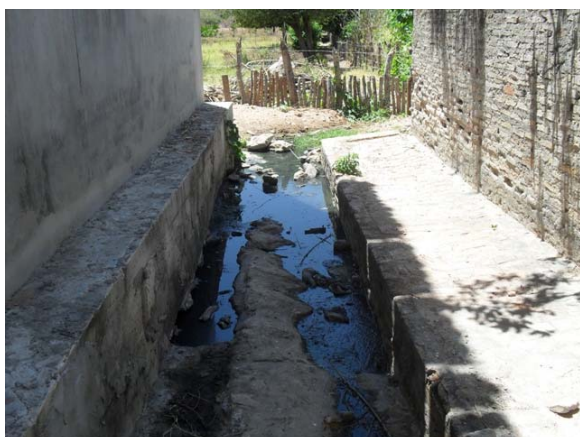
Foto 3: Esgoto a céu aberto – Rua Coronel Antônio Rodrigues Viana.
