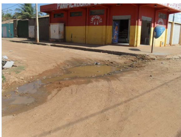
Foto 27: Área Crítica 1 – local de alagamento - Bairro Vila Rica - próximo a BR-020.
