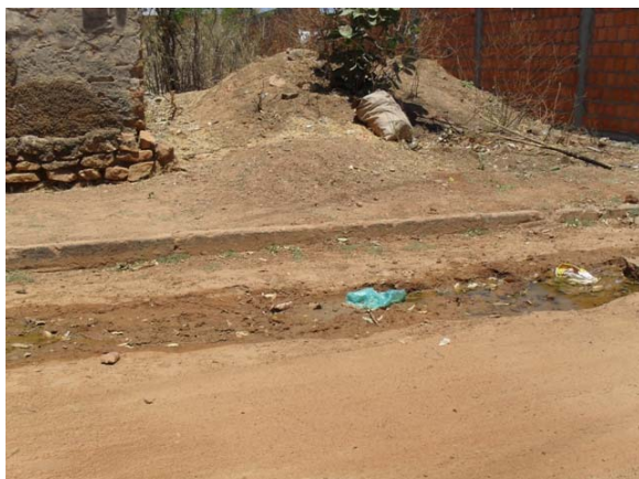
Foto 1: Esgoto secundário lançado a céu aberto na Rua Manoel Remigio.
