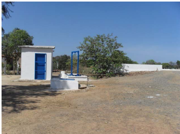
Foto 13: ETE Ribeirão – Estação Elevatória dentro da área da ETE.
