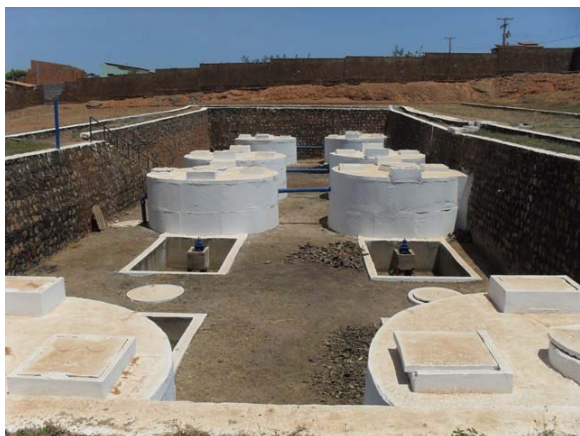
Foto 7: ETE Barreiras 1 – DAFAs.
