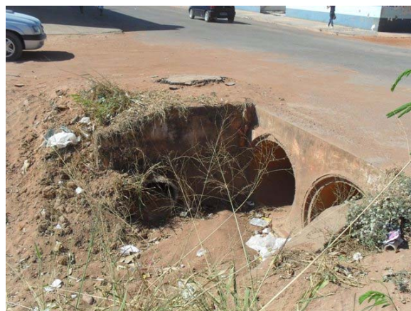
Foto 8: Área Crítica 3 – área de alagamento entre a Rua Senhor do Bonfim e a Rua Paraíba, com detalhe para bueiro duplo.
