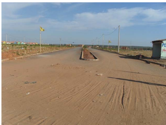
Foto 3: Área Crítica 1 – área de enxurrada entre a Rua Itabuna e a Rua Seabra.
