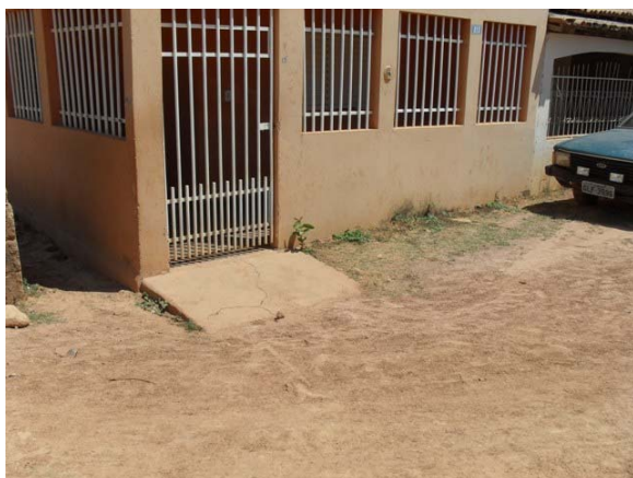
Foto 42: Área Crítica 7 – área de alagamento - Bairro Morada da Lua - Rua Inhazinha Pamplona com a Rua Ulisses Guimarães.
