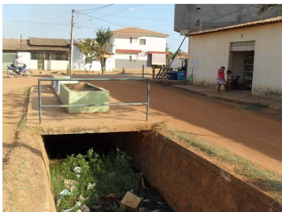
Foto 17: Canal Vila Brasil, carente de limpeza.
