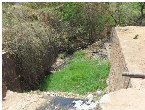
Foto 2: Rua do Canal – final da parte de alvenaria do Canal – presença de esgoto, lixo e vegetação.
