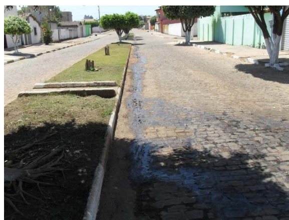
Foto 6: Esgoto a céu aberto – Casas Populares.
