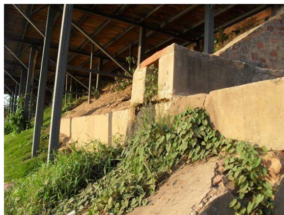
Foto 6: Estação Elevatória - Ribeirão.
