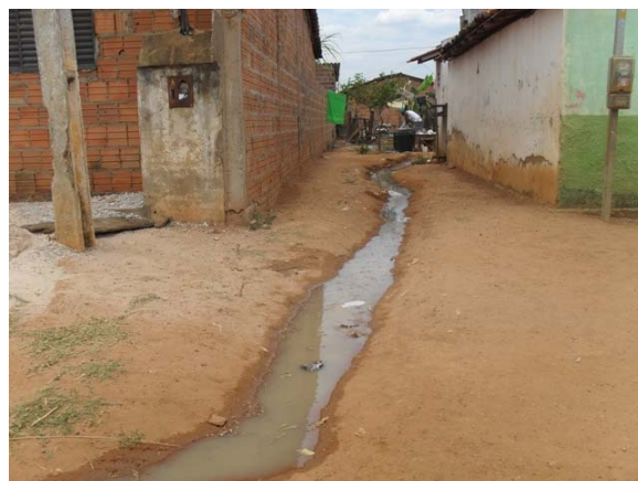
Foto 4: Área Crítica 1 – área de alagamento – Bairro Projetado.
