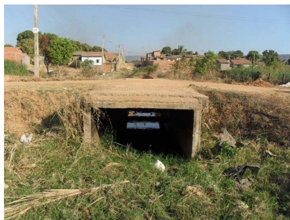
Foto 12: Canal Santa Luzia, necessitando limpeza.
