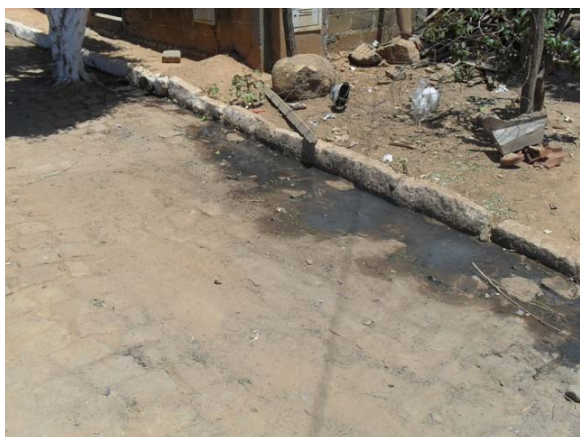
Foto 7: Rua Sete de Setembro – esgoto secundário lançado a céu aberto.
