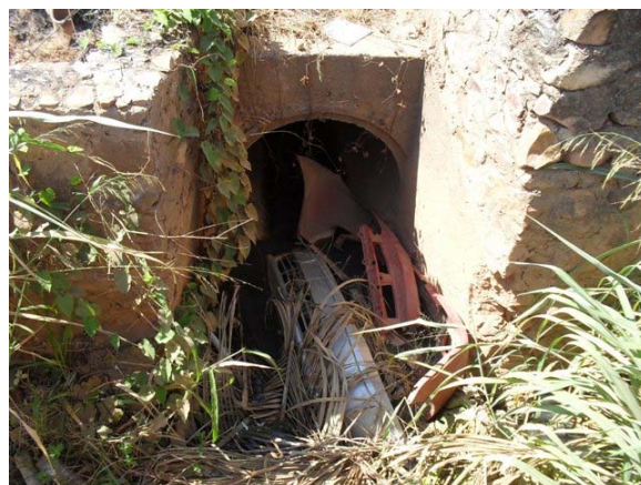
Foto 24: Canal Vila Rica, apresentando obstrução.
