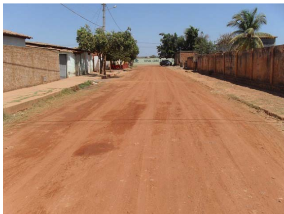
Foto 32: Área Crítica 4 – área de alagamento - Loteamento São Paulo - Rua Uberaba.
