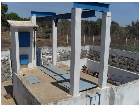
Foto 3: Estação Elevatória - Centro Histórico.
