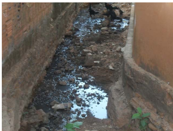
Foto 6: Rua Sete de Setembro – Canal com presença de esgoto secundário.
