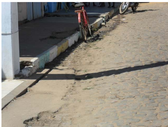
Foto 3: Lançamento de esgoto a céu aberto – Travessa Major Claro.
