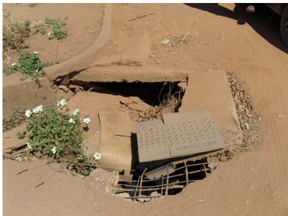
Foto 1: Canal da CODEVASF - boca de lobo com estrutura em estado precário devido a má conservação.
