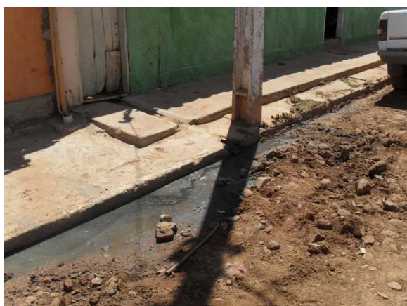
Foto 5: Esgoto secundário lançado a céu aberto na Rua Otoniel Oliveira.
