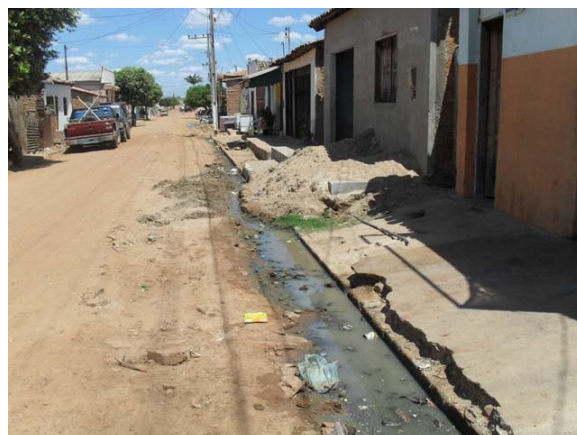
Foto 4: Esgoto secundário lançado a céu aberto na Rua Manoel Remigio – próximo do Açude Municipal.
