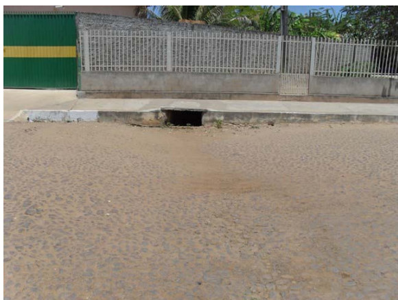
Foto 1: Área Crítica 1 – Rua 2 de Julho – área de alagamento.
