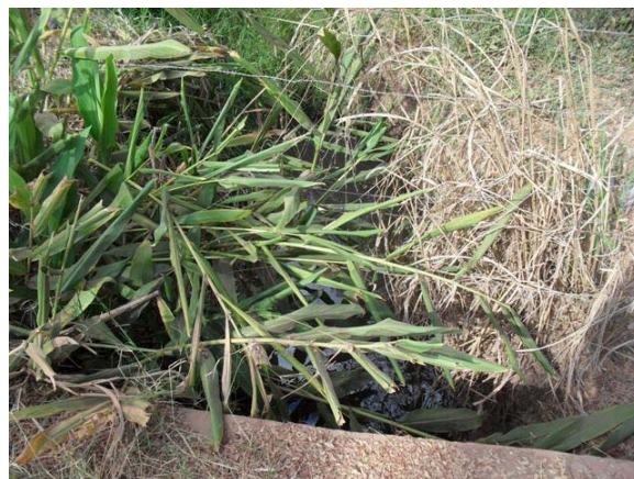
Foto 8: Rua Laudelino Reis – final do Canal – observa-se a presença de vegetação devido a falta de manutenção.
