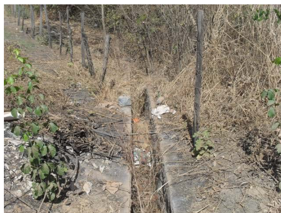
Foto 6: Canal da Morada Nobre, necessitando limpeza.
