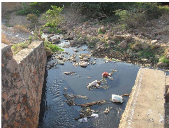
Foto 21: Canal Vila Dulce - final do canal desembocando água pluvial com contribuição de esgoto no Rio Grande.
