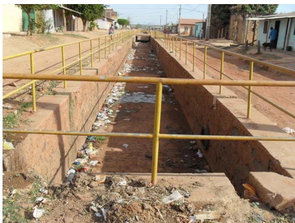
Foto 15: Rua América Dourada – início do Canal Santana – presença de lixo.
