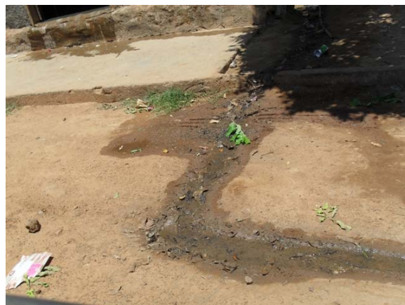
Foto 2: Esgoto secundário lançado a céu aberto na Rua Manoel Remigio.
