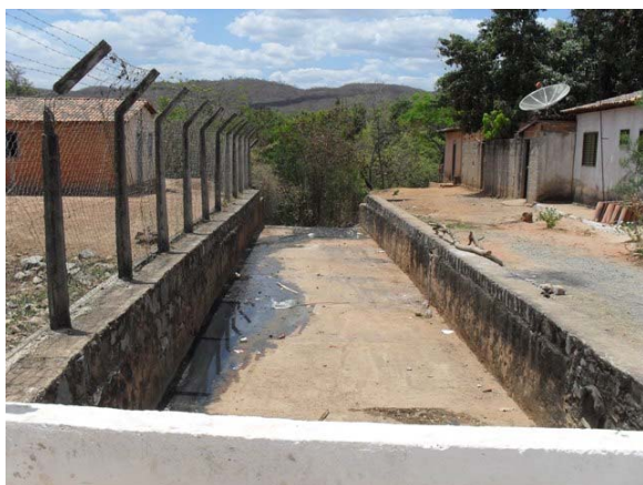
Foto 3: Rua do Canal – final da parte de alvenaria do Canal – presença de esgoto.
