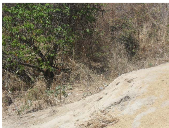
Foto 6: Área de erosão.
