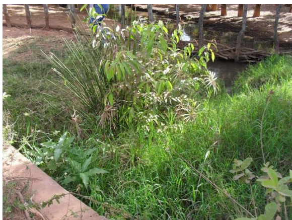
Foto 9: Rua Laudelino Reis – final do Canal – observa-se a presença de vegetação devido a falta de manutenção.
