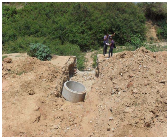
Foto 6: Ponto de lançamento de águas pluviais. Está em implantação o projeto de drenagem (rede com DN 1.000mm).
