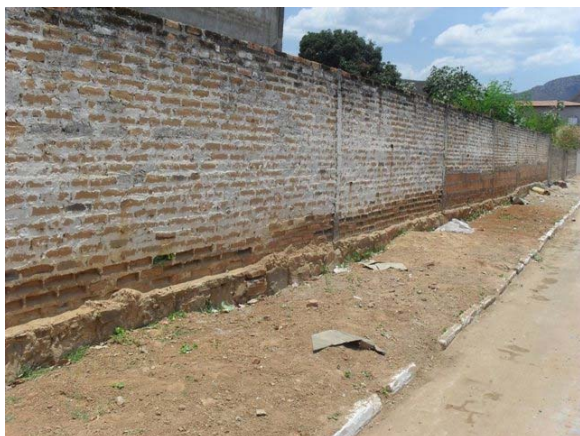
Foto 11: Área Crítica 2 – Av. das Oliveiras .
