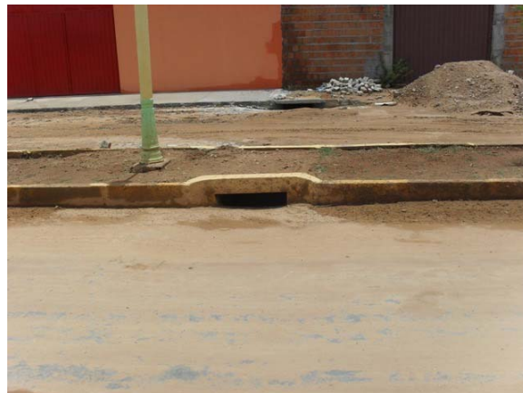
Foto 12: Área Crítica 2 – Rua João Durval Carneiro – área crítica devido enxurrada.
