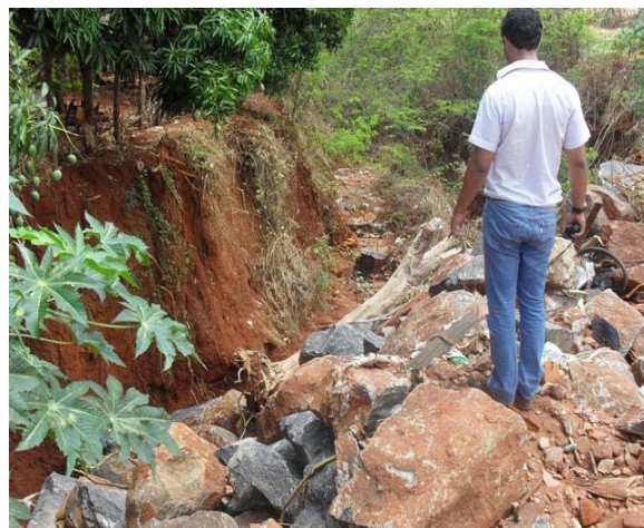
Foto 6: Área Crítica 3 – Rua Amado Magalhães – erosão.
