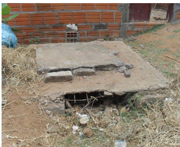
Foto 9: Caixa com abertura na guia e em péssimo estado de conservação.
