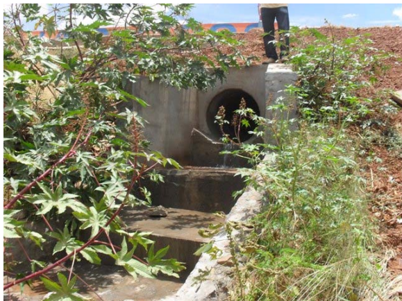
Foto 7: Av. São Sebastião Alcântara – ponto de lançamento de esgoto secundário. Não se vê exatamente o tudo, mas ele escoar para o bueiro.
