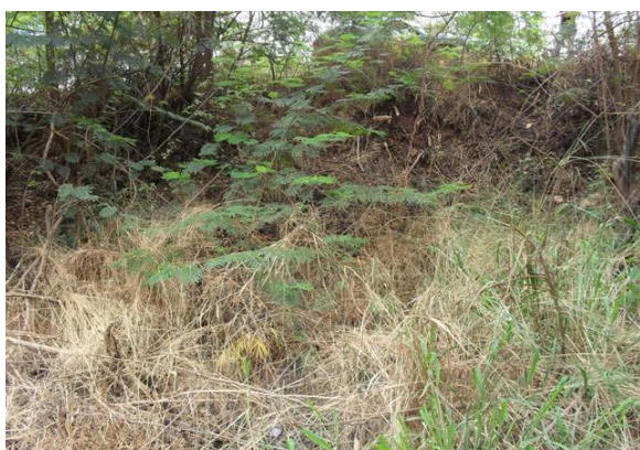
Foto 3: Ponto de lançamento de esgotos a montante do bueiro e chegada da rede na estrada que liga Ipuíara à Brotas de Macaúbas – área particular.
