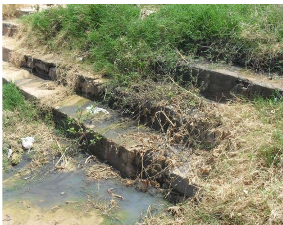
Foto 3: Esgoto lançado diretamente no Rio São Francisco.
