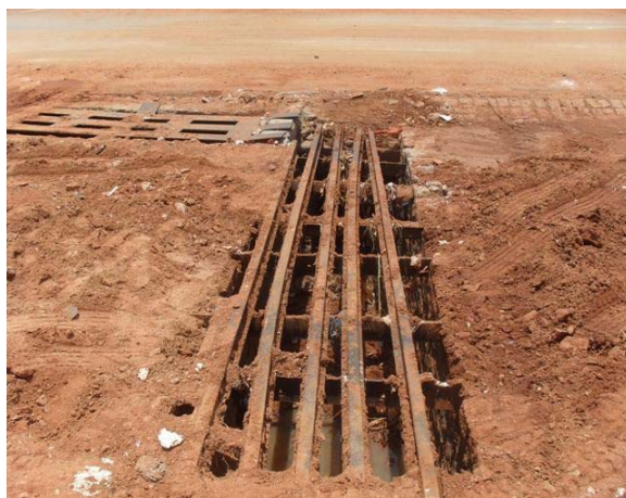
Foto 12: Av. Tiradentes – caixa coletora com grelha.
