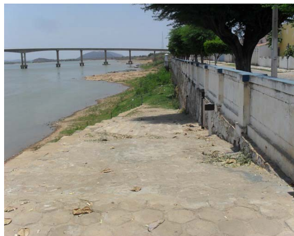
Foto 8: Pontos de lançamento de esgoto e drenagem – difuso – em todo o Cais.
