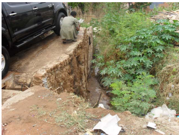
Foto 1: Ponto de lançamento de esgoto – PVC DN 200.
