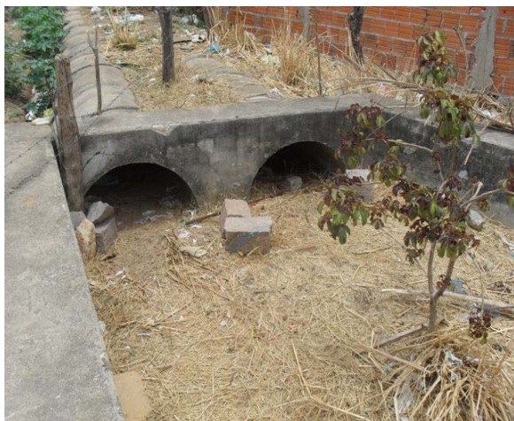
Foto 11: Ponto de saída da galeria de drenagem bastante assoreada.
