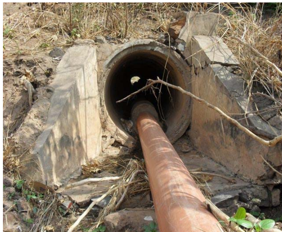
Foto 14: Bueiro que atravessa a BA-242.
