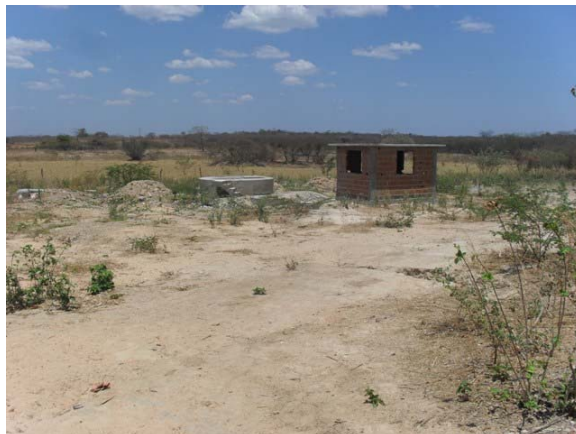
Foto 14: ETE abandonada pela empresa que estava implantando o sistema.
