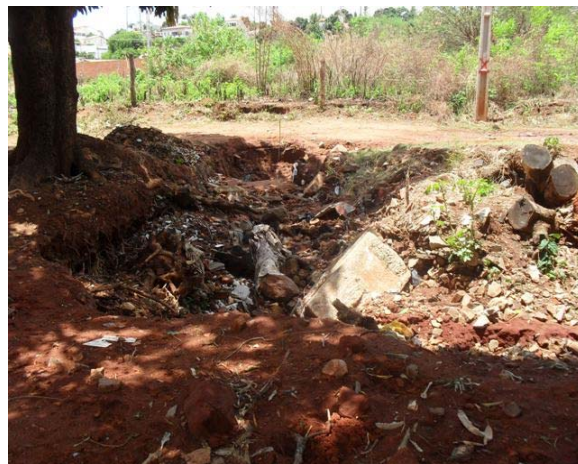
Foto 2: Área Crítica 1 – Rua São José – área de erosão.
