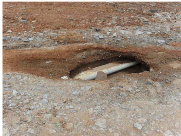
Foto 8: Ponto de lançamento de esgoto – encaminhamento da rede.
