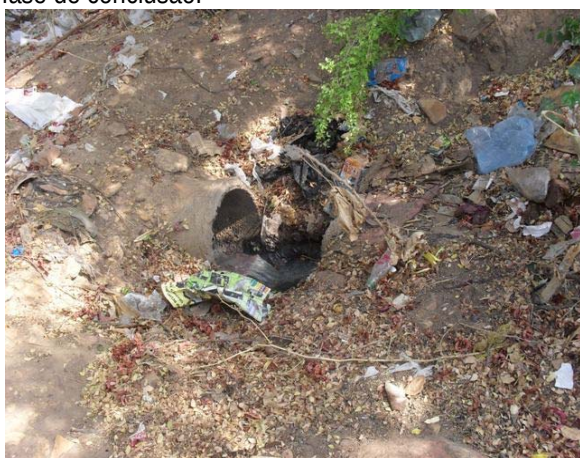
Foto 17: Ponto de lançamento de esgoto a céu aberto – tubo de concreto com DN 300 mm – escoamento para o Rio.
