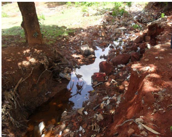
Foto 1: Área Crítica 1 – Rua São José – área de erosão.
