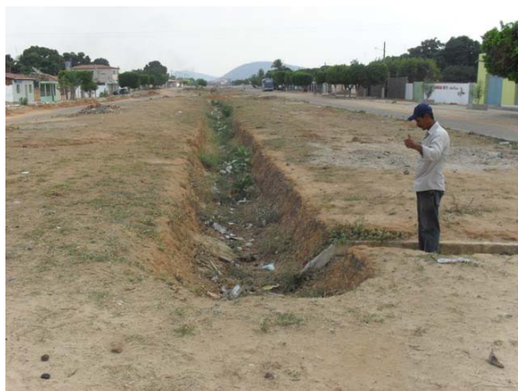
Foto 4: Canal seção mista assoreado – 50% revestido e 50% sem revestimento nas laterais.
