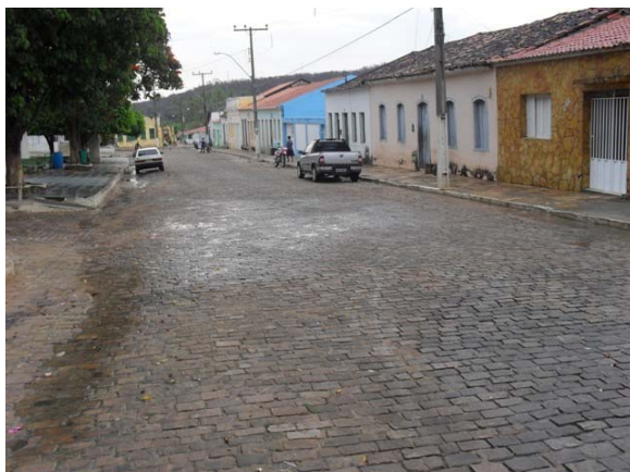
Foto 7: Área Crítica 3 – Rua Coronel José Campos (nas imediações da Praça Dr. João Borges) – ponto baixo sem dispositivo de drenagem – águas descem com velocidade sobre as testadas das casas.
