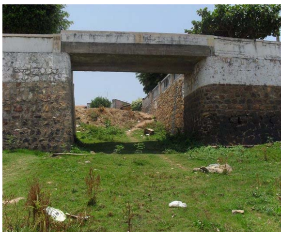
Foto 11: ponto de inundação provocada pelo rio nas maiores cheias.
