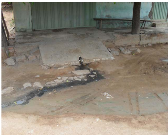
Foto 1: Esgoto lançado a céu aberto.
