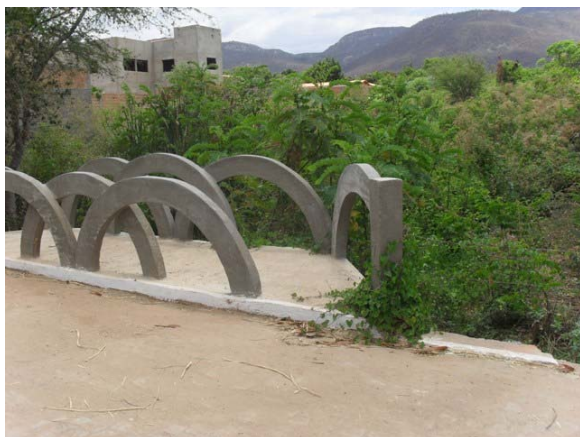
Foto 1: Ponte sobre o Riacho – muito mato e lixo – ponto de lançamento de esgoto.
