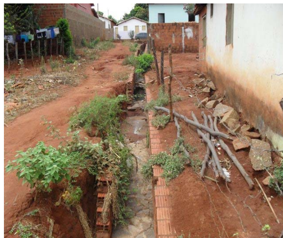
Foto 20: Valeta na Rua Amado Magalhães.
