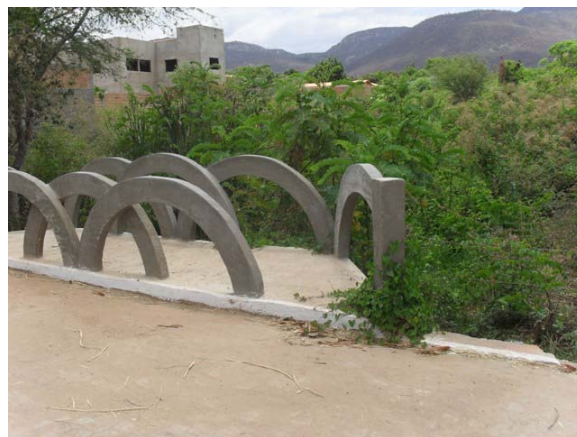
Foto 4: Ponte sobre o Riacho – presença de muito mato, lixo e esgoto.
