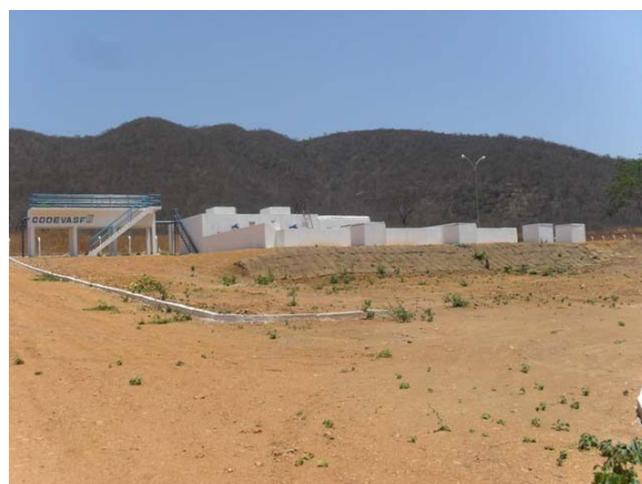
Foto 6: Estação de Tratamento de Esgoto.
