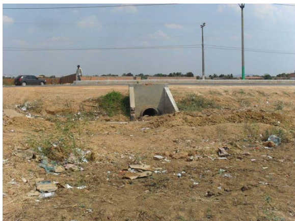
Foto 19: Área Crítica 2 - vista da boca do bueiro a montante – travessia da Avenida – área de alagamento.
