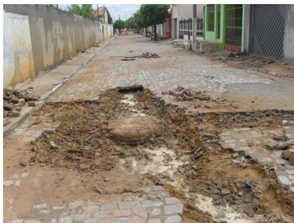
Foto 8: Área Crítica 1 – Rua Sete de Setembro e adjacentes – área crítica devido enxurrada.
