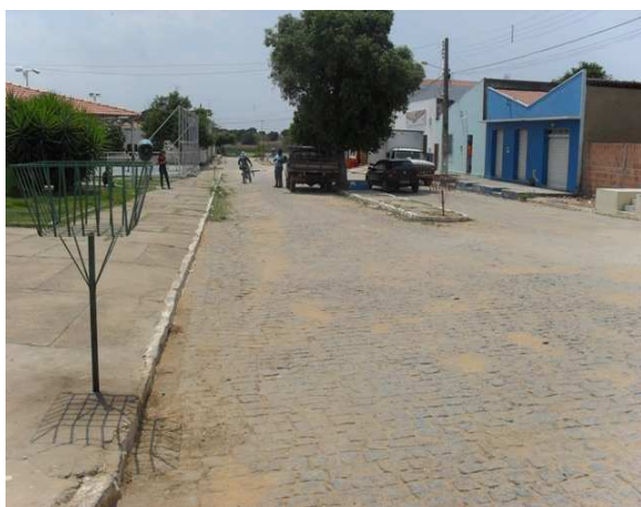
Foto 5: Jusante da drenagem – escoa para a rua lateral da Praça Luis Eduardo Magalhães.
