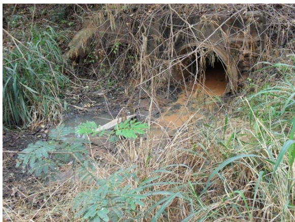
Foto 1: Ponto de lançamento de esgotos na estrada que liga Ipuíara à Brotas de Macaúbas – tubo da rede encaixa no bueiro da estrada – área particular.
