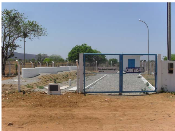
Foto 3: Estação Elevatória – Bacia B.
