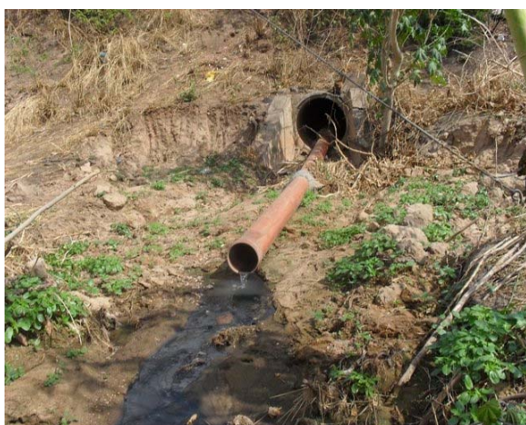
Foto 11: Ponto de lançamento de esgoto – tubo de ferro fundido DN 300 mm (água e esgoto) – escoia para a Lagoa.
