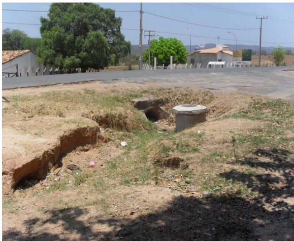
Foto 13: BA-160 – Av. Alves Martins – divisor de águas – com bueiro de DN 800 mm.
