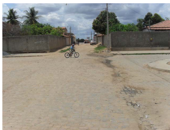
Foto 6: Travessa Barão do Rio Branco com a Rua Rui Barbosa – esgoto a céu aberto.
