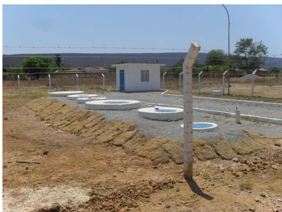
Foto 5: Estação Elevatória – Bacia A.
