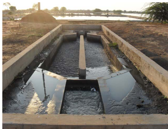
Foto 4: ETE – com 4 lagoas de tratamento.
