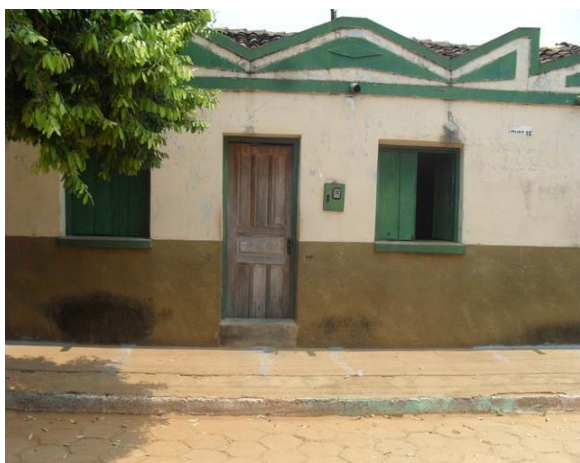
Foto 3: Área Crítica 1 – Av. Elias Pereira de Souza – área de enxurrada.
