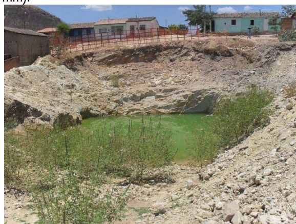
Foto 12: Estação Elevatória em início de implantação – obra esta paralisada – existe poço cheio de água como intensa proliferação de insetos.
