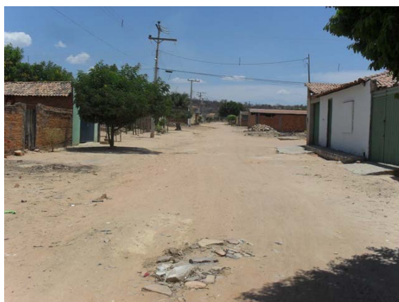
Foto 14: Bairro Renascer do Morro – Rua Genolvaldo G. da Silva – área com problemas de erosão.
