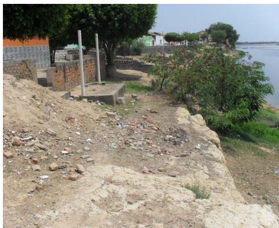
Foto 2: Ponto de lançamento de esgoto secundário direto no rio.
