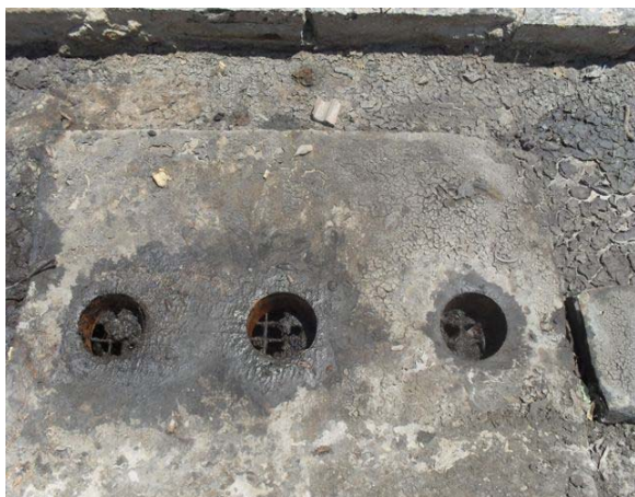
Foto 7: Caixa coletora na Avenida Santo Antônio.
