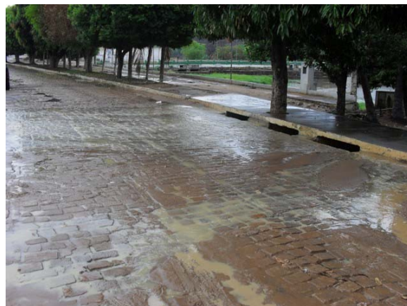
Foto 2: Dispositivo de drenagem – abertura no passeio para descida das águas de enxurrada.
