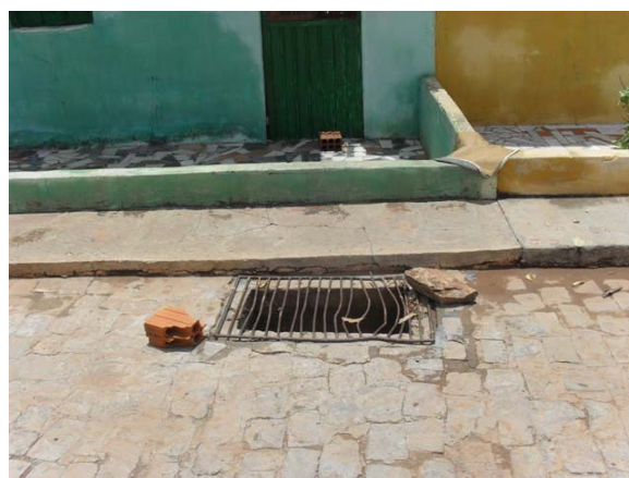
Foto 4: Rua do Rosário – Caixas com grelha direcionam as águas de chuva para o fundo dos quintais.
