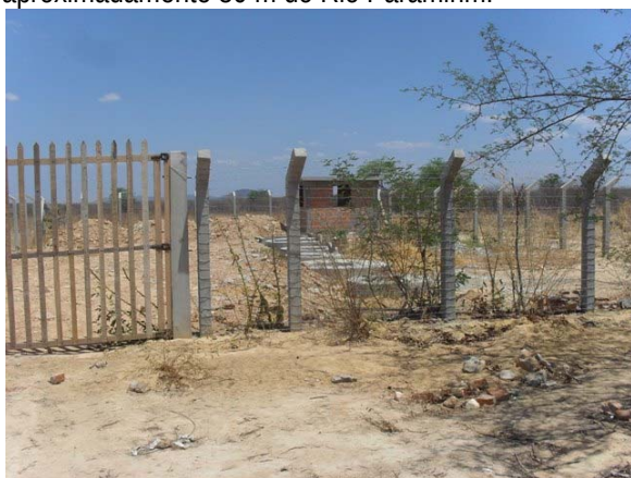
Foto 15: Estação Elevatória do Bairro São Francisco – Rua Juazeiro.
