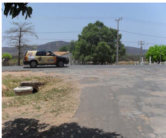
Foto 12: BA-160 – Av. Alves Martins – divisor de águas – com bueiro de DN 800 mm.
