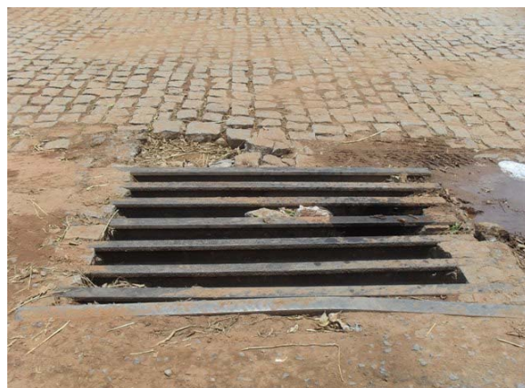
Foto 10: Av. Tiradentes – caixa coletora com grelha.
