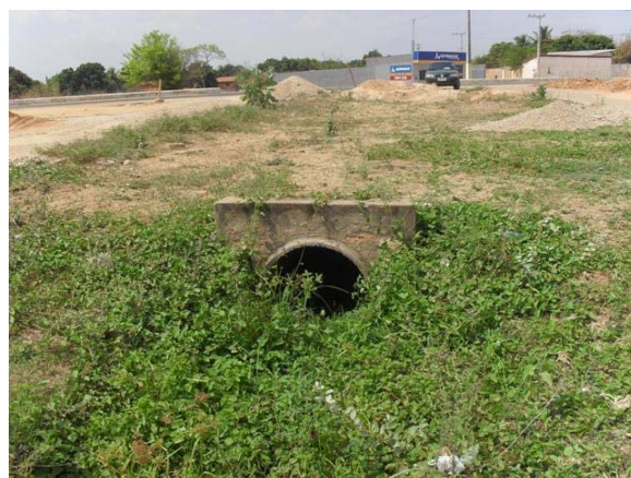
Foto 18: Área Crítica 2 – Av. Rio Branco – vista do Canal e entrada para o bueiro – trecho montante - área de alagamento.
