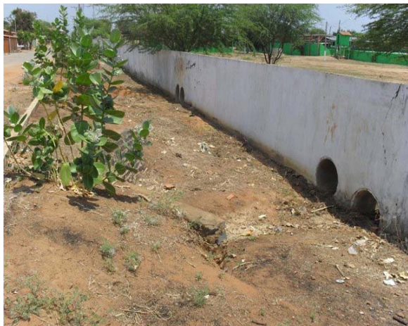
Foto 3: Área Crítica 1 – Baixada Fluminense – Rua Rio de Janeiro – vista dos bueiros - área de alagamento.
