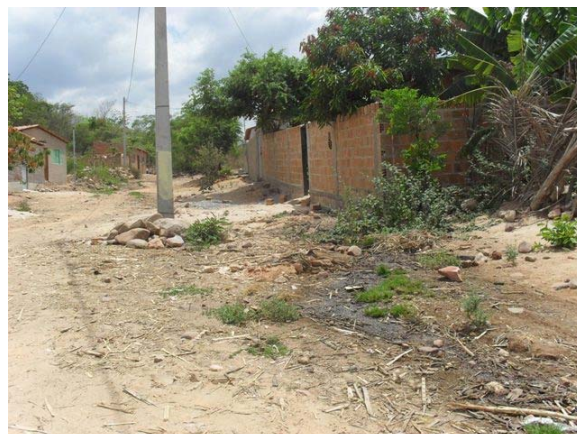
Foto 8: Travessa Ouro Preto com a Rua Santa Cruz – esgoto a céu aberto.
