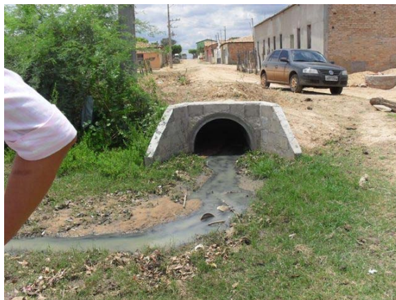
Foto 2: Ponto de lançamento de drenagem com presença de esgoto – escoamento para a Lagoa do Saco Grande – tubo de concreto DN 800 mm parcialmente assoreado.
