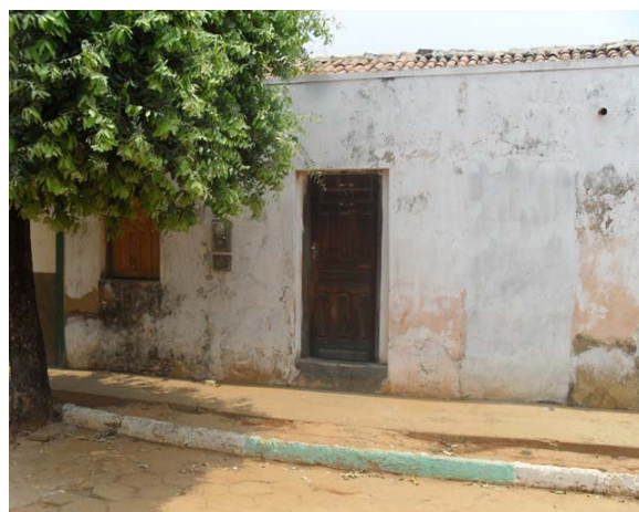
Foto 4: Área Crítica 1 – Av. Elias Pereira de Souza – área de enxurrada.
