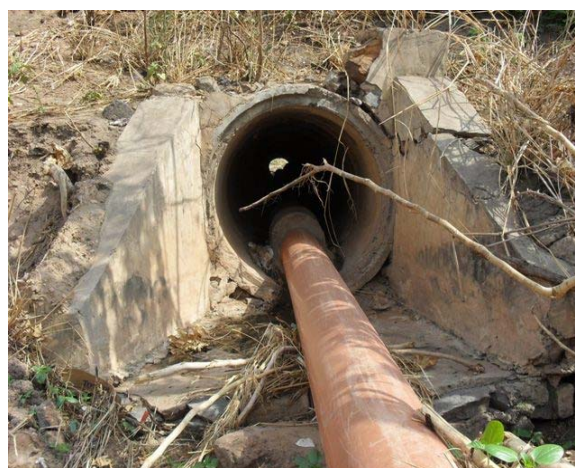
Foto 12: Ponto de lançamento de esgoto – tubo de ferro fundido DN 300 mm (água e esgoto) – escoia para a Lagoa.
