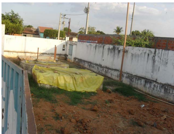
Foto 3: Estação Elevatória do Bairro Magalhães Neto.
