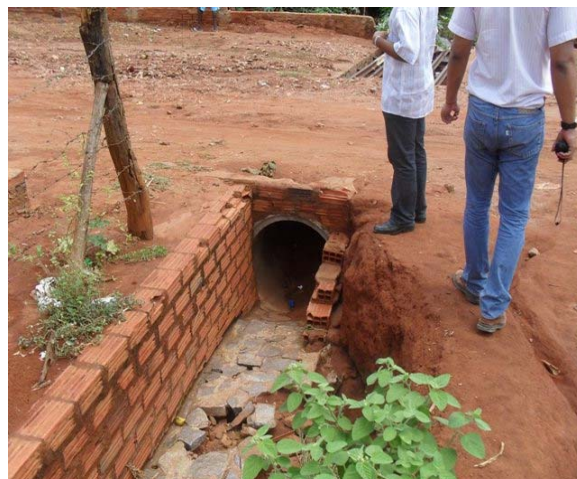
Foto 18: Valeta na Rua Amado Magalhães.
