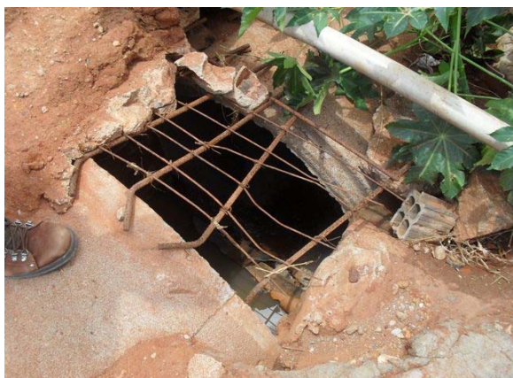
Foto 9: Abertura improvisada na galeria.
