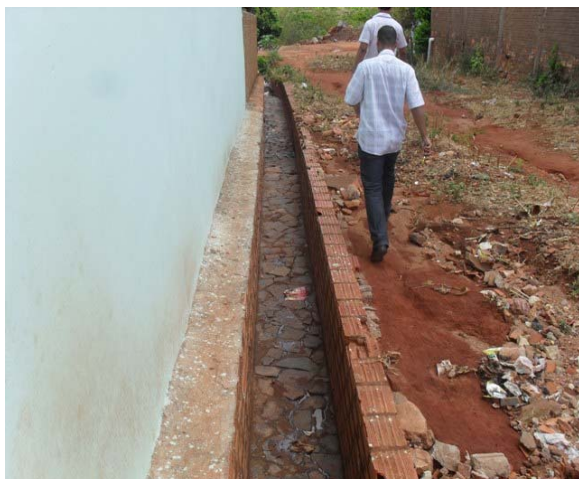
Foto 17: Valeta na Rua Amado Magalhães.
