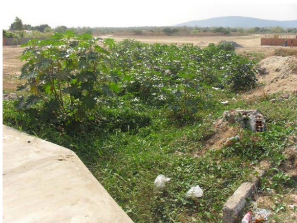
Foto 7: Ponto de lançamento final da rede de PVC de esgoto – final da canaleta - área totalmente coberta pela vegetação.
