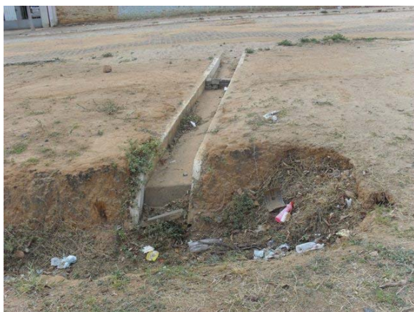
Foto 5: Canal seção mista assoreado – 50% revestido e 50% sem revestimento nas laterais.
