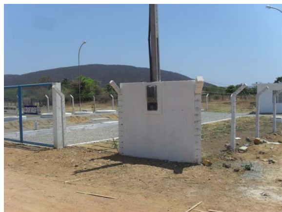
Foto 4: Estação Elevatória – Bacia A.
