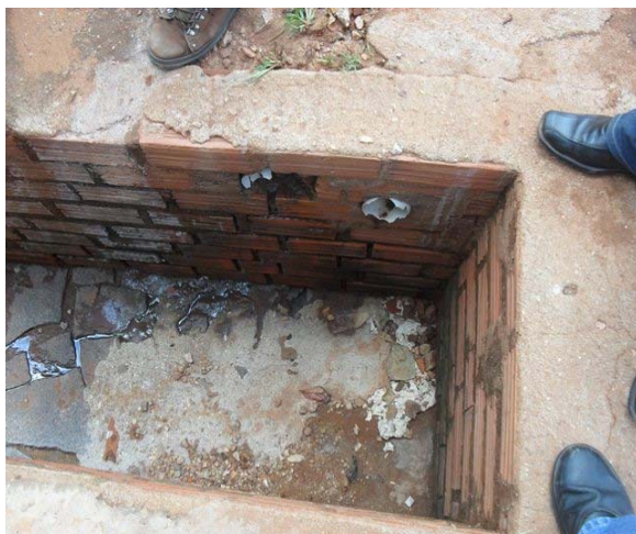
Foto 19: Valeta na Rua Amado Magalhães.
