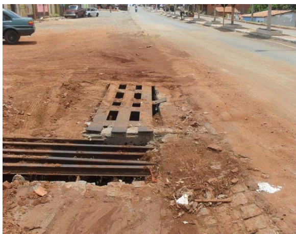
Foto 11: Av. Tiradentes – caixa coletora com grelha.
