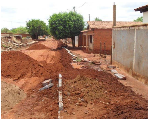
Foto 3: Área Crítica 2 – Praça Vila Eremita – área de alagamento.
