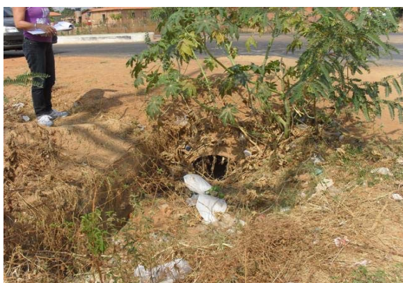
Foto 11: Vista a montante do bueiro que atravessa a Av. José Eduardo Porto – dá vazão as águas de alagamento – presença de muito lixo.
