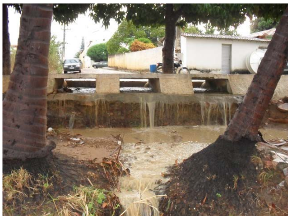
Foto 3: Dispositivo de drenagem – abertura no passeio para descida das águas de enxurrada.
