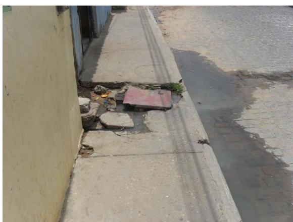
Foto 5: Alameda Plínio Mariano – caixas de gordura – solução para esgoto.
