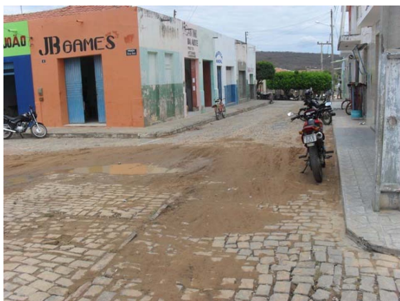
Foto 9: Área Crítica 1 – Rua Sete de Setembro e adjacentes – área crítica devido enxurrada.
