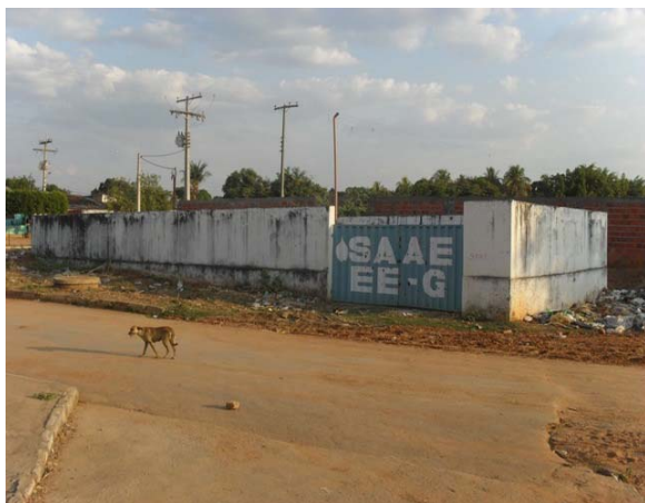
Foto 1: Estação Elevatória do Bairro Magalhães Neto.
