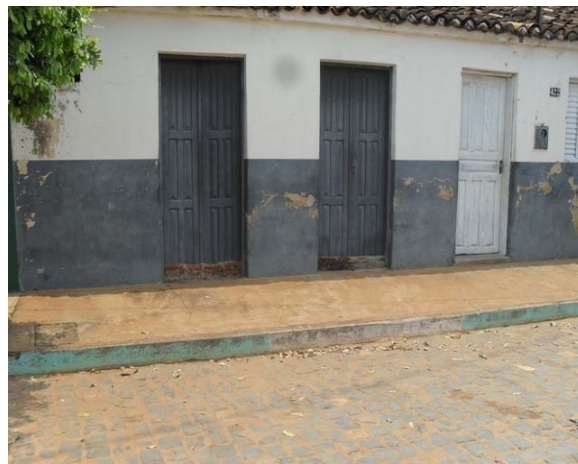
Foto 2: Área Crítica 1 – Av. Elias Pereira de Souza – área de enxurrada.
