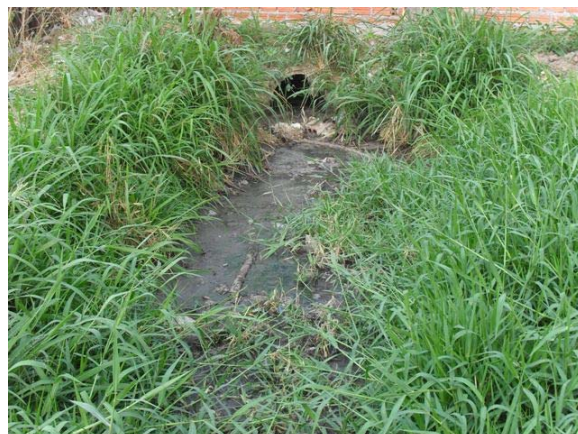
Foto 14: Vista do final da drenagem com presença de esgoto primário e secundário – DN 800 mm.
