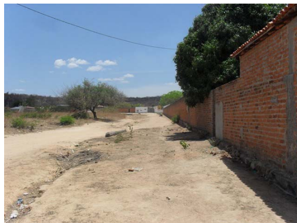
Foto 16: Bairro Renascer do Morro – Rua Horácio Cunha – rua com erosão.
