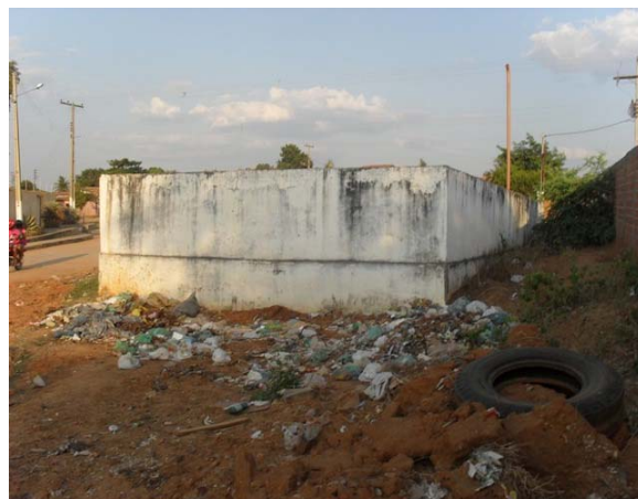
Foto 2: Estação Elevatória do Bairro Magalhães Neto.
