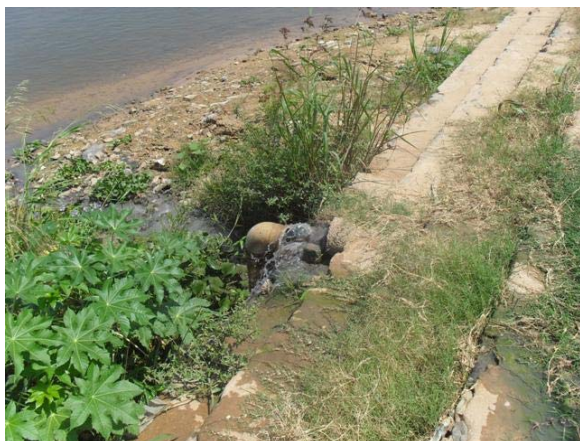
Foto 1: Esgoto lançado diretamente no Rio São Francisco.
