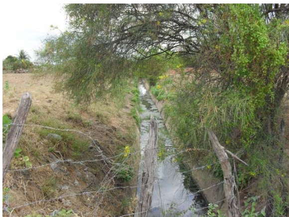
Foto 3: Canal (parte sem revestimento) – seção trapezoidal – escoamento para o bueiro e continua sem revestimento até a Lagoa do Saquinho.
