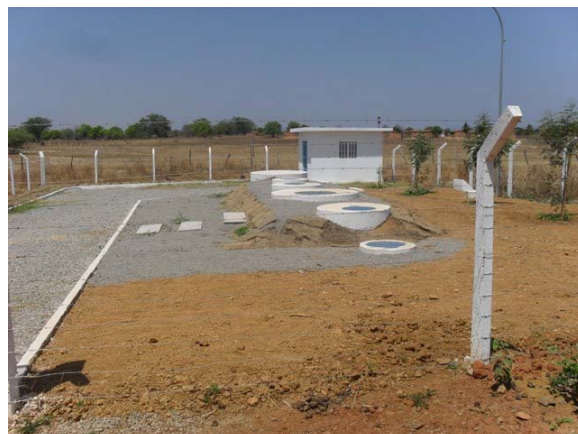
Foto 2: Estação Elevatória – Bacia C.
