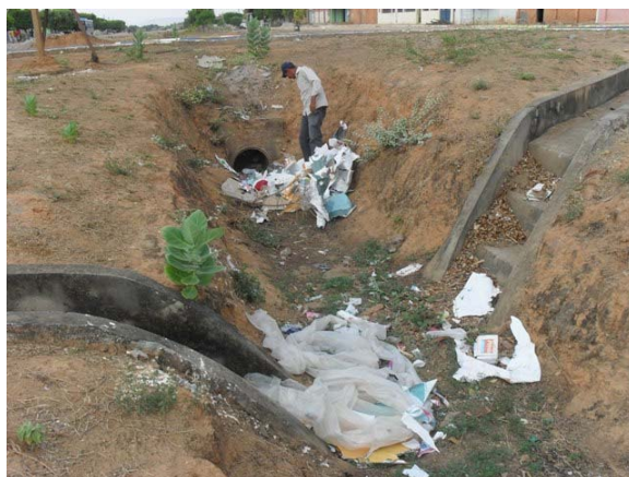
Foto 6: Canal seção mista assoreado – 50% revestido e 50% sem revestimento nas laterais – presença de lixo.
