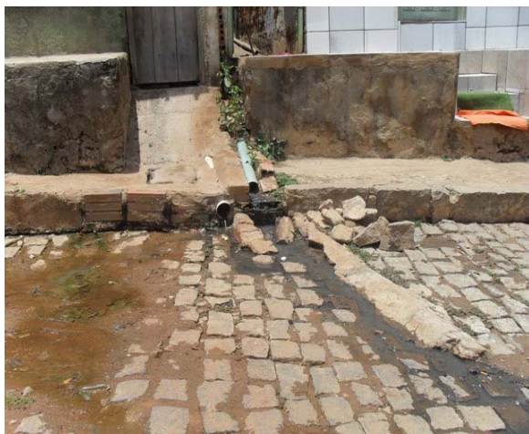
Foto 1: Lançamento de esgoto secundário a céu aberto.
