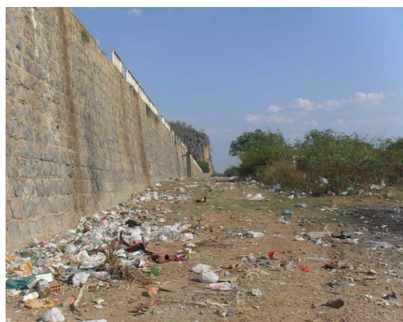
Foto 4: Ponto de lançamento de águas pluviais – muito lixo – calha da Lagoa da Lapa.
