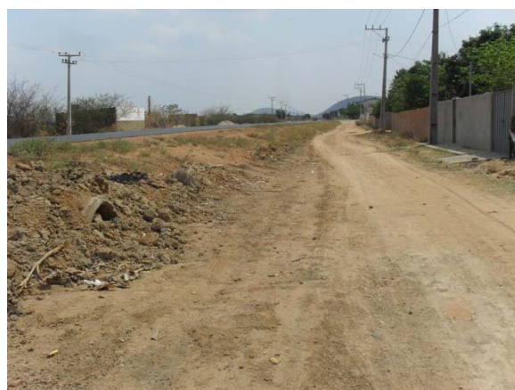
Foto 16: Área Crítica 1 – BA-160 sentido Paratinga / Bom Jesus da Lapa – Bairro Alto da Estrada – área de alagamento.
