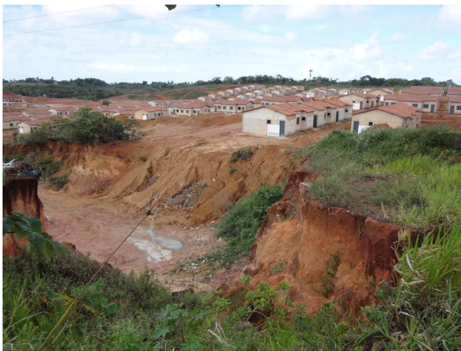
Figura 8.5 - Taludes Verticais Solo Desagregado com Desenvolvimento de Processos Erosivos Generalizados no Canteiro de Obras de Construção de Casas Populares. Coord.: UTM 8.580.482 / 567.166
