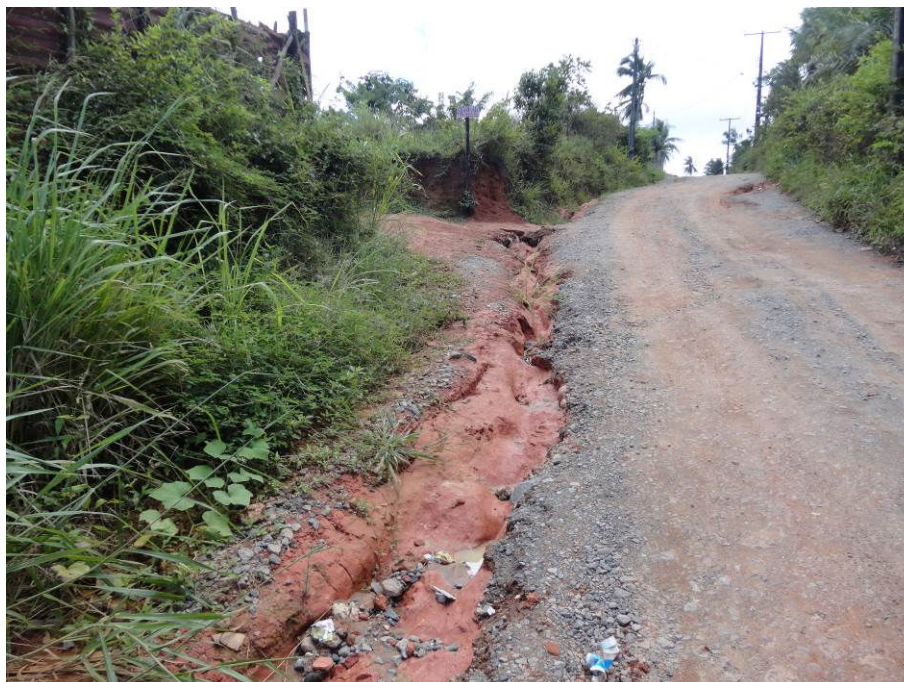
Figura 3.1 - Estrada de Declividade Forte no Sentido de maior Declive e com Drenagem Deficiente e Erosão Hídrica. Coord.: UTM 8.573.820 / 567.305
