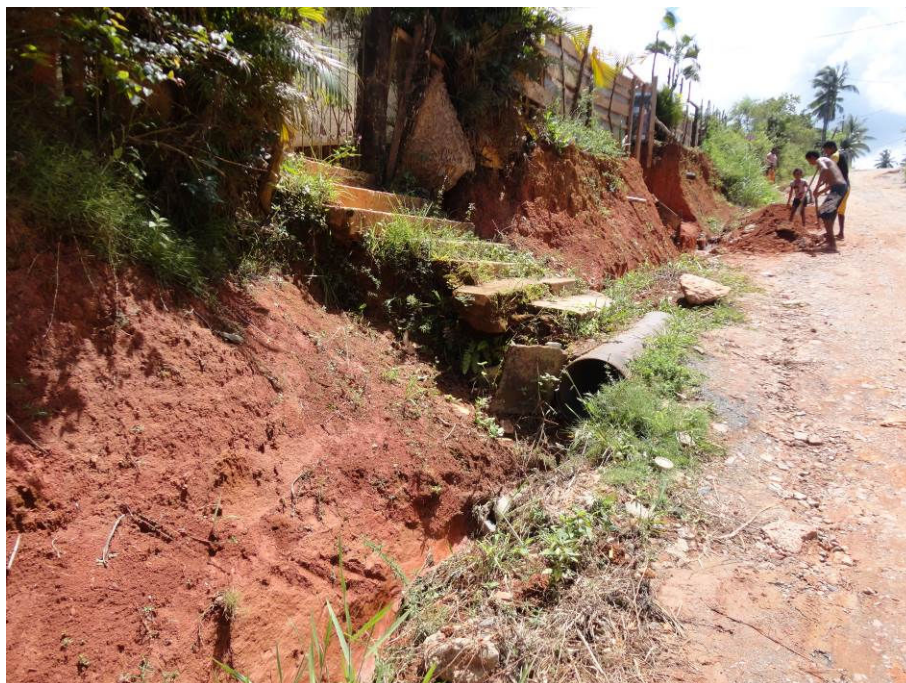
Figura 6.3 - Danos às Escadas de Acesso Devido à Falta de Drenagem. Coord.: UTM 8.573.820 / 567.305
