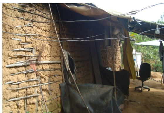
Figura 6.88 - Precariedade das Casas Existentes na Área de Carobeira “Buracão”
