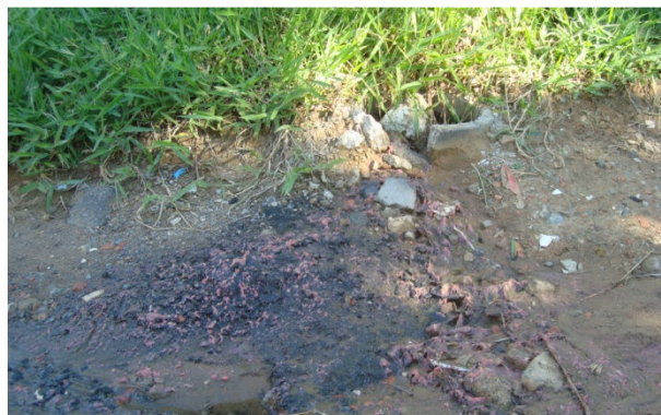
Figura 6.82 - Lançamento de Esgoto a Céu Aberto, Próximo a Fábrica de Polpa, Alto do Girassol
