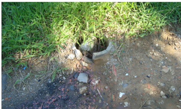
Figura 6.81 - Caixa de Passagem Danificada, Alto do Girassol
