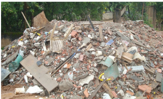
Figura 6.100 - Ponto de Entulho – Estrada que dá Acesso a Localidade de Biribeira
