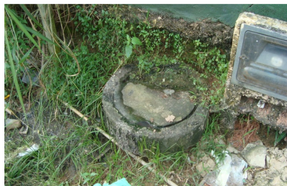
Figura 6.66 - Caixa de Passagem Transbordando, Próxima a Rede de Água Aflorando no Solo, Nova Esperança
