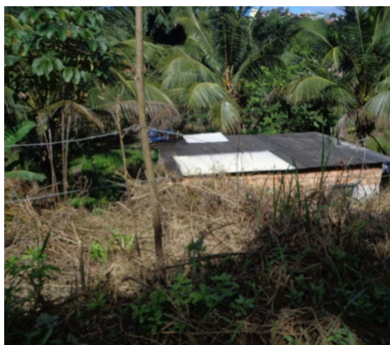
Figura 6.23 - Edificação Implantada abaixo da Cota de Nível da Via Foto do autor. 2013.
