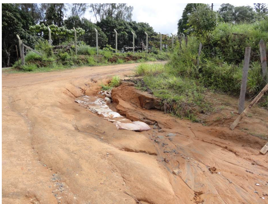
Figura 8.2 - Processos Erosivos Lineares em via de Acesso sem Sistema de Drenagem, onde são Utilizados Sacos de Areia para Conter a Erosão do Pavimento Coord.: UTM 8.578.436 / 567.670
