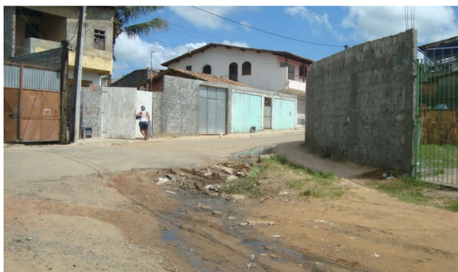
Figura 6.71 - Esgoto a Céu Aberto, Loteamento Ceasa
