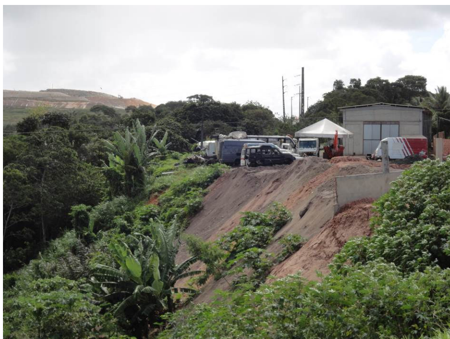
Figura 3.2 - Área de Aterro com Material Alóctone com Risco Elevado de Deslizamento. Coord.: UTM 8.578.302 / 569.041
