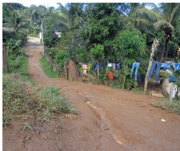
Figura 6.24 - Via sem Pavimentação, sem Drenagem e sem Calçada Foto do autor. 2013.
