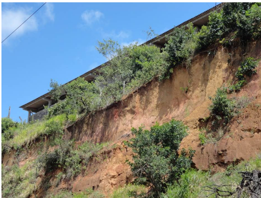
Figura 6.1 - Talude da Estrada com Declividade Invertida com Risco de Desmoronamento. Coord.: UTM 8.576.106 / 568.962
