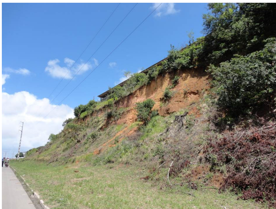
Figura 8.6 - Taludes de Corte na CIA-Aeroporto Apresentando Risco de Deslizamento. Coord.: UTM 8.576.106 / 568.962
