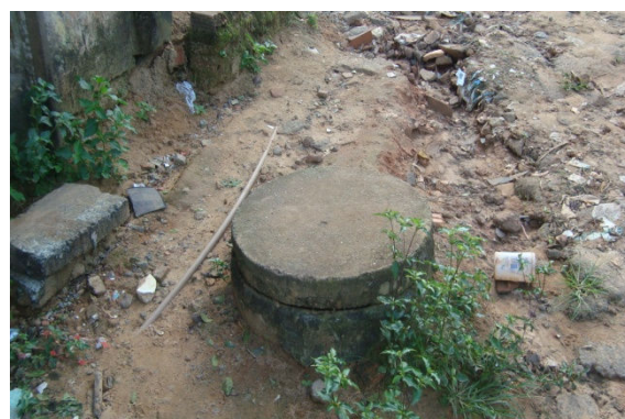
Figura 6.54 - Caixa de Passagem Próxima a Rede de Água Aflorando no Solo, Jardim Campo Verde
