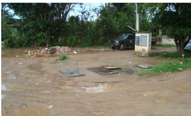
Figura 6.73 - Estação Elevatória de Esgoto Existente, Comunidade do Bosque Ipitanga
