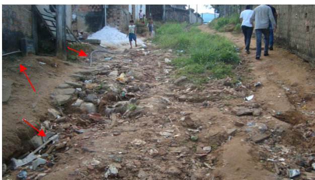
Figura 6.4 - Tubulação da Rede de Distribuição Aparente, Localidade de Jardim Campo Verde/Barro Duro
