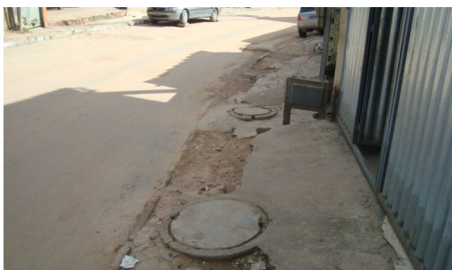
Figura 6.53 - Caixa de Passagem, Jardim Campo Verde
