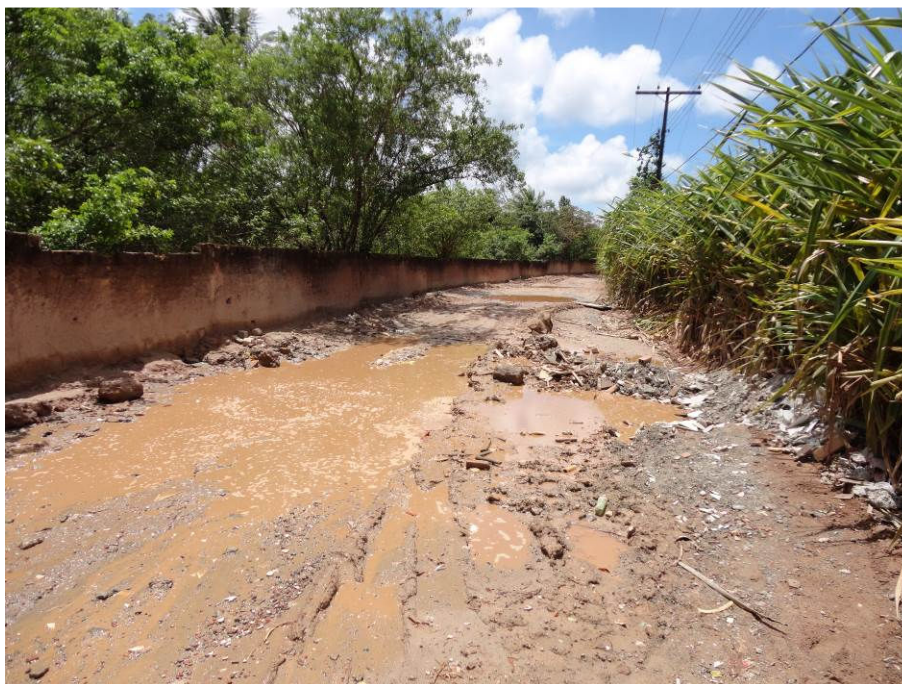
Figura 4.13 - Falta de Drenagem com Consequente Acumulação de Água no Pavimento. Coord.: UTM 8.575.195 / 567.284
