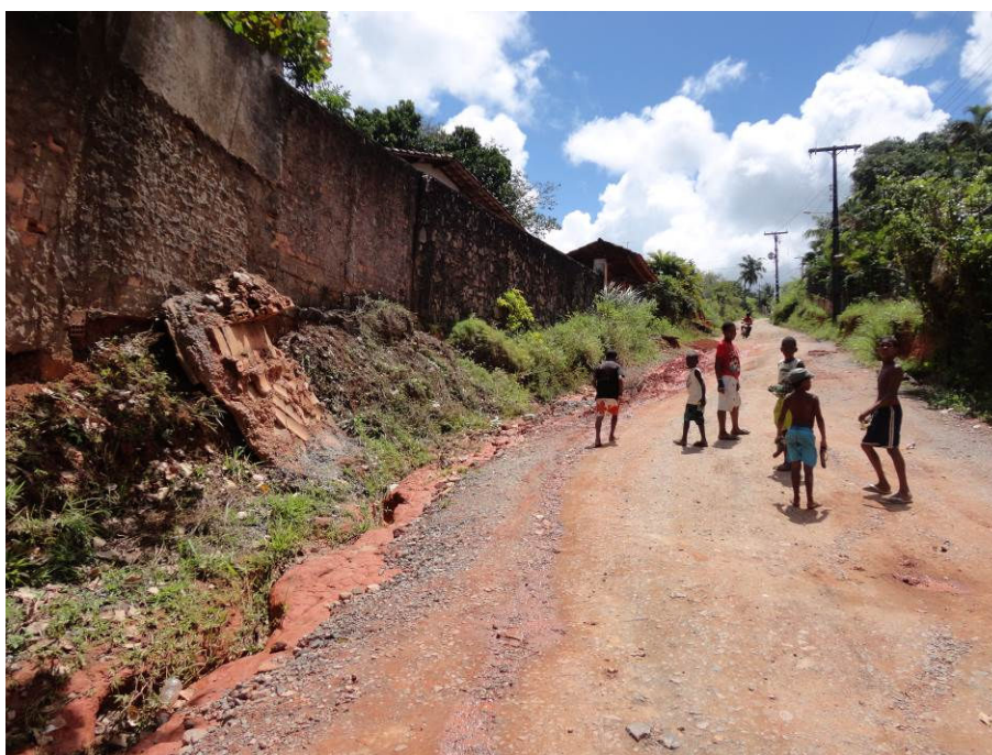
Figura 6.2 - Risco de Queda do Muro Devido a Erosão Coord.: UTM 8.573.820 / 567.305
