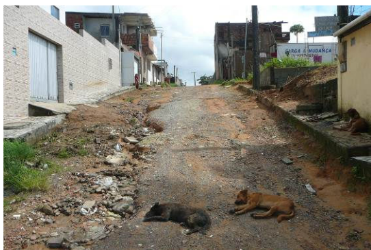
Figura 4.1 - Rua sem Pavimentação
