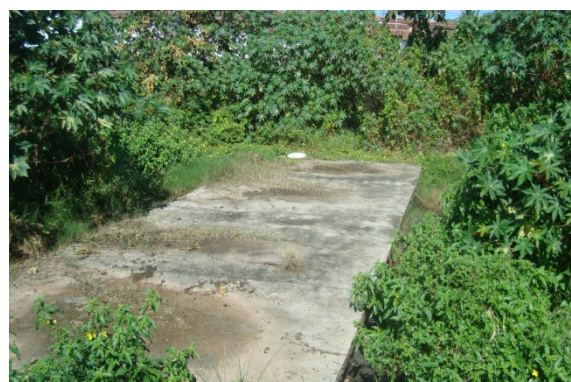
Figura 6.60 - Uma das Fossas Sépticas que Recebe o Esgoto Coletado do CH Jardim Campo Verde
