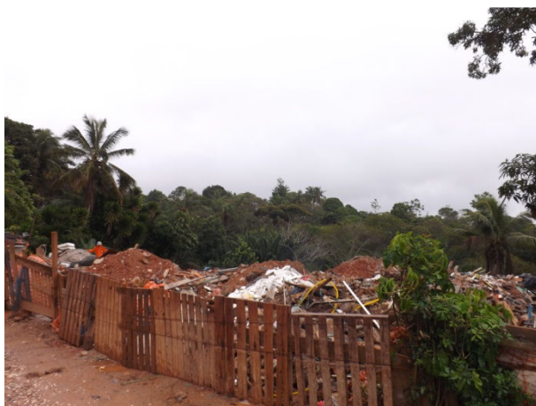
Figura 6.7 - Deposição Indevida de Resíduos Sólidos Provavelmente Derivados da Construção Civil – Localidade de Raposo
