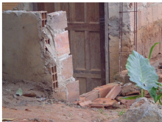
Figura 6.26 - Edificação Implantada abaixo da Cota de Nível da Via
