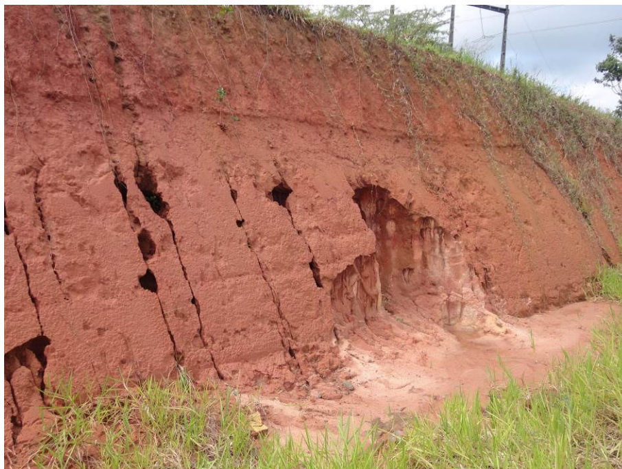
Figura 4.9 - Processos Erosivos Lineares em Taludes de Corte de Grupo Barreiras Causando Entulhamento da Drenagem – Rótula da CEASA. Coord.: UTM 8.580.219 / 567.960
