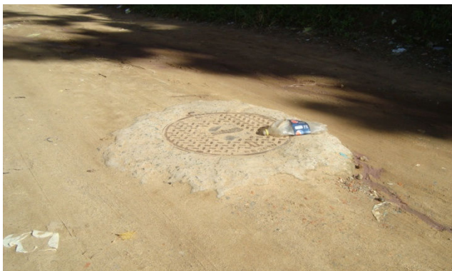
Figura 6.79 - Poço de Visita (PV), Alto do Girassol – Via Principal
