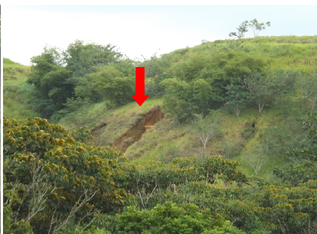
Figura 6.4 - Pontos de Erosão em Encostas localizadas na Região da Represa Ipitanga I
