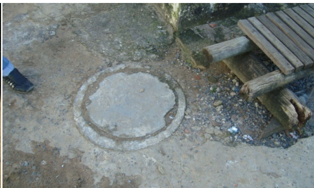
Figura 6.80 - Caixa de Passagem, Alto do Girassol
