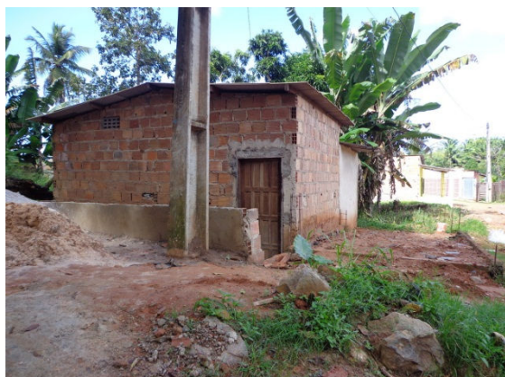
Figura 6.25 - Edificação Implantada abaixo da Cota de Nível da Via
