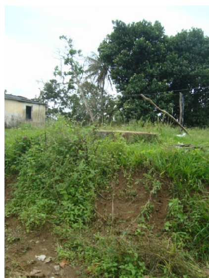
Figura 6.43 - Base do Reservatório de 2.000 L (RAD 1) – Comunidade Pedreira Carangi
