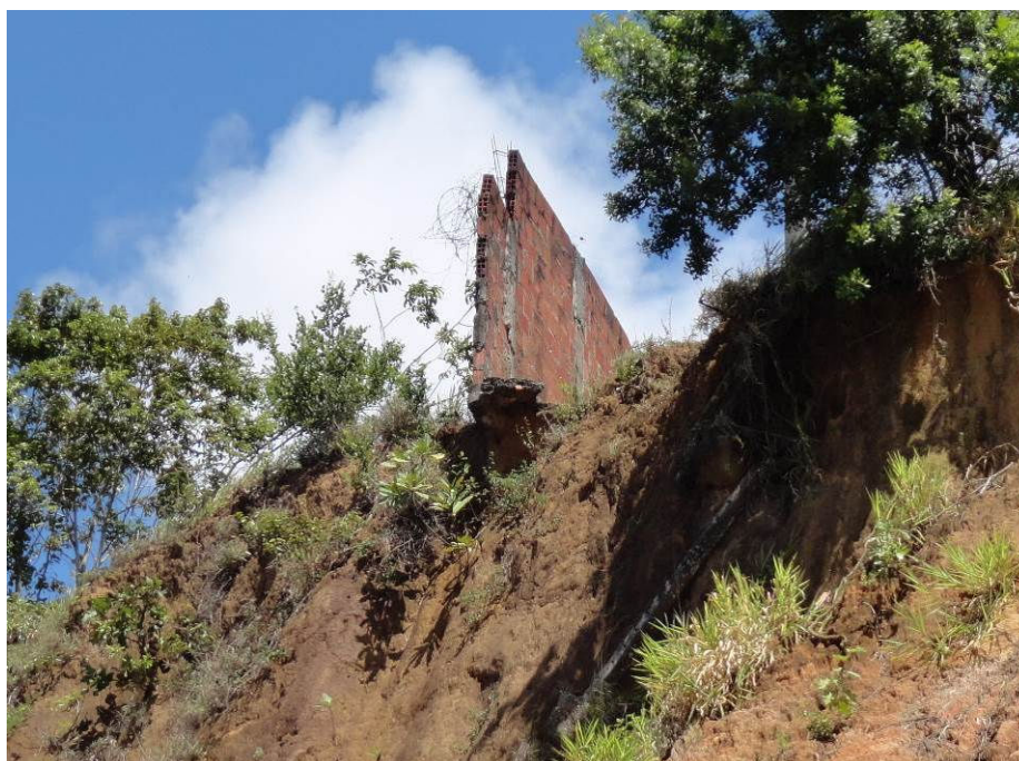
Figura 8.7 - Deslizamento de Parte do Talude com Exposição da Fundação do Muro de Alvenaria. Coord.: UTM 8.576.106 / 568.962
