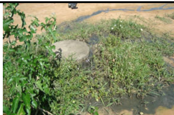
Estrutura de captação de esgoto Transbordando, Esgoto a Céu Aberto – Jardim Campo Verde
