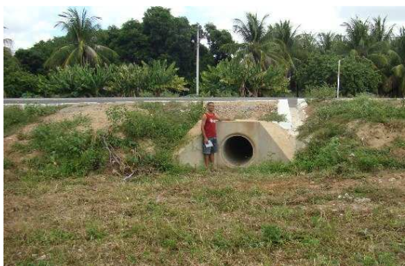
Foto 9: Bueiro responsável pela inundação do Bairro Contornolândia. Vista de montante
