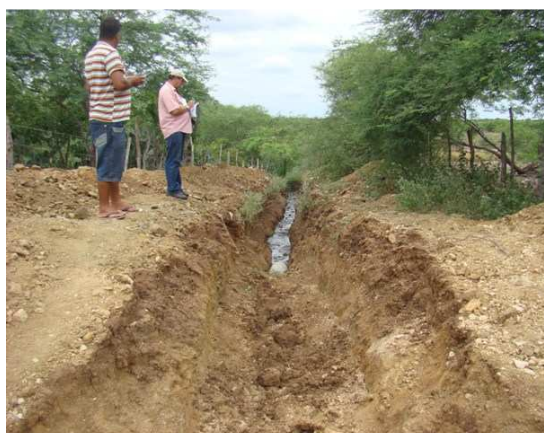
Foto 4: Ponto de lançamento de esgotos em direção ao Rio Jacuípe
