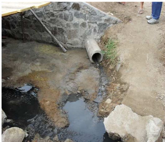
Foto 13: Ponto de lançamento no córrego principal, correspondendo a uma tubulação do sistema misto informal que atende uma parcela da cidade, transportando esgotos
