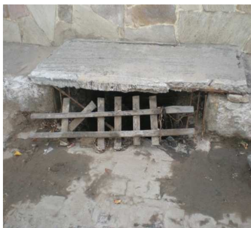
Foto 10: Caixa de passagem com grelha vertical
