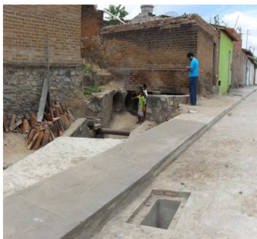
Foto 15: Ponto de lançamento, com boca-de-lobo recém construída, em primeiro plano. Também é uma área crítica
