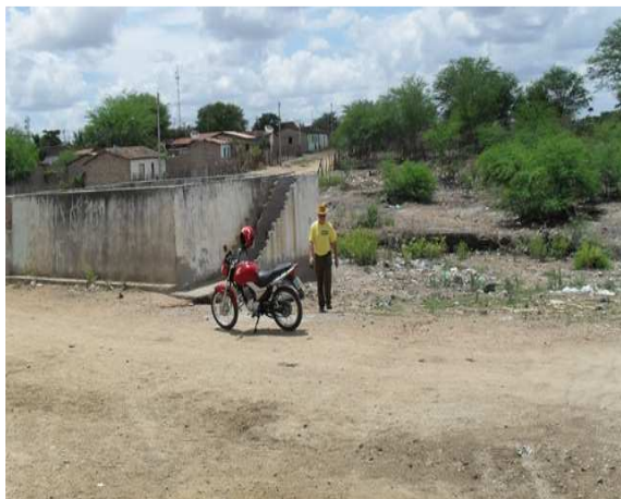
Foto 1: Sistema interceptor inoperante
