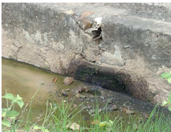
Foto 9: Ponto de esgoto descartado diretamente na macro drenagem
