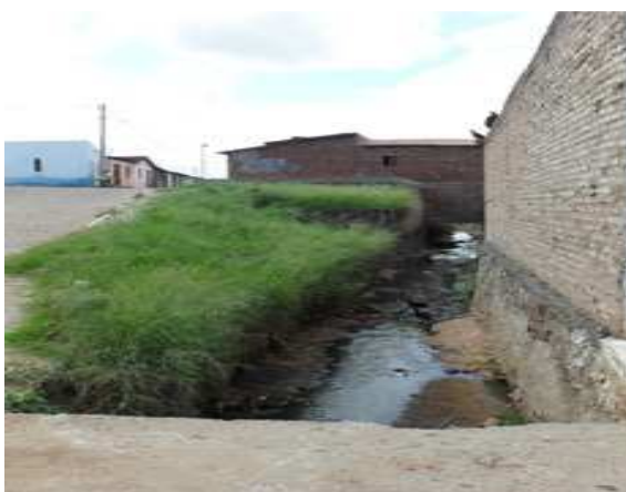
Foto 5: Galeria com leito assoreado sob casas
