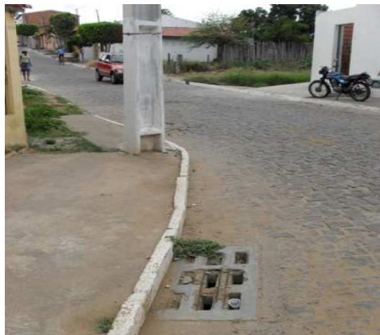
Foto 2: Boca de Lobo, semi-obstruída por folhas e areia, que escoam para o córrego principal do escoamento dos setores centrais da cidade
