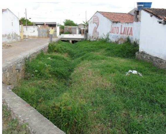
Foto 2: O Riacho Cairu, principal veio de drenagem pluvial e de recolhimento das contribuições sanitárias, no caso as "águas imundas" conduzidas pelo "sistema informal". Área crítica, sujeita à inundação
