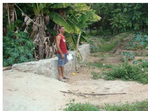
Foto 12: Área de escoamento do bueiro sob a BA 418 que se mostrou insuficiente para a vazão sob chuvas torrenciais
