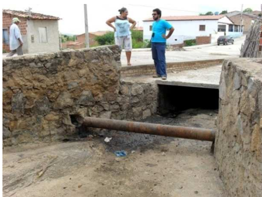
Foto 13: Vista à montante do ponto de lançamento de rede pluvial conduzindo esgotos, à noroeste da mancha urbana
