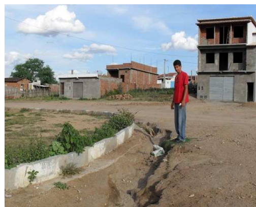
Foto 8: Sulco de erosão, provocado pelo não disciplinamento do escoamento superficial, também conduzindo contribuições sanitárias. É uma área crítica
