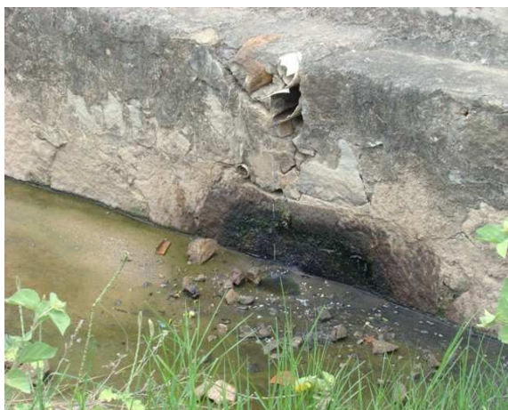
Foto 9: Ponto de esgoto descartado diretamente na macrodrenagem
