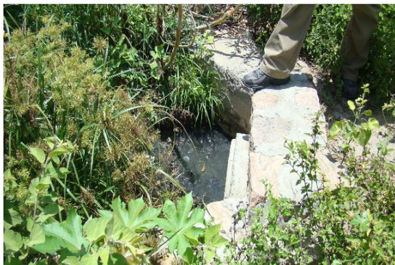
Foto 7: Ponto de descarga da rede secundária de drenagem com contribuição de esgotos na Lagoa do Pandeiro
