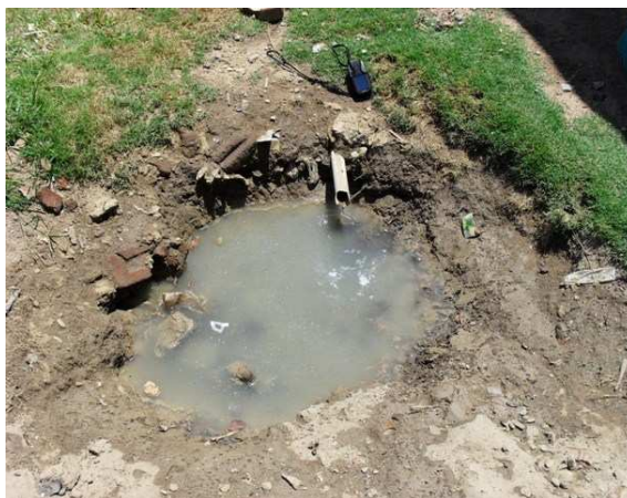
Foto 13: Ponto de acumulação de esgoto secundário em setor urbano onde a fossa absorvente é insuficiente à infiltração
