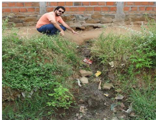
Foto 6: Lançamento de esgotos sanitários no córrego central, no centro da cidade
