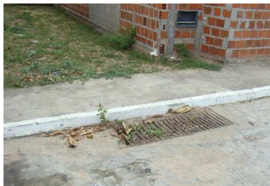
Foto 10: Grelha do sistema de drenagem principal, totalmente obstruída
