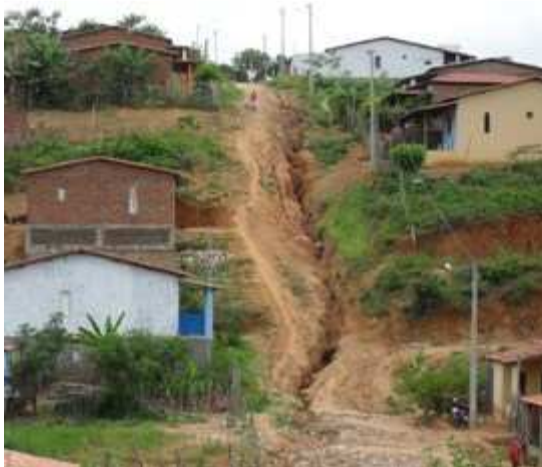
Foto 7: Rua Agripino Fontoura - erosão
