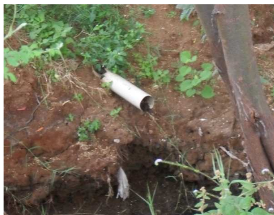
Foto 7: Descarte de contribuição de estabelecimento comercial, diretamente no córrego central, o principal veio de escoamento dos esgotos urbanos
