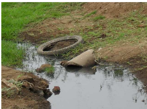
Foto 5: Ponto de lançamento, em condições críticas no córrego principal, de uma tubulação do sistema misto informal que atende uma parcela da cidade
