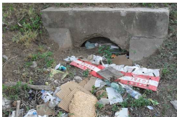
Foto 4: Chegada de águas pluviais ao corpo receptor – obstrução
