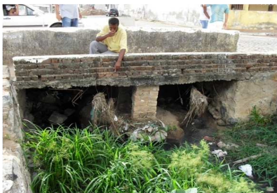
Foto 11: Pontilhão sobre o Riacho Cairu, trecho em que a concentração dos esgotos e o acúmulo de lixo assumem proporções críticas. É uma área crítica
