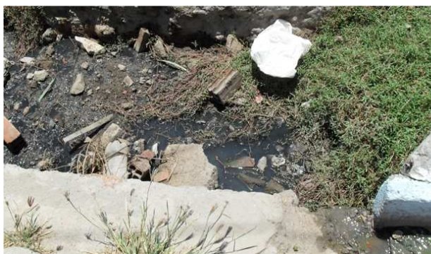
Foto 3: Caixa de drenagem águas pluviais com esgoto
