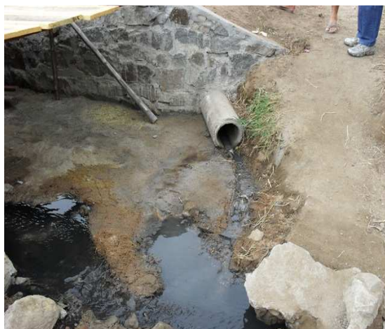
Foto 22: Ponto de lançamento no córrego principal, correspondendo a uma tubulação do sistema misto informal que atende uma parcela da cidade, transportando esgotos
