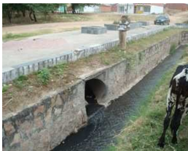
Foto 12: Canal natural lança no canal revestido
