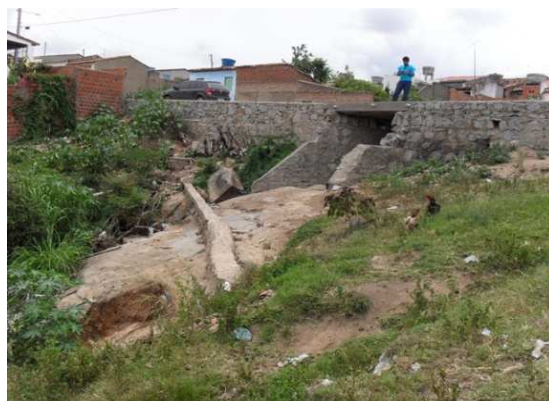
Foto 14: Vista à jusante de ponto de lançamento de rede pluvial conduzindo esgotos, à noroeste da mancha urbana
