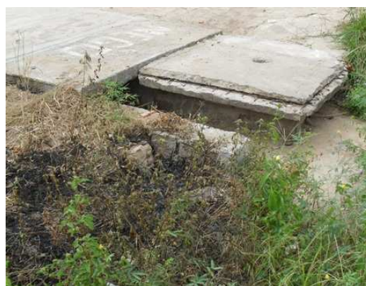
Foto 10: Caixa de saída da galeria cruzando a rua Araujo Sampaio
