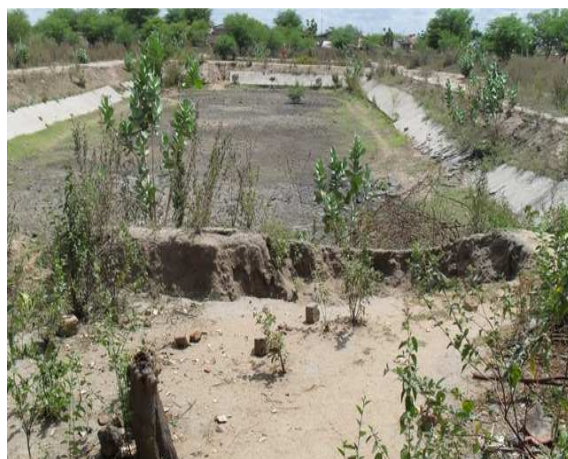
Foto 4: Estação de tratamento de esgoto – interceptor inoperante
