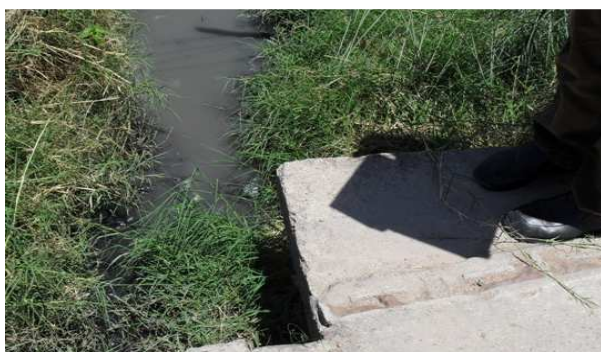
Foto 5: Saída - Caixa de drenagem águas pluviais com esgoto
