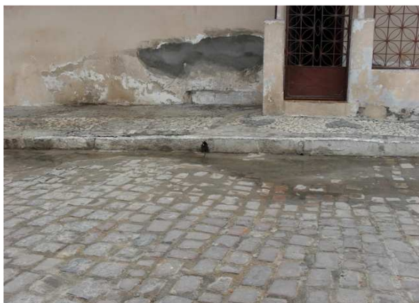
Foto 1: Lançamento de esgoto secundário na sarjeta, no reduzido setor urbano onde a capacidade de infiltração do solo é inferior à média observada
