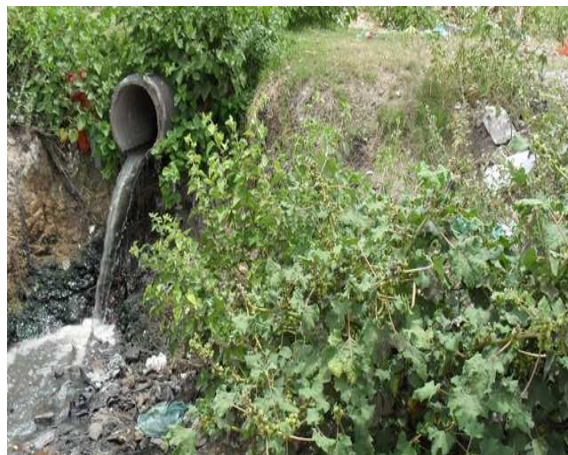
Foto 8: Chegada de águas pluviais e esgoto no corpo receptor via tubulação
