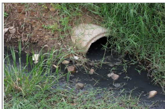
Foto 10: Ponto de lançamento de esgotos no córrego principal, através de uma estrutura típica do sistema de drenagem pluvial, que opera sob regime de "condução mista", no centro da cidade
