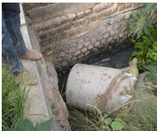
Foto 6: Caixa de passagem que mistura águas pluviais e esgoto
