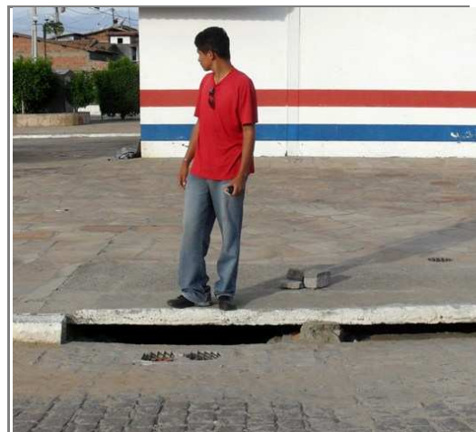
Foto 6: Bocas-de-lobo com admissão pela lateral das guias, na "área crítica" em torno do centro de abastecimento
