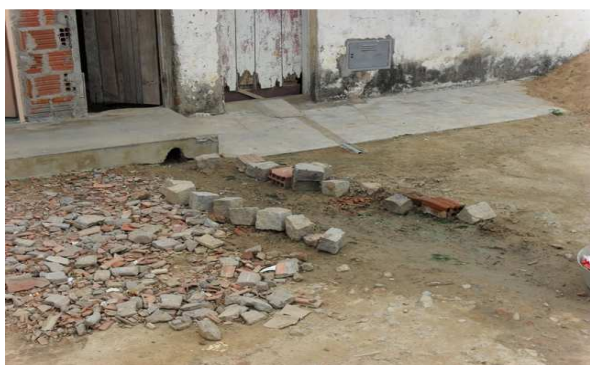
Foto 5: Lançamento de esgoto secundário na sarjeta, no setor urbano denominado “Pinguim”
