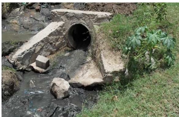
Foto 1: Chegada da Drenagem no corpo receptor
