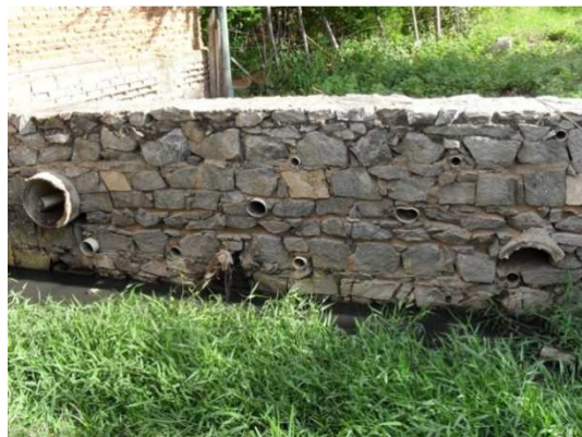
Foto 6: Pontos de lançamento das estruturas do "sistema informal" e pontos de lançamento direto na calha retificada do Riacho Cairu, no centro da cidade
