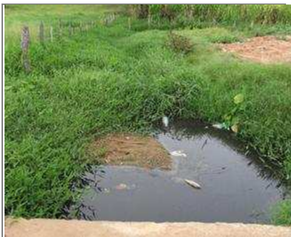
Foto 1: Área Crítica 1 Final da rua 2 de Julho-galeria lançando esgotos no pasto-ponto de alagamento
