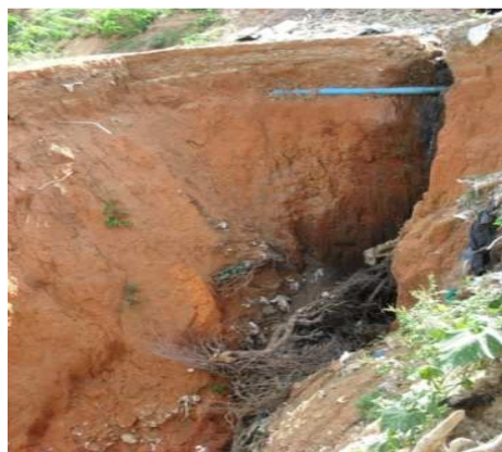
Foto 17: A voçoroca localizada vista de outro ângulo. Denota-se a exposição da tubulação da rede de abastecimento de água
