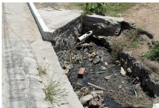
Foto 4: Caixa de drenagem águas pluviais com esgoto
