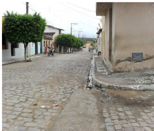
Foto 2: Lançamento de esgoto secundário em sarjeta, convergente ao setor baixo onde se estabelece a várzea receptora principal.
