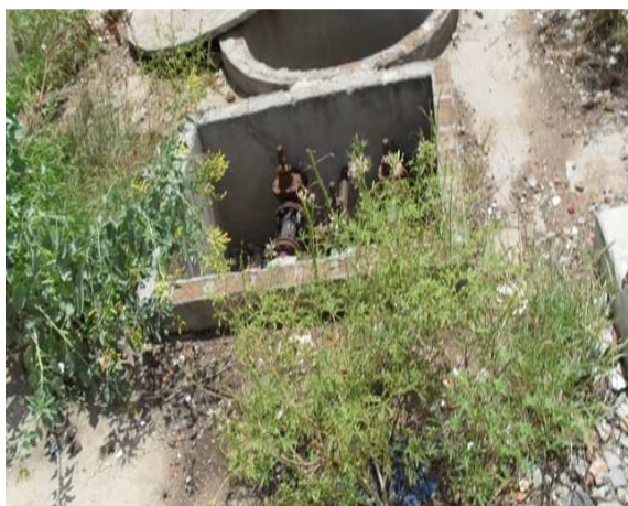
Foto 3: Estação de tratamento de esgoto – interceptor inoperante
