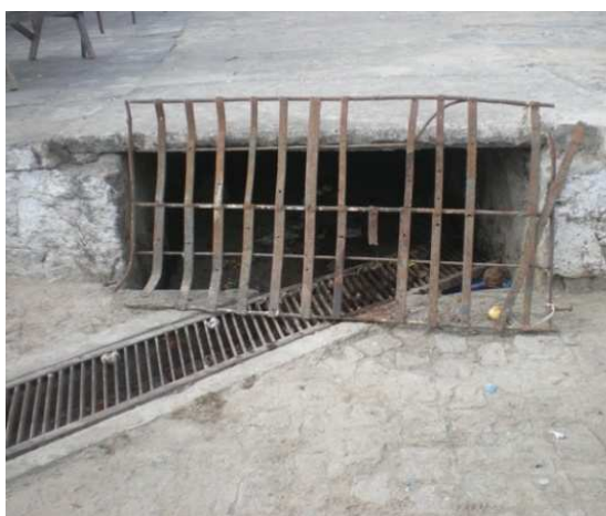
Foto 9: Caixa de passagem com grelha vertical e horizontal galeria de rua
