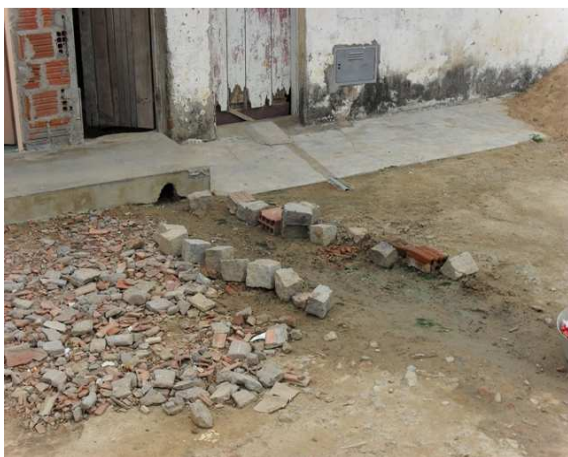
Foto 3: Lançamento de esgoto secundário na sarjeta, no setor urbano denominado "Pinguim".
