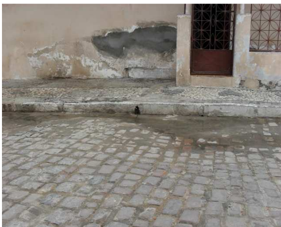
Foto 1: Lançamento de esgoto secundário na sarjeta, no reduzido setor urbano onde a capacidade de infiltração do solo é inferior à média observada.
