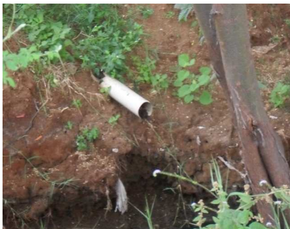
Foto 1: Descarte de contribuição de estabelecimento comercial, diretamente no córrego central, o principal veio de escoamento dos esgotos urbanos
