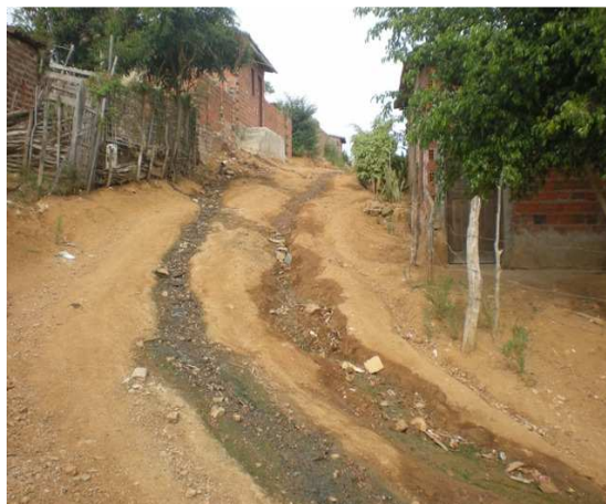
Foto 2: Esgoto correndo a céu aberto
