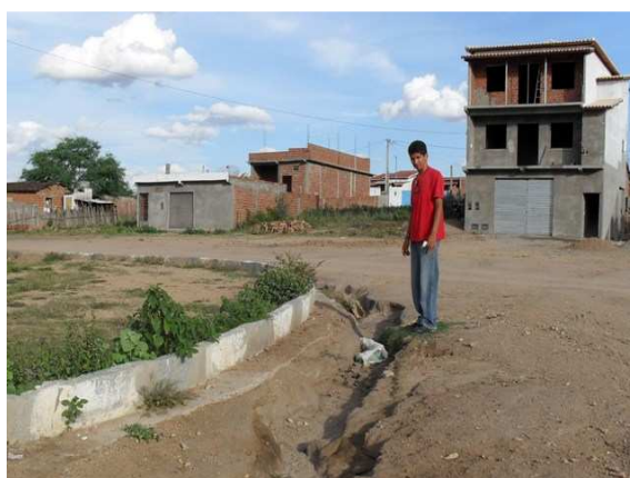
Foto 4: Sulco de erosão, provocado pelo não disciplinamento do escoamento superficial, também conduzindo contribuições sanitárias. É uma área crítica
