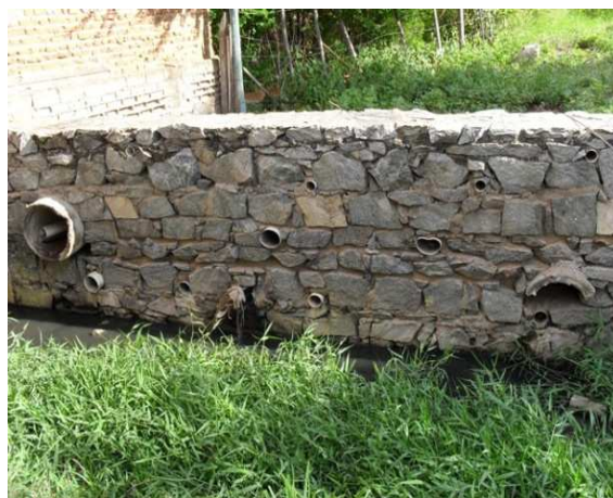
Foto 4: Pontos de lançamento das estruturas do "sistema informal" e pontos de lançamento direto na calha retificada do Riacho Cairu, no centro da cidade
