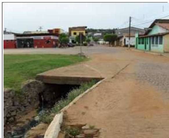
Foto 2: Área Crítica 2 – Rodoviária - córrego confinado-ponto de alagamento
