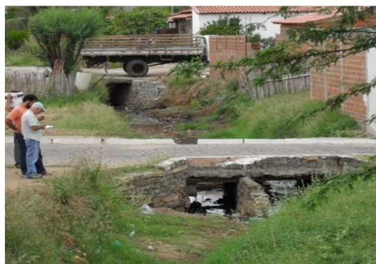
Foto 9: Bueiro celular duplo e pontilhão (ao fundo) ao longo das vias urbanas, ambas estruturas sobre o córrego principal, no setor central da cidade. Corresponde a uma área crítica, sujeita à inundação
