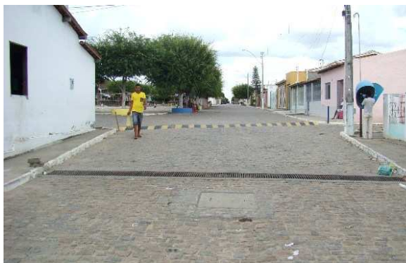
Foto 9: Grelha transversal existente no final da rua Honorato Barbosa (Sistema independente)
