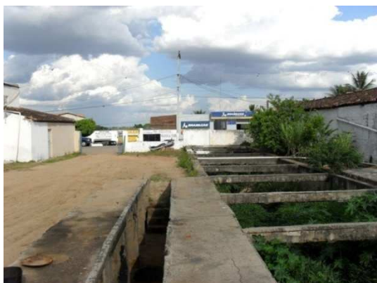
Foto 7: Trecho canalizado (endicado) do Riacho Cairu, no centro da cidade
