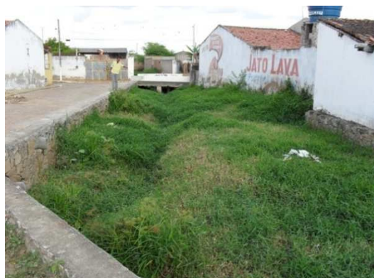
Foto 4: O Riacho Cairu, principal veio de drenagem pluvial e de recolhimento das contribuições sanitárias, no caso as "águas imundas" conduzidas pelo "sistema informal". Área crítica, sujeita à inundação
