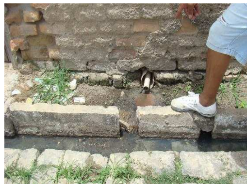
Foto 4: Detalhe de contribuição de esgoto secundário doméstico na calha aberta na Rua Josefa Maria de Oliveira Silva
