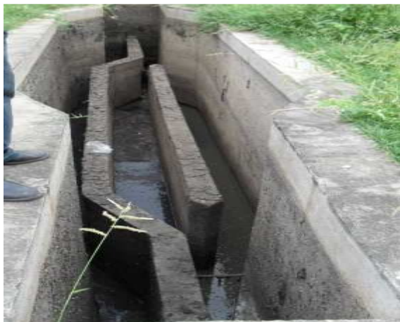
Foto 7: ETE - Calha parshal
