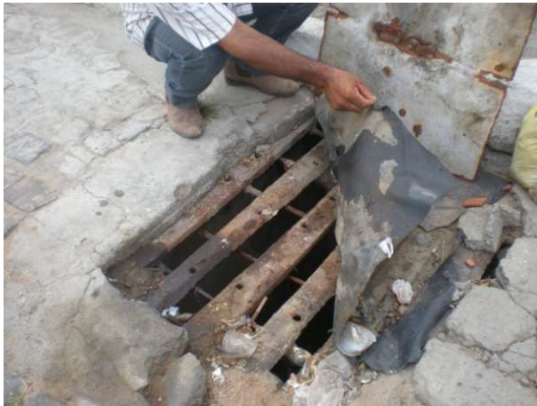
Foto 1: Caixa de passagem com grelha – águas pluviais
