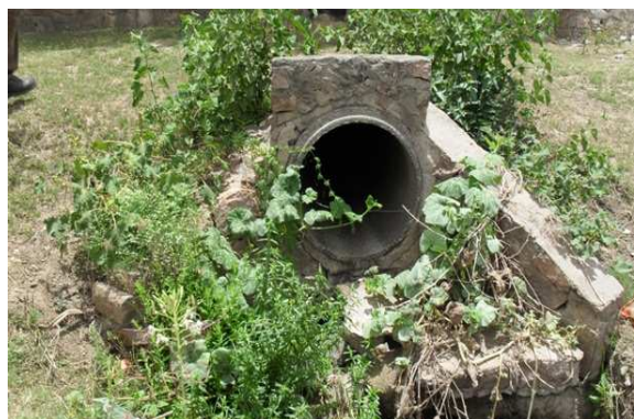
Foto 2: Chegada da Drenagem no corpo receptor
