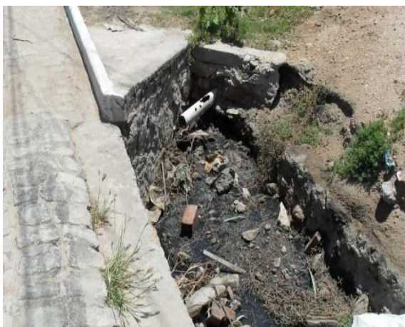
Foto 7: Galeria de Águas Pluviais que conduz esgoto
