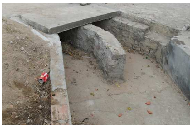
Foto 5: Canaleta - chegada da água próximo a rua Araujo Sampaio
