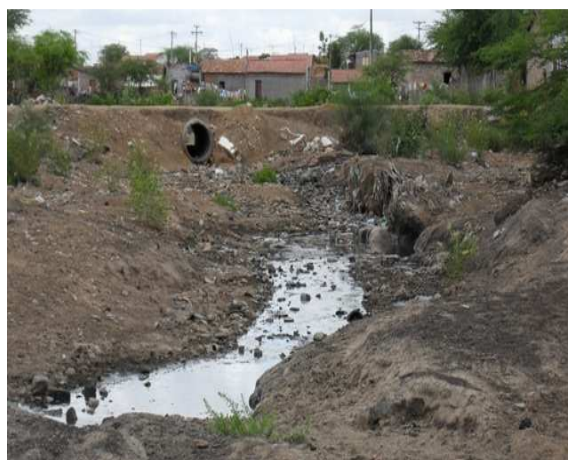
Foto 6: Drenagem natural – Alto do Cruzeiro com esgoto
