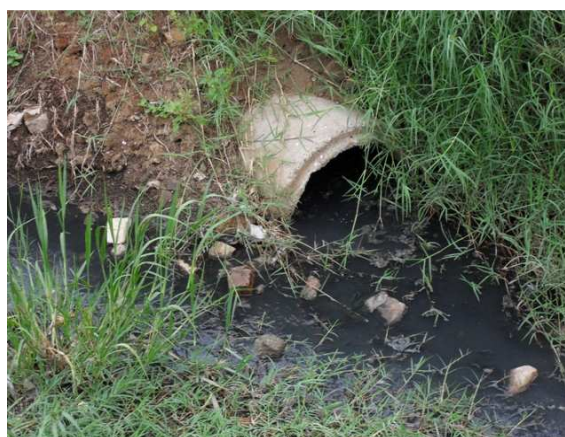
Foto 4: Ponto de lançamento de esgotos no córrego principal, através de uma estrutura típica do sistema de drenagem pluvial, que opera sob regime de "condução mista", no centro da cidade
