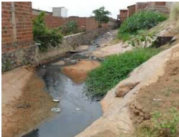
Foto: Galeria lançando esgotos no Riacho Salgadinho
