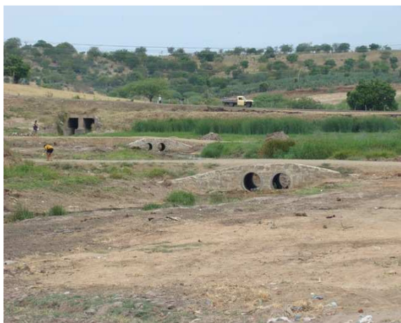
Foto 3: Baixa da Presa vendo-se ao fundo o bueiro sob a BR 407 que causa alagamento na área.
