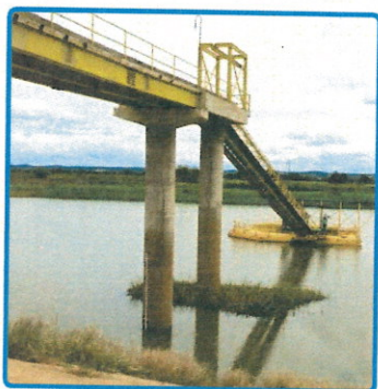
CAPTAÇÃO ADUTORA DO FEIJÃO
