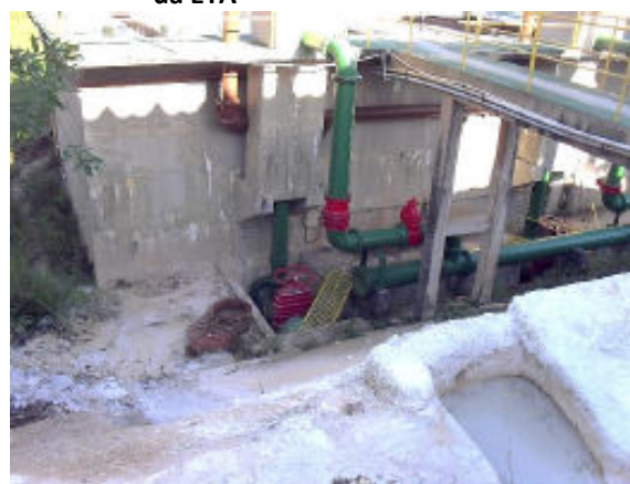
Foto 4.13 - Vista do barrilete de entrada dos filtros da ETA
