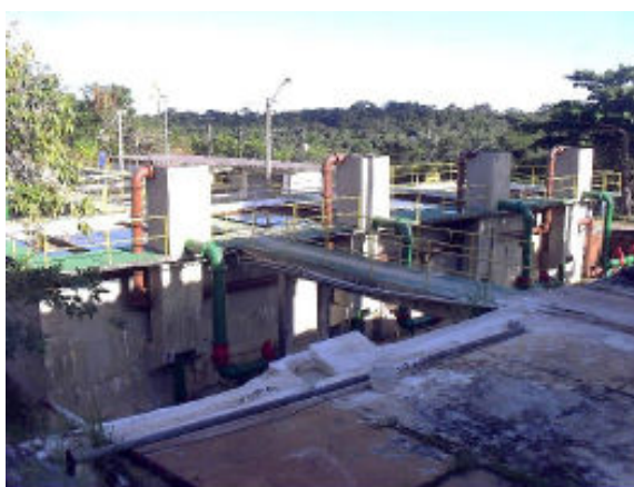
Foto 4.12 - Vista de filtros da ETA
