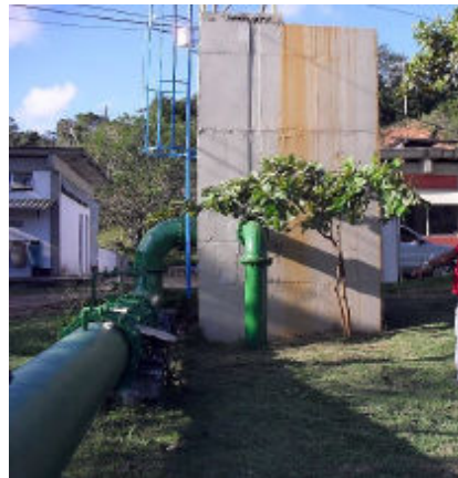
Foto 4.15 - Torre de mistura da ETA
