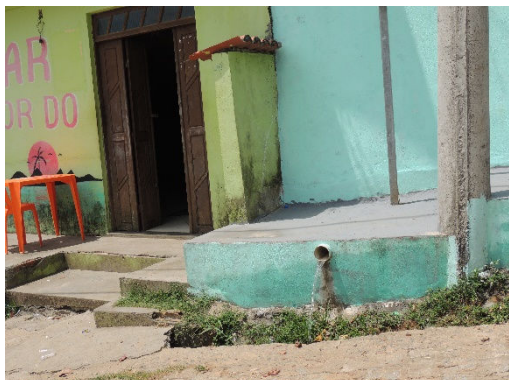
Foto 3.44 - Detalhe de tubulação de água servidas na rua no Povoado de Misericórdia
