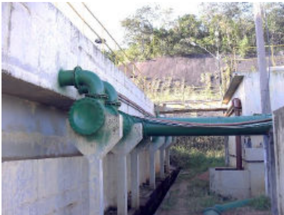
Foto 4.14 - Detalhe da saída da ETA
