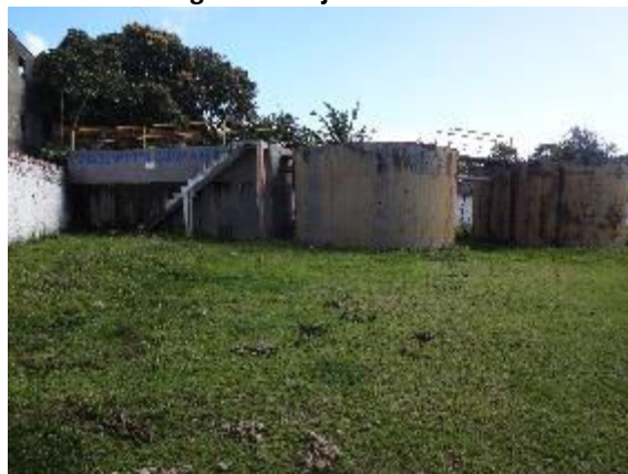
Foto 3.80 - Vista Estação de Tratamento de Esgoto – Conjunto habitacional Urbis
