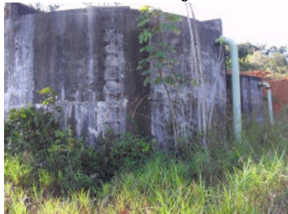
Foto 4.19 - Reservatório de lavagem da ETA
