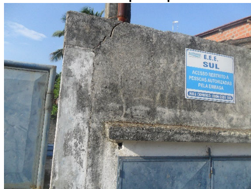
Foto 3.45 - Estação Elevatória de Esgoto – Sul em Alto das Pombas - no qual extravasa para o porto
