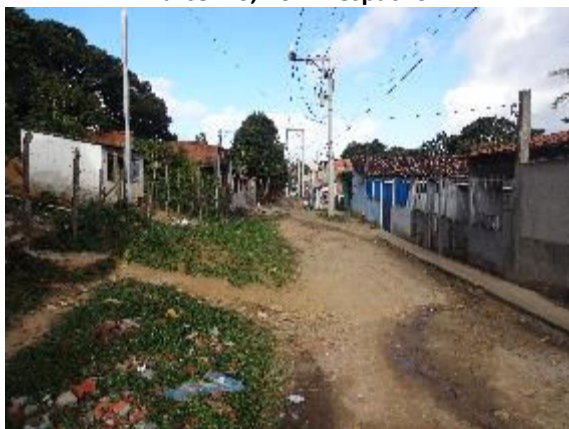
Foto 3.81 - Vista da inexistência de drenagem urbana e de pavimentação em Marcelino, Bom Despacho
