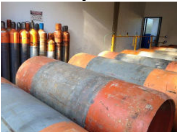
Foto 4.18 - Cilindros de gás cloro
