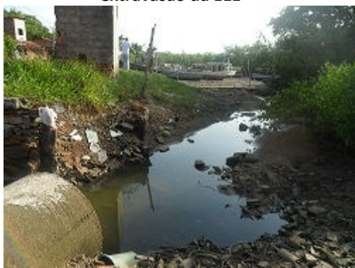
Foto 3.46 - Manilha do Ponto final de lançamento de efluente da Estação Elevatória de Esgoto, no porto do bairro de Alto das Pombas (Mangue seco), quando da ocorrência de extravasão da EEE
