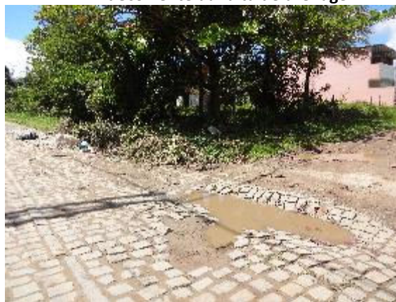
Foto 3.114 - Trecho da Rua Getúlio Vargas com rompimento da pavimentação decorrente da falta de drenagem
