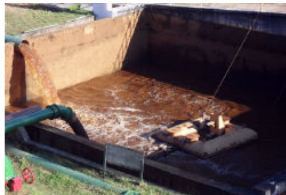
Foto 4.21 - Vista da entrada d'água da ETA
