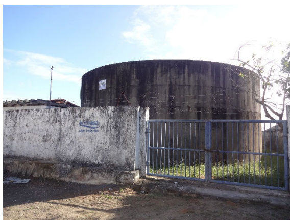
Foto 4.22 - Vista do reservatório existente no bairro do Alto do Santo Antônio – sede de Itaparica
