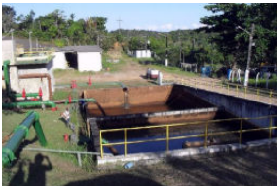
Foto 4.20 - Vista geral dos tanques de decantação da ETA
