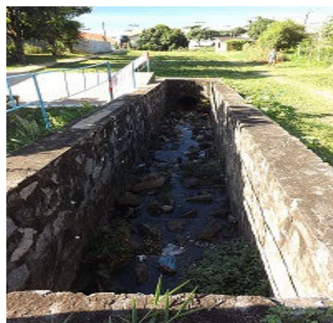
Foto 4.25 - Presença de resíduos no canal de drenagem
