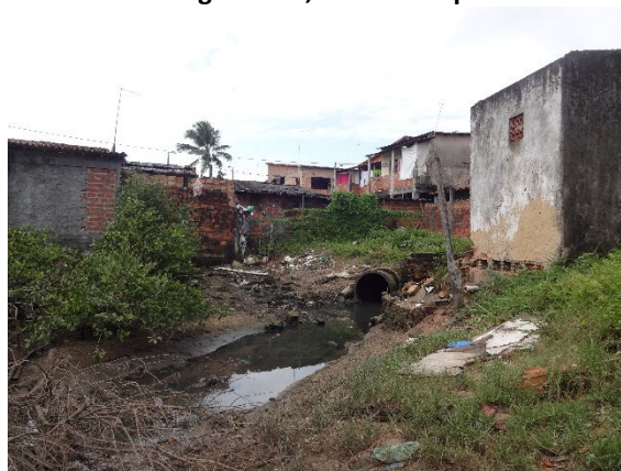
Foto 3.86 - Lançamento de esgoto na ocupação de Mangue Seco, sede de Itaparica
