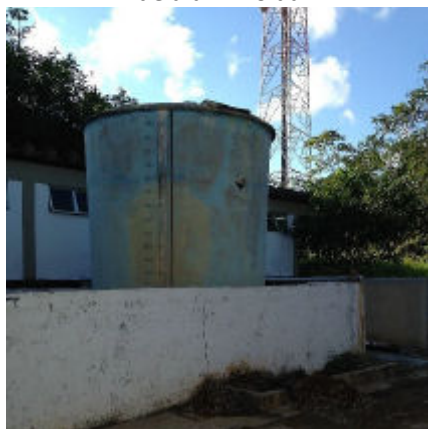
Foto 4.16 - Reservatório de armazenamento do sulfato de alumínio da ETA
