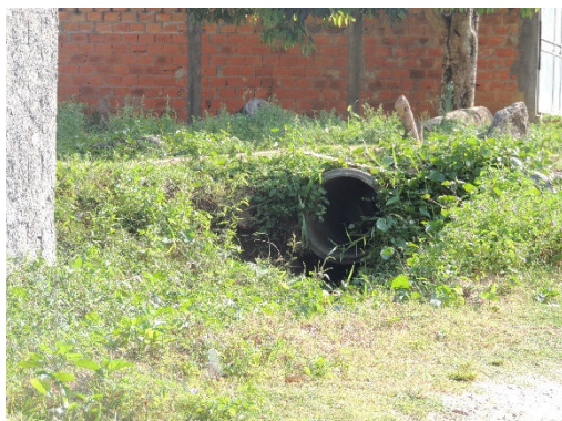
Foto 3.42 - Detalhe de manilha de drenagem na rua de Cima
