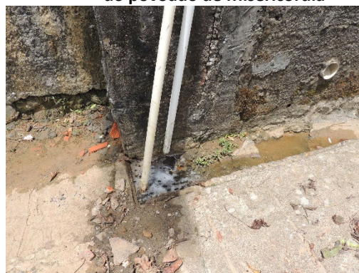
Foto 3.53 - Tubulação despejando em margem de rua de acesso ao cais do povoado de Misericórdia
