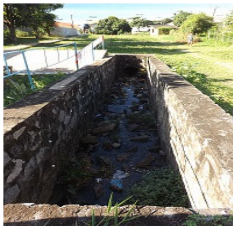
Foto 1.22 - Presença de resíduos no canal de drenagem
