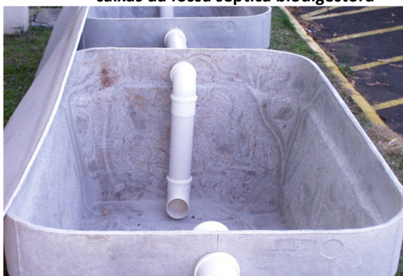
Foto 1.1 - Detalhe da disposição da tubulação nas caixas da fossa séptica biodigestora
