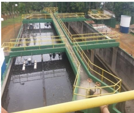
Figura 5.1 – ETE do Sistema Sede de Itacaré.
