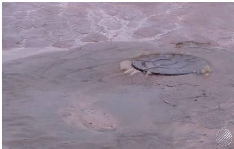
Figura 6.5 – Transbordamento de esgoto no bairro Jardim do Caraípe (Teixeira de Freitas – BA)
