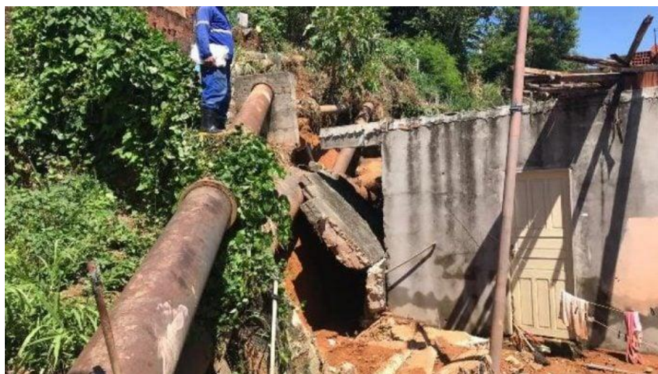
Figura 6.1 - Rompimento de adutora em Ilhéus
