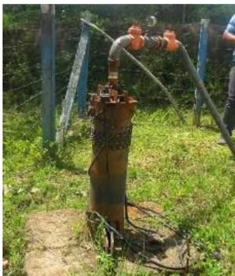
Foto 3.96 - Poço tubular nº. 19.830 localizado no Povoado Riacho do Meio - Pojuca/BA
