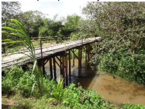
Foto 3.120 - Local do lançamento de esgoto 2 no rio Pojuca – Final da Rua 29 de Julho (Centro) – Sede de Pojuca
