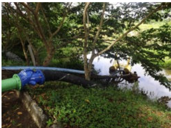
Foto 3.9 - Visão Geral de Captação Flutuante no rio Una
