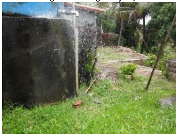
Foto 3.99 - Desperdício da água captada no Reservatório de Abastecimento de Água de Miranga - Pojuca/BA
