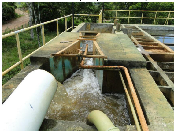
Foto 3.89 - Chegada da água bruta na unidade de mistura rápida (calha Parshall)
