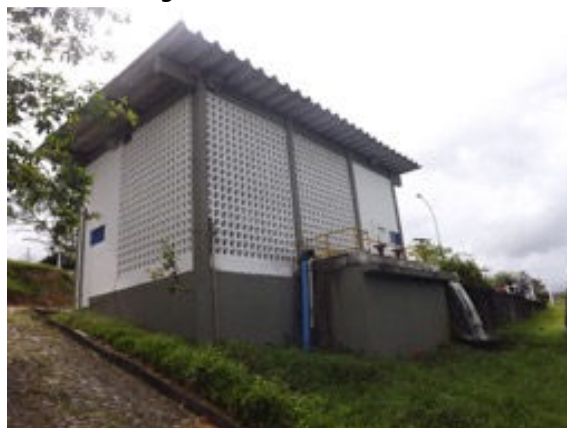
Foto 3.10 - Visão geral de Estação Elevatória de Água Bruta – Casa de Bombas
