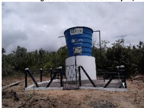
Foto 3.95 - Reservatório de Abastecimento de Água do Povoado Cabiola - Pojuca/BA
