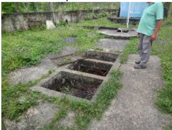
Foto 3.106 - Filtro de sangue sem tela de proteção – Matadouro Municipal – Sede do Município
