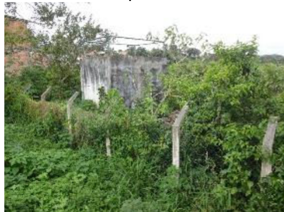
Foto 3.113 - Estação de Tratamento de Esgoto do Bairro de São Francisco (ETE 1) – Sede do Município
