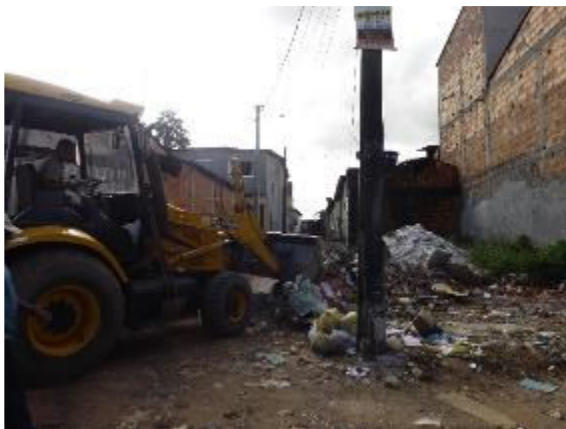
Foto 3.80 - Coleta de descarte irregular no bairro de Cajazeiras – Sede do Município
