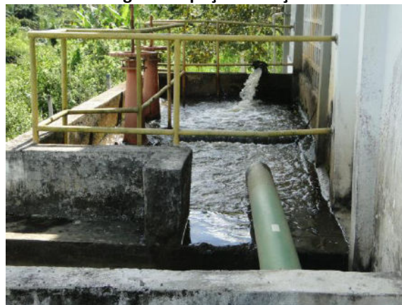
Foto 3.87 - Chegada no poço de sucção da EEAB2
