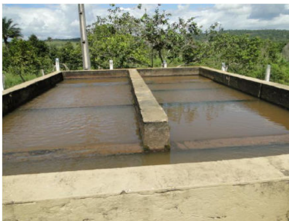
Foto 3.86 - Caixa de areia
