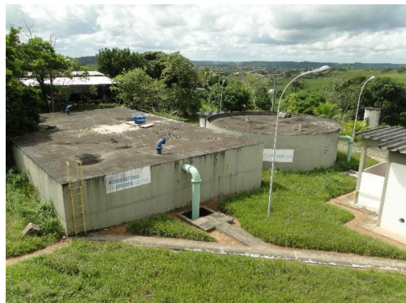
Foto 3.93 - Reservatórios de abastecimento da ETA
