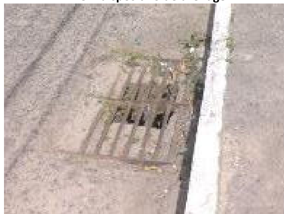
Foto 3.182 - Presença de resíduos e vegetação em dispositivo de drenagem
