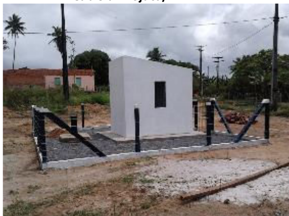
Foto 3.94 - Casa de Bomba localizado no Povoado Cabiola - Pojuca/BA
