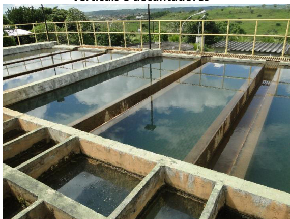
Foto 3.90 - Vista do floculador de chicanas verticais e decantadores
