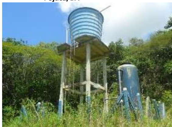
Foto 3.97 - Reservatório elevado de Distribuição (Cap. 20.000 l) / Filtro Removedor de Ferro do Povoado Riacho do Meio - Pojuca/BA
