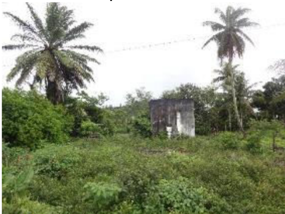
Foto 3.114 - Estação de Tratamento de Esgoto do Bairro Corujão (ETE 2) – Sede do Município
