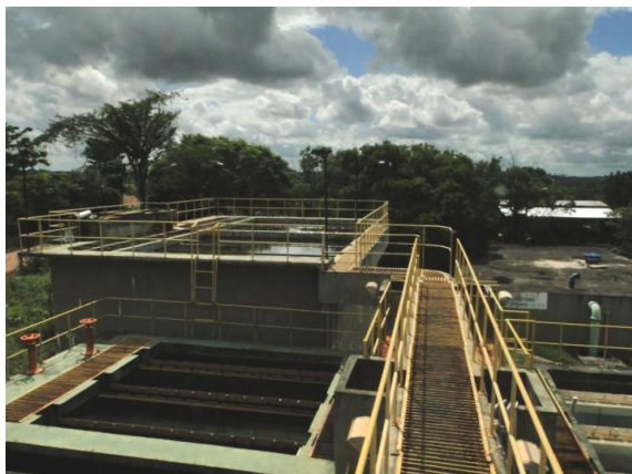
Foto 3.88 - Vista geral da ETA do SAA de Pojuca
