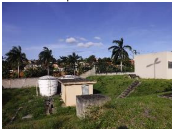
Foto 3.119 - Estação de Tratamento de Esgoto do Hospital Municipal de Pojuca– Sede do Município
