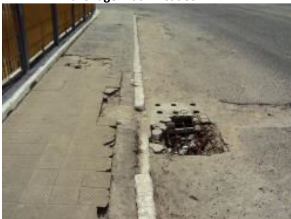
Foto 3.177 - Pavimentação e dispositivo de drenagem danificados
