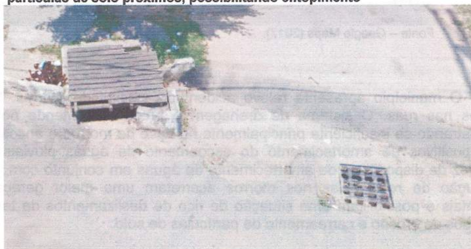
Figura 5 - Dispositivos de drenagem danificados e com resíduos sólidos e partículas de solo próximos, possibilitando entopimento
