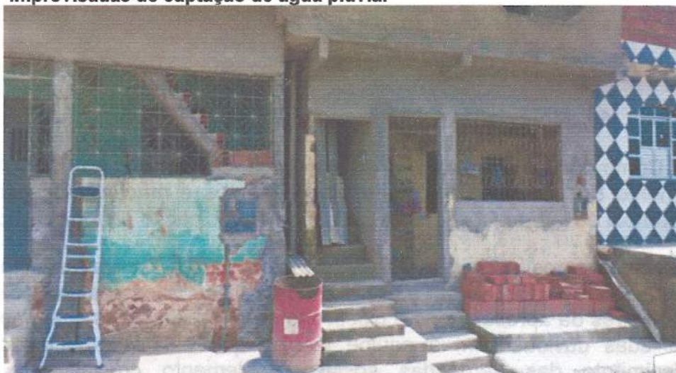
Figura 8 - Existem residências que possuem estruturas precárias e improvisadas de captação de água pluvial
