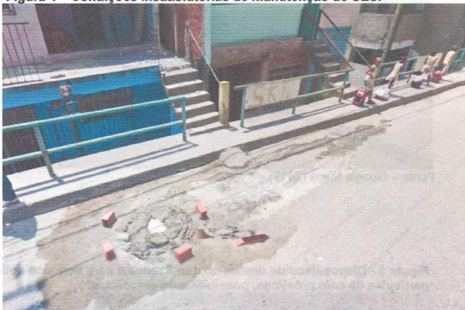
Figura 4 – Condições insatisfatórias de manutenção do SES.
