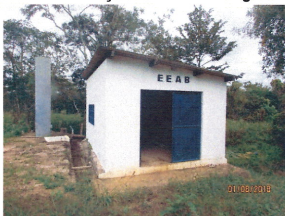
Figura 31 - Casa de bombas da Estação Elevatória de Água Bruta em Utinga (EEAB)
