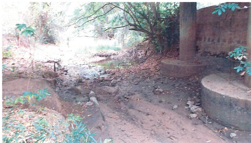
Figura 41 - trecho por onde passa a rodovia BA-164, no município de Wagner, o rio secou e até as estruturas da ponte estão aparentes. Durante o período de chuva, a água chega a atingir mais de 3 metros de altura
