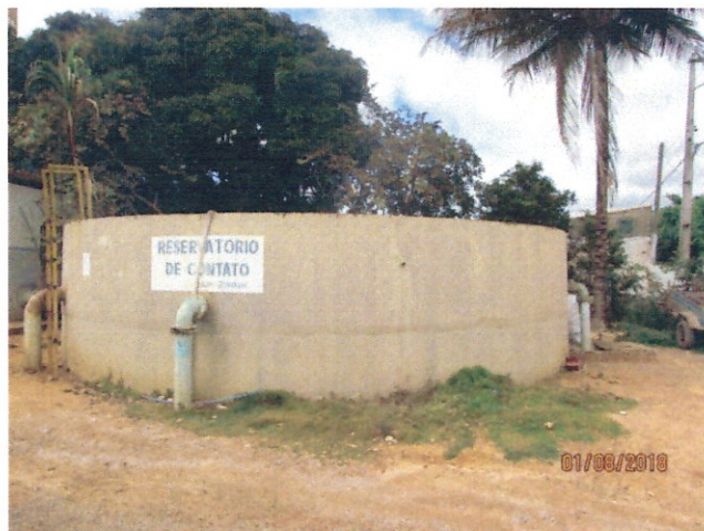
Figura 30 - Reservatório com capacidade de 200m³ no SAA de Utinga
