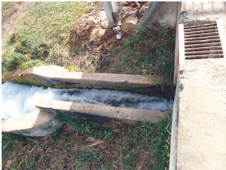
Figura 20 - Tomada com saída para canal para irrigação (canal A)
