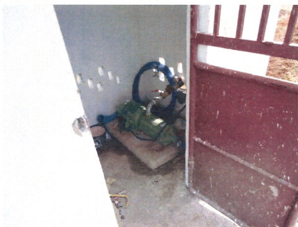
Figura 19 - Interior da casa de bombas com tomada no corpo da barragem para irrigação de áreas mais elevadas
