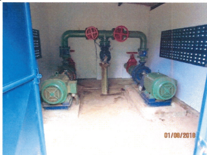
Figura 33 - Interior da casa de bombas da EEAB de Utinga
