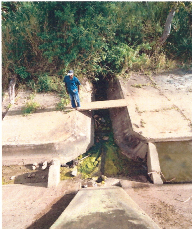
Figura 24 - Estado precário das canaletas de restituição – secas quando todas as tomadas estão totalmente abertas na estiagem (foto anterior às obras de recuperação do maciço)
