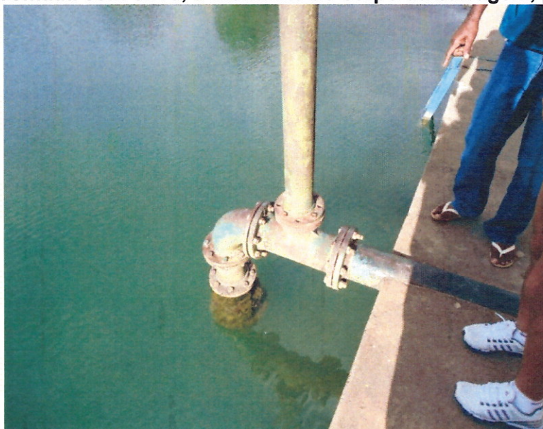
Figura 22 - Tomada com crivo, à montante do corpo da barragem, para adutora
