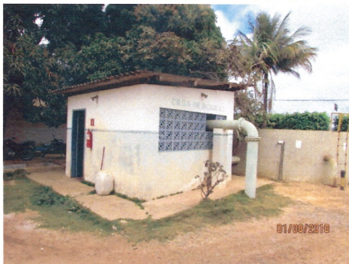
Figura 37 - Casa de bombas existente na ETA de Utinga
