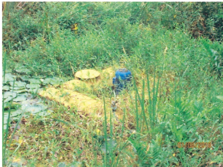
Figura 32 - Vista da Captação Flutuante instalada no Rio Utinga
