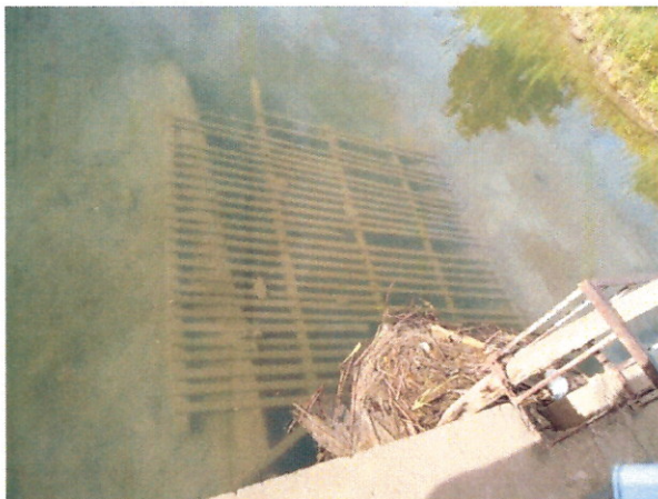
Figura 17 - Grelha na saída de canal de irrigação regulado por comporta
