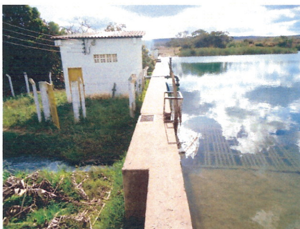
Figura 18 - Casa de bombas de sistema de irrigação
