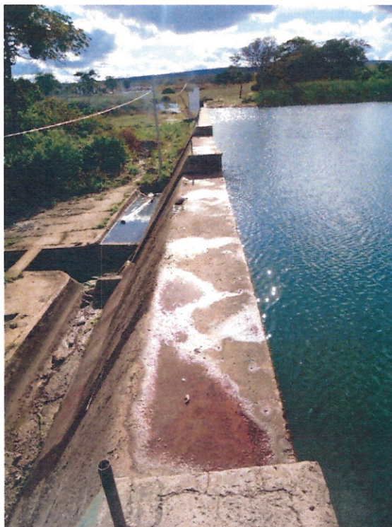
Figura 23 - Estado dos vertedouros, com pouca água vertendo – situação que acontece quando todas as comportas e tomadas estão abertas (foto anterior às das obras de recuperação do corpo da barragem)
