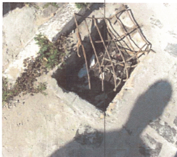
Figura C.3.1 – Estrutura de drenagem entupida e danificada em área de alagamento.
