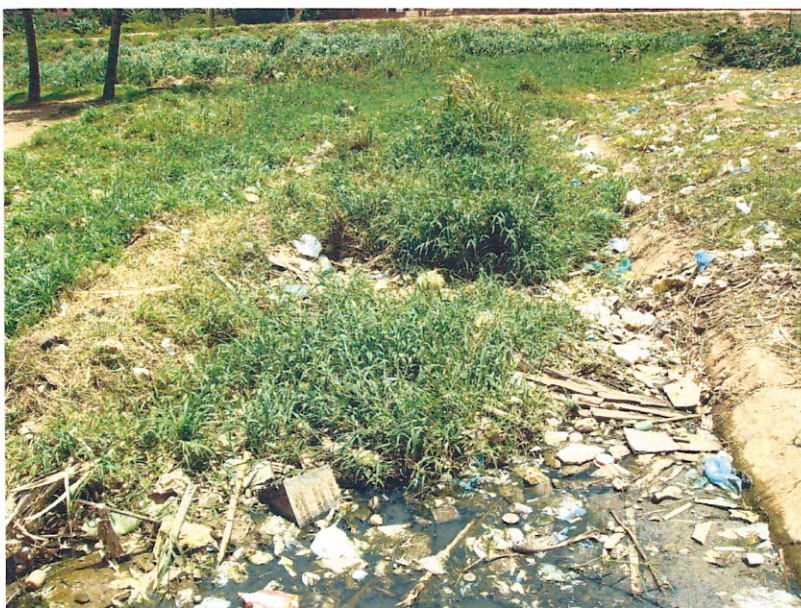
Figura 13 – Córrego existente nas imediações da Av. Gal Costa assoreado por resíduos sólidos e vegetação. Tal situação evidencia a carência de manutenção no sistema de drenagem.
