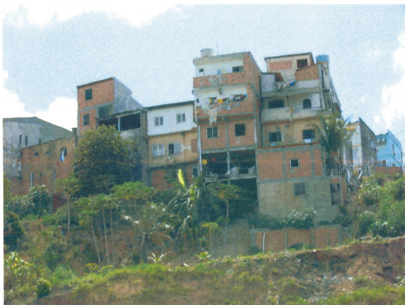
Figura 17 – Encosta irregularmente ocupada, onde é possível ver corte realizados na mesma.
