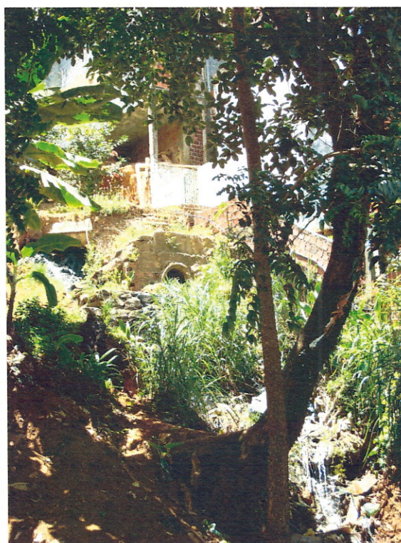
Figura 10 – Área de encosta sem qualquer tipo de contenção, pode-se observar que, em virtude da ausência de sistema de coleta, o esgoto é lançado diretamente no corpo do talude.
