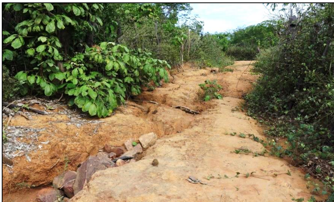
FIGURA 8 - EXEMPLO DE ÁREA DE EROSÃO VISTORIADA NA ÁREA DA BARRAGEM LAJINHA.
