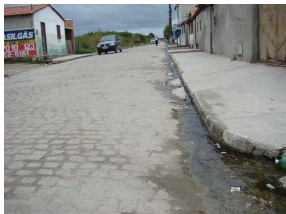
Foto 6: Ponto de lançamento de esgoto a céu aberto – Rua Joviniano Martins dos Santos com a Rua João Guilhermino – Bairro Jaqueira.
