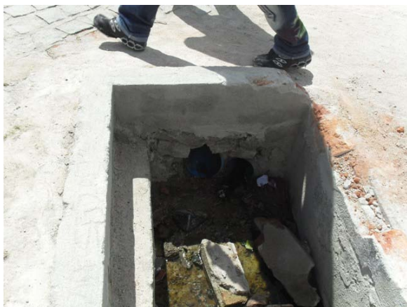
Foto 3: Caixa de passagem de drenagem da lagoa do hospital com presença de esgoto – Av. Bezerra de Menezes.
