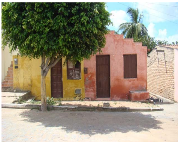
Foto 1: Área Crítica – com relatos de desabamentos.
