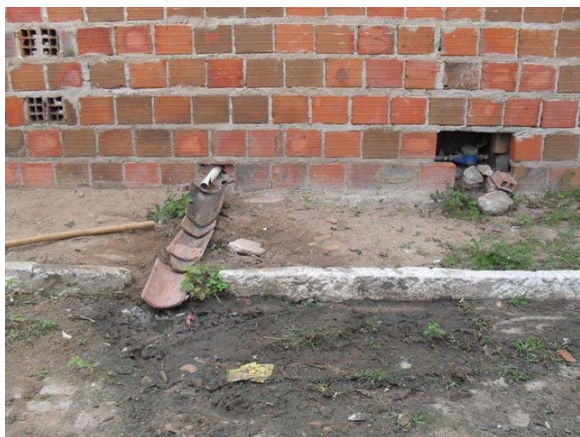
Foto 1: Lançamento de esgoto a céu aberto na sarjeta – Rua Mané Garrincha.
