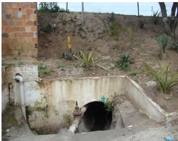
Foto 7: Caixa que causa inundação na Rua D. Pedro II – Bairro Ginásio – paralela à BA-116 (norte).
