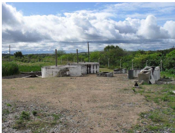
Foto 4: Vista da ETE.
