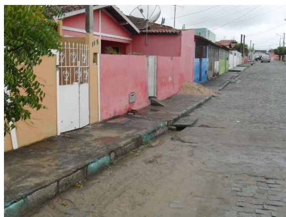
Foto 10: Área Crítica de alagamento – Rua Santa Maria.
