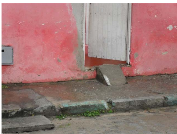
Foto 11: Área Crítica de alagamento – Rua Santa Maria – casa com proteção.
