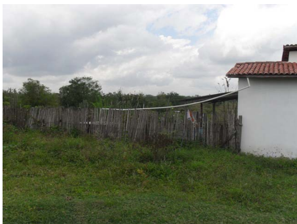
Foto 9: Aproveitamento de água de chuva – cisterna.
