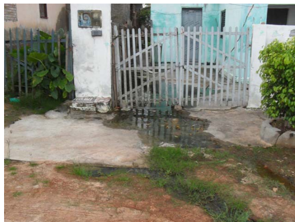
Foto 14: Lançamento de esgoto secundário e águas pluviais a céu aberto – Travessa Tancredo Neves.
