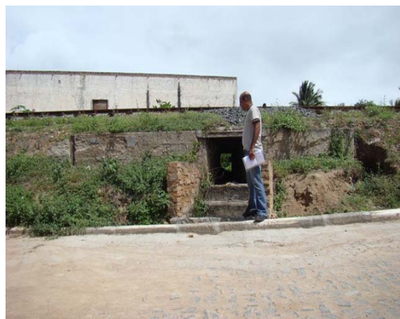
Foto 4: Área Crítica – com relatos de desabamentos.
