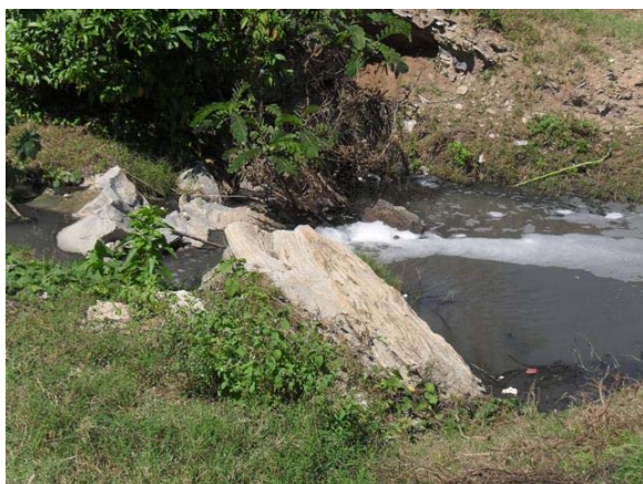
Foto 5: Bueiro sob a Av. Contorno – lançamento de esgoto a céu aberto para o Açude.
