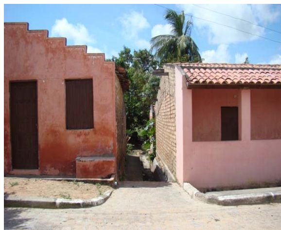
Foto 2: Área Crítica – com relatos de desabamentos.
