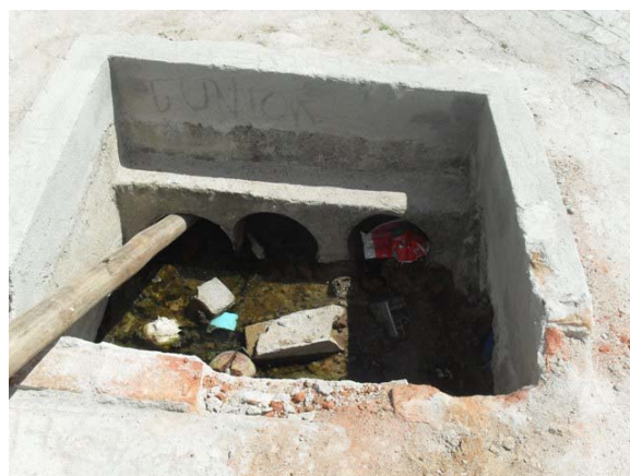
Foto 6: Caixa de passagem de drenagem da Lagoa do Hospital – Av. Bezerra de Menezes.
