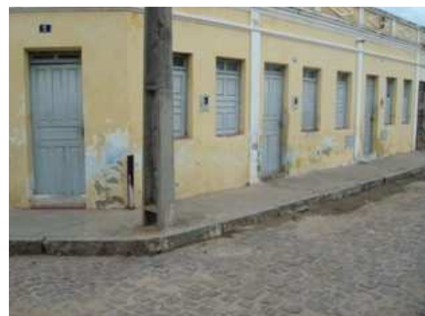
Foto 18: Rua Augusto Moura – alagamento
