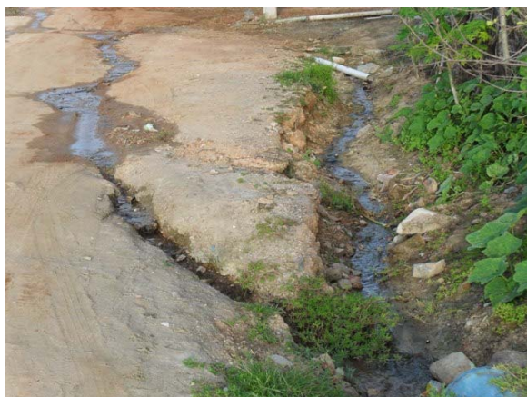
Foto 9: Lançamento de esgoto secundário a céu aberto – Rua da Caixa D'água.
