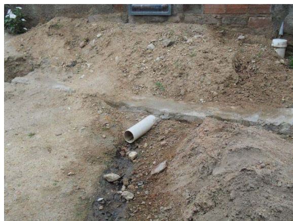
Foto 4: Lançamento de esgoto a céu aberto – Rua Travessa Adelidio Santos.
