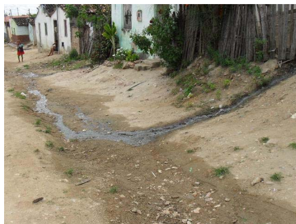
Foto 4: Esgoto a céu aberto – Rua M – bairro Cascalheira.
