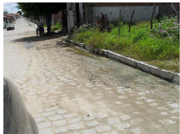
Foto 12: Lançamento a céu aberto na sarjeta – Rua Vitorino da Silva.
