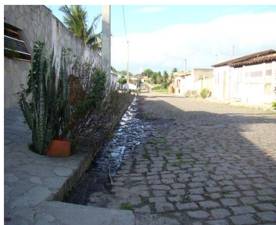
Foto 4: Presença de esgoto secundário pela sarjeta.
