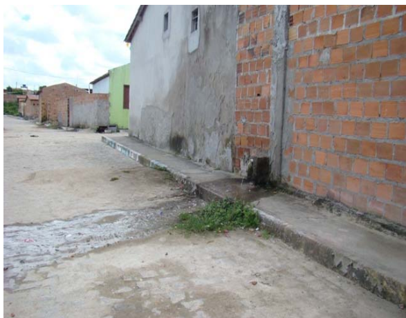
Foto 9: Ponto de lançamento de esgoto secundário a céu aberto – Travessa Princesa do Agreste.
