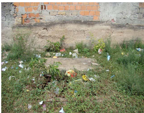
Foto 3: Caixa coletora de águas pluviais no Tanque Velho – próximo a Rua Antônio João Nader.
