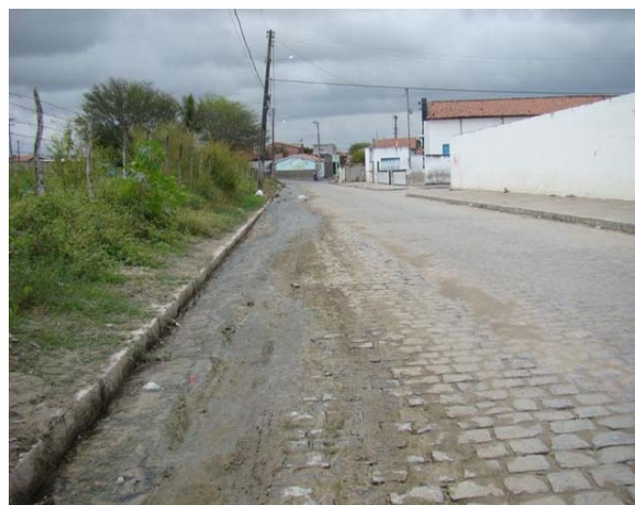
Foto 4: Esgoto a céu aberto – Rua Zacarias Alves.
