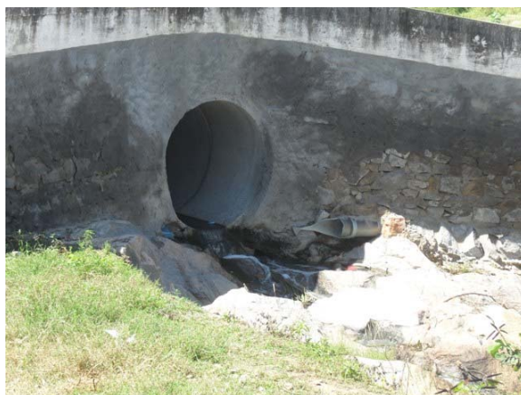
Foto 4: Bueiro sob a Av. Contorno – lançamento de esgoto a céu aberto para o Açude.
