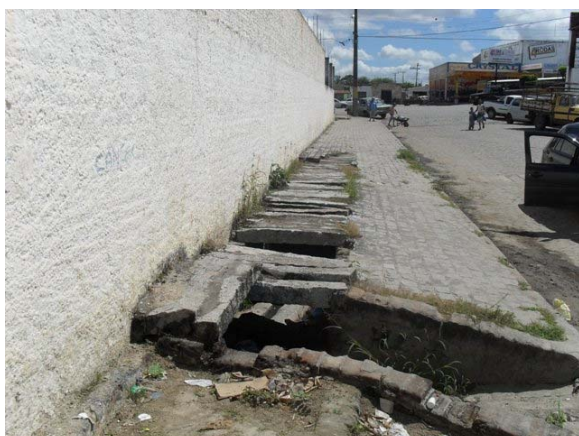
Foto 11: Galeria da Rua Ferreirinha com presença de esgoto.
