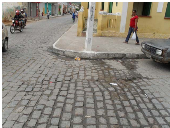
Foto 2: Calçamento mal definido das ruas.
