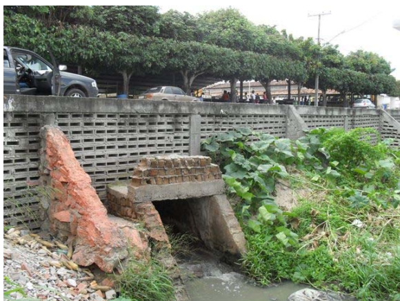
Foto 9: Lançamento de esgoto a céu aberto – Rua Banco de Areia.
