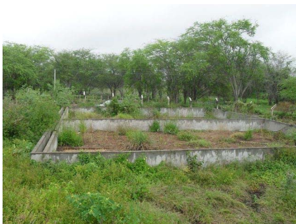
Foto 3: Leito de secagem de lodo da ETE – sem operação.
