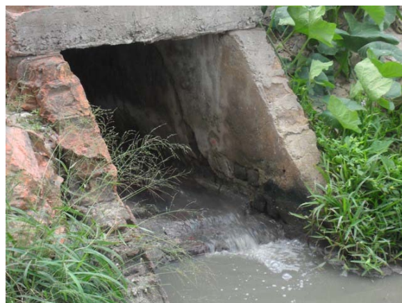
Foto 10: Lançamento de esgoto a céu aberto – Rua Banco de Areia.
