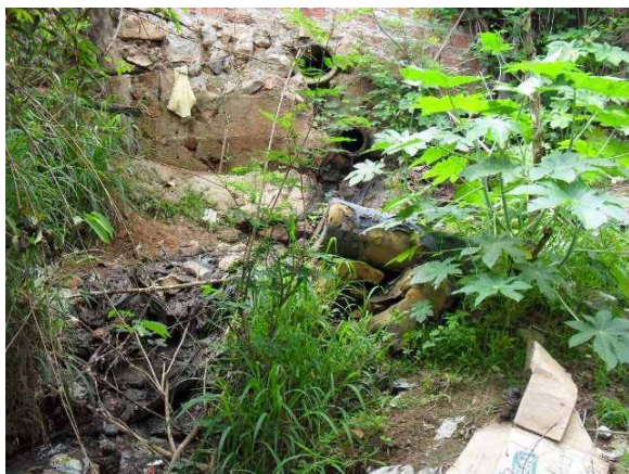
Foto 1: Lançamento de esgoto no Bairro Cascalheira – Rua Bom Viver (fundos).
