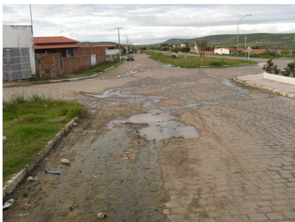
Foto 9: Escoamento de águas pluviais pela pavimentação – Av. Tancredo Neves.
