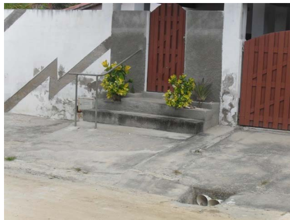
Foto 2: Área de alagamento – Rua Antonio Lopes.
