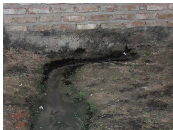
Foto 12: Lançamento de esgoto secundário a céu aberto – Travessa Tancredo Neves.
