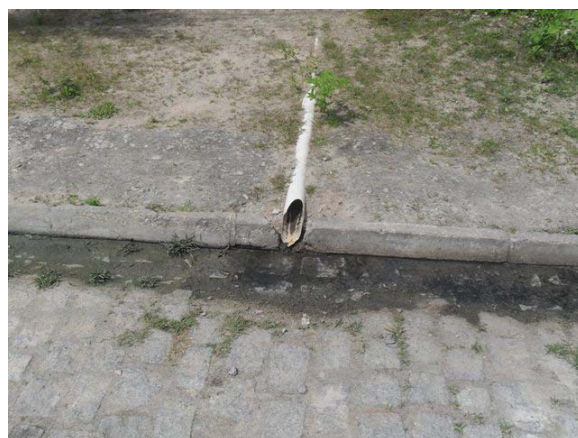
Foto 6: Lançamento individual de esgoto secundário a céu aberto.
