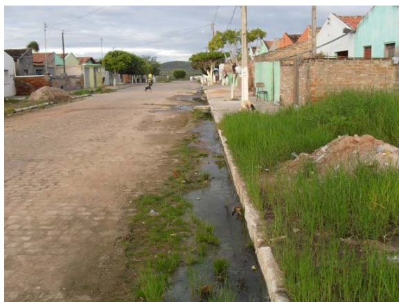
Foto 4: Sarjeta com presença de esgoto secundário – Rua Manoel Fidelis.
