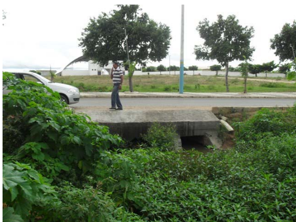
Foto 5: Bueiro – Av. Luis Eduardo Magalhães.
