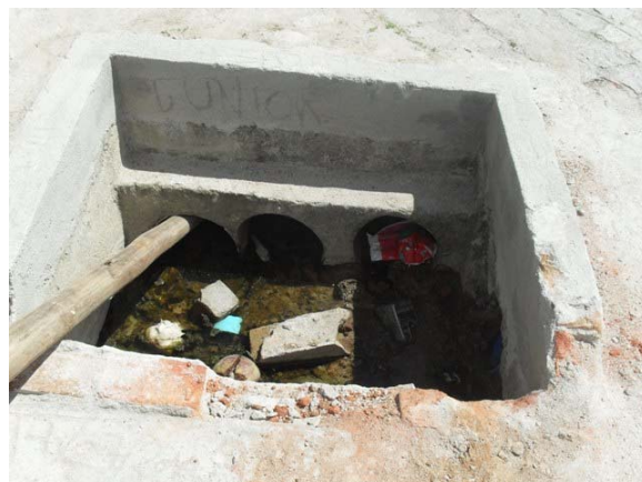
Foto 2: Caixa de passagem de drenagem da lagoa do hospital com presença de esgoto – Av. Bezerra de Menezes.
