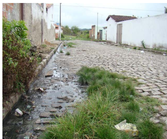
Foto 6: Esgoto secundário a céu aberto – 1ª Travessa José Rufino.
