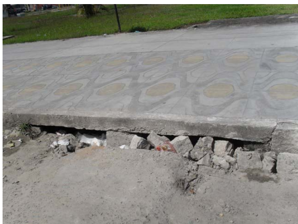
Foto 3: Boca de lobo obstruída – Praça Monsenhor Berenguer.
