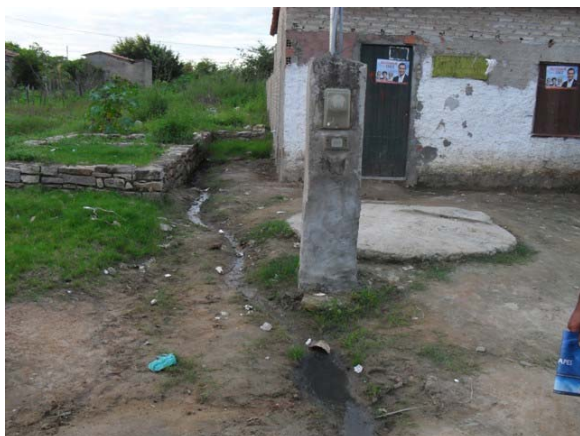
Foto 13: Lançamento de esgoto secundário a céu aberto – Travessa Tancredo Neves.
