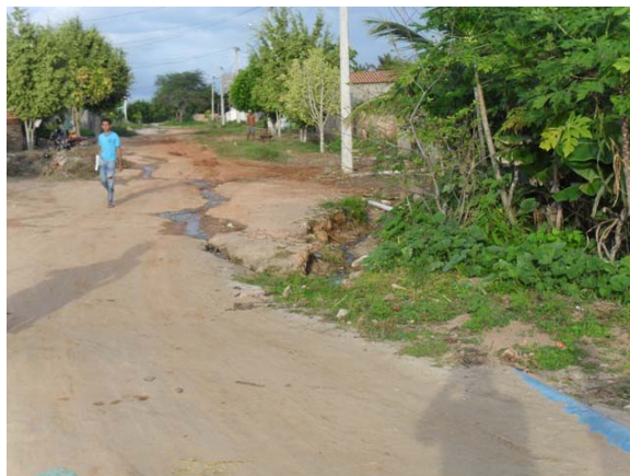
Foto 2: Lançamento de água pluvial e esgoto secundário a céu aberto – Rua da Caixa D'água.
