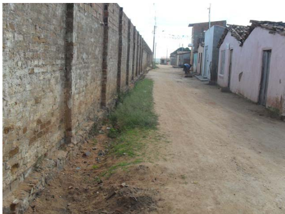
Foto 1: Rua atrás do campo – Área Crítica de alagamento.
