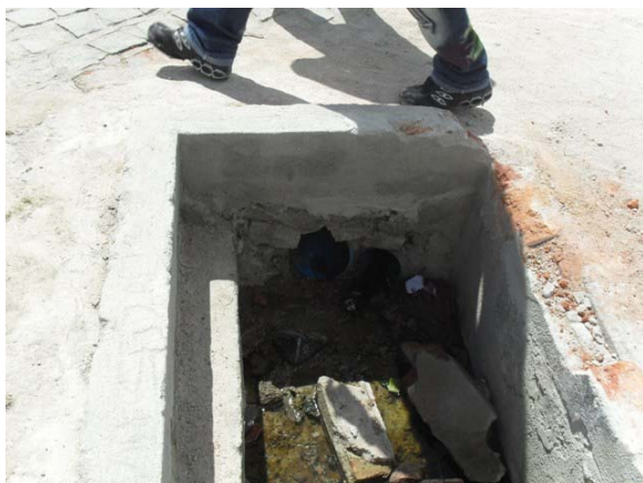
Foto 7: Caixa de passagem de drenagem da Lagoa do Hospital – Av. Bezerra de Menezes.
