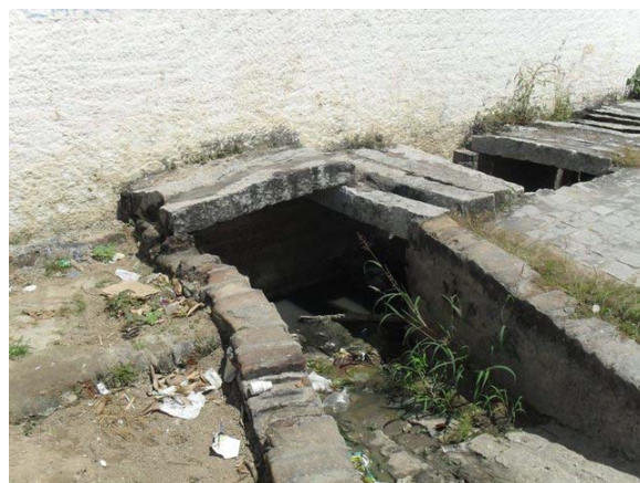
Foto 10: Galeria da Rua Ferreirinha com presença de esgoto.
