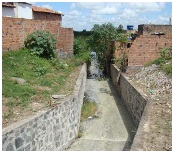
Foto 3: Galeria – Rua 1º de Janeiro – com bomba.
