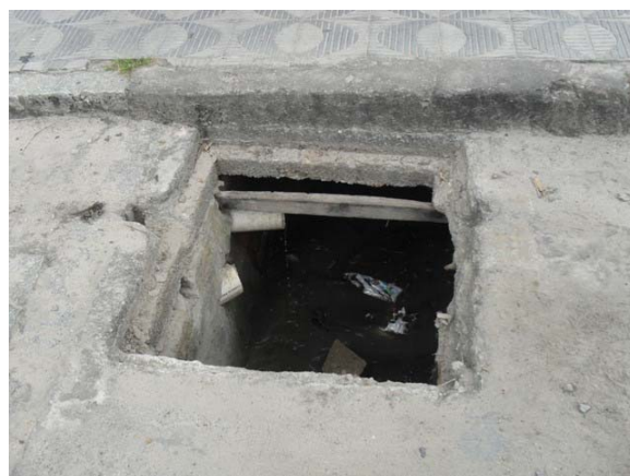
Foto 6: Caixa de rua sem proteção – Rua Castelo Branco.
