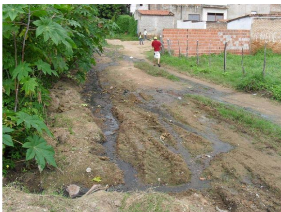
Foto 3: Lançamento de esgoto secundário e águas pluviais a céu aberto – Rua Monsenhor José Dias.
