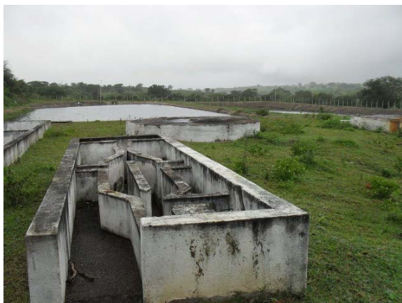
Foto 1: Caixa de areia da ETE.
