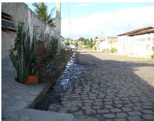
Foto 9: Esgoto secundário a céu aberto – Rua Joaquim Cordeiro.
