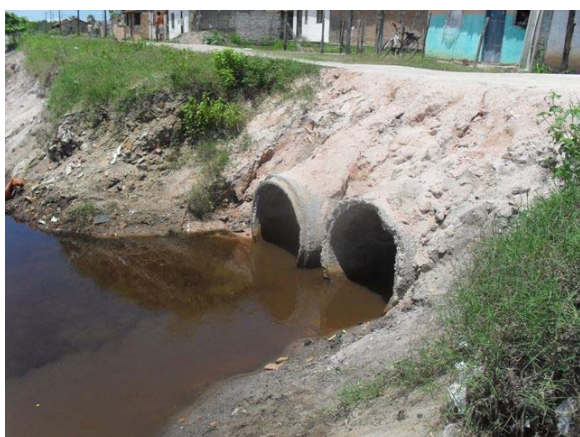
Foto 5: Trecho sem revestimento do Canal do São Braz.
