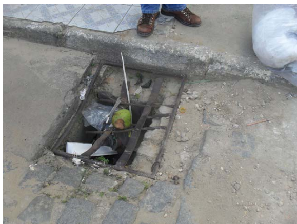
Foto 15: Área Crítica 8 – Rua José de Anchieta – área de alagamento. Observa-se elemento de drenagem com muito lixo e danificado.
