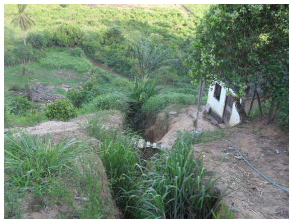
Foto 16: Área Crítica 9 – Rua Bonifácio Dantas – área de erosão.
