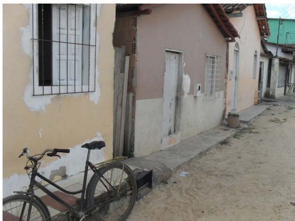
Foto 7: Área Crítica 2 – Rua Santo André com a Rua Clemente Souza – área de enxurrada.
