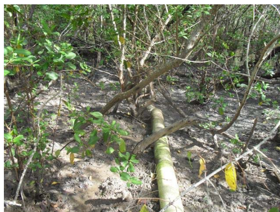
Foto 12: Lançamento direto de esgoto no mangue convergente ao Rio Mucuri.
