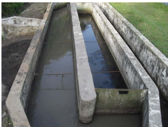
Foto 3: Caixa de areia na entrada da ETE.
