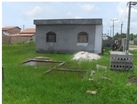
Foto 20: Área Crítica 5 – Rua São Judas Tadeu – Bairro Morais – área de alagamento.
