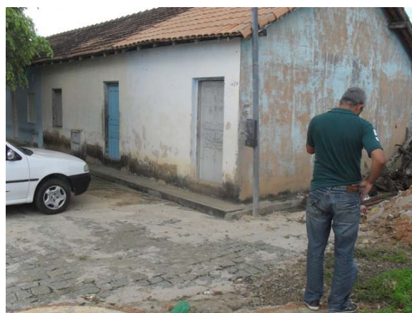
Foto 4: Área Crítica 2 – Fundo do Estádio Municipal – erosão.
