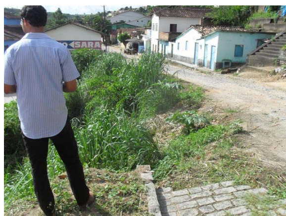
Foto 12: Área Crítica 4 – Rua Esbela Costa – área de erosão.
