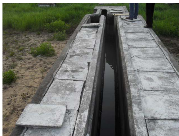
Foto 4: Visão geral do tratamento preliminar da ETE.
