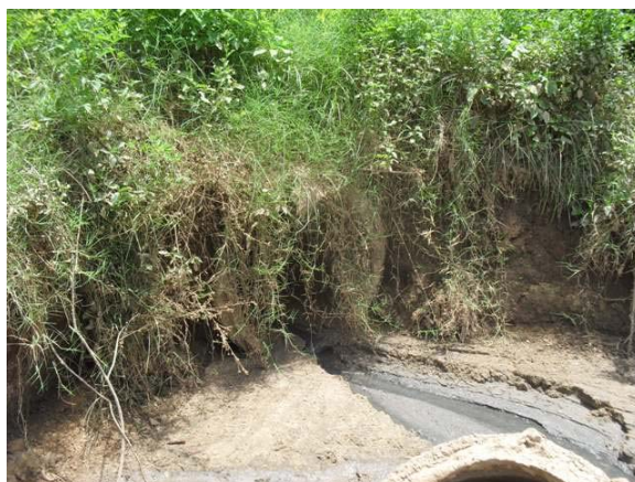
Foto 4: Lançamento de efluentes provenientes da rede mista no Rio Jucuruçu.
