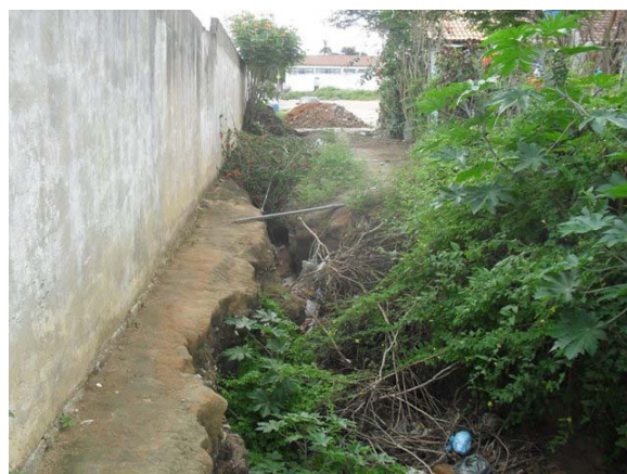
Foto 6: Área Crítica 2 – Fundo do Estádio Municipal – erosão.
