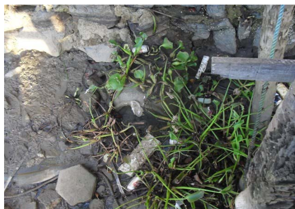
Foto 7: Ponto de lançamento de drenagem – escoamento para o Rio Alcobaca.
