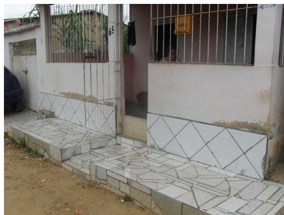
Foto 20: Área Crítica 12 – Rua Bahia – área de alagamento.
