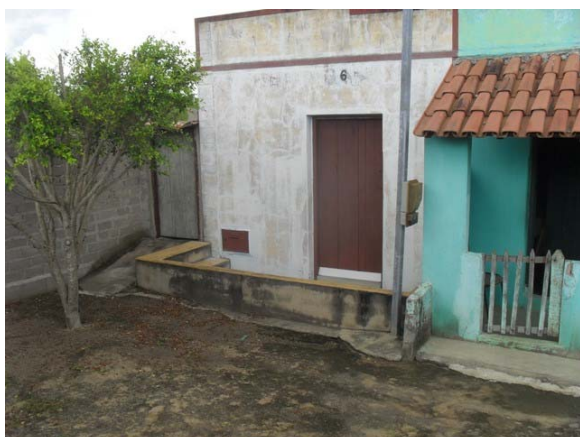
Foto 5: Área Crítica 2 – Fundo do Estádio Municipal – erosão.
