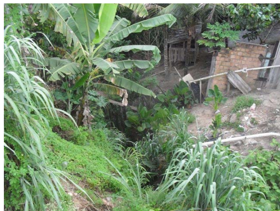
Foto 8: Área Crítica 3 – Rua Santo Antônio do Monte – área de erosão.
