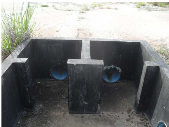
Foto 1: Caixa de contribuição da ETE nova.
