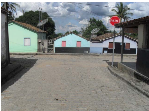
Foto 1: Área Crítica 1 – Rua Antonio Rocha Mota – área de enxurrada.
