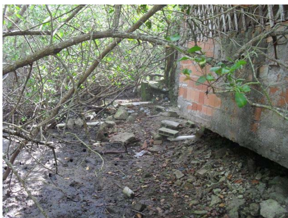
Foto 11: Lançamento direto de esgoto no mangue convergente ao Rio Mucuri.
