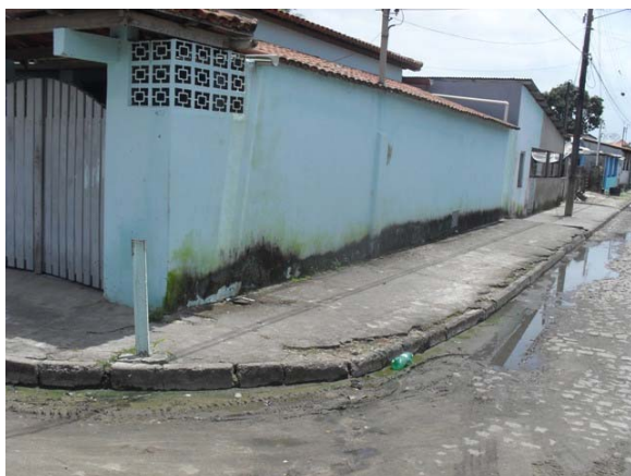
Foto 15: Área Crítica 3 – Rua das Palmeiras – bairro Nova Coréia – área de alagamento.
