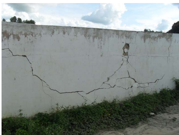
Foto 3: Área Crítica 2 – Fundo do Estádio Municipal – erosão.
