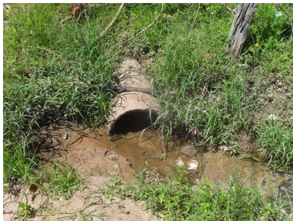
Foto 2: Saída da galeria circular de microdrenagem.
