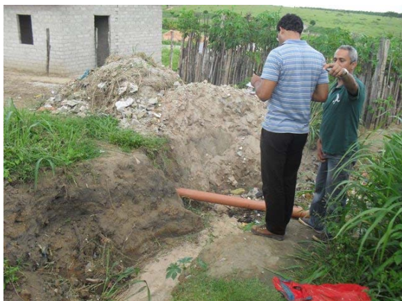
Foto 1: Esgotos sendo lançados no fundo do estádio municipal.
