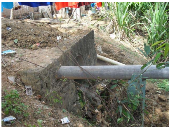
Foto 1: Águas residuais sendo lançadas no Córrego provenientes da microdrenagem.
