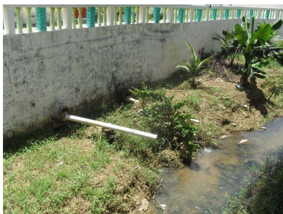
Foto 6: Lançamento direto de esgoto no Córrego do Chumbo.
