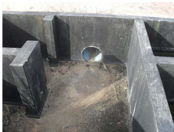
Foto 2: Caixa de contribuição da ETE nova.
