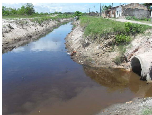
Foto 6: Trecho sem revestimento do Canal do São Braz.
