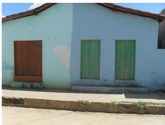
Foto 4: Área Crítica 1 – Avenida Sadi Teixeira – área de alagamento.
