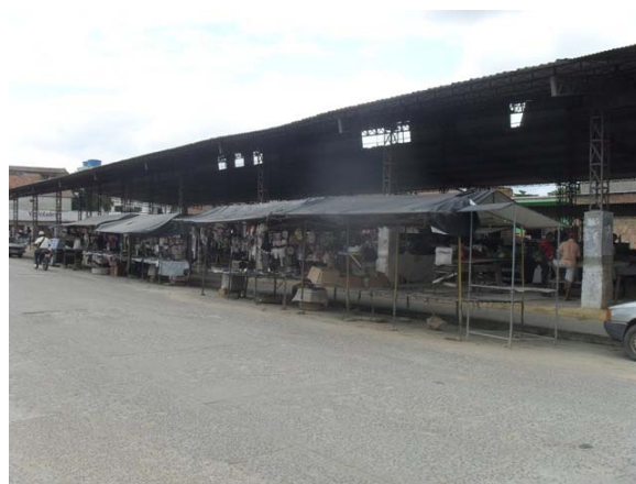
Foto 24: Área Crítica 14 – Praça do Mercado Municipal – área de alagamento.
