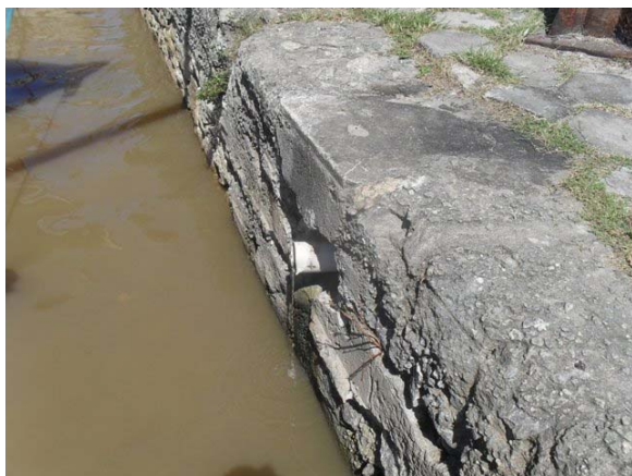
Foto 1: Lançamento difuso de esgotos no Rio Peruípe.
