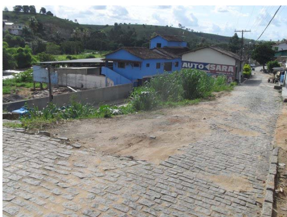
Foto 11: Área Crítica 4 – Rua Esbela Costa – área de erosão.
