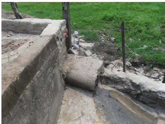
Foto 1: Águas residuárias provenientes da drenagem.
