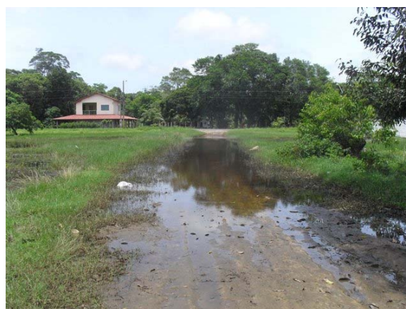
Foto 18: Área Crítica 4 – Rua 5 - Loteamento Vila Franca – área de alagamento.
