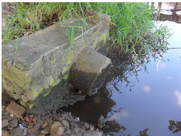
Foto 1: Lançamento de águas residuais no Rio Jucuruçu.
