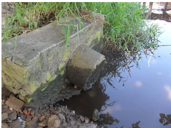
Foto 7: Trecho sem revestimento do Canal do São Braz.
