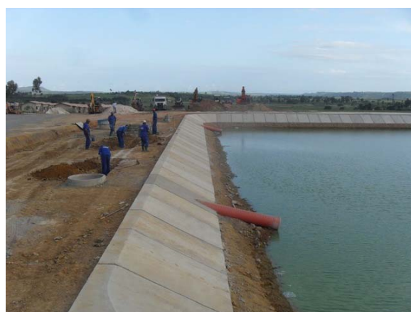
Foto 6: Lagoas construídas do novo SES.
