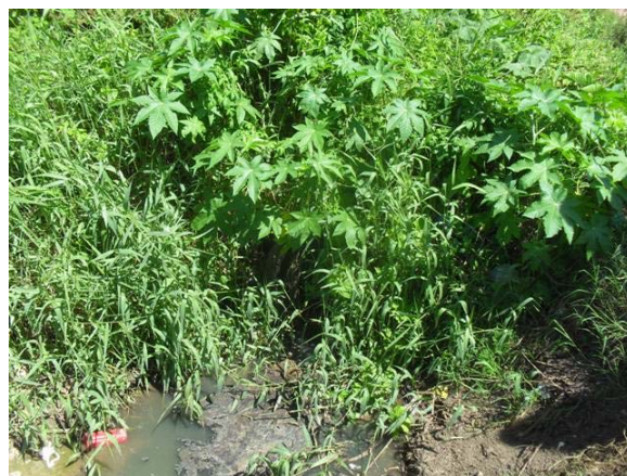
Foto 4: Saída de manilha DN 1000 mm com contribuições de esgoto secundário.
