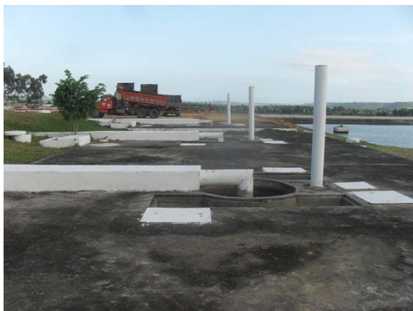
Foto 1: DAFAs construídos na nova ETE.
