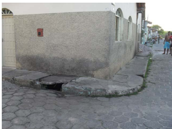
Foto 6: Boca de lobo necessitando reparação.
