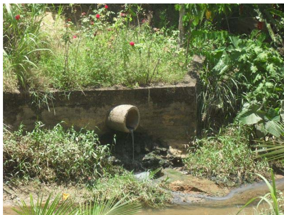
Foto 2: Lançamento de efluentes provenientes da rede mista no Córrego do Chumbo.
