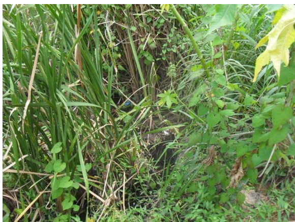
Foto 3: Ponto de lançamento concentrado de esgoto.
