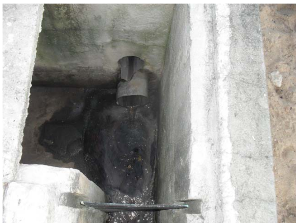
Foto 1: Aspecto geral do afluente da ETE.
