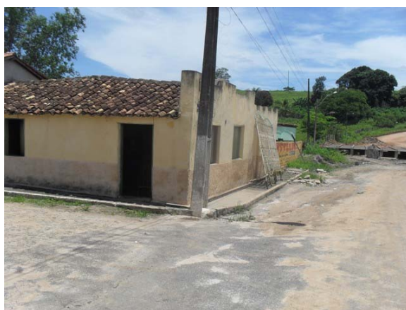
Foto 4: Área Crítica 2 – Rua Dr. José da Cruz – área de enxurrada.
