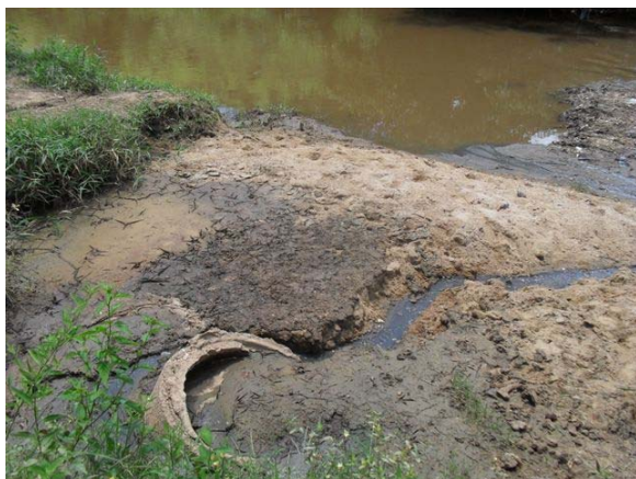
Foto 1: Lançamento de efluentes provenientes da rede mista do Córrego do Chumbo.
