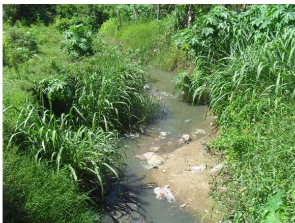
Foto 5: Saída de manilha DN 1000 mm com contribuições de esgoto secundário.
