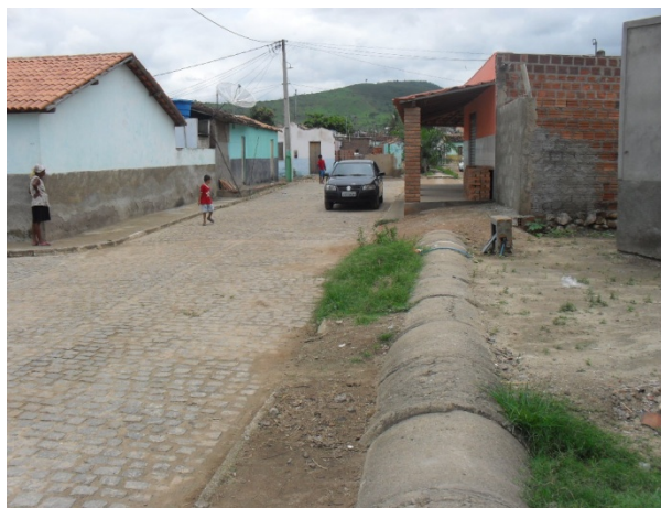
Foto 15: Rua Humberto de Campos. A rede de macrodrenagem que recebe esgoto sanitário segue com tubulação exposta ao longo de um trecho significativo.
