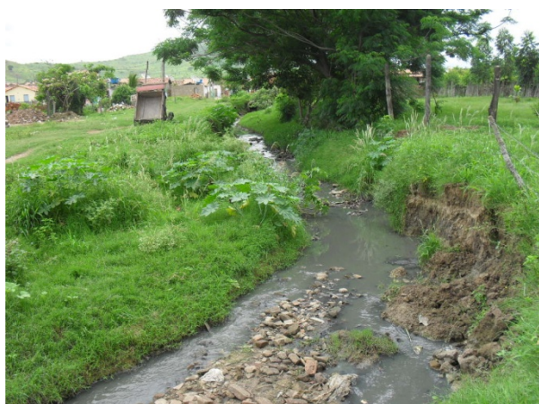
Foto 3: Após o local de lançamento da rede de macrodrenagem da rua Humberto de Campos que transporta que também esgoto, os efluentes escoam a céu aberto até o Rio Maiquinique.
