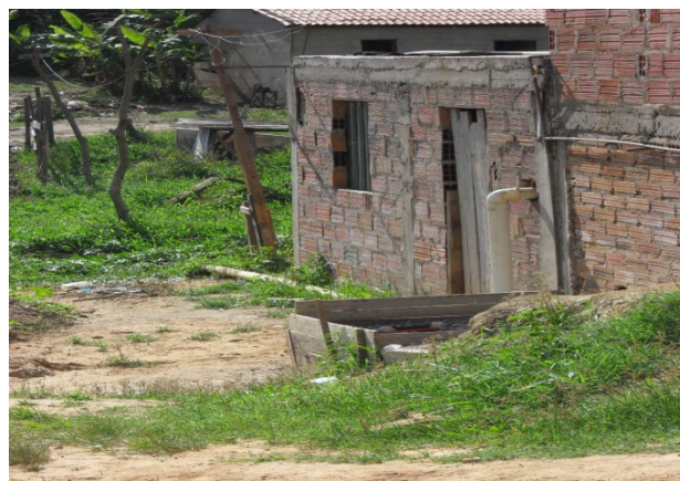
Foto 12: Casas próximas a BA – 262. Mesmo com a rede coletora existente algumas residências ainda lançam o esgoto a céu aberto no quintal.
