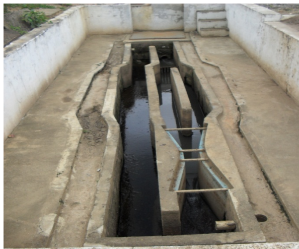
Foto 2: Detalhe dos elementos que realizam o pré-tratamento. Gradeamento, caixa de areia dupla com by pass e medidor de vazão tipo Parshall.
