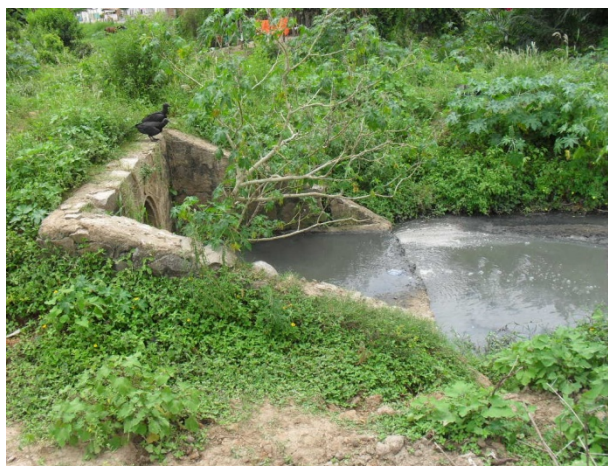
Foto 5: Ponto de lançamento de esgotos sanitários e águas pluviais da rede coletora no Rio de Areia. Galeria circular de concreto de 1000 mm de diâmetro.
