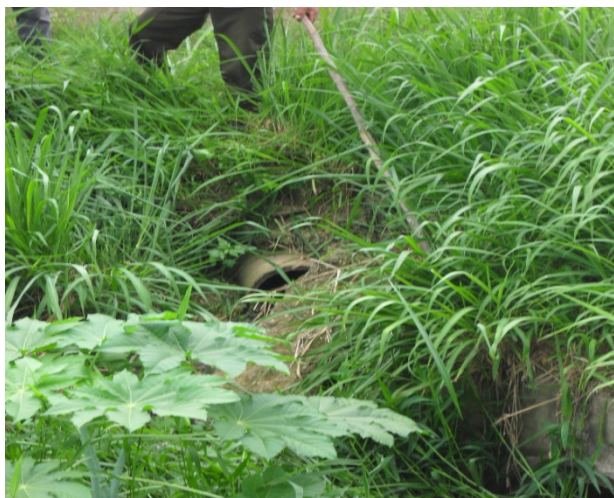
Foto 1: Avenida Itabuna. Ponto de lançamento de esgotos sanitários e águas pluviais da rede coletora no Rio de Dentro. Tubulação de concreto de 300 mm de diâmetro.
