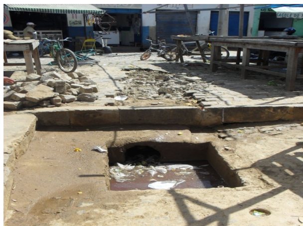
Foto 4: Boca de lobo obstruída devido aos resíduos da feira jogados nela. Local em que se prevê uma substituição da tubulação para melhorar o escoamento da região.
