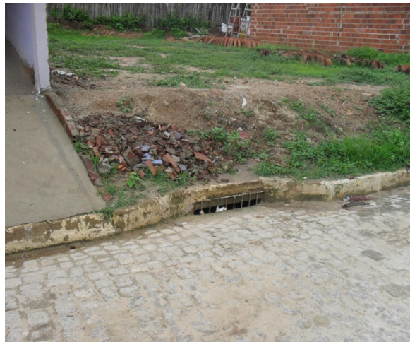
Foto 20: Avenida Tancredo Neves. Outro tipo de dispositivo de drenagem superficial utilizado nas ruas cidade.
