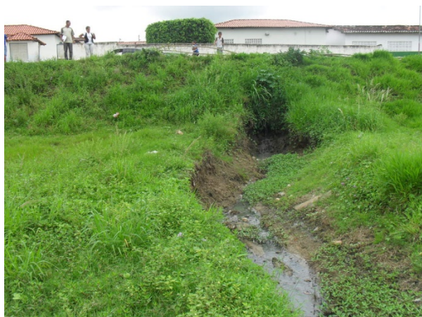
Foto 3: Avenida Antônio Carlos Magalhães. Ponto de lançamento de esgotos sanitários e águas pluviais no terreno que deságua no Córrego da Mijada. Tubulação de concreto de 400 mm de diâmetro.
