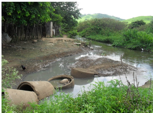
Foto 1: Ponto de lançamento de esgotos sanitários e águas pluviais da rede coletora no Rio Riachão. Tubulação de concreto de 1000 mm de diâmetro.
