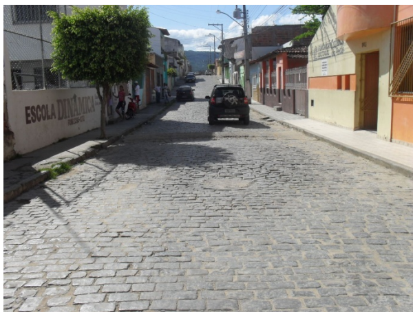
Foto 9: Rua Rui Barbosa. Área crítica por conta da ocorrência de alagamento. Área crítica 3.
