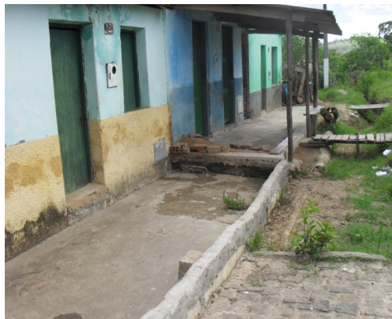
Foto 2: Rua Edvard Brito Landi. Área crítica por conta da ocorrência de alagamento. Área crítica 1.
