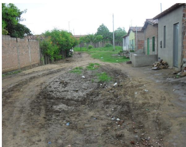
Foto 13: Rua José Francisco Lacerda. Região mais afetada da área crítica 5. Casas construídas no caminho por onde ocorre o escoamento natural das águas favorecem a ocorrência de alagamento.
