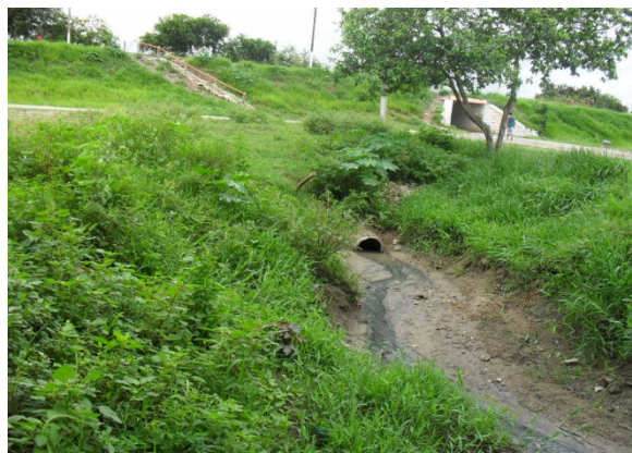
Foto 6: BA – 670. Ponto de lançamento de esgotos sanitários e águas pluviais de uma rede que cruza a rodovia e desemboca no Córrego da Mijada.
