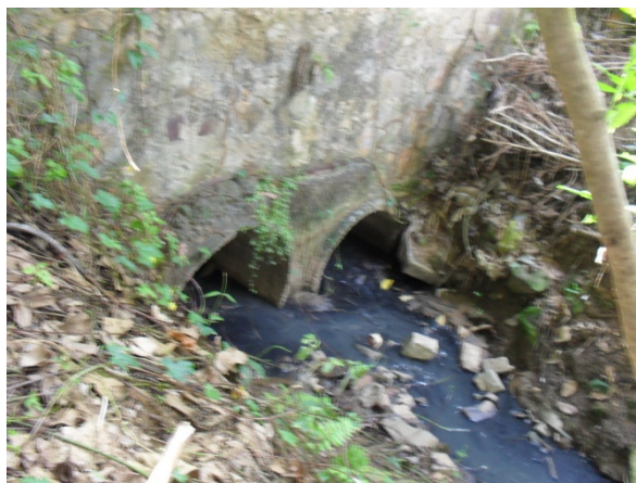
Foto 14: Rua Iracy. Bueiro duplo de travessia de um riacho que corta a cidade. Tubulação de concreto de 800 mm.
