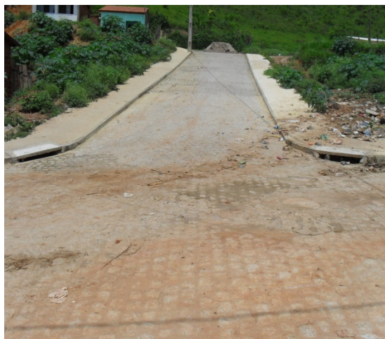
Foto 2: Bairro Cidade Nova. Dispositivos de coleta superficial e galerias subterrâneas já implantadas em algumas ruas. Sistema local utilizado é do tipo separador.
