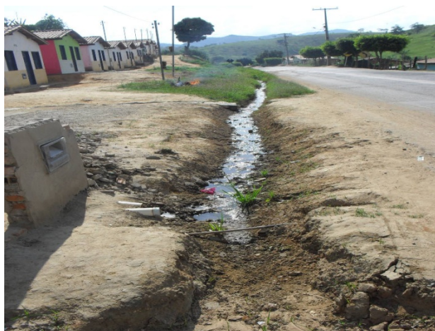
Foto 15: Casas populares da BA – 262. Fossas já apresentam problemas e algumas pessoas já estão lançando seus esgotos a céu aberto.
