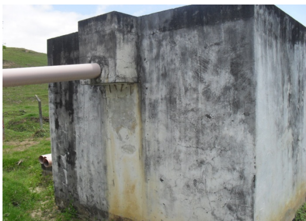
Foto 9: Detalhe do decantador primário da ETE.
