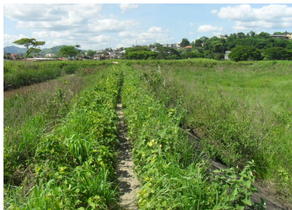
Foto 6: Lagoas de estabilização completamente tomada pela vegetação e sem receber efluente devido a problemas no interceptor.
