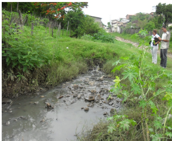
Foto 1: Rua Antônio Dias. Ponto de lançamento de esgotos sanitários e águas pluviais através de galeria circular de concreto de 400 mm de diâmetro.
