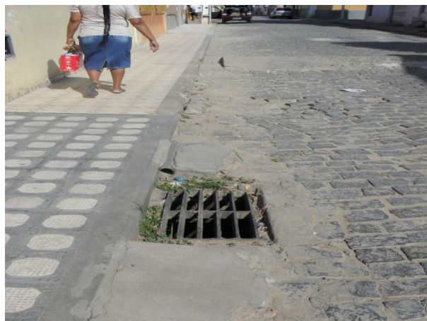
Foto 10: Rua Rui Barbosa. Dispositivos de drenagem existentes no local são insuficientes para escoar as águas superficiais que se acumulam no local.
