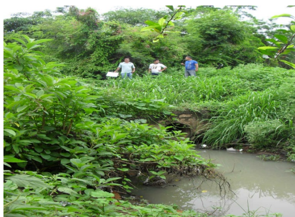
Foto 16: Ponto de lançamento da galeria de macrodrenagem que se inicia na avenida Getúlio Vargas e desemboca no rio Verruga.
