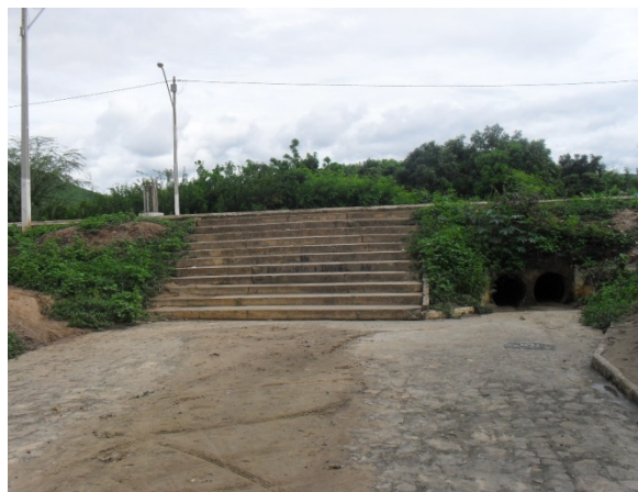
Foto 4: Detalhe do bueiro duplo. Dispositivo responsável por escoar toda a contribuição superficial de águas pluviais que convergem para a rua Padre Juracy Mendes.
