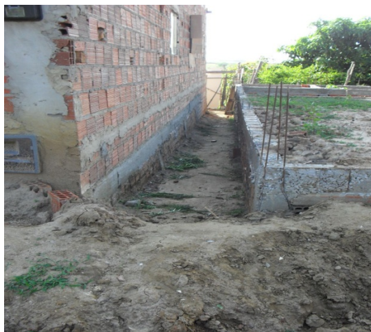
Foto 22: Bairro Quintas do Sul, Asa Sul. Local por onde ocorre o escoamento natural das águas superficiais já está sendo ocupado de maneira irregular. Área com risco potencial de sofrer problemas de drenagem.
