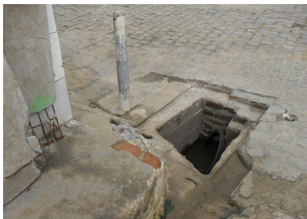
Foto 11: Rua 7 de Abril. Detalhe do dispositivo de drenagem local que além de não possuir dimensões suficientes para captar as águas pluviais que escoam superficialmente apresentam lixo.
