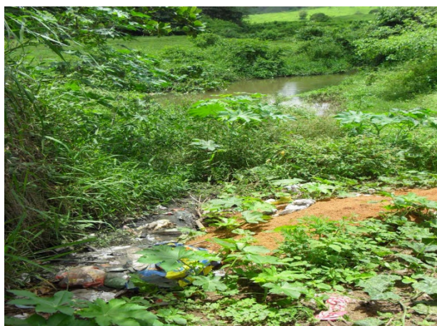
Foto 3: Ponto de lançamento de esgotos sanitários e águas pluviais da rede coletora no Rio Riachão. Tubulação de concreto de 300 mm de diâmetro encoberta por lixo e pela vegetação na margem do rio.
