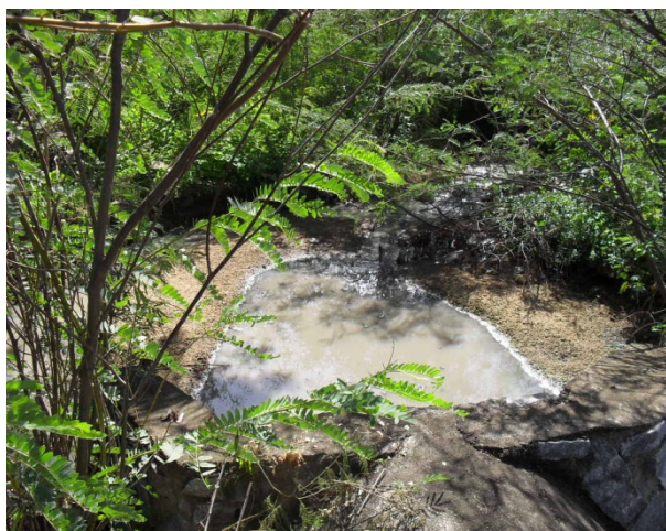
Foto 7: Vila Isabel. Ponto de lançamento da rede coletora de esgotos sanitários e águas pluviais próximo a ETE.
