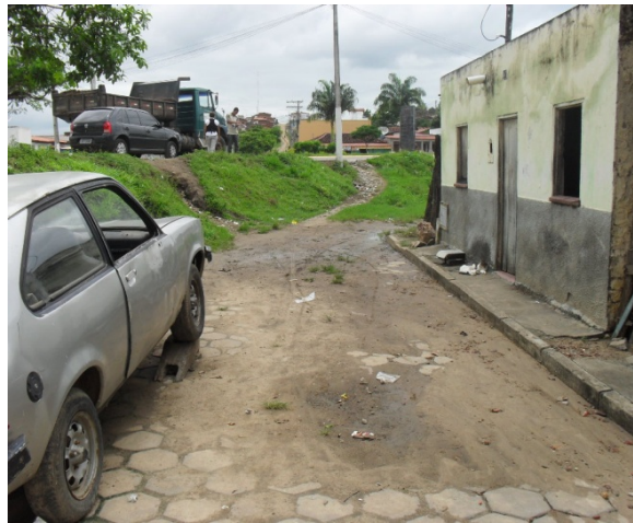
Foto 2: Rua Canavieiras. Vista de outro ângulo da área crítica 1.
