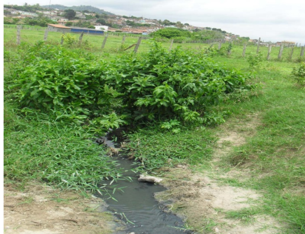
Foto 8: Rua Antonio Rodrigues dos Santos. Ponto de lançamento da rede coletora de águas pluviais e esgoto sanitário no terreno natural. Tubulação de concreto de 600 mm de diâmetro.
