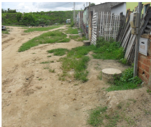
Foto 20: Bairro Américo Nogueira. Detalhe das caixas de passagem da rede coletora do sistema isolado de esgotamento sanitário existente no bairro.
