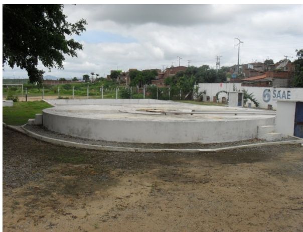
Foto 9: Detalhe do DAFA do sistema isolado dos bairros Quintas do Sul, Quintas do Morumbi, Américo Nogueira e Loteamento Alvorada. Problema no projeto obrigou a instalação de uma elevatória para recalcar o esgoto sanitário para o DAFA.
