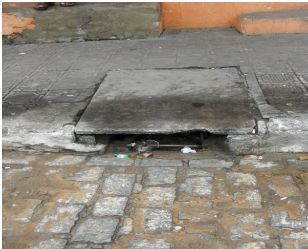
Foto 1: Detalhe do dispositivo de drenagem do tipo caixa coletora com abertura na guia.
