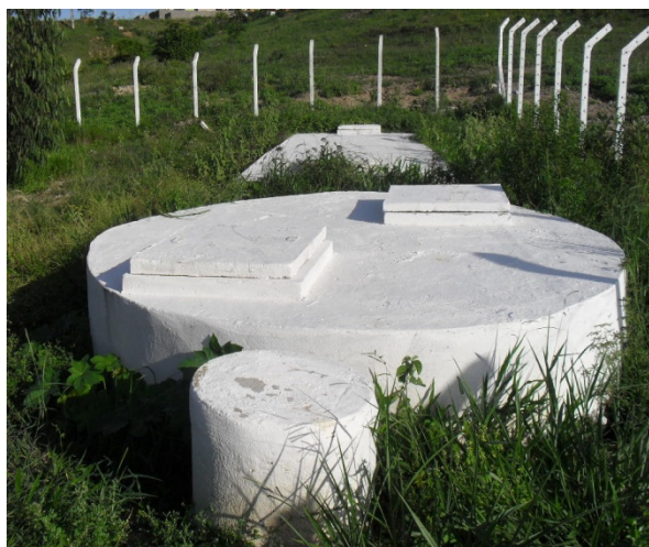
Foto 12: Detalhe dos dispositivos recentemente implantados com recursos de particulares na ETE do sistema isolado dos bairros Quintas do Sul, Quintas do Morumbi, Américo Nogueira e Loteamento Alvorada.
