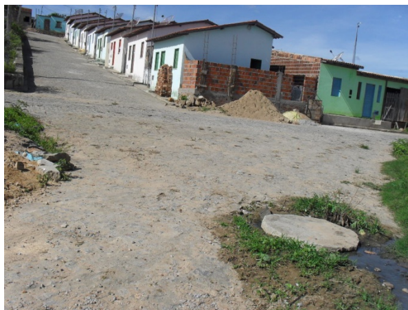
Foto 6: Vila Isabel. Sistema Isolado de esgotamento sanitário apresenta grandes problemas de operação devido a erro de execução e de projeto. Rede constantemente apresenta problemas
