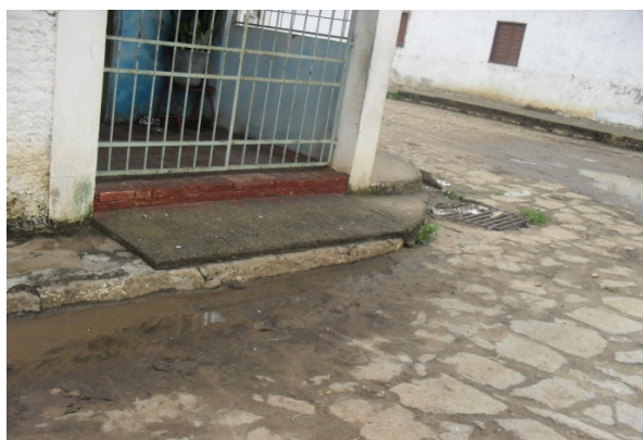
Foto 9: Cruzamento das ruas Manoel Novaes e 2 de Julho. Dispositivos de drenagem situados nas esquinas são insuficientes para escoar o volume de água durante as chuvas de enxurrada.
