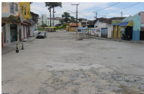
Foto 11: Rua próxima a praça Lomanto Júnior. Área mais prejudicada pelo alagamento ocorrido na região, pois o que não é captado pelos dispositivos de drenagem existentes se acumula no local.
