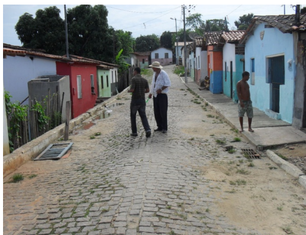
Foto 3: Rua Maiquinique. Uma das ruas que sofre por causa da enxurrada que começa na rua Belo Horizonte e desemboca na rua Itapetinga. Área crítica 1.
