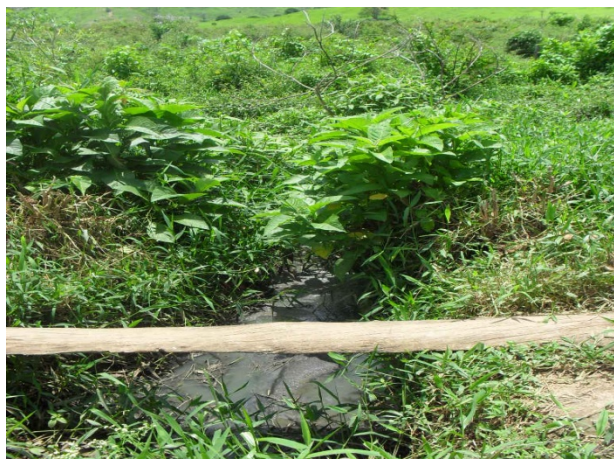
Foto 5: Outro ponto principal de lançamento de esgotos sanitários e águas pluviais da rede coletora no rio Riachão. Tubulação de concreto de 1000 mm de diâmetro encoberta pela vegetação.
