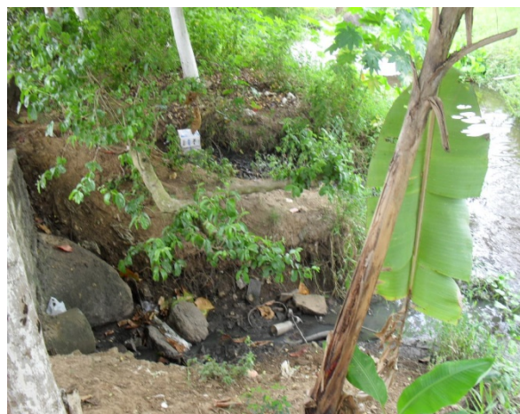
Foto 6: Ponto de lançamento da rede coletora de esgotos sanitários e águas pluviais no Rio de Areia. Galeria circular de concreto de 300 mm de diâmetro.
