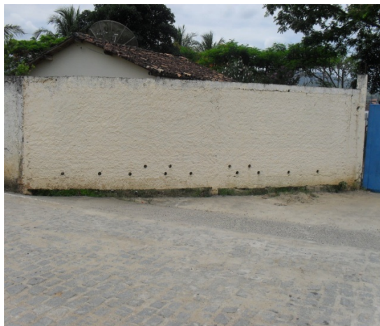
Foto 2: Rua Gerson Batista França. Para facilitar o escoamento das águas pluviais no momento do alagamento, foram construídas passagens no muro para amortizar o efeito das cheias.
