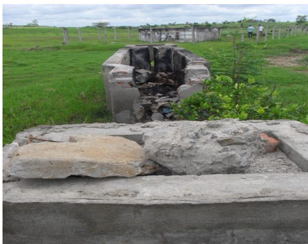
Foto 3: Detalhe dos dispositivos de entrada da ETE completamente danificados. Caixa de areia bastante depredada.
