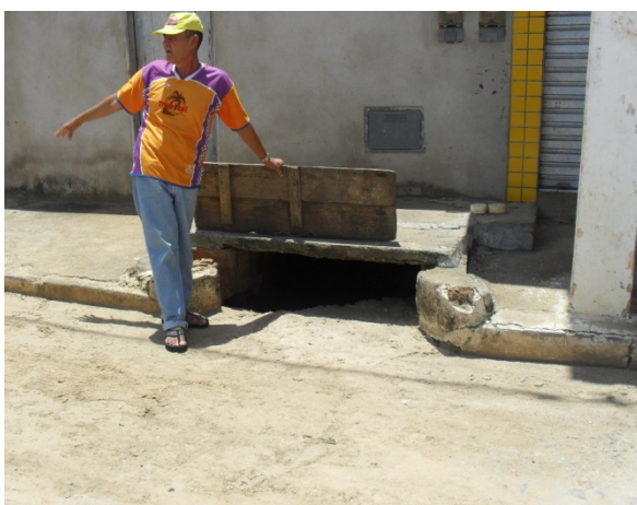
Foto 11: Rua Crescencio Silveira. Dispositivo de drenagem existente não é suficiente para escoar o volume de água superficial que converge para a região na ocorrência das chuvas de enxurrada.
