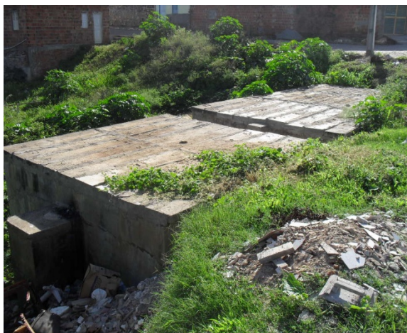
Foto 2: Conjunto Habitacional ECOSANI. Detalhe dos 2 Filtros Biológicos situados próximo a pista. As condições de operação e manutenção estão inadequadas.
