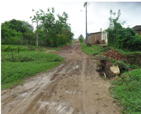
Foto 1: Rua Agenor Novaes. Área crítica por conta da ocorrência de alagamento. Área crítica 1.
