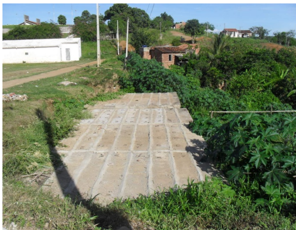
Foto 1: Conjunto Habitacional ECOSANI. Sistema isolado de esgotamento sanitário cujo tratamento utilizado consiste em Filtros Biológicos.
