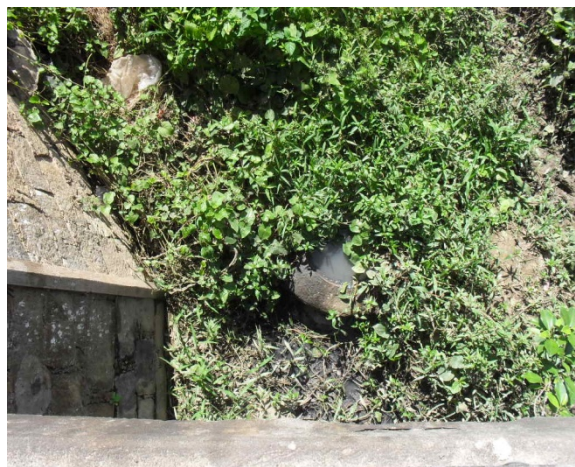
Foto 2: Poço de visita do interceptor da rede de esgoto transbordando na margem do rio Colônia. Muitos PVs estão nestas condições e praticamente todo esgoto da rede coletora está sendo lançado no rio Colônia.
