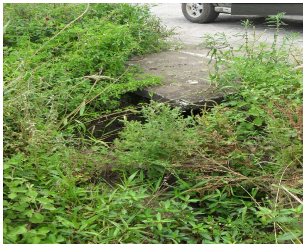
Foto 1: Rua Gerson Batista França. Dispositivo de entrada do sistema de drenagem existente. Área crítica por conta da ocorrência de alagamento. Área crítica 1.
