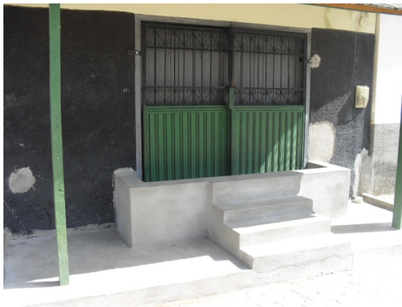
Foto 17: Rua Independência. Moradores constroem muretas na entrada de suas residências para conter a invasão das águas pluviais.
