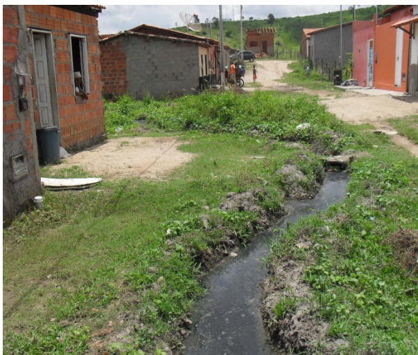
Foto 13: Bairro Enedina de Carvalho. Esgoto a céu aberto.
