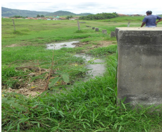
Foto 6: Os efluentes que antes eram conduzidos a ETE através de um emissário, estão escoando a céu aberto ao lado da mesma.
