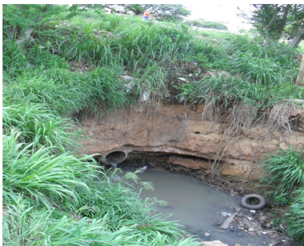
Foto 19: Avenida Beira Rio, próximo ao galpão da Azaléia. Ponto de lançamento da rede coletora de esgoto sanitário e águas pluviais no rio Catolé. Tubulação de concreto de 600 mm de diâmetro.
