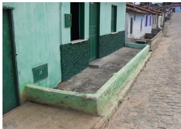
Foto 6: Rua Belo Horizonte. Moradores constroem muretas na frente de suas casas para evitar que a água invada suas residências.
