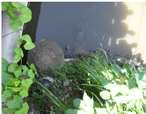
Foto 1: Poço de visita do interceptor da rede coletora implantado praticamente dentro da calha do rio Colônia.
