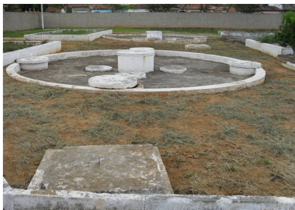
Foto 3: Detalhe dos DAFA's existentes na ETE do bairro Arnulfo Órfão em bom estado de conservação.
