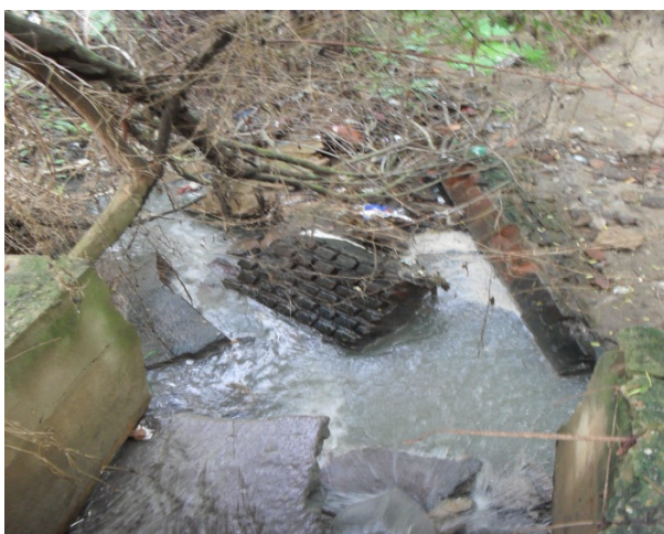
Foto 19: Trecho final da galeria retangular de macrodrenagem com sinais de quebraimento.
