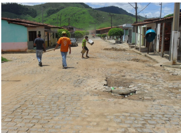
Foto 3: Ponto de lançamento da rede de drenagem ainda não foi definido. Até o momento as águas captadas e transportadas pela rede de drenagem estão aflorando no PV localizado na Avenida Juracy Magalhães.
