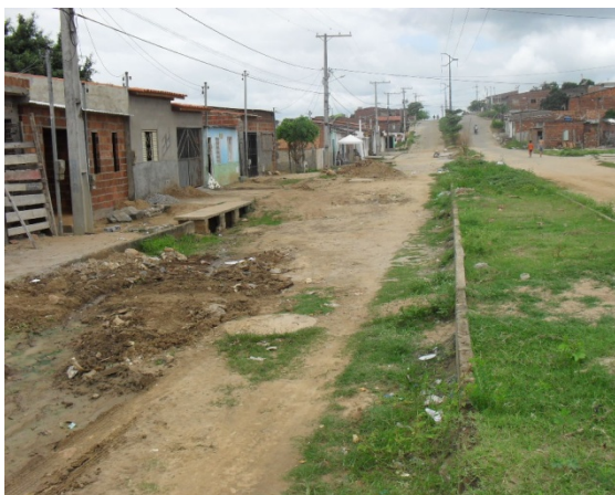
Foto 5: Bairro Américo Nogueira. Avenida por onde passa a galeria enterrada de macrodrenagem de seção retangular.
