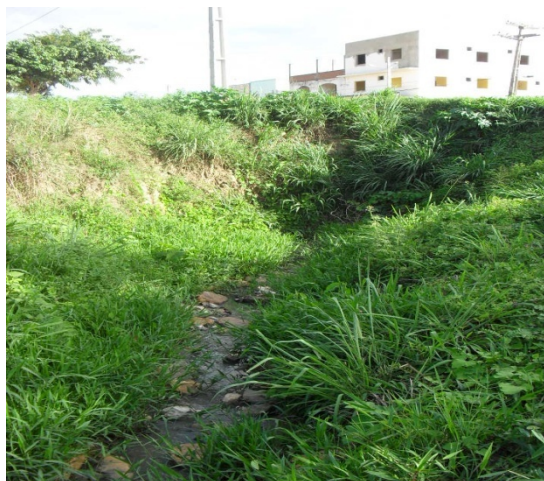
Foto 10: Canal da Clerolândia, trecho no qual o riacho cruza a Avenida Júlio José Rodrigues. Bueiro com seção insuficiente e com indícios de obstrução promove o alagamento na área que afeta moradores locais.
