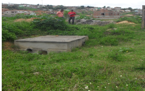
Foto 2: Área próxima a rua D. Detalhe do dispositivo construído pela prefeitura para amenizar o efeito do alagamento na região.
