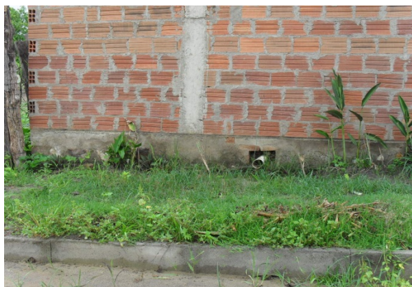
Foto 5: Rua Tibúcio Prado. Esgoto a céu aberto escoando próximo a rua.
