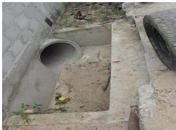
Foto 14: Rua Francisco Oliveira. Detalhe do dispositivo de drenagem responsável por escoar o volume de contribuição superficial na área crítica.
