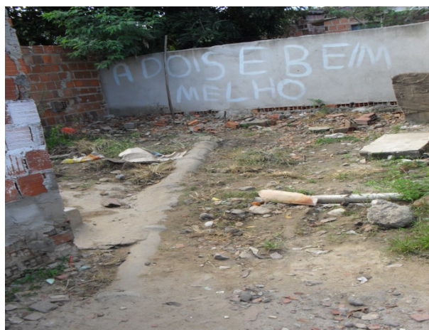
Foto 4: Rede coletora passa por dentro de lotes e cruza alguma residências é insuficiente para escoar as águas pluviais. Algumas casas são invadidas na área crítica 1.
