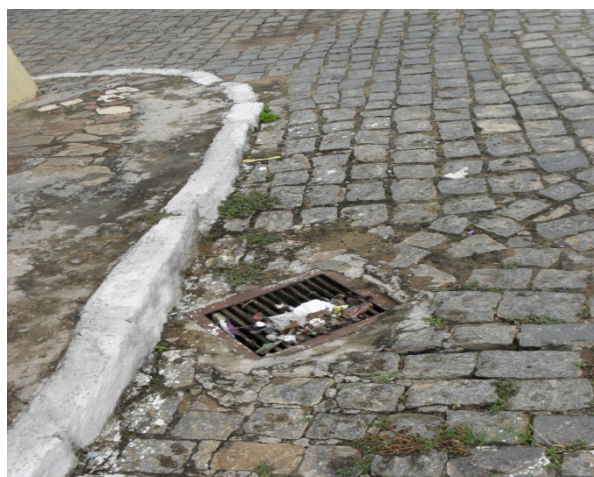
Foto 4: Detalhe do dispositivo de drenagem superficial do tipo caixa coletora com grelha. Estado de conservação médio e presença de lixo.
