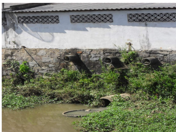
Foto 3: Esgotos sanitários e águas pluviais dos boxes da feira e da rede coletora que passa na rua são lançados diretamente no rio Colônia.
