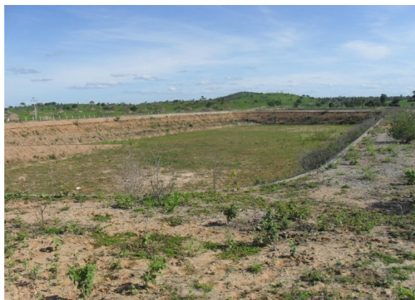
Foto 16: Detalhe da lagoa de estabilização da ETE pertencente ao sistema geral de esgotamento sanitário em fase de implantação.
