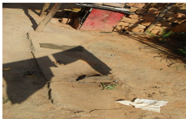
Foto 14: Casas populares da BA – 262. Sistema de fossa séptica seguida de sumidouro.
