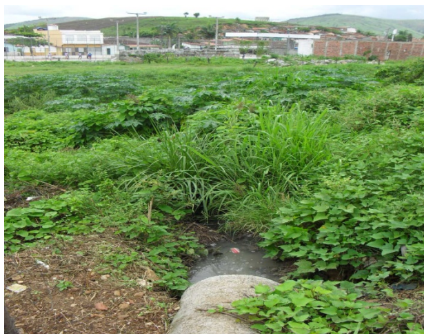
Foto 7: Rua Mário R. Oliveira. Ponto de lançamento de esgotos sanitários e águas pluviais no córrego. Tubulação de concreto de 400 mm de diâmetro.
