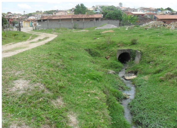
Foto 15: Ponto de lançamento da rede coletora de águas pluviais e esgoto sanitário próximo a Estação de Tratamento de Esgoto. Tubulação de concreto de 800 mm de diâmetro.
