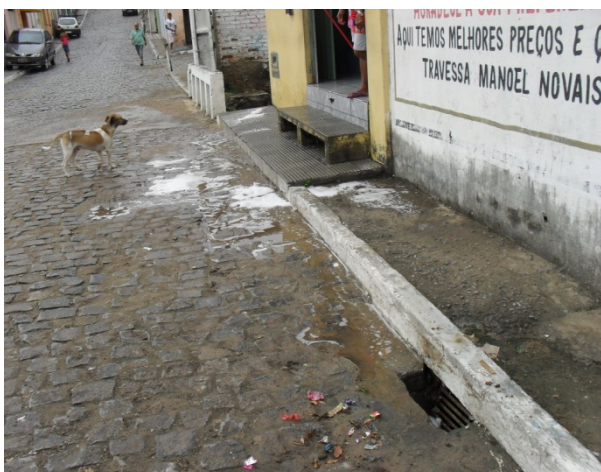
Foto 3: Detalhe do dispositivo de drenagem do tipo caixa coletora com grelha necessitando de manutenção.
