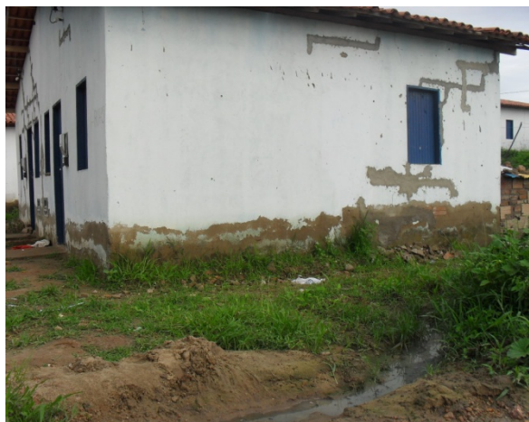
Foto 8: Casas Populares. Esgotos sanitários sendo lançados a céu aberto.
