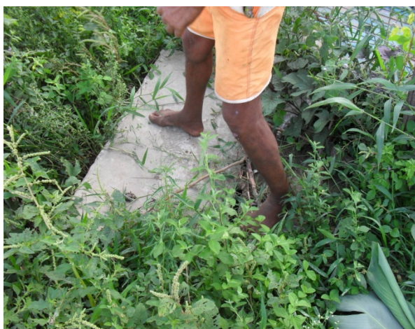
Foto 25: Detalhe da fossa do sistema de esgoto do bairro Laís Gois. Estrutura danificada não realiza mais o tratamento dos esgotos sanitários.
