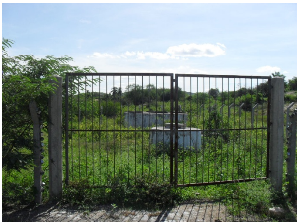
Foto 5: Vila Isabel. Visão geral da Estação de Tratamento de Esgoto Sanitário do sistema isolado de esgotamento sanitário.
