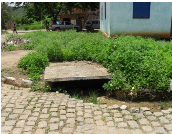
Foto 9: Avenida Francisco Viana Filho. Parte do pavimento foi removido para facilitar a entrada das águas pluviais na boca de lobo que conduz as águas pluviais diretamente para o rio Riachão que passa por trás da avenida.
