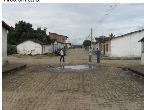
Foto 8: Cruzamento das ruas Manoel Novaes e 2 de Julho. Área crítica de alagamento por conta das chuvas de enxurrada. Área crítica 4.
