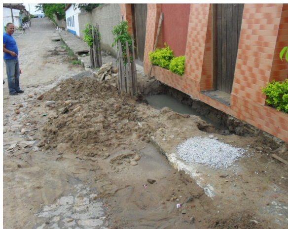
Foto 10: Rua Ilda Mendes. Rede coletora de águas pluviais e esgotos sanitários que passa debaixo do passeio estava estourada na ocasião da visita.
