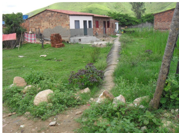
Foto 2: Trecho em que a tubulação da rede coletora de esgotos sanitários e águas pluviais de 1000 mm de diâmetro está exposta quando passa por trás e por baixo de residências da Avenida Juracy Magalhães
