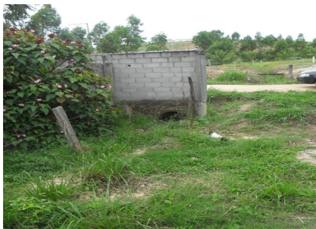
Foto 3: Bairro Ozeas Andrade. Área crítica por conta da ocorrência de alagamento. Área crítica 2.
