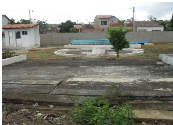
Foto 4: Detalhe dos Tanques Imhoff da ETE.
