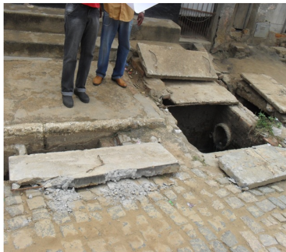
Foto 2: Rua Zeferino Silveira Silva. Detalhe dos dispositivos de coleta superficial da rede coletora de esgoto sanitário e águas pluviais.
