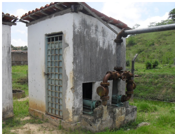
Foto 8: Detalhe da elevatória que recalca o esgoto que chega na ETE para o decantador.
