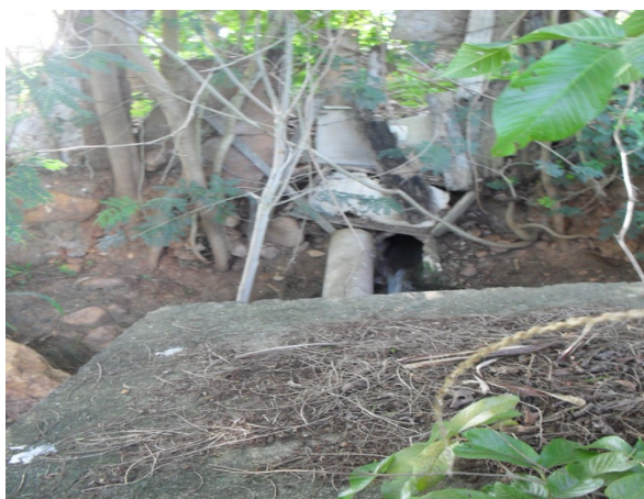
Foto 4: Conjunto Habitacional ECOSANI. Detalhe da tubulação de chegada os esgotos sanitários no Filtro Biológico. O esgoto está sendo lançado a céu aberto devido à tubulação estar danificada.
