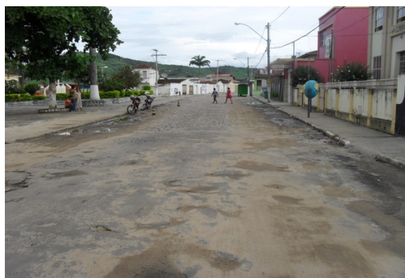
Foto 10: Praça em frente à prefeitura. Área crítica por conta da ocorrência de alagamentos provocados por chuvas de enxurrada. Área crítica 5.
