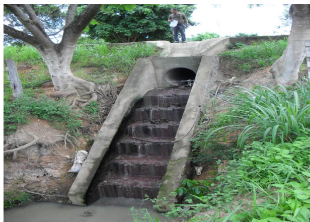
Foto 7: Avenida Camilo de J. Lima. Ponto de lançamento da rede mista que cobre o bairro Novo Horizonte. Tubulação de concreto de 800 mm de diâmetro.
