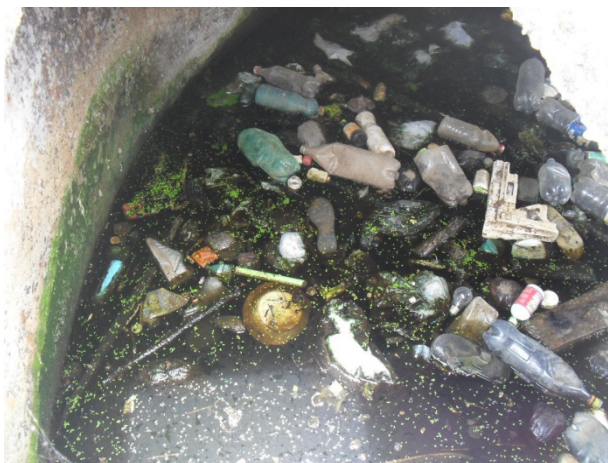
Foto 5: Detalhe de dentro do DAFA. Estrutura aberta e cheia de lixo na parte interior.
