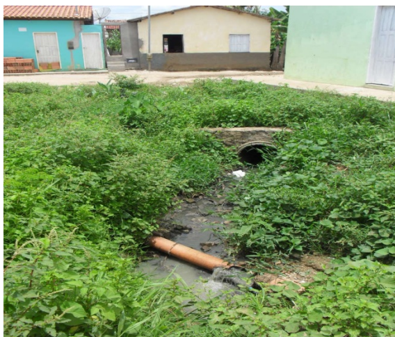
Foto 8: Bairro Cajazeiras. Lançamento de esgoto e águas pluviais da rede coletora no terreno natural.
