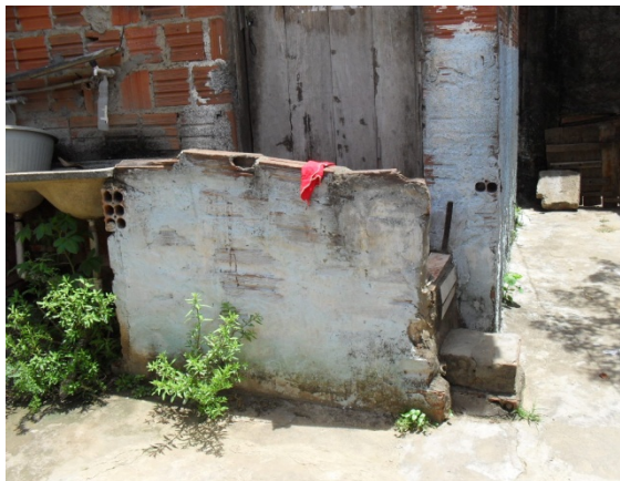
Foto 6: Avenida Juracy Magalhães. Residência identificada que sofre tanto com as águas pluviais que entram pela frente da casa quanto as águas que escoam pelo fundo. Morador deixou até uma passagem de água no muro para facilitar o escoamento.
