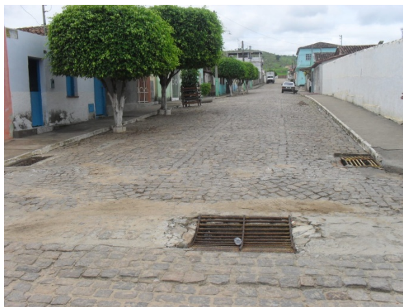
Foto 6: Cruzamento da rua 2 de Julho com a rua Aureliano Coelho. Início da galeria de macrodrenagem que recebe esgoto sanitário.
