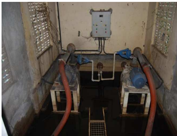
Foto 1: Casa de Bomba - Estação Elevatória da Vila Santana
