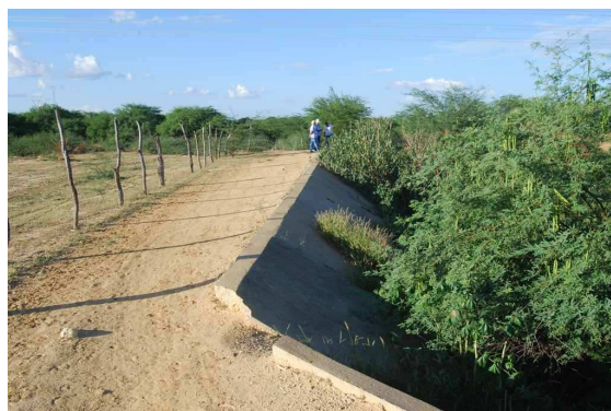
Foto 8: Estação de tratamento abandonada – Perto da Vila Santana
