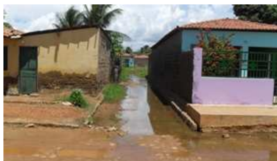
Foto 4: Área crítica - passagem de água entre lotes – Rua Sem Nome (próxima a Rua Gilberto Gonçalves)
