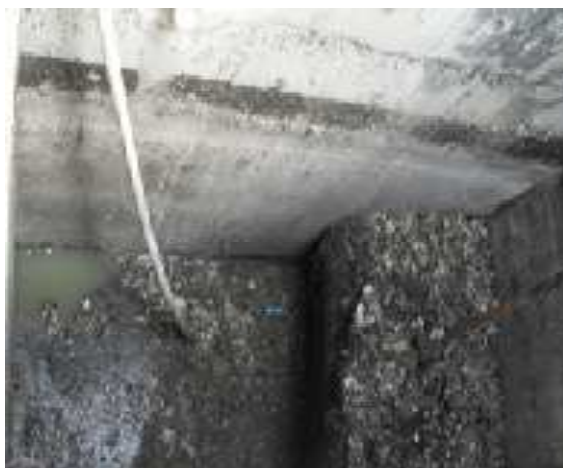
Foto 7: Gradeamento – Estação de Esgoto – Oscar Ribeiro
