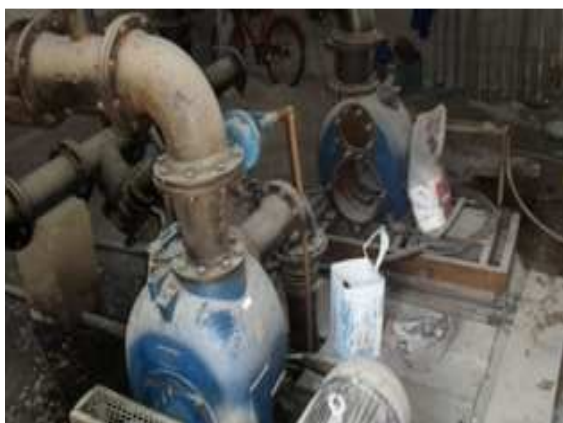
Foto 5: Estação de esgoto – Oscar Ribeiro
