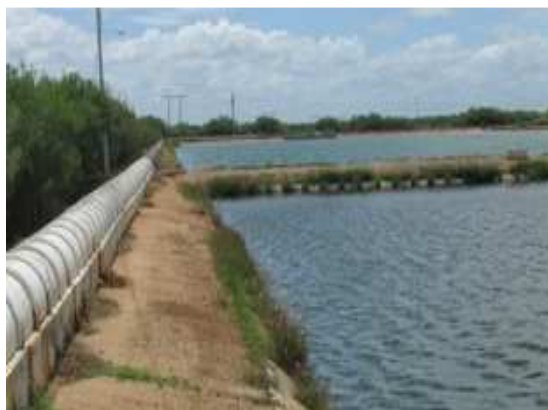
Foto 2: ETE – lagoas e emissário
