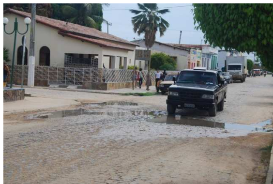
Foto 4: Rua 1 de maio - área de alagamento.
