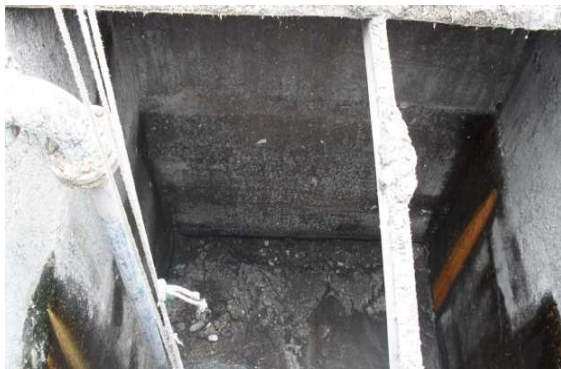
Foto 13: Estação Elevatória 2 – Centro – Asa Oeste
