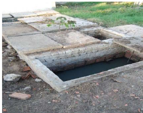
Foto 2: Caixas - Estação Elevatória da Vila Santana
