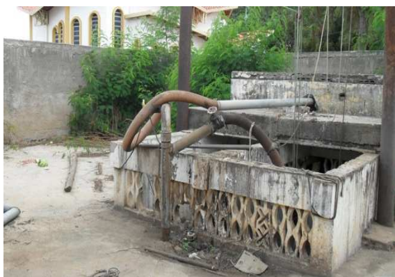
Foto 9: Estação Elevatória – Centro – Asa Leste
