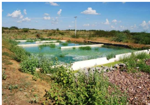
Foto 2: Lagoa Anaeróbica e Facultativa
