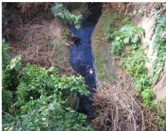
Foto 10: Lançamento de esgoto em direção ao Rio Várzea Barris
