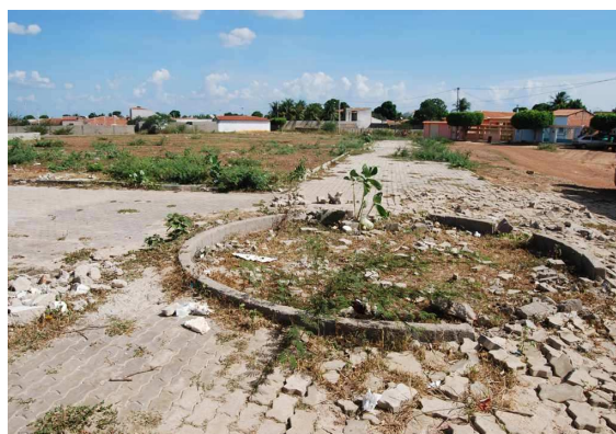
Foto 4: Área de inundação próxima a Rodoviária
