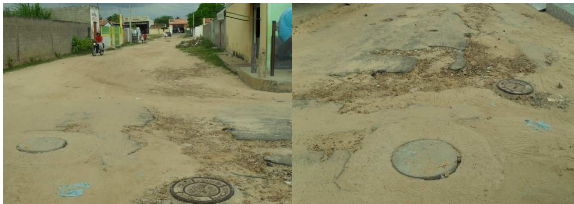
Foto 1: Caixa de Passagem – Rua Delcídio Castelo Branco com Rua Reginaldo Ferreira dos Santos
