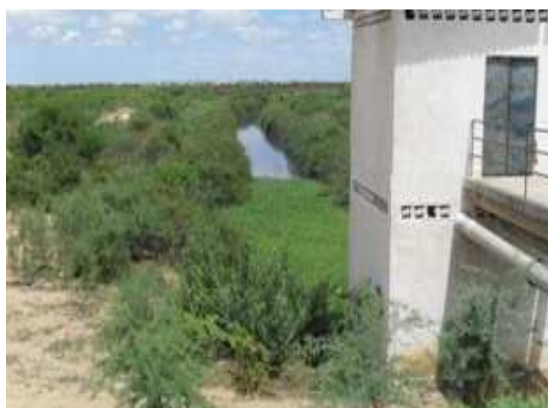
Foto 4: Caixa de Controle - Dique São Geraldo
