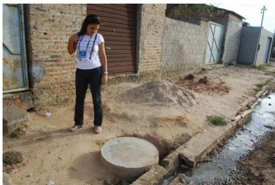
Foto 1: Rede de esgoto – Caixa de Passagem – Rua Treze de Junho.
