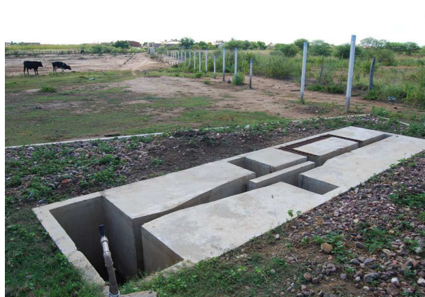
Foto 8: Detalhe do sistema da Lagoa Aeróbica
