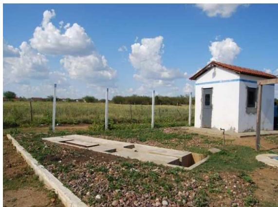
Foto 7: Conjunto do sistema da Lagoa Aeróbica
