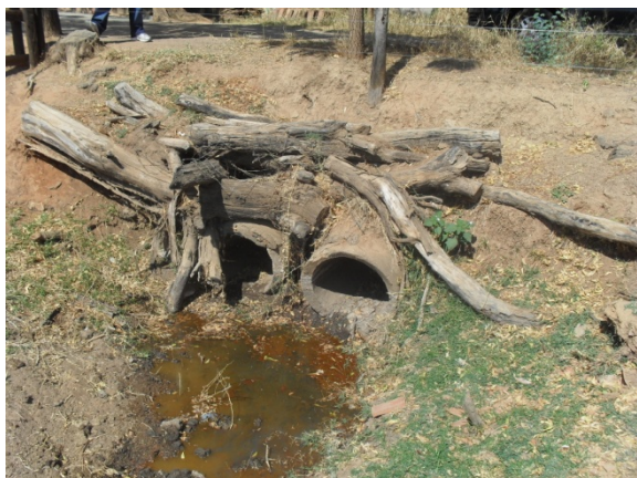
Foto 13: Canal Bairro BNH – lançamento final a céu aberto em um pasto.
