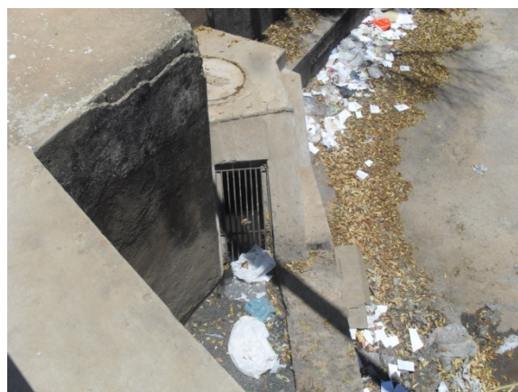
Foto 4: Gradeamento da captação em tempo seco no Canal do Belém com inadequada manutenção.
