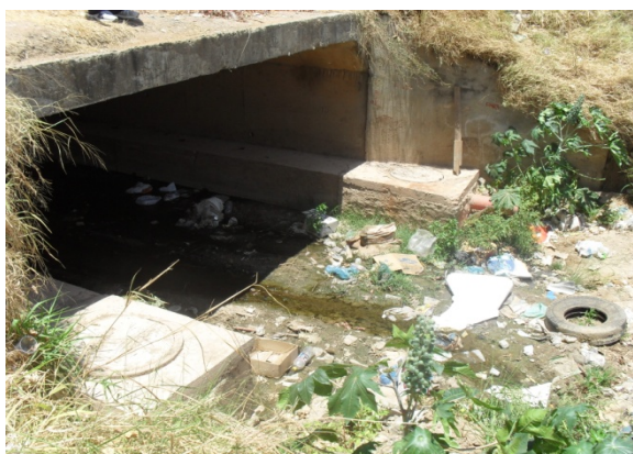
Foto 5: Canal do Belém – final do trecho revestido em concreto e início do trecho sem revestimento, com presença constante de lixo.
