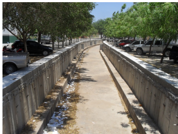
Foto 20: Área Crítica 6 – Centro – Avenida Deolinda Martins - Carência de sistema de microdrenagem para conexão com o Canal do Belém.
