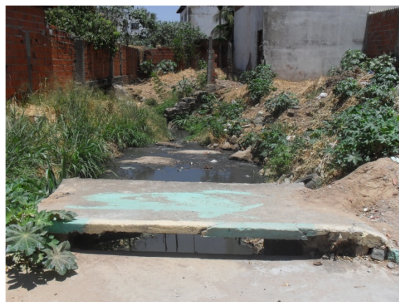
Foto 2: Canal do Belém – trecho sem revestimento com contribuições de esgoto sanitário e repleto de vegetação e lixo.
