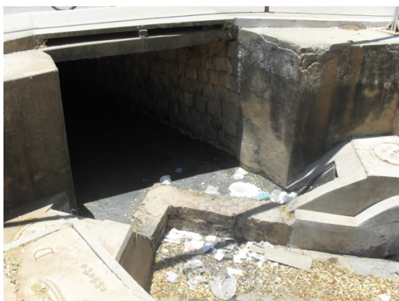
Foto 3: Captação em tempo seco no Canal do Belém operada pela Embasa.
