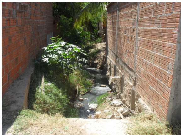
Foto 7: Canal Bairro Lagoinha – sem revestimento repleto de terra e vegetação.
