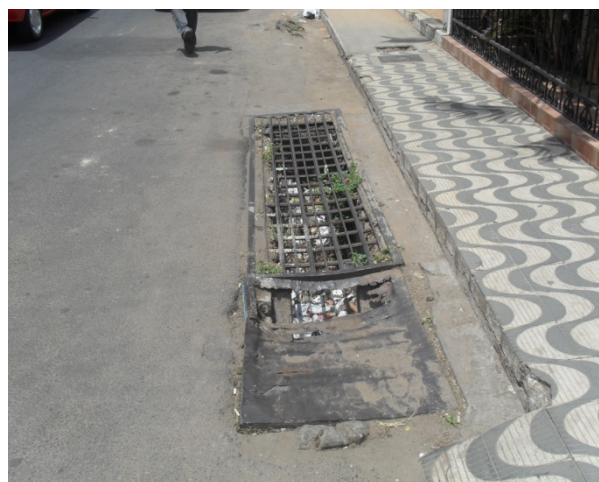
Foto 8: Avenida Antônio Moreira Guimarães com dispositivo de microdrenagem recebendo lançamento inadequado de resíduos sólidos.
