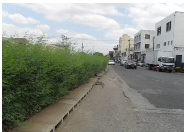
Foto 4: Urbanização lateral com coleta e lançamento das águas pluviais.
