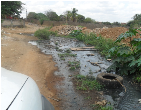
Foto 9: Área crítica 1- Bairro Baraúna. Local onde ocorrem freqüentes alagamentos.
