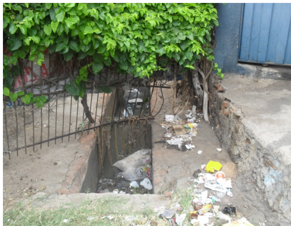
Foto 2: Rua Guilherme Dias - Canal revestido obstruído confinado a terreno particular.
