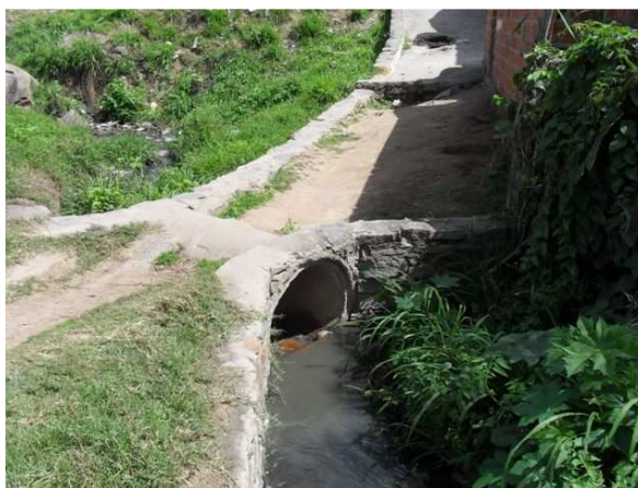
Foto 17: Bueiro simples do canal Oriente que apresenta muita vegetação em seu leito e carece de manutenção constante.
