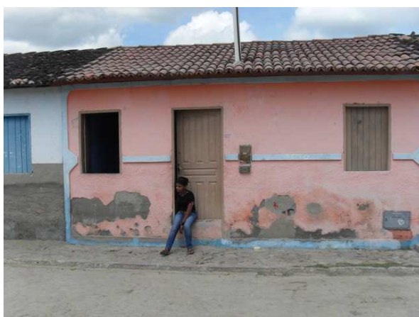
Foto 11: Área crítica de alagamento – Casas afetadas
