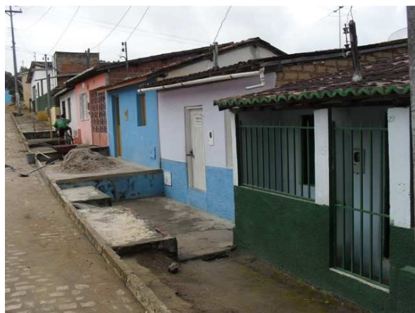
Foto 8: Área Crítica 1 – Rua Duque de Caxias – Casas afetadas
