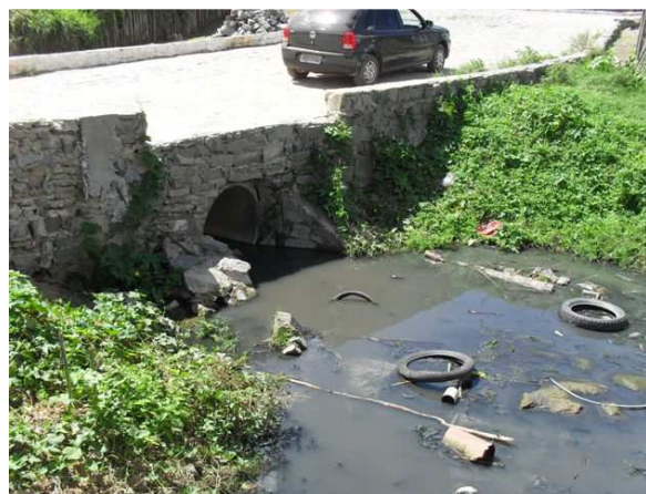
Foto 18: Bueiro simples do Canal Oriente, com destaque para o lixo existente.
