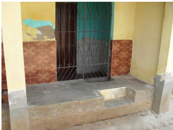
Foto 1: Área Crítica nº1 – Bairro da Cerâmica – Casas afetadas
