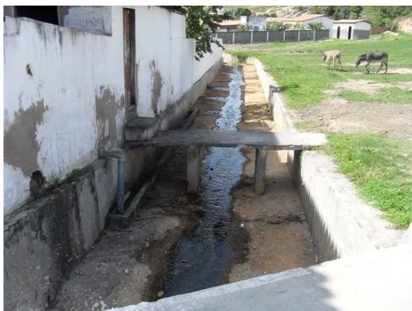
Foto 5: Rio Saracura - trecho urbano com obstrução
