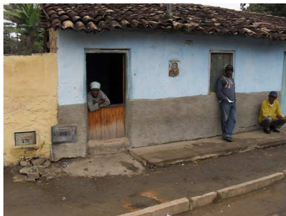
Foto 6: Área Crítica n º4 – Rua Getúlio Vargas – Casas Afetadas
