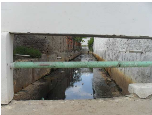
Foto 5: Rio Saracura - trecho urbano com estrangulamento
