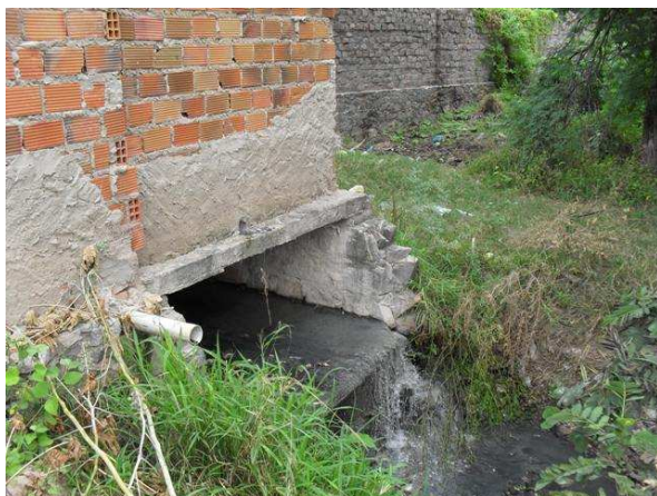
Foto 1: Lançamento direto de esgoto no Canal Rua Osvaldo Brito.
