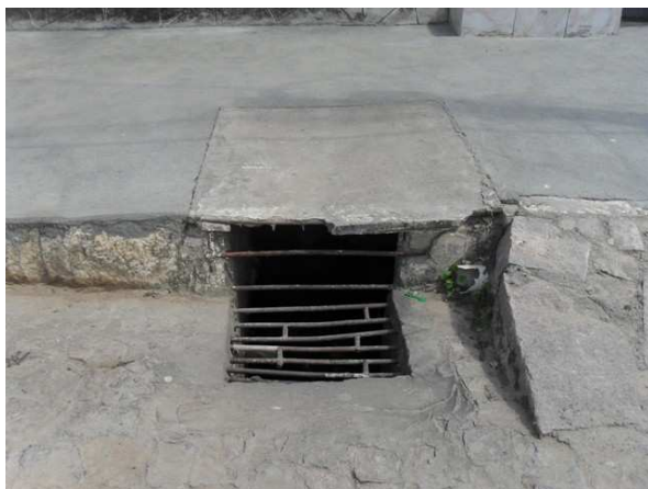
Foto 3: Caixa coletora com grelha, dispositivo de microdrenagem.
