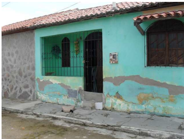
Foto 7: Área crítica de alagamento – Casas afetadas
