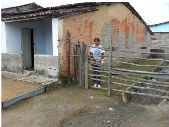
Foto 5: Área Crítica n º4 – Rua Getúlio Vargas – Sistema de Drenagem pelos quintais das casas
