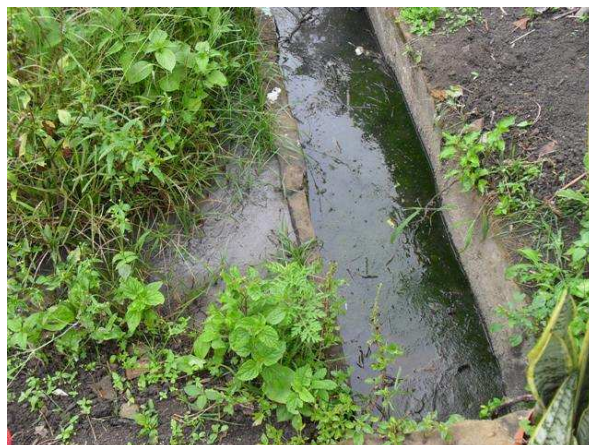
Foto 2: Valeta com esgoto secundário a céu aberto
