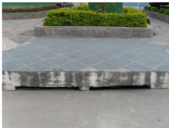
Foto 6: Dispositivo de micro-drenagem – caixa coletora com abertura na guia
