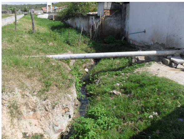
Foto 3: Esgoto a céu aberto.
