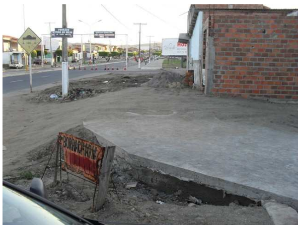
Foto 11: Deflexão do canal Francisco Gil, com edificações construídas sobre ele.
