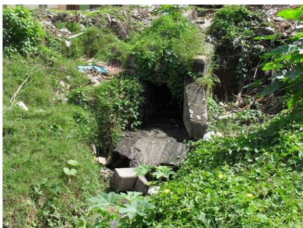
Foto 17: Loteamento Primavera - Ponto de lançamento dos esgotos a céu aberto
