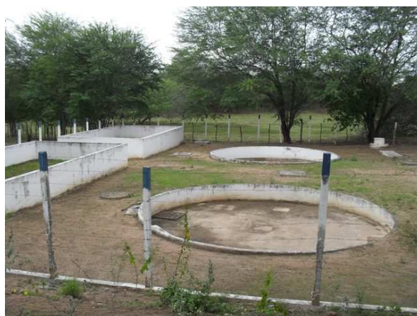
Foto 4: ETE operada pela Embasa
