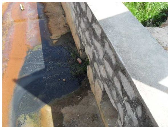
Foto 4: Rio Saracura - trecho urbano com lançamento direto de esgoto
