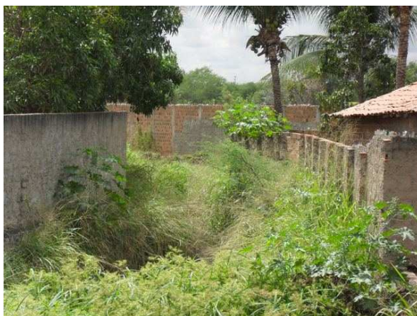
Foto 6: Estrangulamento no canal de alvenaria de pedra – Bairro da Cerâmica
