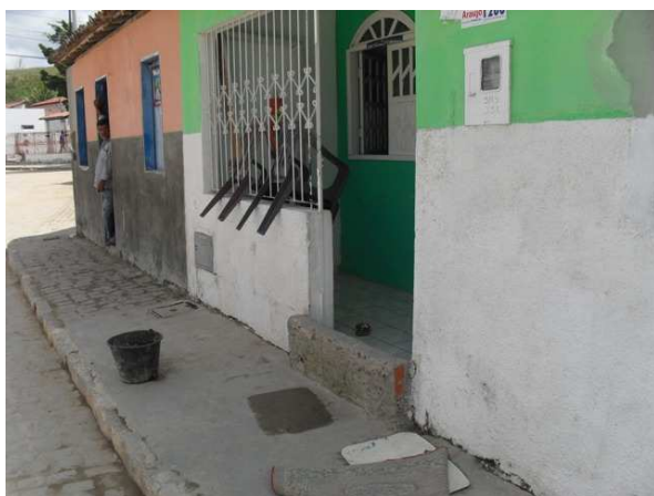
Foto 9: Área crítica de alagamento – Casas afetadas
