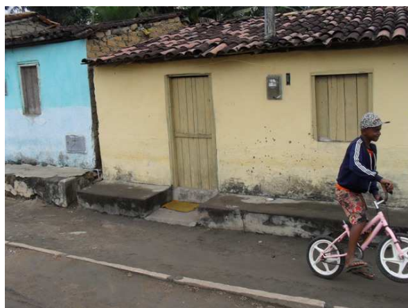
Foto 4: Área Crítica 2 – Rua Castelo Branco e Rua do Meio – Casas afetadas
