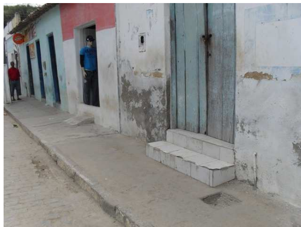
Foto 8: Área crítica de alagamento – Casas afetadas
