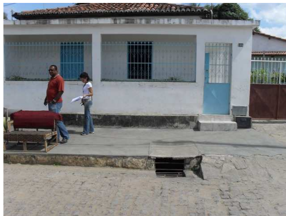
Foto 2: Caixa coletora com grelha, dispositivo de microdrenagem.
