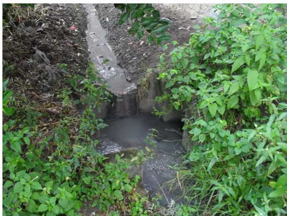
Foto 1: Esgoto secundário a céu aberto
