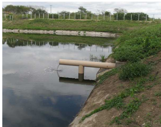
Foto 8: Estação de Tratamento de Esgoto – Tubulação de entrada na Lagoa Facultativa
