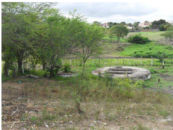
Foto 3: Estação de Tratamento do Sistema Isolado Praça São Judas Tadeu - fora de operação.
