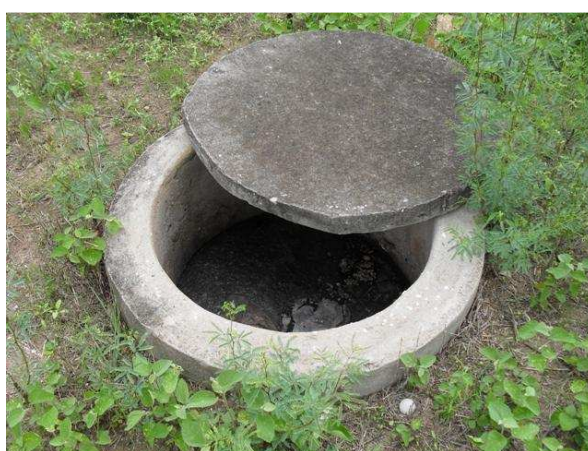
Foto 6: Estação de Tratamento de Esgoto – Caixa de passagem
