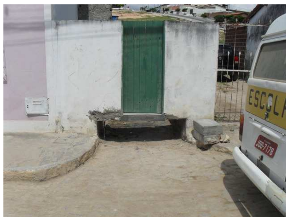
Foto 10: Área crítica de alagamento – Casas afetadas
