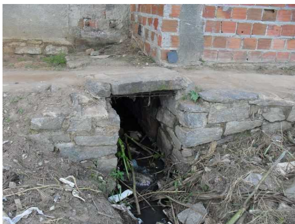
Foto 12: Loteamento Bahia - Ponto de lançamento dos esgotos a céu aberto
