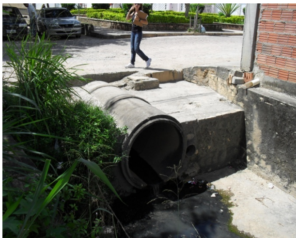
Foto 11: Praça da Juventude. Final da galeria de concreto com seção de DN 1200mm que recebe contribuição de esgotos sanitários e águas pluviais da Vila Feliz e outros bairros adjacentes.
