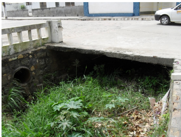
Foto 7: Canal de macrodrenagem de alvenaria de pedra que canaliza as águas do Riacho do Judeu e desemboca no Rio do Ouro. Seção 4m X 1,5m. pode-se observar o acúmulo de material na seção da estrutura.
