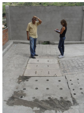
Foto 6: Trecho final do canal de concreto que desemboca em terreno particular. 1ª Travessa da São Geraldo.
