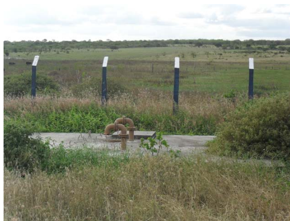
Foto 6: ETE 2 - povoado de Piabas - conjunto constituído de tanque séptico e vala de filtração.
