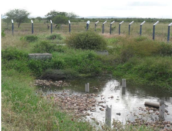
Foto 7: ETE 2 - povoado de Piabas – vala de filtração recoberta por mato e sem escoamento dos esgotos.
