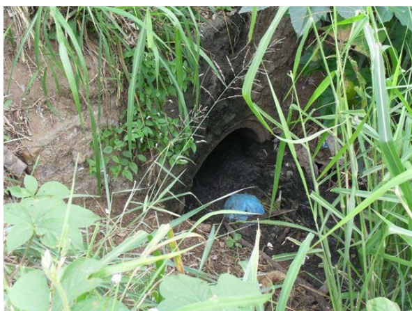
Foto 5: Ponto de lançamento de esgoto com contribuição de águas de chuvas.
