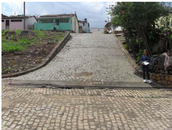
Foto 1: Dispositivo de drenagem para interceptação do escoamento superficial.
