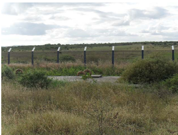
Foto 5: ETE 2 - povoado de Piabas - conjunto constituído de tanque séptico e vala de filtração
