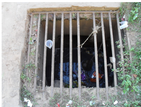
Foto 4: Dispositivos de drenagem contendo lixo e conduzindo esgotos. Rua Manoel Novaes.
