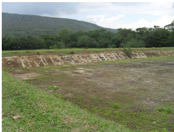
Foto 2: Lagoa de tratamento de esgoto – abandonada por falta de equipamentos para bombeamento.
