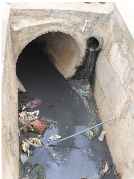
Foto 3: Transição da tubulação de DN 500 para o Canal com presença de esgoto e lixo.
