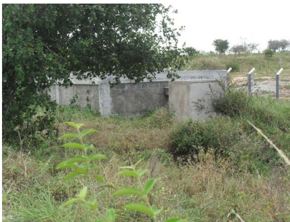
Foto 1: ETE 1 - povoado de Piabas – conjunto constituído de tanque séptico e vala de filtração.
