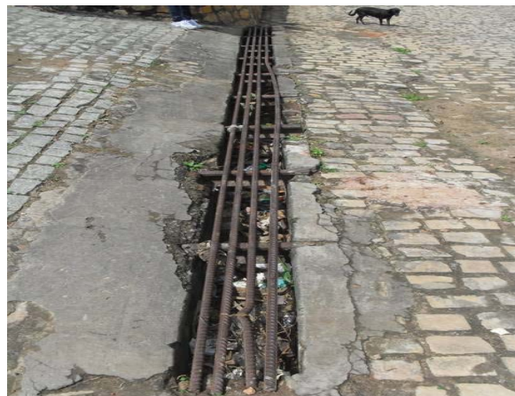
Foto 2: Dispositivo de drenagem com presença de lixo.
