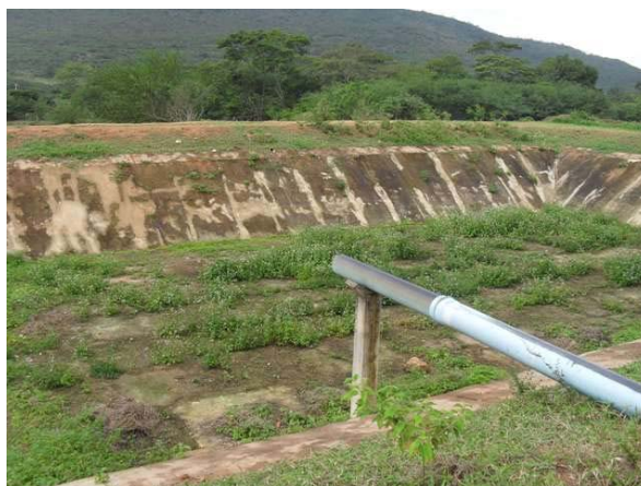
Foto 4: Lagoa de tratamento de esgoto – abandonada por falta de equipamentos para bombeamento.
