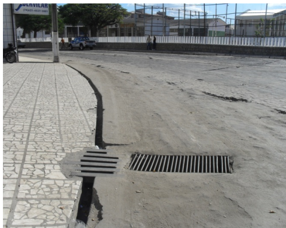
Foto 14: Dispositivos de drenagem superficial da Avenida Lomanto Júnior.
