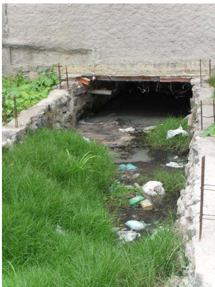
Foto 5: Ponto de lançamento de esgoto transportado por canal em alvenaria de pedra – presença de muito lixo e vegetação.
