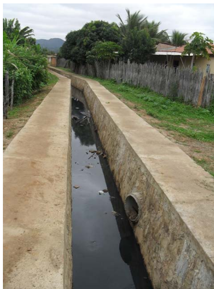
Foto 4: Lançamento de esgoto direto no canal de drenagem.
