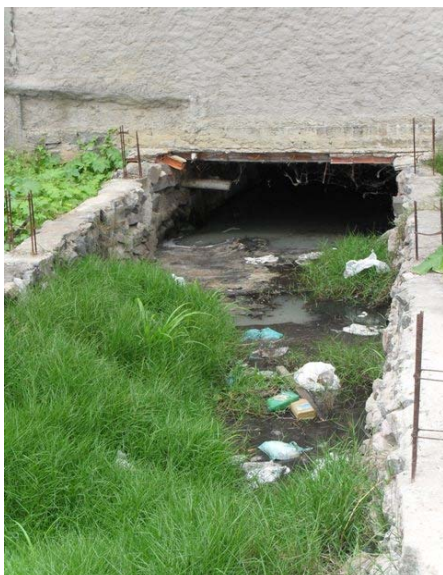
Foto 3: Ponto de lançamento de esgoto em canal de alvenaria de pedra. Os efluentes vão encaminhados para lagoa.
