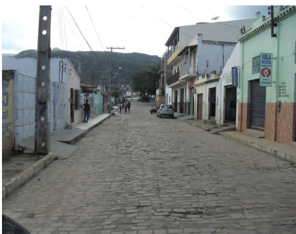
Foto 17: Área crítica 3 - Rua Duque de Caxias. Área crítica por conta das chuvas de enxurrada.
