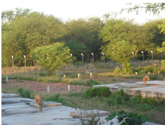
Foto 3: Vista da ETE 1 - povoado de Pedras Altas – totalizando 6 conjuntos constituídos de tanque séptico e vala de filtração
