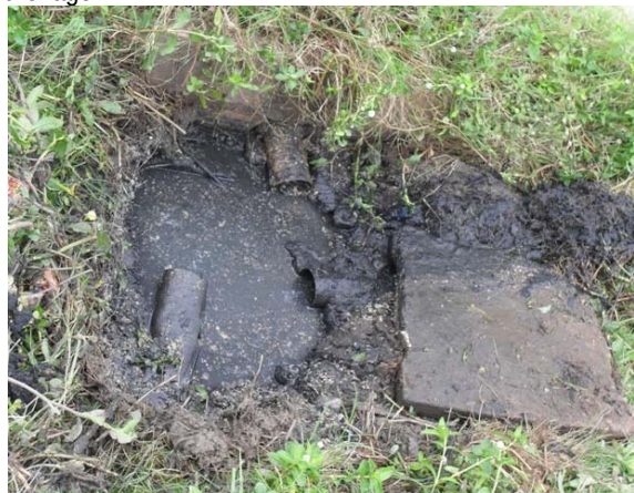
Foto 6: Caixa de esgoto danificada, situada no fundo de uma casa.
