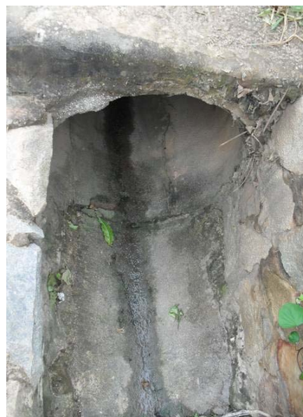
Foto 4: Tubulação de DN 1000mm – recebe águas de chuvas de parte da cidade.
