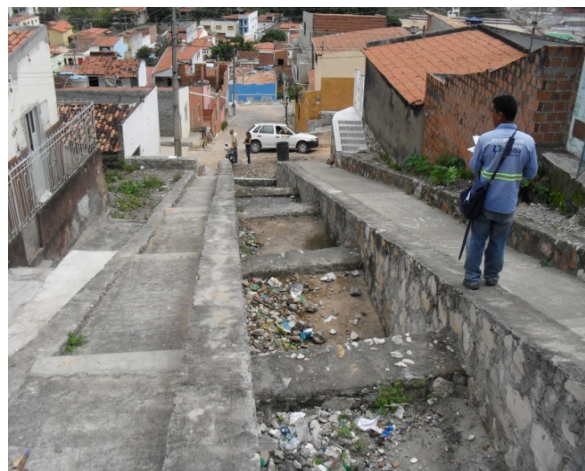
Foto 4: Escadaria drenante que amortece o escoamento das águas de chuva cheia. Pode-se observar a presença de sedimentos e lixo.
