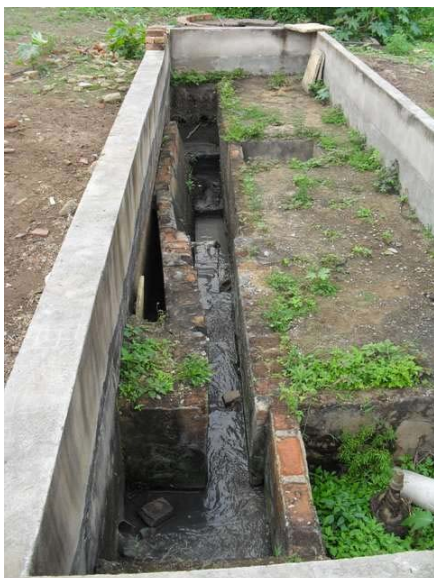
Foto 9: Estação de bombeamento de esgoto abandonada. É ponto de lançamento de esgoto.
