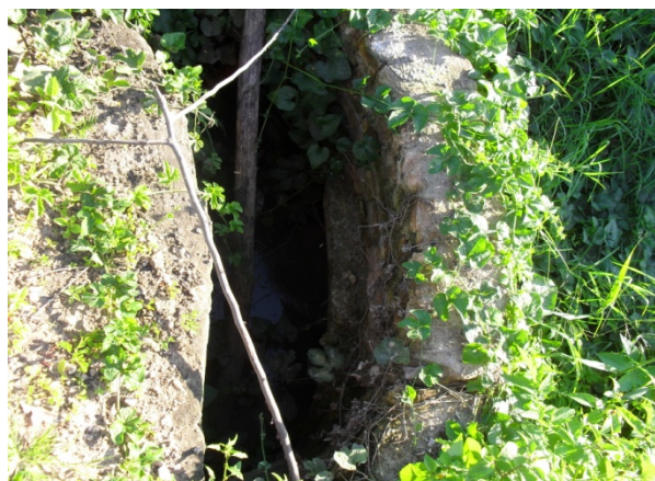
Foto 4: Ponto de lançamento de esgotos sanitários e águas pluviais de parte da região central. Tubulação de concreto de DN 1000mm com saída recoberta por mato.
