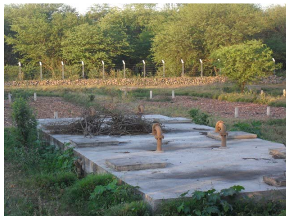
Foto 2: ETE 1 - povoado de Pedras Altas – implantada para esgotamento da Bacia A, é constituída por 6 conjuntos de tanque séptico e vala de filtração.
