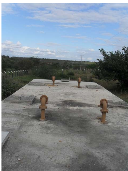
Foto 3: ETE 1 - povoado de Piabas – vista do tanque séptico.
