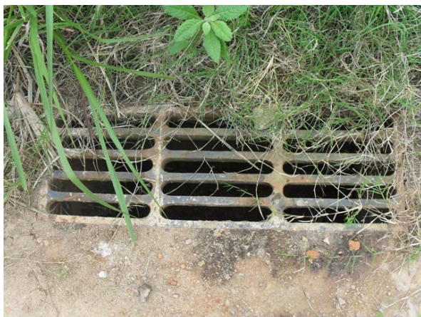
Foto 3: Dispositivo de microdrenagem sem manutenção com presença acentuada de vegetação.
