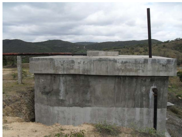
Foto 4: Digestor anaeróbio de fluxo ascendente – DAFA - obras não concluídas.
