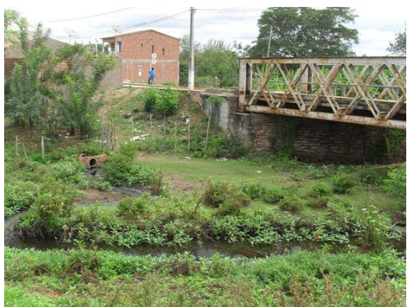
Foto 4: Ponte da Loura – ponto de lançamento de esgoto com contribuição de águas de chuvas –tubulação de DN150mm.
