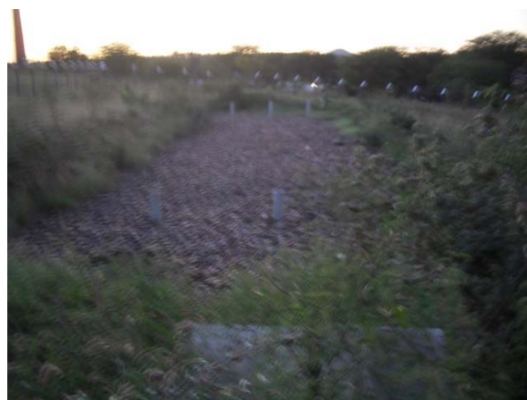
Foto 4: ETE 2 - povoado de Pedras Altas – implantada para esgotamento da Bacia B, possui um conjunto constituído de tanque séptico e vala de filtração.
