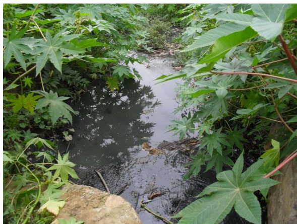
Foto 4: Ponto de lançamento final do canal de alvenaria de pedra com presença de esgotos.
