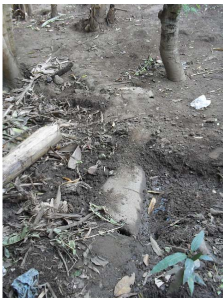
Foto 7: Tubulação de esgoto danificada que passa pelo fundo do quintal de uma casa.
