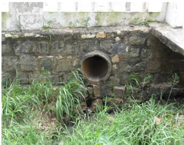
Foto 1: Lançamento pontual de esgotos sanitários e águas pluviais em frente ao local onde deságua o Riacho do Judeu próximo ao Rio do Ouro.
