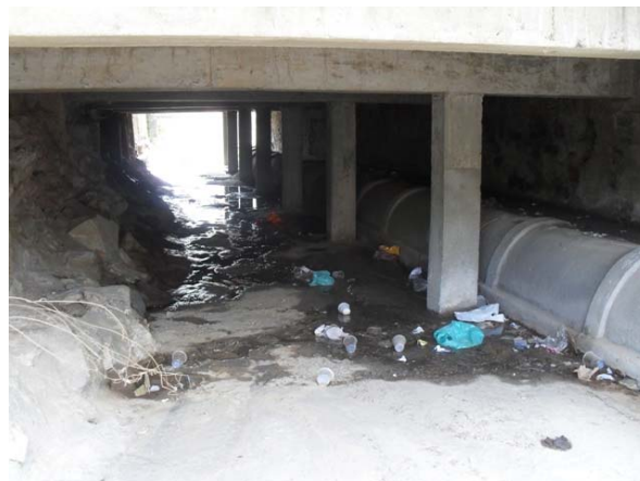
Foto 4: Canal de alvenaria de pedra, com tubulação de esgoto e com construção de prédio feita indevidamente sobre a estrutura.
