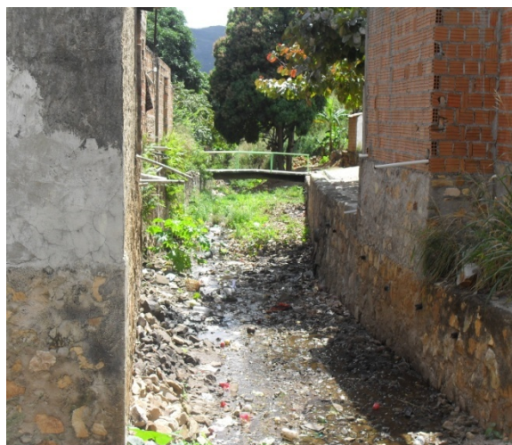
Foto 4: Lançamento direto de esgotos sanitários no riacho da Grotinha. Leito natural seco e com lixo.
