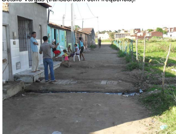
Foto 8: Esgoto sanitário correndo a céu aberto em via não pavimentada
