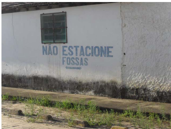
Foto 5: Fossas do hospital construídas ao longo da Rua Getúlio Vargas (transbordam com frequência).
