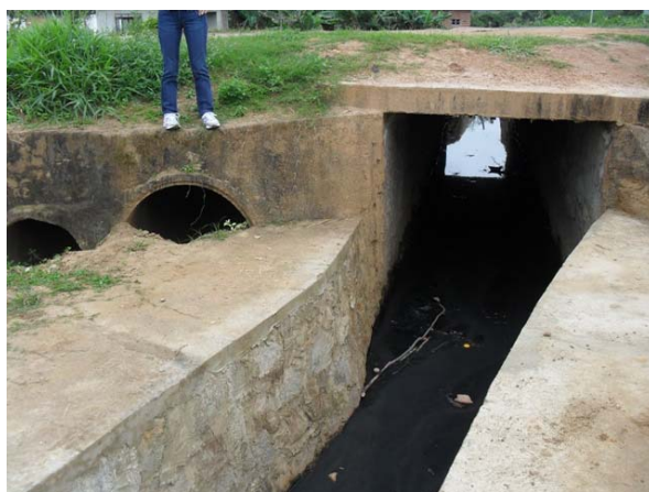
Foto 6: Canal em alvenaria de pedra com presença de esgoto.
