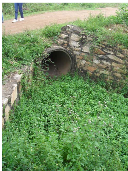
Foto 10: Vista de bueiro sob a rua onde nota-se a presença de vegetação comprovando a falta de manutenção.
