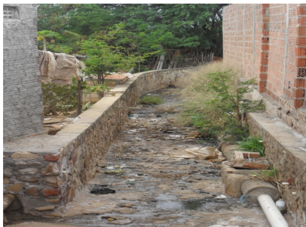
Foto 7: Canal de alvenaria de pedra recebendo esgotos sanitários nos últimos 100m de sua extensão.
