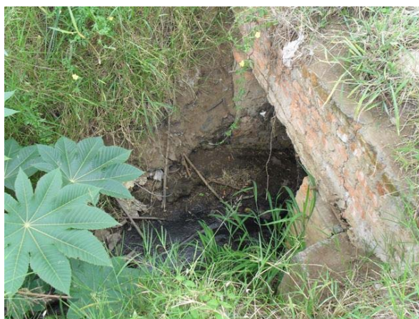
Foto 6: Ponto de lançamento de esgoto com contribuição de águas de chuvas.
