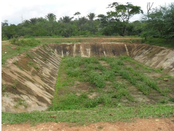
Foto 3: Lagoa de tratamento de esgoto – abandonada por falta de equipamentos para bombeamento.
