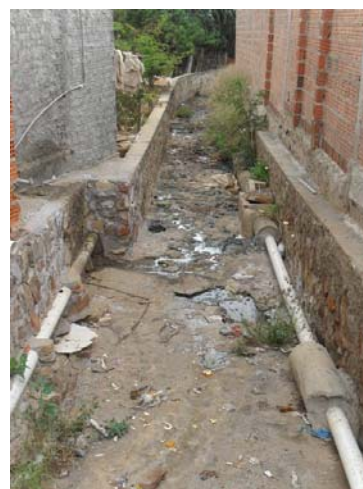
Foto 4: Rede coletora de esgotos sanitários passando por dentro do canal de macrodrenagem revestido em alvenaria de pedra.
