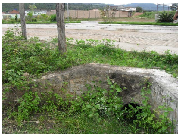
Foto 15: Vista de bueiro sob a Av. Paulo Souto onde nota-se a presença de vegetação comprovando a falta de manutenção.
