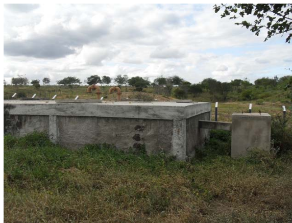
Foto 2: ETE 1 - povoado de Piabas – conjunto constituído de tanque séptico e vala de filtração.
