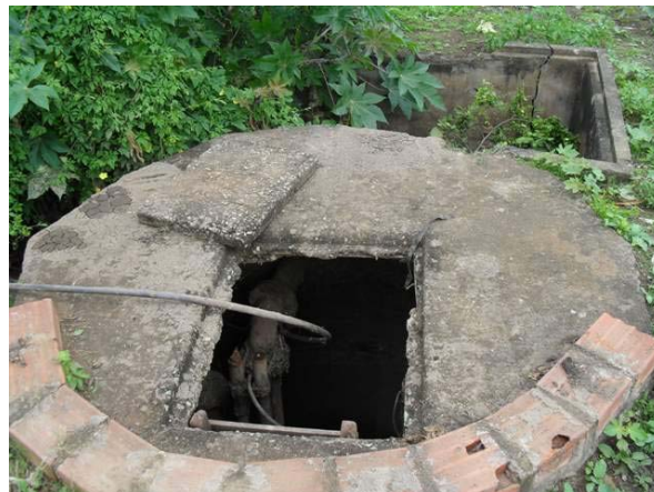
Foto 8: Estação Elevatória sem manutenção.
