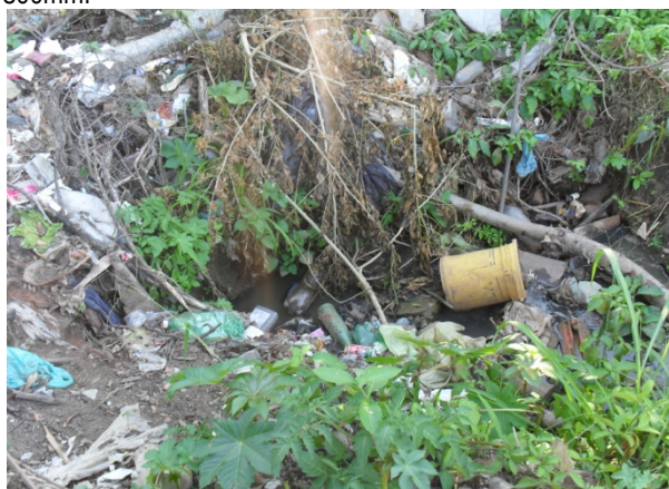
Foto 3: Ponto de lançamento de esgotos sanitários e águas pluviais da Rua Manoel Novaes e adjacências. Tubulação de concreto de DN 1000mm com saída quase totalmente obstruída por conta do lixo.
