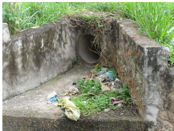
Foto 6: Ponto de lançamento das águas pluviais. Observa-se a falta de manutenção.
