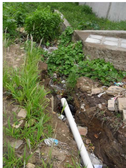
Foto 10: Ponto de lançamento de esgoto secundário – trecho aproximado de 20 casas.
