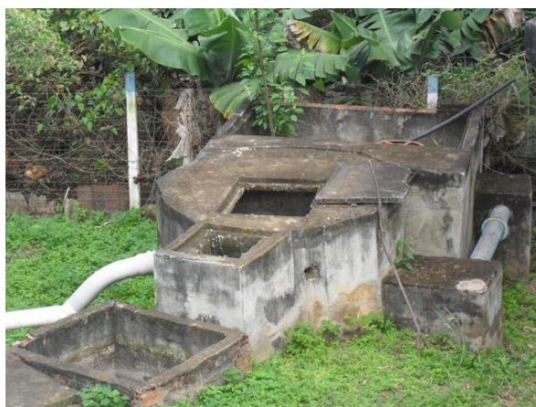
Foto 6: Estação Elevatória sem manutenção.
