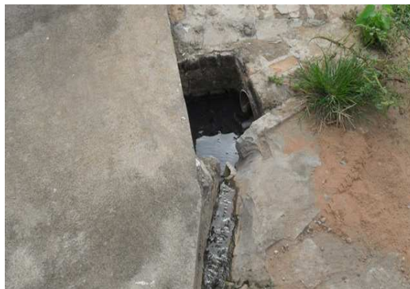
Foto 10: Caixa de drenagem de águas pluviais com esgoto secundário.
