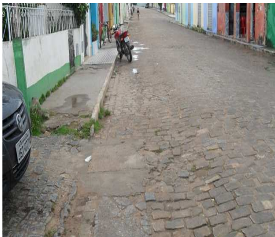
Foto 1: Área de alagamento, cruzamento da Rua 2 de Julho com a Rua Catarino José dos Santos.
