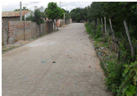
Foto 6: Rua pavimentada com presença de esgoto pelas laterais.
