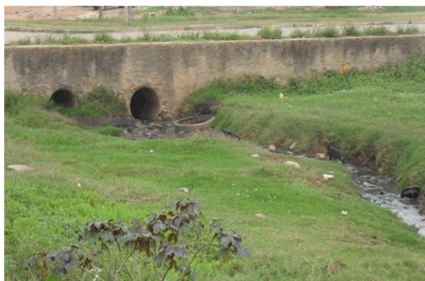
Foto 4: Ponto de lançamento do esgoto para o Rio Vargem, Bueiro próximo da BR-110. Duas manilhas de Ø1000
