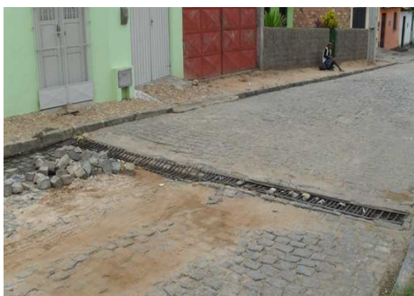
Foto 3 : Rua Travessa do Campo. Drenagem com grelha horizontal.
