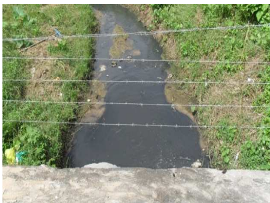
Foto 3: Ponto de lançamento de esgoto. Próximo da Av. Luis Viana Filho.
