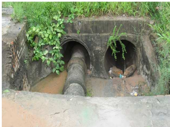
Foto 2: Segundo ponto do canal a céu aberto – tubulação de esgoto que vai para o tanque São Paulo Velho, próximo da BA 220.
