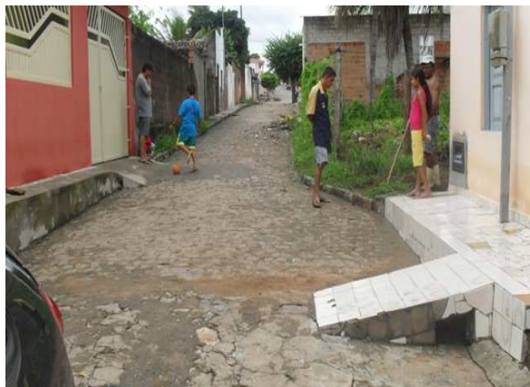
Foto 2: Rua José Ribeiro, água de alagamento e lançamento para o canal receptor.
