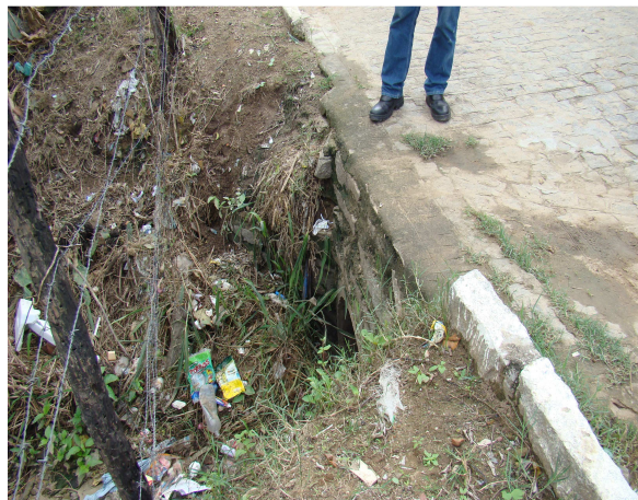
Foto 2: Rua Simões Filho – descarte de esgoto.
