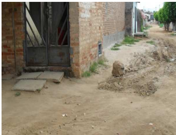
Foto 1: Área crítica 1, caracterizada por freqüentes alagamentos, Rua São Felix.
