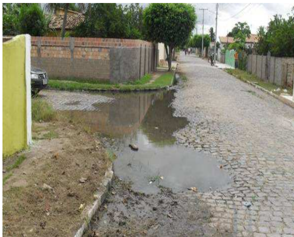
Foto 7: Área de lançamento de esgoto a céu aberto secundário.
