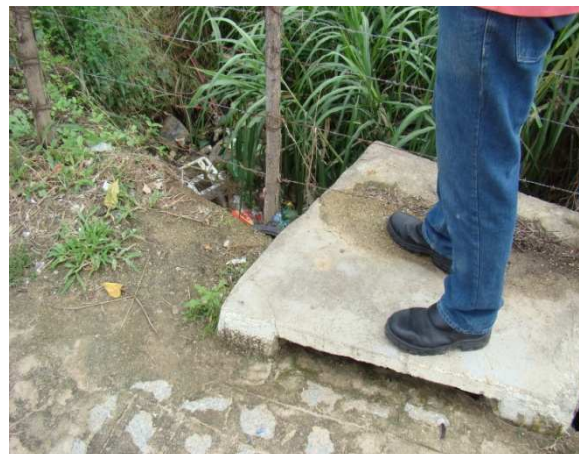
Foto 4: Rua Bonfim – Final da galeria de águas pluviais
