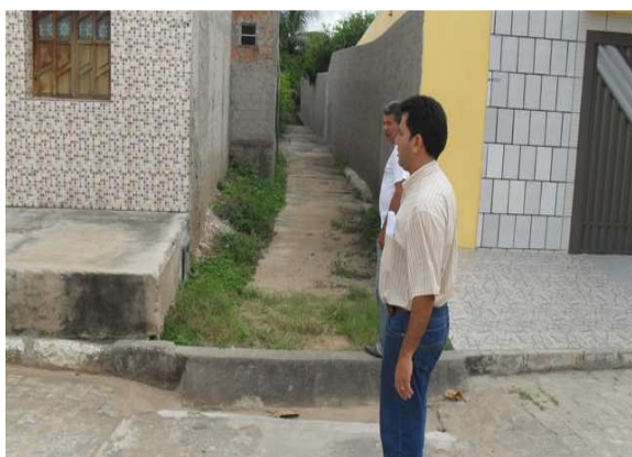
Foto 9: Rua Princesa Isabel. Área de escoamento de Águas Pluviais que passa pelo corredor ao lado da casa.
