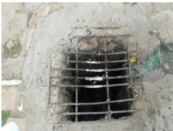
Foto 11: Caixa de chegada com grelha horizontal.
