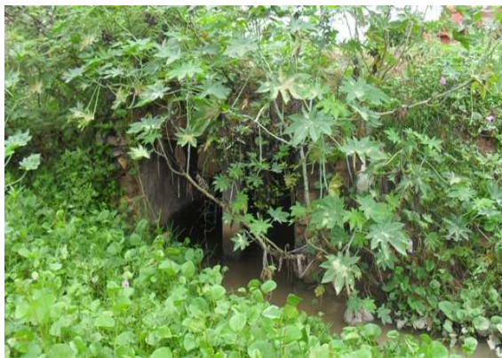
Foto 1: Primeira Travessa Tancredo Neves. Bueiro construído pelo proprietário do terreno.
