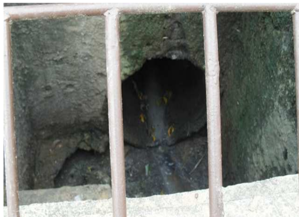
Foto 8: Detalhe caixa de concreto, com presença de esgoto secundário.
