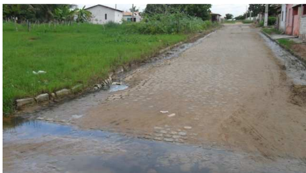
Foto 3: Área de lançamento com esgoto a céu aberto. Rua Ovídio Rodrigues de Matos.
