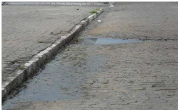
Foto 1: Esgoto a céu aberto - Praça Frei Sarafin.
