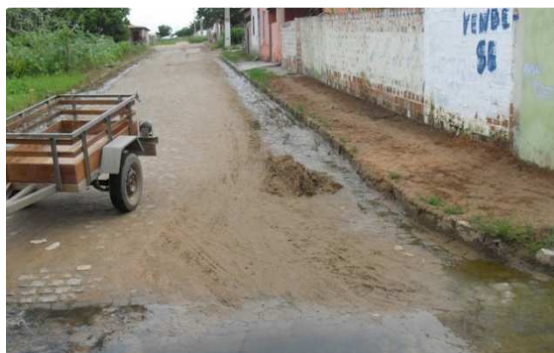
Foto 4: Área de lançamento com esgoto a céu aberto. Rua Ovídio Rodrigues de Matos.
