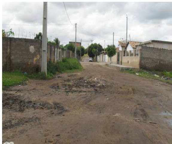
Foto 8: Rua não pavimentada com acumulação de águas pluviais e esgoto.
