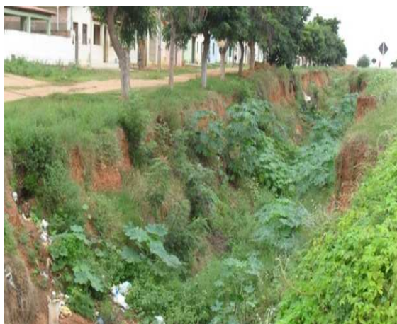
Foto 5: Canal aberto próximo da BR-110, apresentando trecho com erosão.
