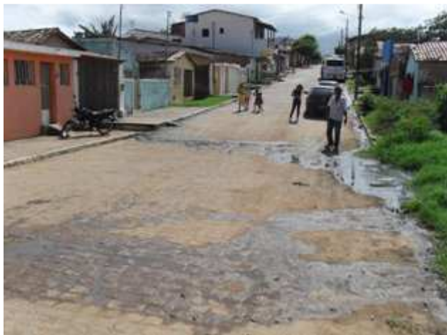
Foto 1: Esgoto secundário correndo à céu aberto
