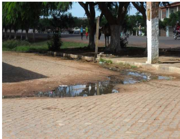
Foto 2: Escoamento superficial AP/Esgoto secundário.
