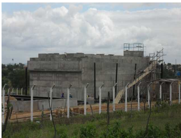
Foto 9: Estação de Tratamento de Água da Embasa. Próximo a BR116
