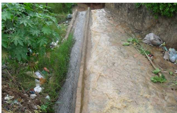
Foto 11: Estrada São José da Fortaleza. Drenagem ao longo da estrada. Canal a céu aberto.
