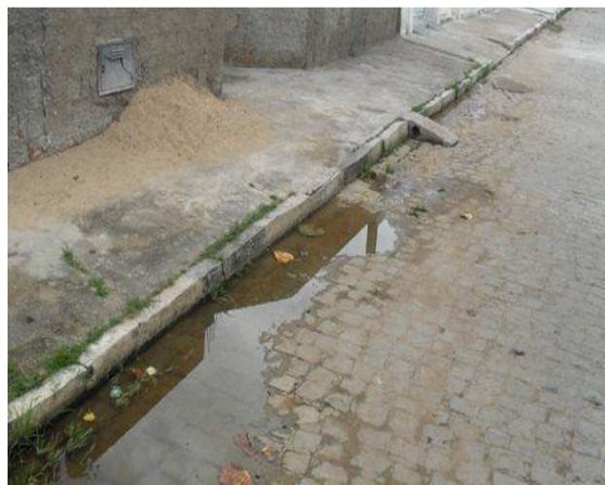
Foto 2: Filete de água nas sarjetas.
