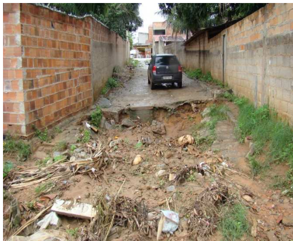
Foto 1: Ponto de erosão ocasionado pelas chuvas.
