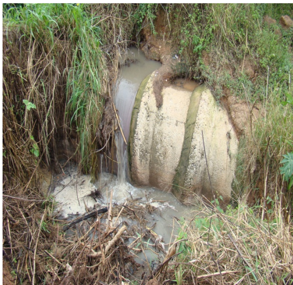
Foto 1: Rua Alexandre Ferreira – Dafa inoperante.
