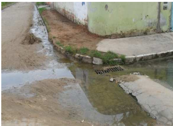
Foto 3: Área de alagamento, ponto de escoamento da água pluvial.
