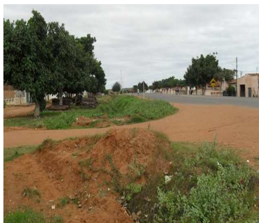
Foto 6: Área de alagamento próxima da BR-110.
