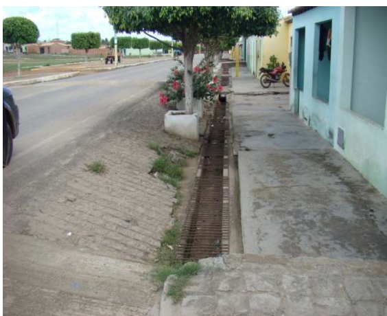
Foto 6: Sistema de drenagem – Área crítica.
