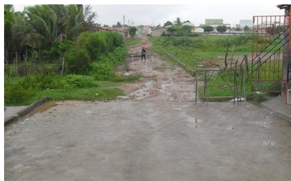
Foto 4: Rua Nova Brasília - Área de alagamento. Ponto de lançamento do esgoto que vai para BA 220
