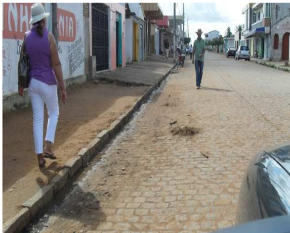
Foto 1: Escoamento e lançamento de esgoto a céu aberto na sarjeta.
