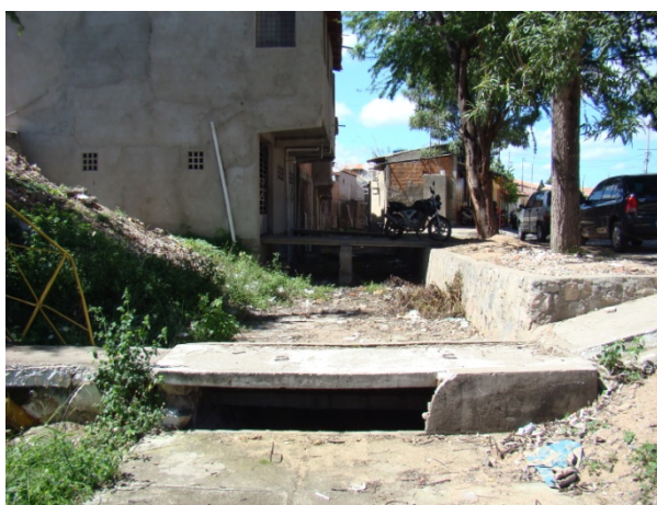
Foto 3: Galeria de macro drenagem – Rua Alagoinhas.
