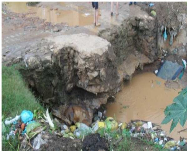
Foto 1: Rua dos Missionários, ponto de chegada do esgoto que vem da Av. ACM.
