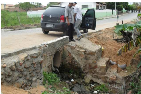
Foto 5: Ponto de lançamento de esgoto com manilha de 400. Av. Francisco Matos.
