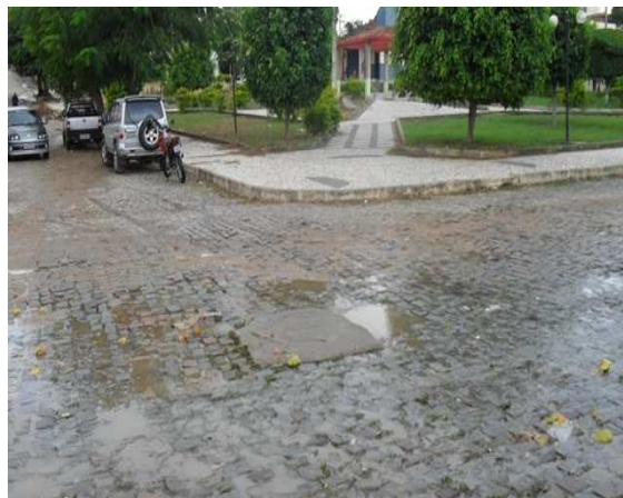
Foto 2: Caixa receptora que recebe esgoto da Orlando Teixeira e da Rua José Ferreira Lima.
