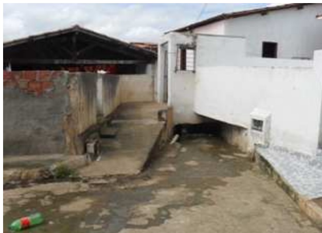
Foto 2: Boca-de-lobo sob edificação. Contribuição de águas pluviais e esgotos ao canal.
