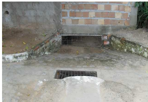
Foto 2: Ponto de chegada da água pluvial. Drenagem com grelha e valeta que funciona como guia passando por debaixo do muro.
