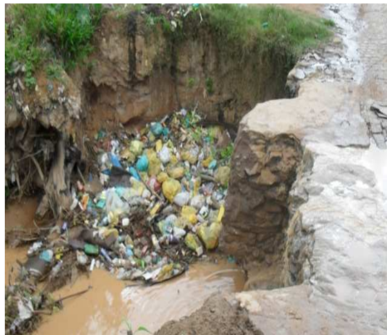
Foto 2: Rua dos Missionários, detalhe da chegada do esgoto vendo-se um processo de erosão e deposição de lixo.
