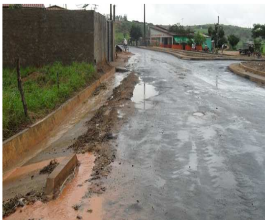
Foto 9: Bueiro BR-110, escoamento de águas pluviais que desce pela Rua Maria Batista dos santos.
