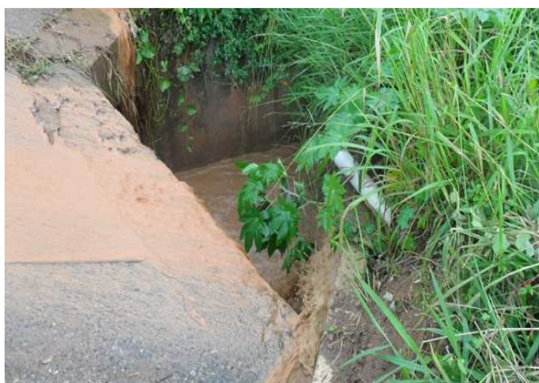
Foto 3: Rua dos Missionários, ponto de chegada de água e esgoto. Sistema Misto.
