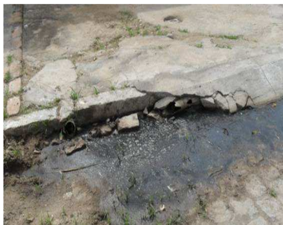
Foto 2: Lançamento de esgoto secundário.
