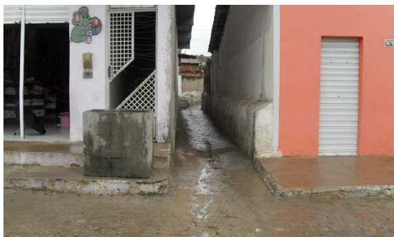
Foto 7: Beco por onde passa o escoamento de águas pluviais para Av. Nossa Senhora de Fátima
