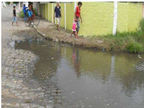
Foto 1: Área de alagamento com lançamento de águas pluviais e esgoto.
