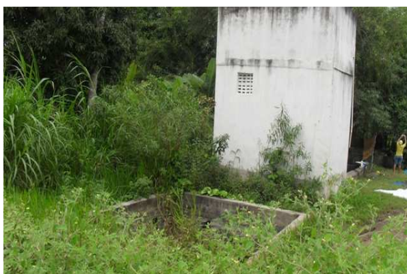
Foto 6: Estação elevatória antiga próxima da Av. Genival Lucas.
