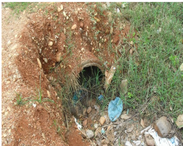
Foto 1: Bueiro ponto de lançamento de esgoto próximo a BR-349.
