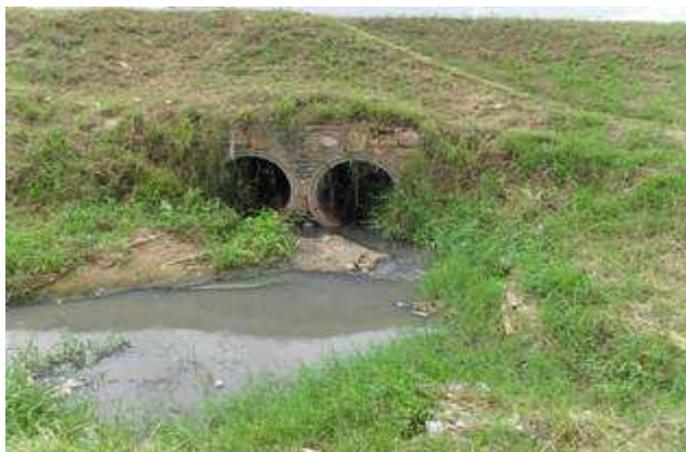
Foto 5: Bueiro duplo sob estrada
