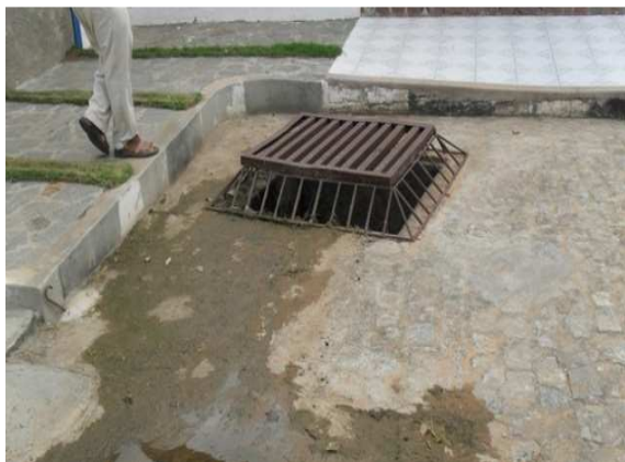
Foto 9: Micro-drenagem caixa com grelha.
