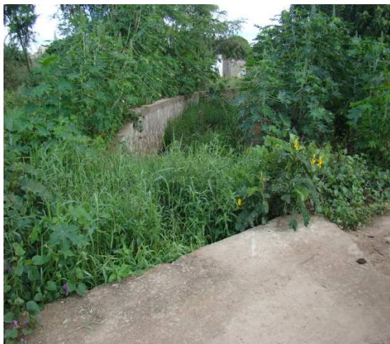
Foto 1: Final da Galeria de Macrodrenagem . Alto das Pedreiras.
