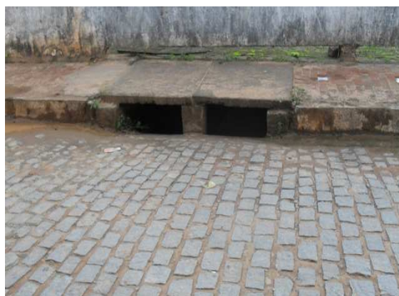
Foto 4: Caixa receptora de concreto encostada ao passeio do Hospital Luis Eduardo Magalhães. Rua Edgar Santos.
