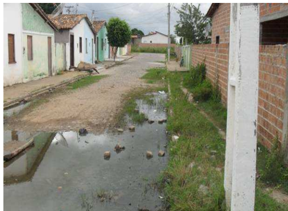
Foto 4: Esgoto secundário a céu aberto.
