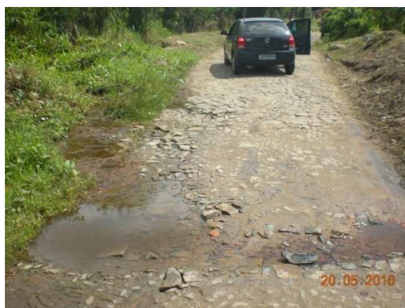
Foto 20: Rua do Pontilhão – Área de alagamento.
