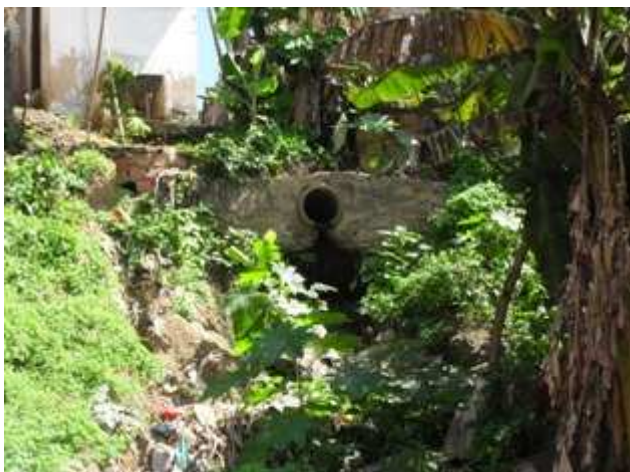
Foto 3: Ponto de lançamento de drenagem com contribuição de esgoto
