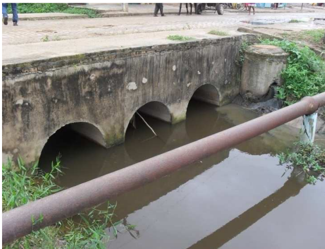
Foto 17: PV danificado lançando esgoto em canal no Bairro Aviários
