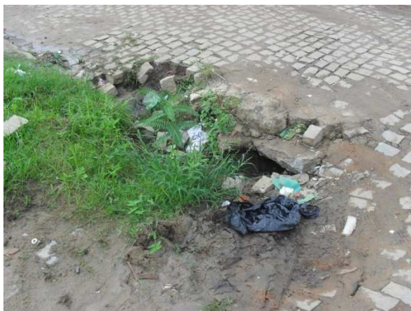
Foto 21: Dispositivo de microdrenagem danificado na área crítica dos Aviários.
