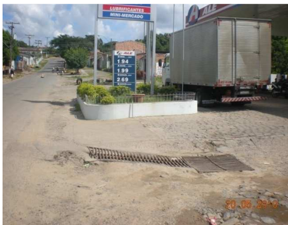
Foto 17: Drenagem com grelha – Final da Av. Artur Magalhães, próximo ao posto de gasolina na BR 101.
