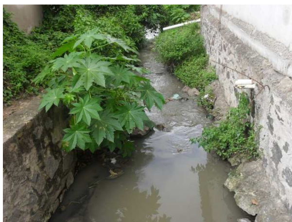
Foto 28: Canal da Chácara da Mangabeira - Local de área crítica.
