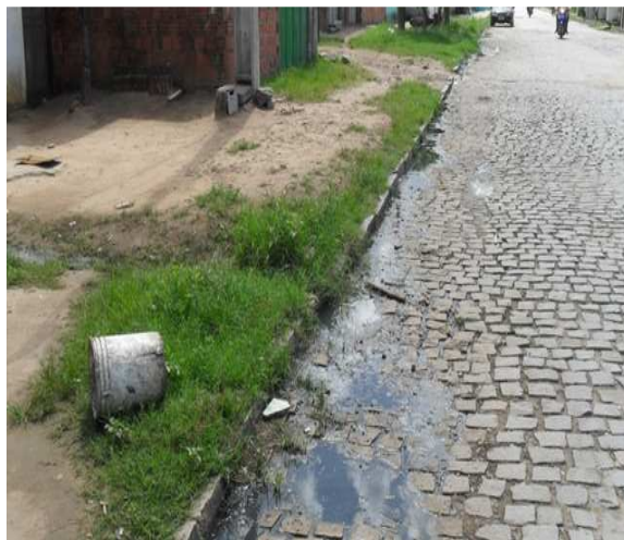
Foto 2: Ponto de lançamento de esgotos na sarjeta – lançamento a céu aberto.
