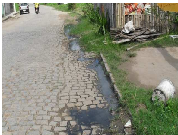
Foto 3: Ponto de lançamento de esgotos na sarjeta – lançamento a céu aberto.
