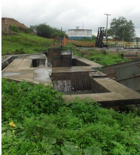
Foto 1: Gradeamento na ETE da Bacia do Jacuípe
