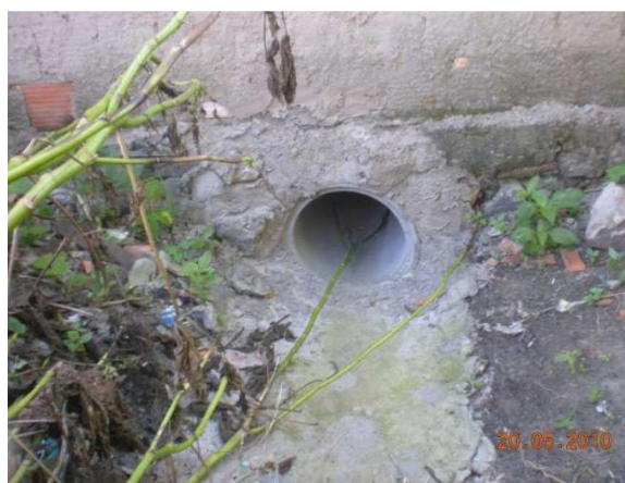
Foto 28: Linha DN 1000 mm, vem do centro e atravessa a Rua Tancredo Neves e passa pelo fundo
