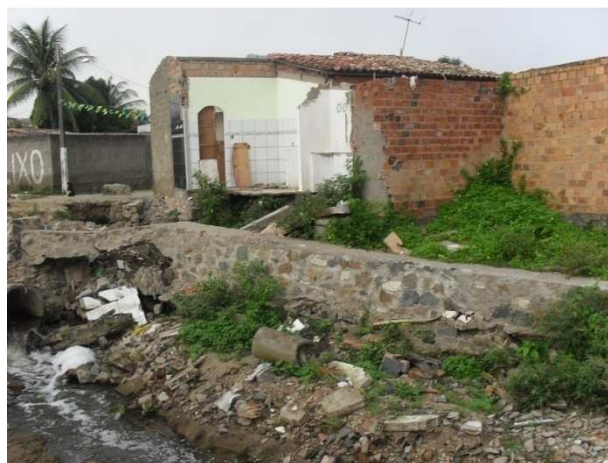
Foto 14: Local onde havia uma casa, destruída pelas águas do canal no Conjunto Feira X.
