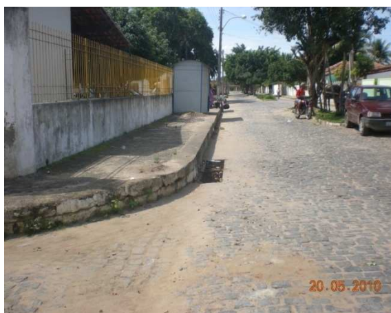
Foto 8: Área de alagamento – Rua Zulmira Chagas, Rua do Hospital cruzam com a Rua Antônio Nunes.
