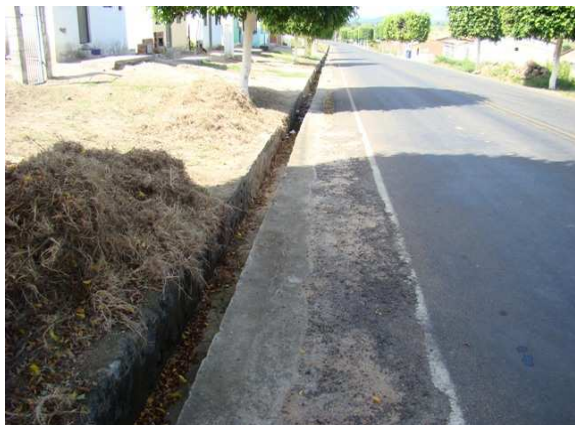
Foto 1: Canaleta de microdrenagem com contribuição de esgoto secundário
