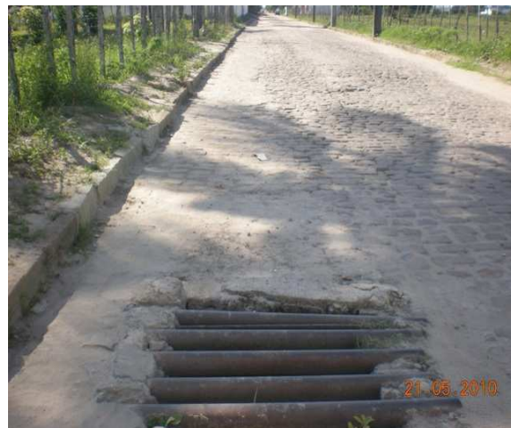
Foto 2: Área de alagamento - Rua da Independência próxima ao Colégio Atenas. Caixa de chegada.
