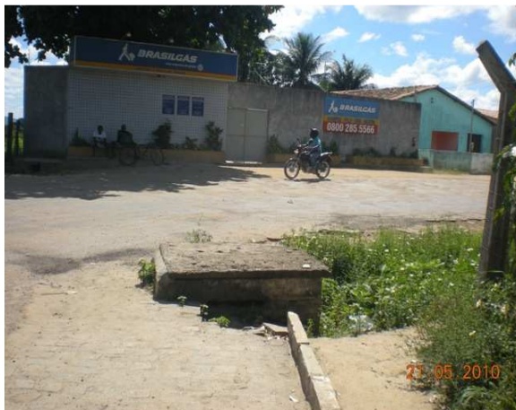
Foto 5: Caixa de chegada do esgoto próximo do posto da Brasilgás. Joga para o brejo.
