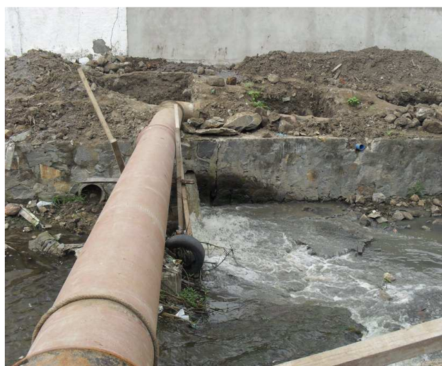
Foto 16: Ponto de extravazão de esgoto da Estação Elevatória em canal do Bairro Feira X
