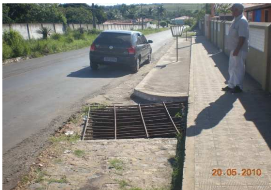
Foto 31: Caixa de drenagem com grelha Rua Vigário Galdino.
