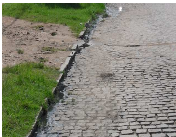
Foto 4: Ponto de lançamento de esgotos na sarjeta – lançamento a céu aberto.
