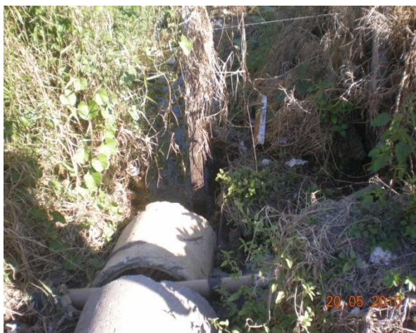
Foto 35: Final da Rua Vigário Galdino chegada da tubulação de DN 1000 mm. Área de alagamento.
