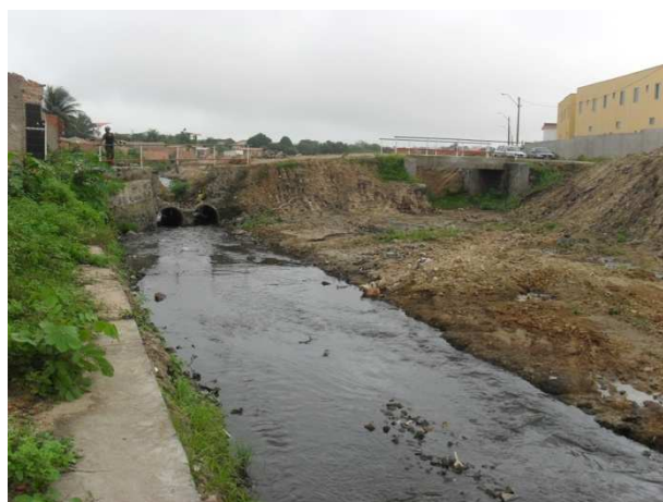
Foto 18: Vista do bueiro duplo danificado e do pontilhão no Conjunto Feira X.
