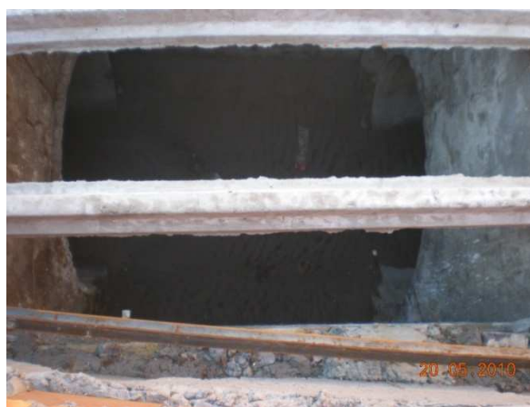
Foto 26: Linha de DN 1000 mm, vem do centro e atravessa a Rua Tancredo Neves e passa pelo fundo da casa 78 – Reduz para DN 400 mm em trecho aberto e desce pela Rua Rio de Janeiro.
