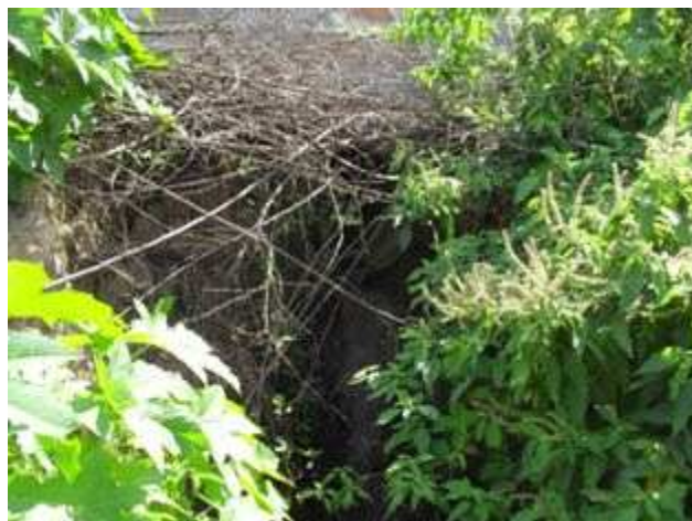
Foto 4: Ponto de lançamento de drenagem com contribuição de esgoto
