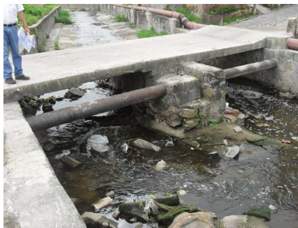
Foto 36: Ponto de obstrução no canal do Conjunto Feira X.
