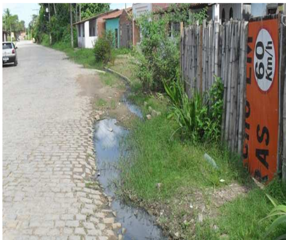
Foto 1: Área de lançamento de esgotos na sarjeta – lançamento a céu aberto.
