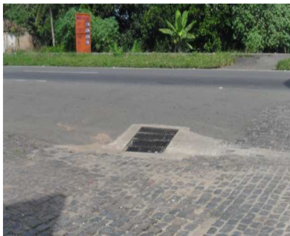
Foto 8: Dispositivo de drenagem horizontal, próximo à BR-324.
