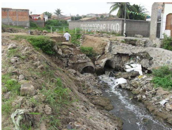
Foto 13: Bueiro duplo destruído no Conjunto Feira X.
