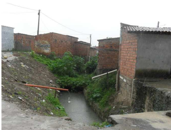
Foto 7: Canal no Feira VII com lançamento difuso e casas construídas numa área crítica de alagamento, às margens do canal.
