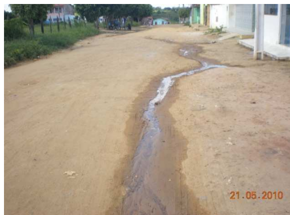
Foto 8: Rua João Pimentel - esgoto a céu aberto.
