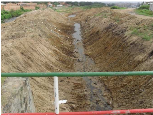
Foto 19: Canal escavado recentemente paralelo ao curso d'água existente como tentativa de solucionar os alagamentos no Conjunto Feira X.
