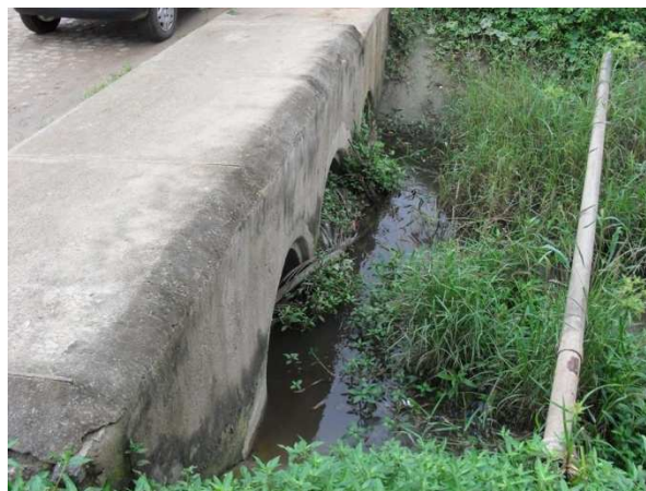
Foto 22: Bueiro triplo carente de manutenção na região dos Aviários.
