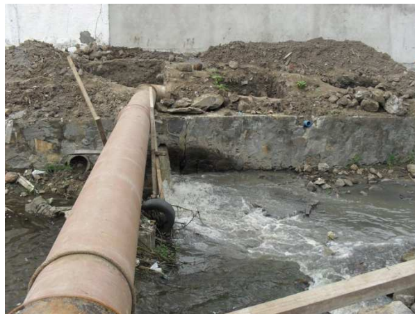
Foto 38: Local de extravazão de esgoto da estação elevatória no canal do Conjunto Feira X.
