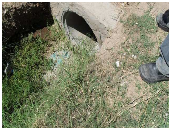
Foto 12: Tubulação de concreto de 600mm. Praça Hermes Fagundes.
