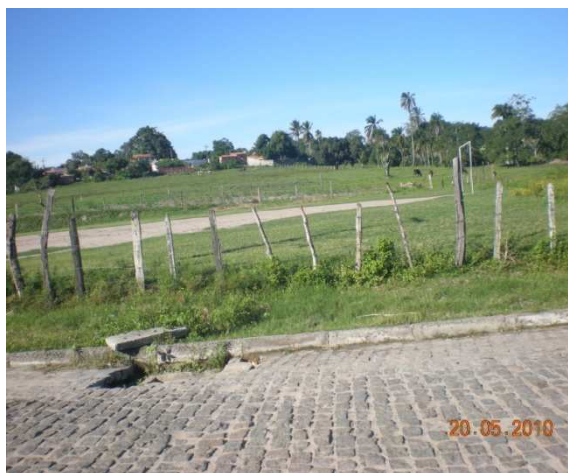
Foto 36: Área de alagamento, Av. José Sarney – caixa de visita.
