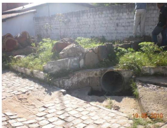
Foto 4: Rua Padre Mato Grosso. Linha de drenagem DN 800mm. Há 4 PVs em toda extensão da rua.
