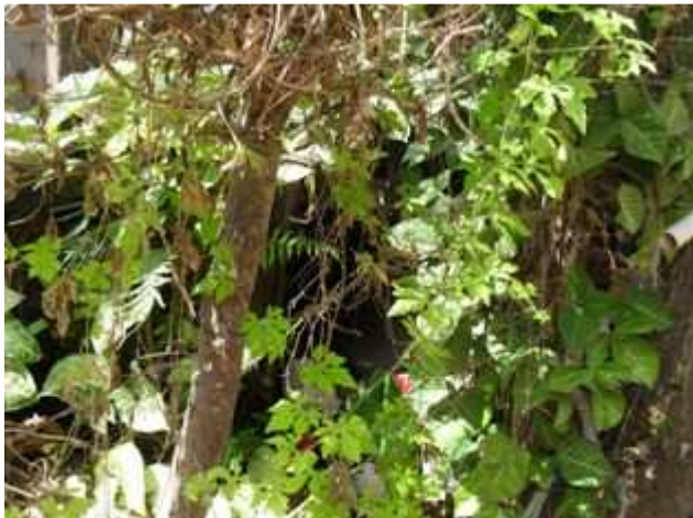
Foto 1: Ponto de lançamento de drenagem com contribuição de esgoto
