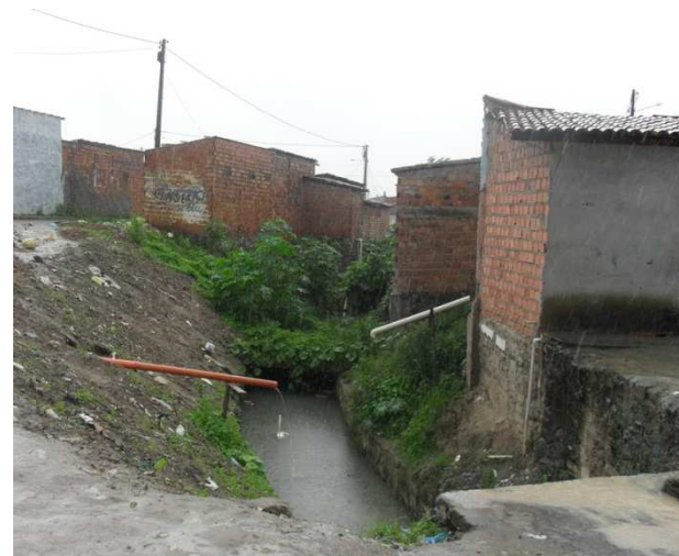
Foto 20: Lançamento difuso de esgoto em canal
