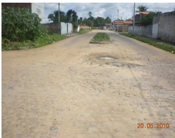
Foto 3: Área de alagamento – Drenagem e PVs, Rua Zulmira Chagas, Rua do Hospital cruzam coma Rua Antônio Nunes.
