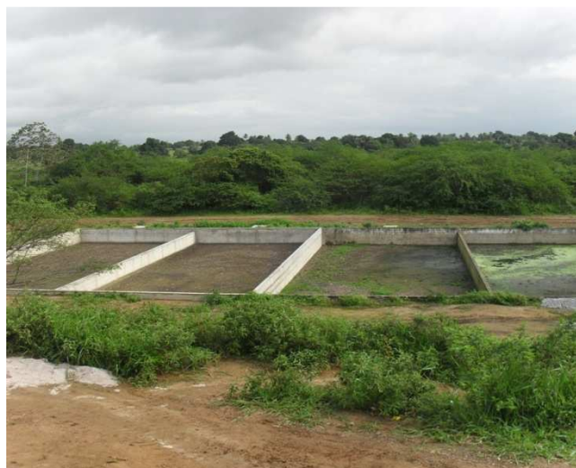
Foto 12: Leitos de secagem na ETE da Bacia do Subaé
