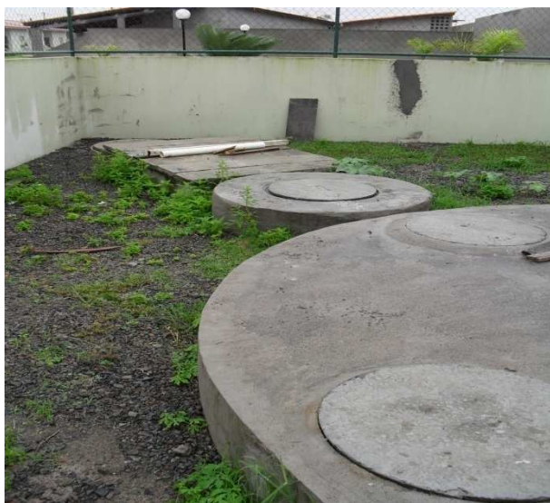
Foto 27: ETE do Condomínio Parque das Azaléias (Caixa de areia e DAFA)
