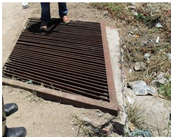
Foto 24: Grelha para drenagem de águas pluviais.
