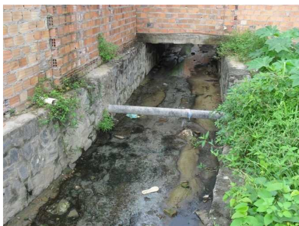
Foto 15: Canal no Conjunto Feira X com construções sobre ele.
