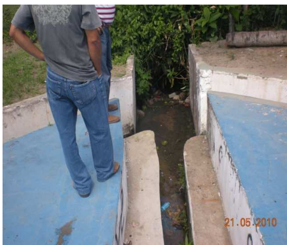
Foto 3: Final da Fonte das Palmeiras - lançamento de esgoto para o brejo.
