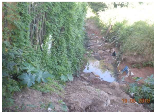
Foto 14: Ponto de lançamento que vem da Rua Duque de Caxias e área de erosão no funda de casa (Área de alagamento).
