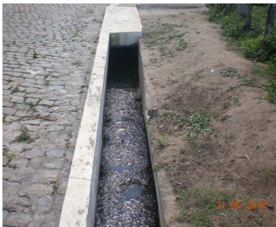
Foto 1: Rua Maria Quitéria. Fonte das Palmeiras, Canaleta de alvenaria lançamento de esgoto próximo da fonte.
