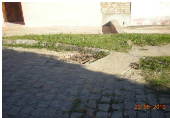
Foto 30: Praça Hermes Fagundes – caixa de visita de rede de manilhas de DN 300 mm, que vai para saída do final da Rua Vigário Galdino.
