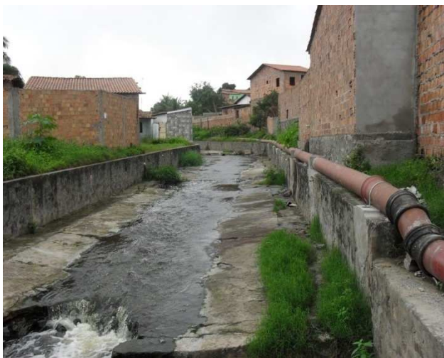
Foto 19: Linha de recalque margeando canal no Bairro Feira X
