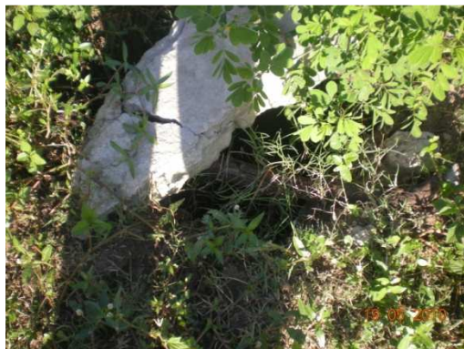
Foto 13: Ponto de lançamento que vem da Rua Duque de Caxias (Área de alagamento).
