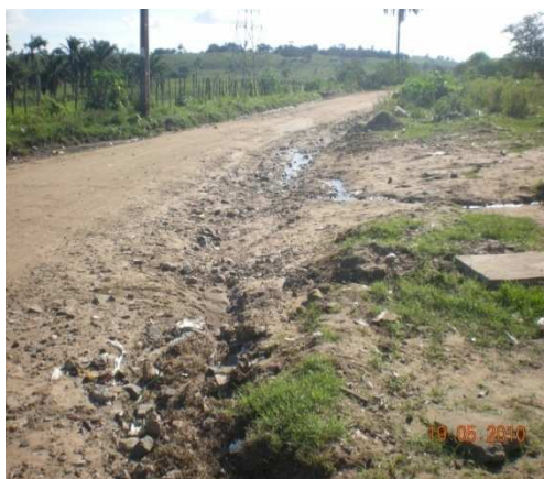
Foto 7: Área de alagamento Rua: Padre Mato Grosso 1º PV, final da Rua Mato Grosso próximo a fonte.
