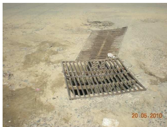
Foto 16: Drenagem com grelha – Final da Av. Artur Magalhães, próximo ao posto de gasolina na BR 101.
