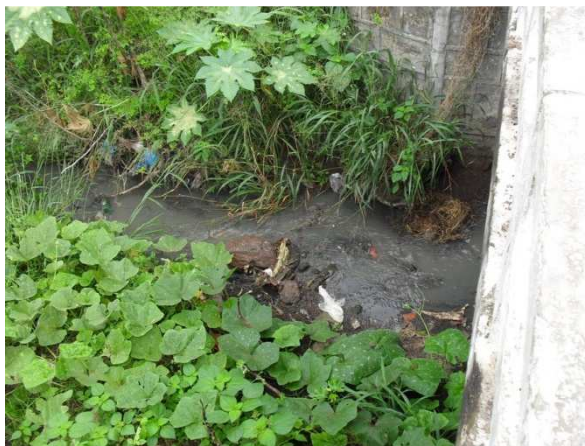
Foto 2: Ponto de lançamento de esgoto
