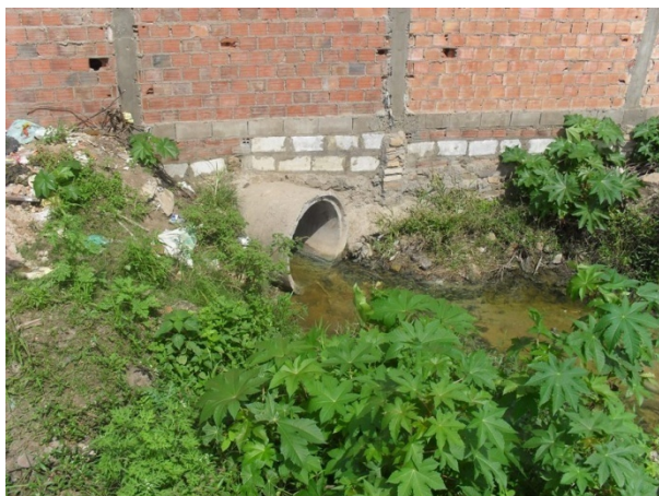
Foto 25: Bueiro no bairro Mangabeira. Local de área crítica.
