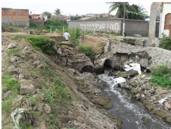
Foto 13: Bueiro duplo destruído no Feira X
