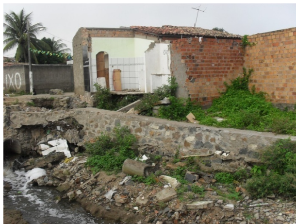
Foto 14: Local onde havia uma casa, destruída pelas águas do canal no Feira X
