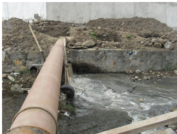
Foto 38: Local de extravazão de esgoto da estação elevatória no canal do Feira X
