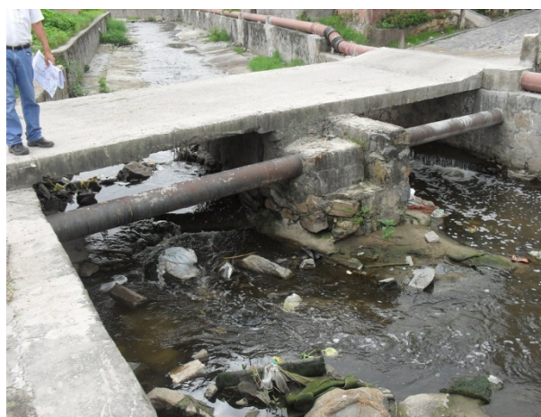
Foto 36: Ponto de obstrução no canal do Feira X
