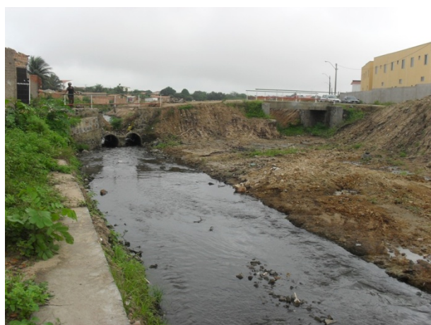
Foto 18: Vista do bueiro duplo danificado e do pontilhão no Feira X.
