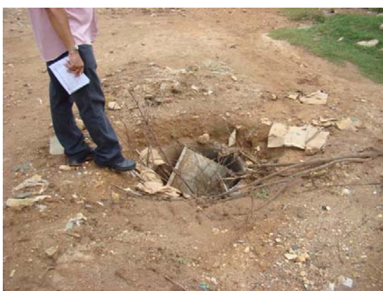
Foto 9: Poço de visita obstruído e assoreado. (Registro fotográfico D em planta)
