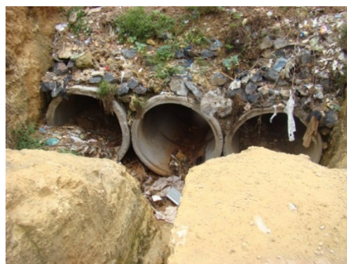
Foto 6: Vista das manilhas assoreadas. (Registro fotográfico E em planta)
