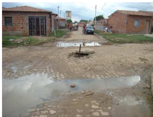
Foto 4: Poço de visita danificado e área com água empoçada
