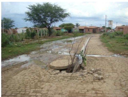
Foto 3: Poço de visita danificado e área com água empoçada
