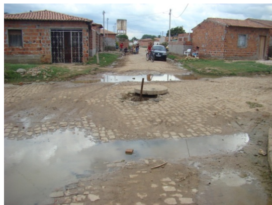
Foto 4: Poço de visita danificado e área com água empçada
