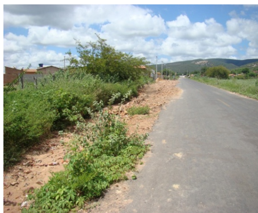
Foto 4: Erosão na lateral da pista que vai para o Povoado.
