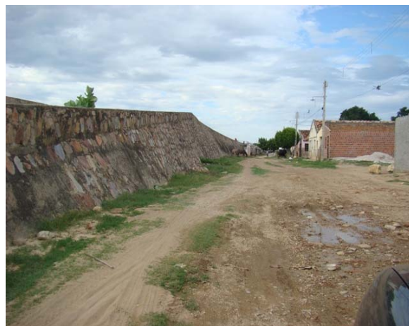
Foto 8: Contenção do rio que margeia a cidade
