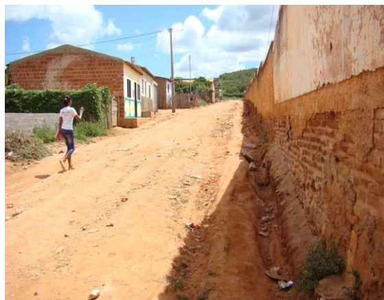
Foto 4: Vista da Travessa São Cristóvão com erosão.
