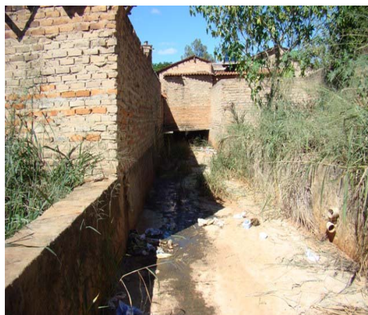
Foto 4: Vista do Canal com casa construída em cima.
