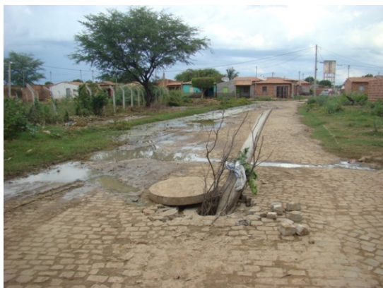
Foto 3: Poço de visita danificado e área com água empçada
