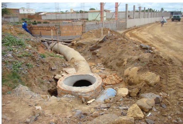
Foto 7: Vala com Poço de Visita e rede de 600 mm.
