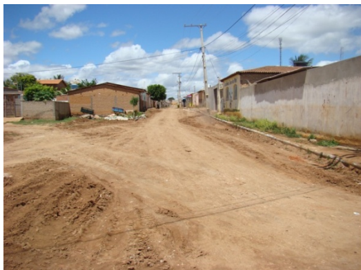
Foto 1: Rua Sidelcino Andrade a ser pavimentada sem drenagem.
