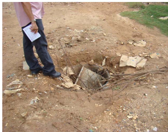
Foto 4: Poço de visita obstruído e assoreado.
