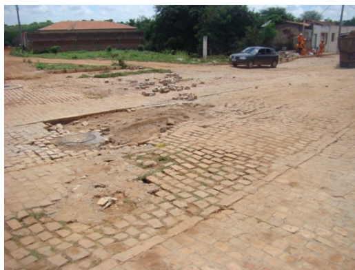
Foto 5: Rua evidenciando processo erosivo.
