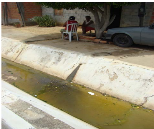
Foto 1: Canal de macrodrenagem com contribuição de esgoto
