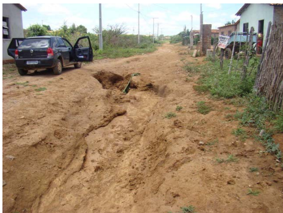
Foto 4: Rua evidenciando processo erosivo.
