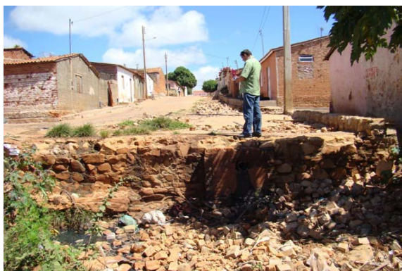
Foto 3: Travessa Santa Luzia, final de despejo da rede de esgoto vindo da Av. Saldanha da Gama.
