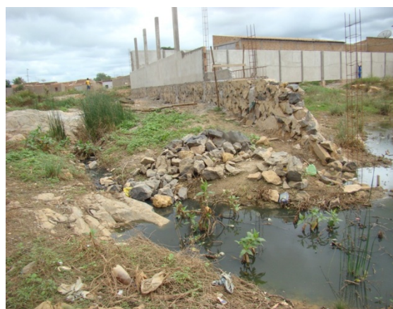
Foto 4: Vista do Reservatório 2 com macro chegada de esgoto.
