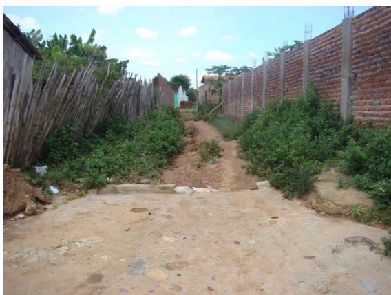
Foto 6: Rua evidenciando processo erosivo.
