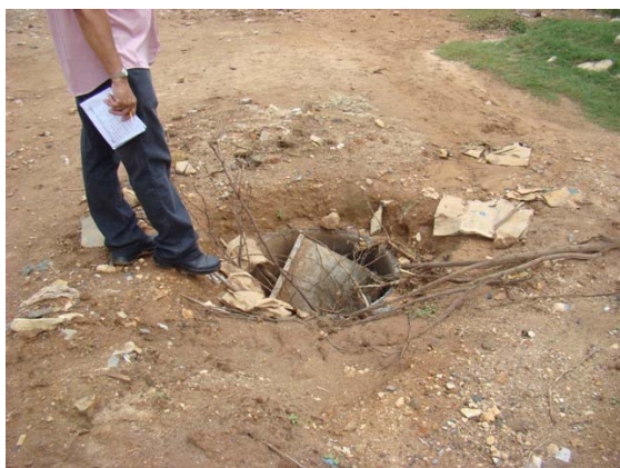
Foto 9: Poço de visita obstruído e assoreado.
