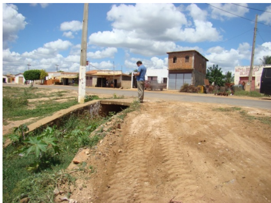
Foto 1: Ponto de descarga da 3ª macro drenagem – entrada da cidade - Av. Presidente Dutra.
