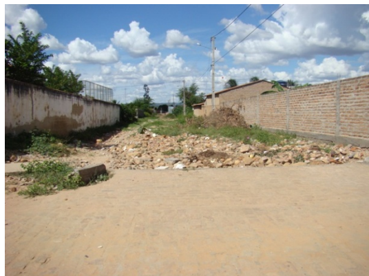
Foto 2: Erosão na rua ao lado da Secretaria Municipal de Saúde.
