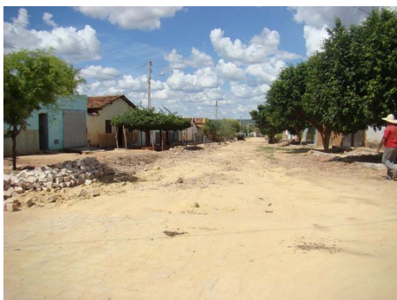
Foto 3: Erosão na Rua D. Pedro I.
