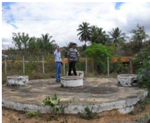
Foto 8: DAFA da estação de tratamento de esgoto
