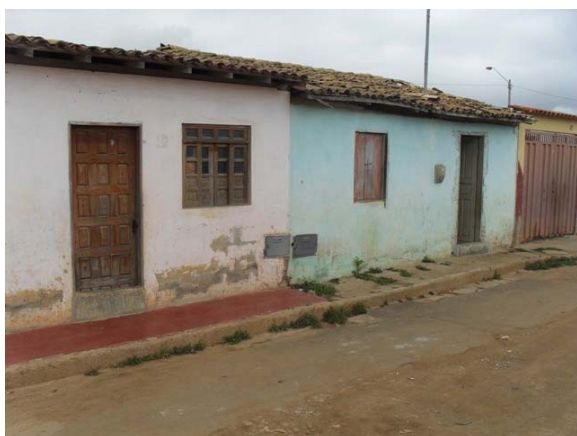
Foto 47: Área Crítica 4 – Alagamento – Bairro Santa Cruz – Rua 4 entre as ruas 8 e 11 – Reação aos alagamentos com elevação dos batentes das casas.
