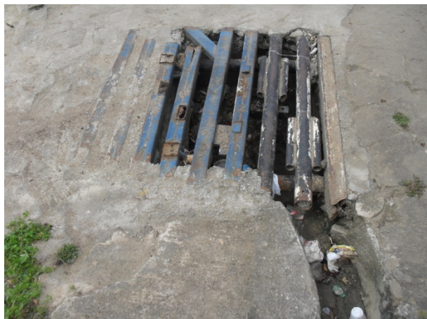
Foto 1: Praça da Feira. Detalhe da caixa coletora com grelha que dá início a uma rede de microdrenagem que tem saída na rua Castro Alves.
