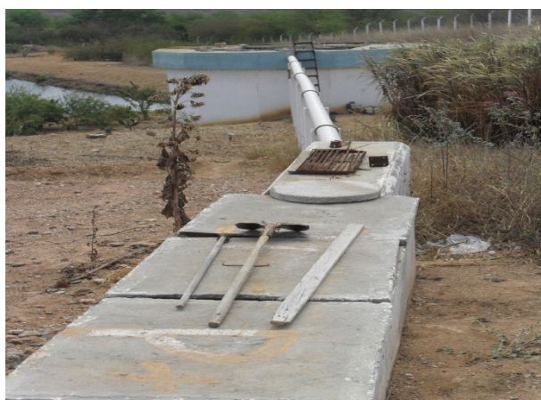
Foto 3: Estruturas de entrada da Estação de Tratamento de Esgoto. Sistema constituído de pré-tratamento, seguido de DAFA e lagoa facultativa.
