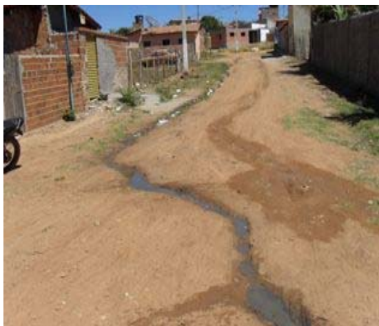
Foto 1: Esgoto secundário escoando por vias não pavimentadas
