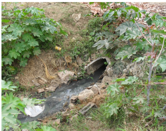
Foto 3: Ponto de lançamento de águas pluviais e esgotos sanitários
