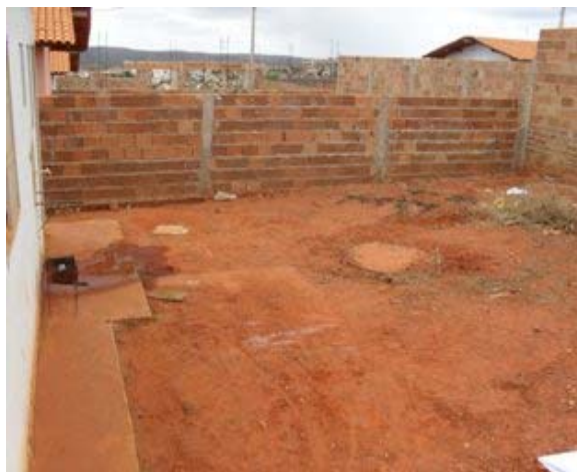
Foto 6: Fossa séptica e sumidouro, presentes em todas as casas populares construídas recentemente
