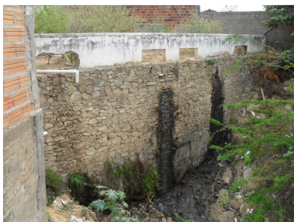
Foto 4: Lançamento de esgotos sanitários de modo difuso no Riacho de Lúcio. Situação pouco significativa diante do baixo número de casos observados.
