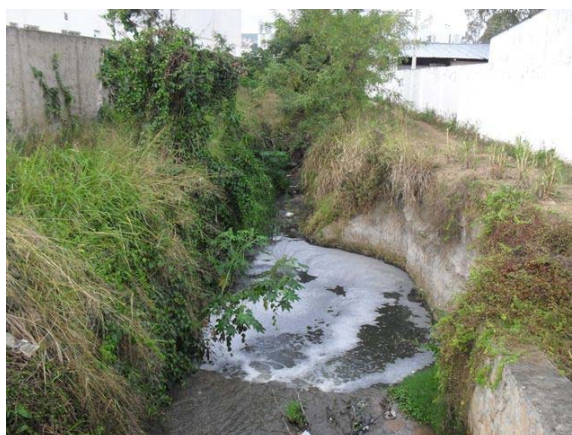
Foto 36: Canal 11 – Trecho do canal sem revestimento e repleto de vegetação com deságüe no Córrego Verruga.
