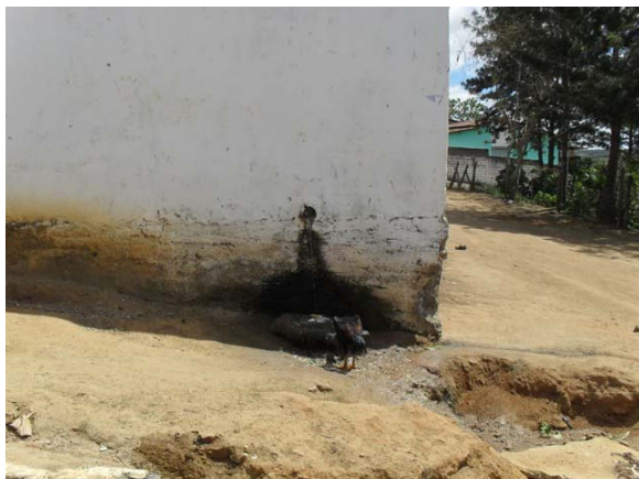
Foto 7: Lançamento de esgoto a céu aberto.
