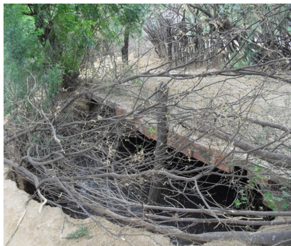
Foto 2: Sistema de fossas comunitárias. As estruturas nunca tiveram manutenção e na ocasião da visita apresentavam vazamentos.
