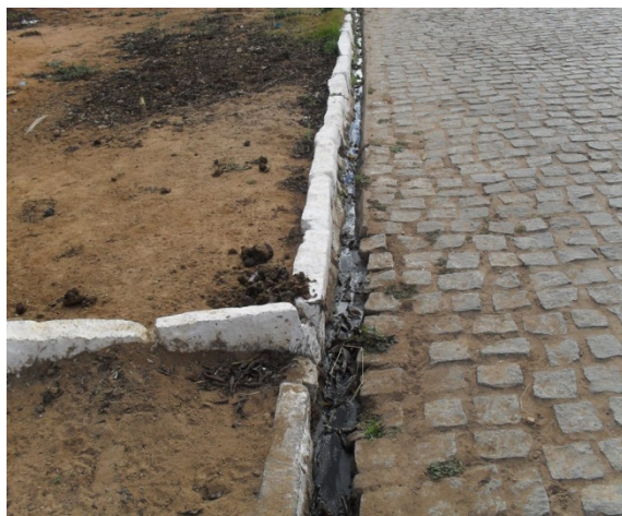
Foto 2: Rua da Lagoa – esgoto a céu aberto.
