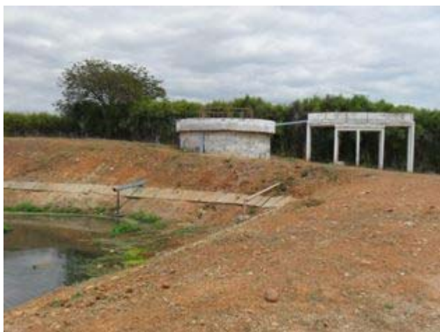
Foto 3: DAFA e estrutura com gradeamento e caixa de areia
