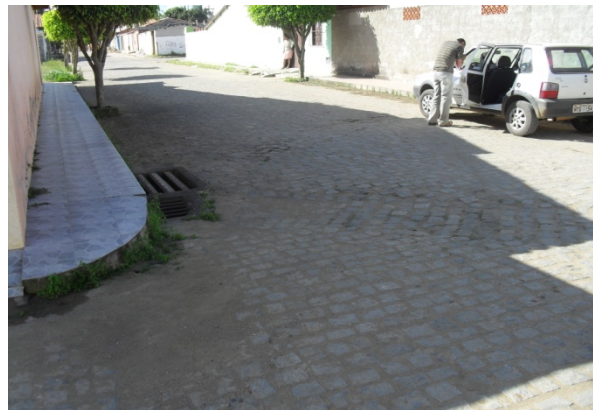
Foto 18: Rua J. J. Seabra, cruzamento próximo a fábrica de queijo. Área crítica por conta da ocorrência de alagamento. Área crítica 7.
