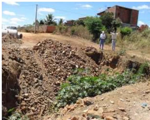
Foto 8: Área crítica 3. Erosão que exige cuidados constantes da Prefeitura
