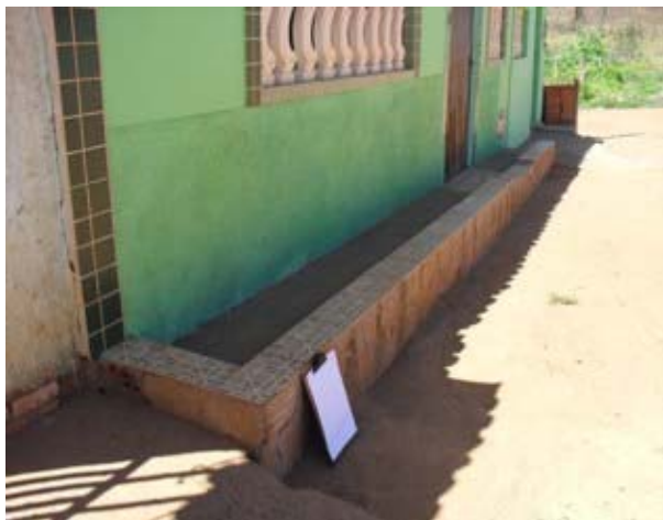
Foto 1: Área crítica 1, sujeita a alagamento
