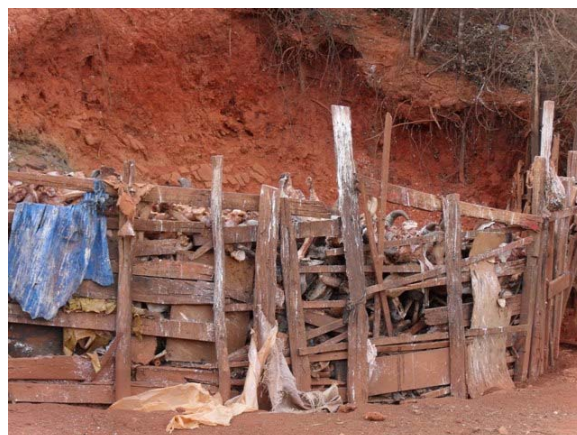
Foto 6: Travessa Joana Angélica – área crítica de erosão.
