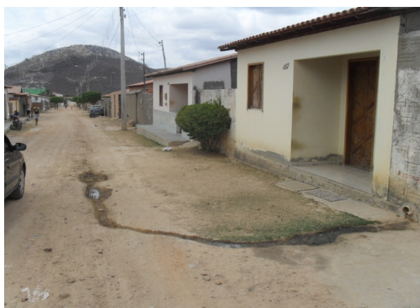
Foto 3: Residências lançando esgoto secundário a céu aberto.
