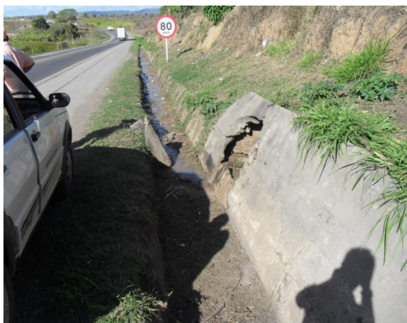
Foto 21: BR – 116. Após a rede de drenagem que transporta esgoto lançar os efluentes na valeta da pista, os esgotos sanitários e as águas pluviais desembocam na lagoa de Periperi.
