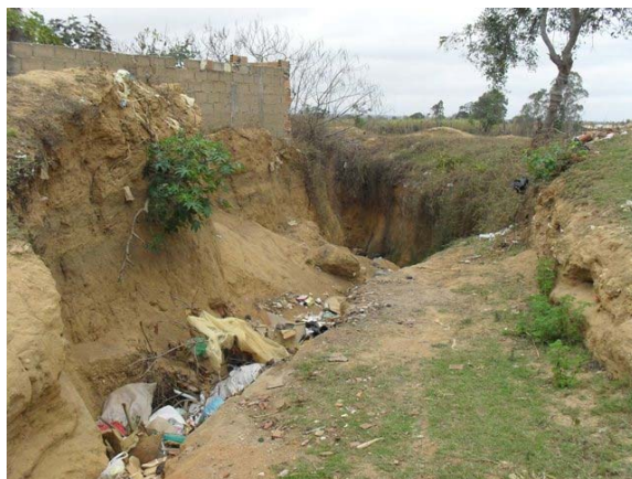
Foto 44: Área Crítica 2– Erosão - Bairro Enriqueta Pratis – Rua T - Carência de pavimentação e de sistema de drenagem e presença de lixo.
