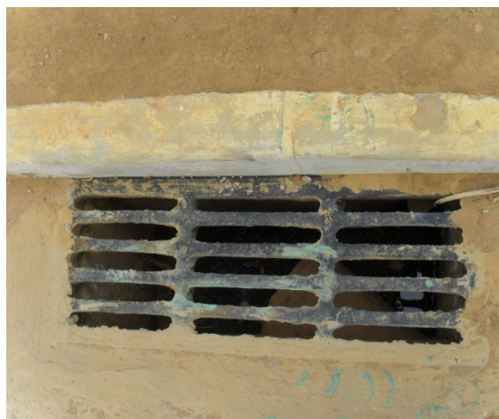
Foto 4: Rua Noruega. Detalhe do dispositivo de coleta superficial implantado.
