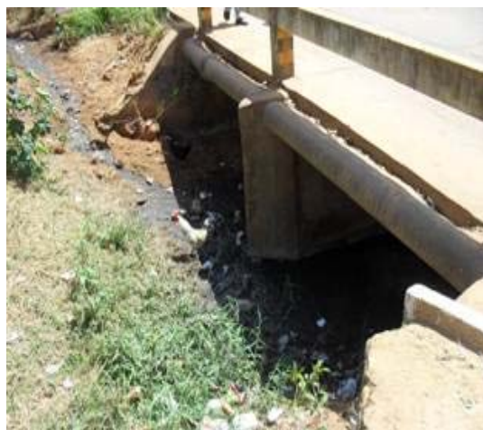
Foto 6: Pontilhão sobre o córrego do sangradouro com contribuição de esgoto
