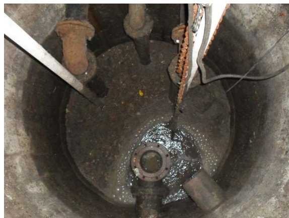
Foto 14: Poço de sucção da Estação Elevatória de Esgoto Santa Cruz.
