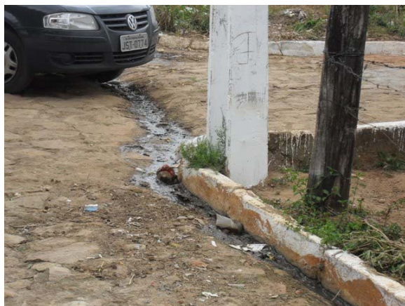
Foto 8: Rua João Mangabeira – Lançamento de esgoto a céu aberto.
