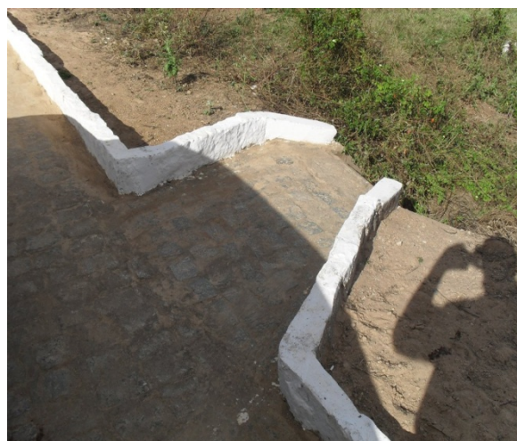
Foto 4: Drenagem em direção à lagoa.
