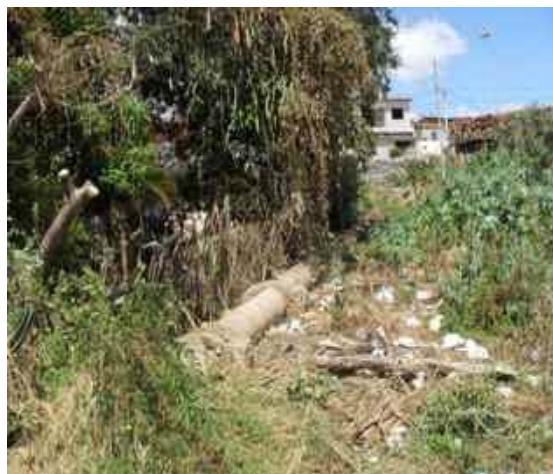
Foto 9: Rede de drenagem que transporta água pluvial e esgotos até o Ribeirão da Ressaca
