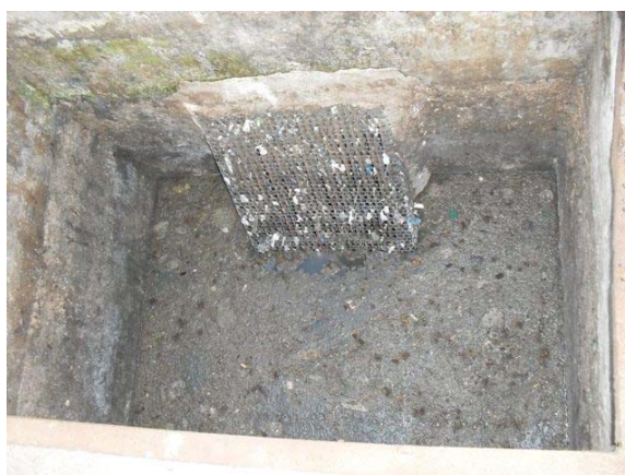
Foto 6: Unidade de gradeamento da Estação Elevatória de Esgoto Coveima.
