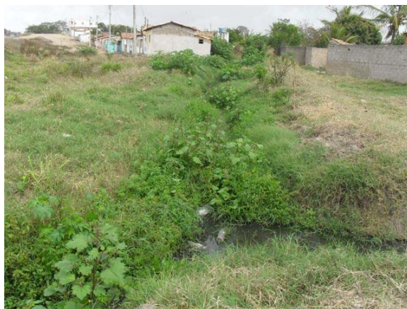
Foto 2: Lançamento de esgotos a céu aberto.
