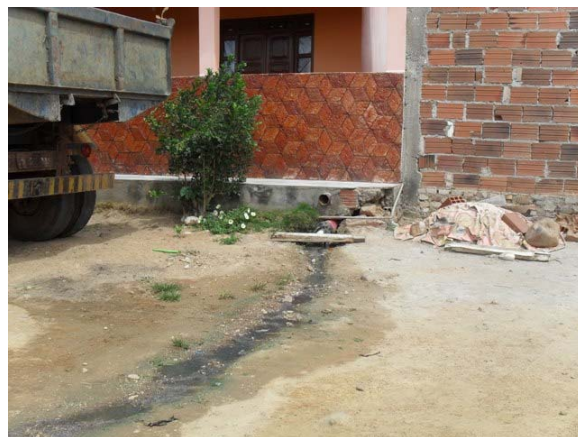
Foto 2: Lançamento de esgoto a céu aberto.
