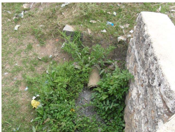
Foto 3: Outro ponto de lançamento de esgotos a céu aberto.
