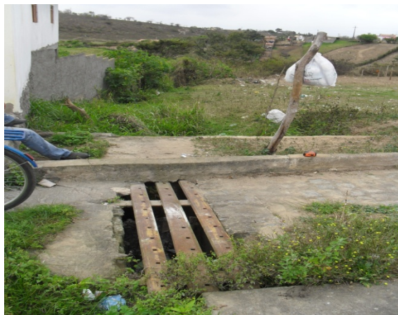
Foto 2: Rua Castro Alves. Detalhe da caixa coletora do final da rede de microdrenagem que recebe esgoto sanitário oriundo das residências clandestinamente e lança no terreno natural próximo ao açude.
