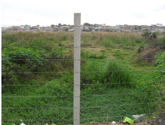
Foto 33: Canal 11 – Extravassor da Lagoa da Jurema na Avenida Presidente Dutra correspondendo ao início do canal.
