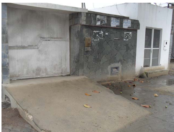
Foto 51: Área Crítica 6 – Alagamento – Bairro Jurema – Rua Bartolomeu de Gusmão – Reação aos alagamentos com elevação dos batentes das casas.
