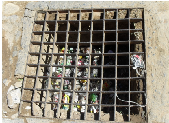
Foto 2: Rua Cleriston Andrade. Dispositivos de drenagem superficial com bastante lixo.
