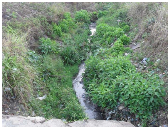
Foto 32: Canal 8 – Trecho do canal sem revestimento e repleto de vegetação com deságüe no Córrego Verruga.
