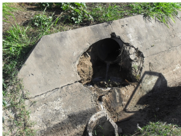
Foto 20: BR – 116. Ponto de lançamento da rede de microdrenagem que transporta esgoto conectado clandestinamente por moradores. Tubulação de concreto de 600 mm de diâmetro.
