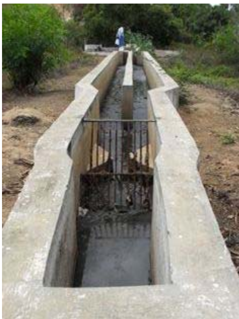
Foto 7: Gradeamento, caixa de areia e calha Parshall na estação de tratamento de esgoto
