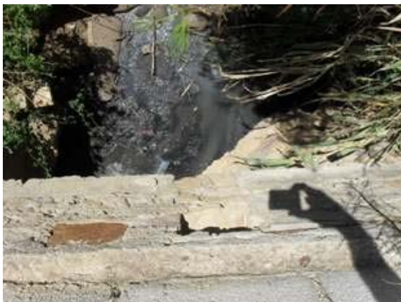
Foto 8: Pequeno córrego que recebe águas pluviais de uma galeria e leva ao córrego do sangradouro
