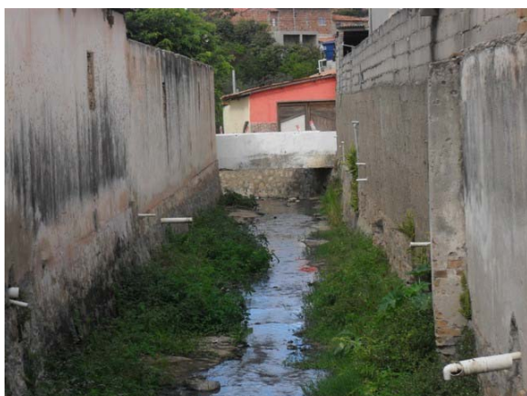
Foto 5: Calha do rio, revestido e ocupada indevidamente por construções que lançam seus esgotos no rio.
