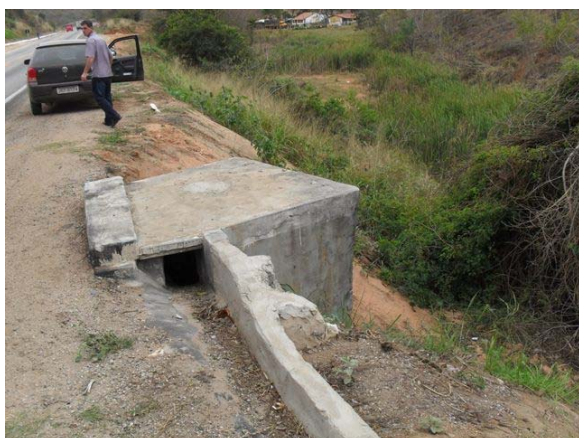
Foto 9: Lançamento de drenagem da BR-116 para o Córrego Parque Vaquejada.
