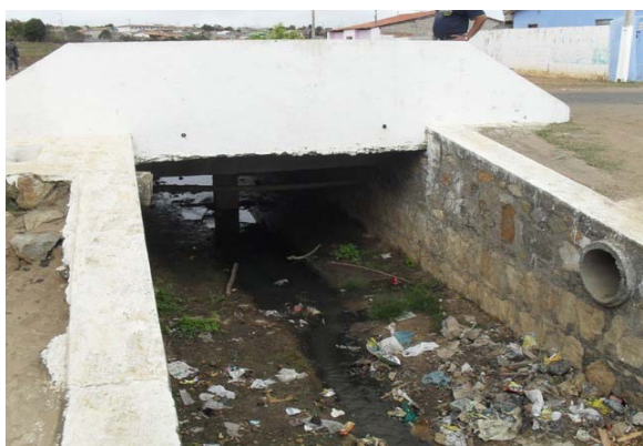
Foto 5: Rio São José – riacho revestido – ponto de lançamento de águas pluviais – presença de muito lixo.
