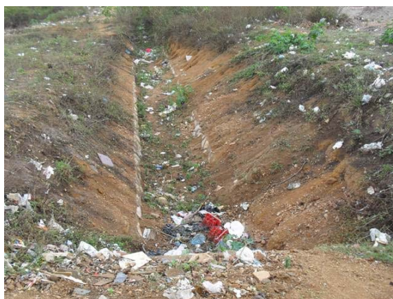
Foto 10: Canal 4 - Início do canal aberto revestido em alvenaria de pedra que contorna a serra, repleto de terra, lixo e vegetação.
