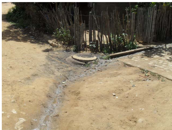
Foto 4: Bairro Casinhas Populares – lançamento de esgoto a céu aberto.
