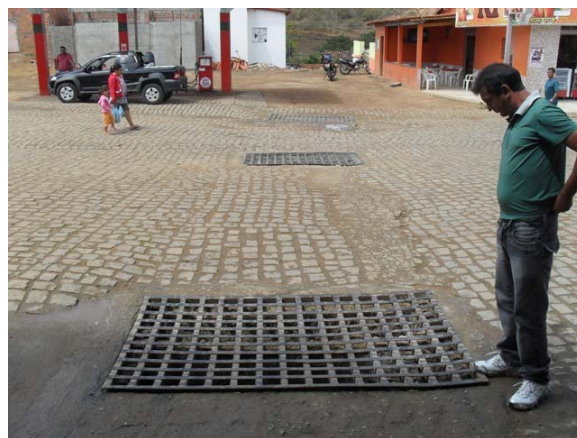
Foto 4: Av. Orlando Fontes - caixa coletora com grelha.
