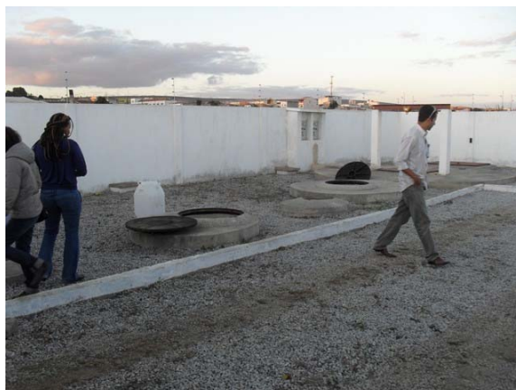
Foto 8: Estação Elevatória de Esgoto Alegria bem conservada.
