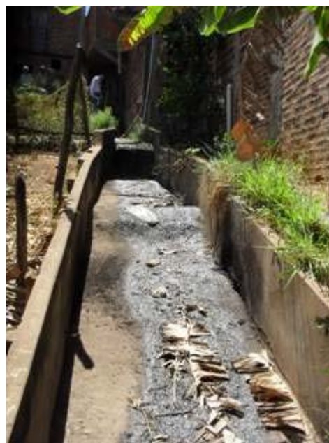
Foto 4: Canal que deságua na lagoa da cidade com contribuição de esgotos secundários
