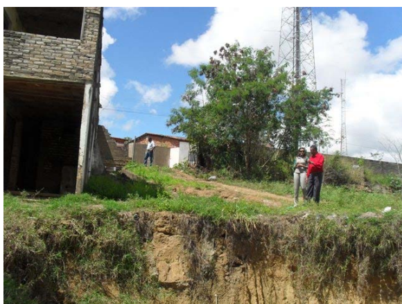
Foto 3: Av. Vitoria da Conquista – erosão.
