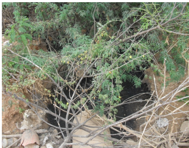
Foto 1: Ponto de lançamento de esgotos sanitários da rede coletora no Rio Caveira. Tubulação de concreto de 500 mm.
