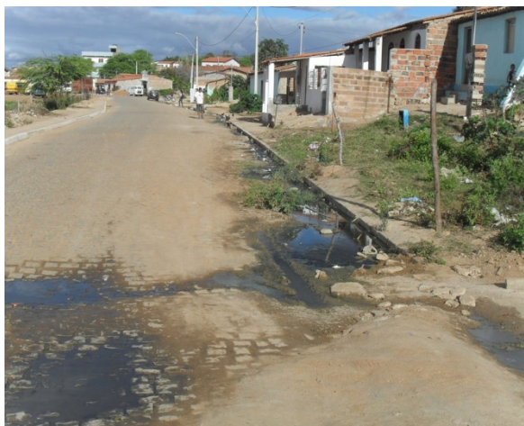
Foto 1: Rua da Lagoa – esgoto a céu aberto.
