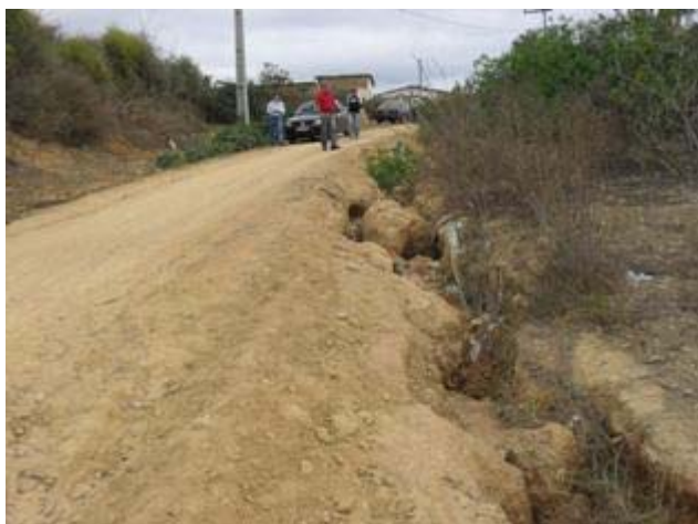
Foto 3: Área crítica 2. Erosão em área próxima do açude
