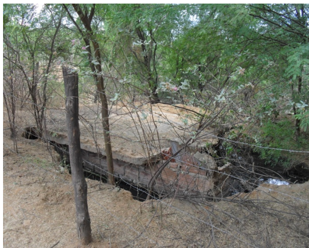
Foto 1: Sistema de fossas comunitárias. Estruturas em péssimo estado de conservação, localizadas próximo ao Rio do Peixe que recebem esgotos sanitários de uma parte da cidade.
