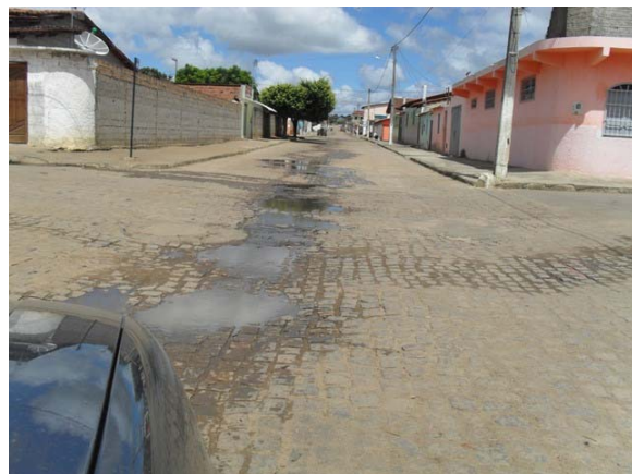
Foto 8: Lançamento de esgoto a céu aberto.
