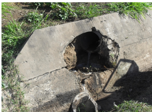
Foto 3: BR – 116. Ponto de lançamento da rede de drenagem que transporta esgotos sanitários conectados clandestinamente pelos moradores. Tubulação de concreto de 600 mm de diâmetro.
