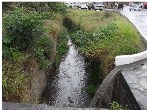
Foto 26: Canal 6 – Trecho do canal no Bairro Jurema aberto revestido em alvenaria de pedra, apresentando má conservação.
