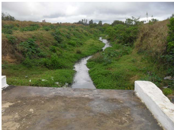
Foto 27: Canal 6 – Trecho do canal no Bairro Jurema sem revestimento com deságüe no Córrego Verruga.
