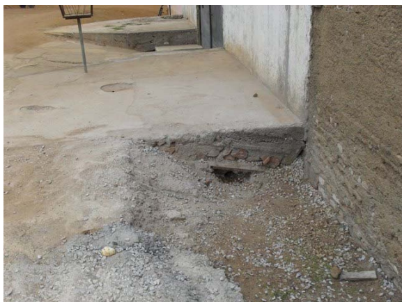
Foto 49: Área Crítica 5 – Alagamento – Bairro Nossa Senhora Aparecida – Rua São Sebastião – Obstrução no percurso das águas pluviais.
