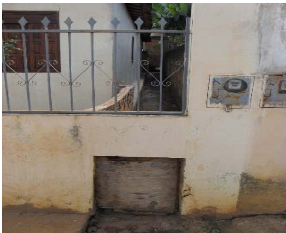
Foto 7: Passagem de água ao lado de casa na área crítica 2 (Centenário)
