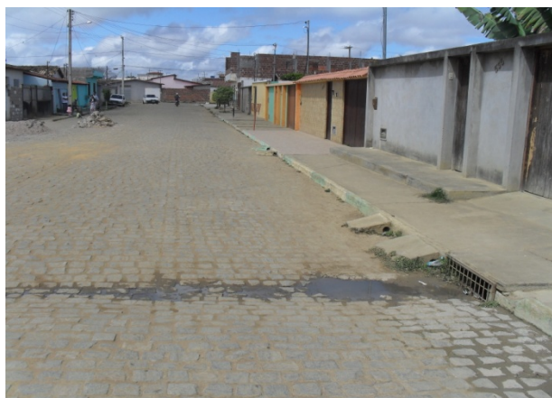
Foto 11: Rua Íris Silveira. Detalhe do dispositivo de coleta superficial que dá início a uma pequena rede de microdrenagem.
