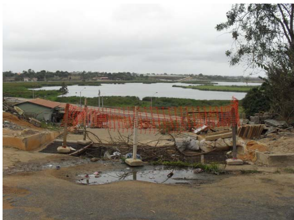
Foto 1: Canal 1 - Caixa coletora com grelha de grandes dimensões e em condições precárias correspondendo ao início da galeria circular enterrada na Rua 1 no Bairro Santa Cruz.
