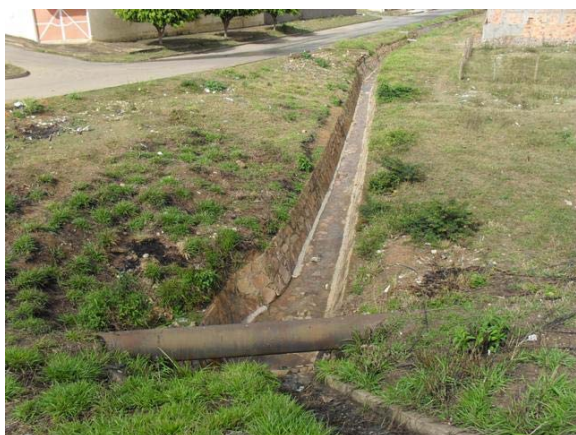
Foto 15: Canal 4 – Estrangulamento, redução da seção do canal após mudança de material do revestimento.
