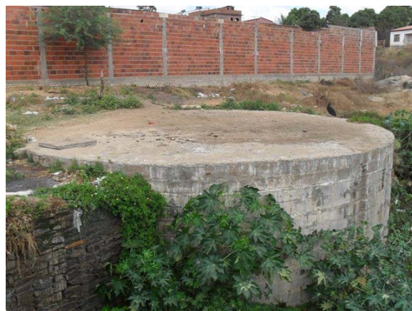
Foto 6: Unidade de tratamento com funcionamento precário – margem do rio (fundo da garagem).
