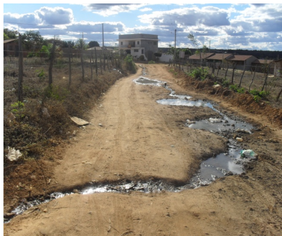
Foto 2: Esgoto secundário sendo lançado a céu aberto na frente das casas. Situação comumente observada em algumas ruas.
