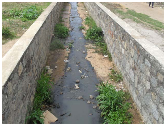
Foto 4: Rio São José conduzindo esgotos.
