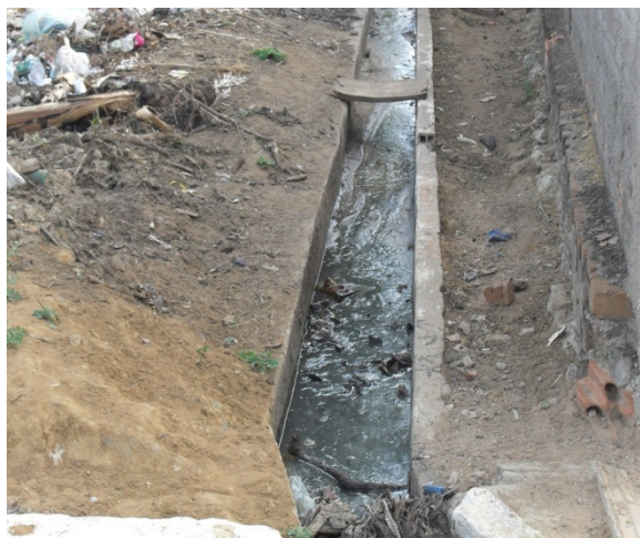
Foto 6: Canaleta de drenagem com presença de esgoto e lixo.
