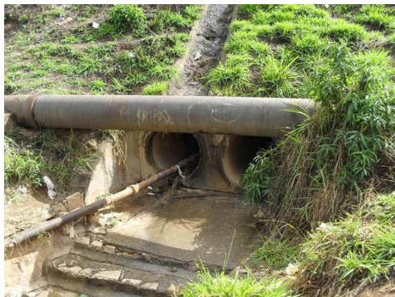
Foto 14: Canal 4 – Travessia longitudinal de estrutura física causando obstrução.
