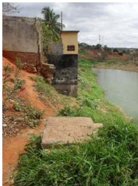
Foto 2: Estação elevatória que recalca todo o esgoto coletado na cidade
