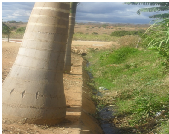
Foto 2: Estrada para Condeúba. Canaleta de seção trapezoidal situada na margem da pista transporta águas pluviais e esgotos sanitários de residências próximas e desemboca no rio Canabrava.
