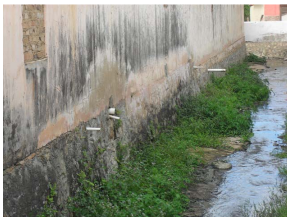
Foto 6: Calha do rio, revestido e ocupada indevidamente por construções que lançam seus esgotos no rio.
