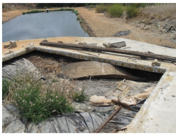
Foto 4: Detalhe do DAFA existente. Estrutura funcionando em condições precárias. Equipe responsável pela manutenção da ETE não possui qualificação adequada.
