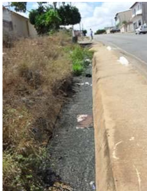
Foto 2: Valeta transportando esgotos secundários
