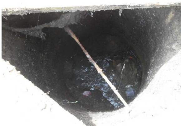
Foto 1: presença de esgoto na rede de drenagem.
