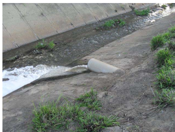
Foto 18: Lançamento dos efluentes tratados no Córrego Verruga.
