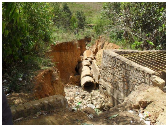
Foto 8: Erosão – Rua da Boiada em direção ao Rio Catolé.
