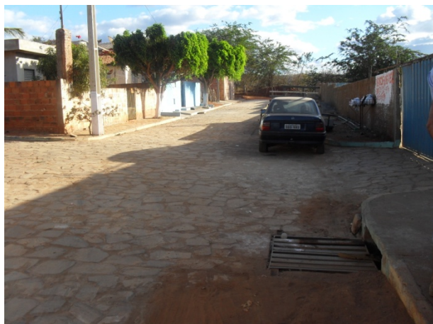
Foto 5: Rua Afrisio Barbosa. Detalhe do dispositivo de coleta superficial tipo abertura na guia associado à caixa com grelha.
