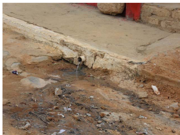
Foto 6: Rua José do Porto – Lançamento de esgoto a céu aberto.
