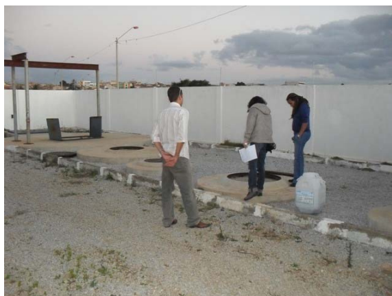
Foto 12: Estação Elevatória de Esgoto Santa Cruz bem conservada.
