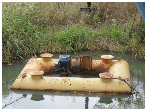
Foto 4: Captação de água – EMBASA.
