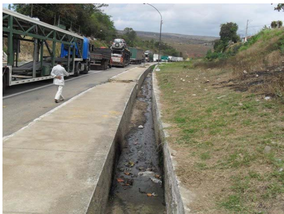
Foto 1: Lançamento de drenagem da BR-116 para o Córrego Parque Vaquejada com presença de esgoto.
