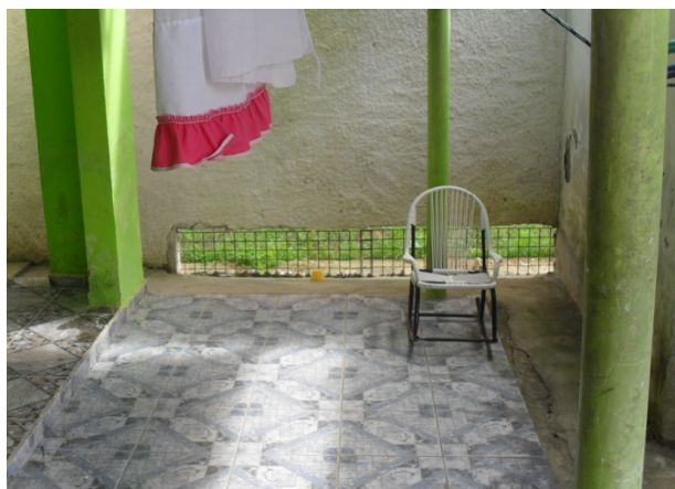
Foto 13: Rua Joaquim Sales, antiga rua Rui Barbosa. Morador construiu uma passagem de água no muro de sua residência para facilitar o escoamento das águas pluviais que invadem o local quando a rua está alagada.
