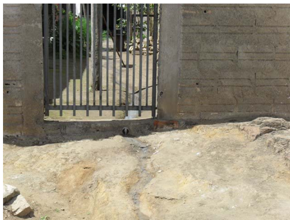
Foto 2: Av. Vitória da Conquista – esgoto a céu aberto.
