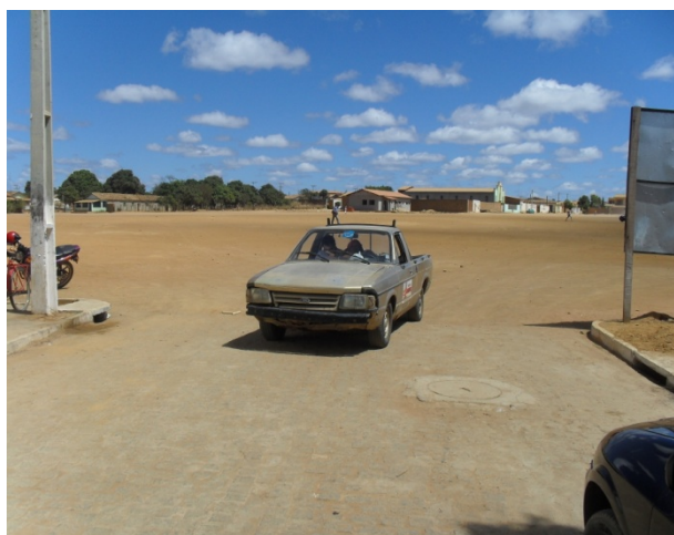
Foto 3: Rua São Tomé. Rede de microdrenagem recentemente implantada.
