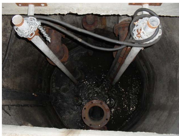
Foto 10: Poço de sucção da Estação Elevatória de Esgoto Alegria.
