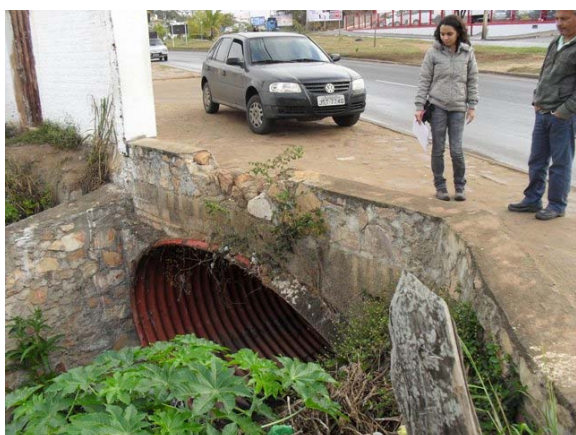
Foto 35: Canal 11 – Travessia em armco sob a Avenida Juraci Magalhães.
