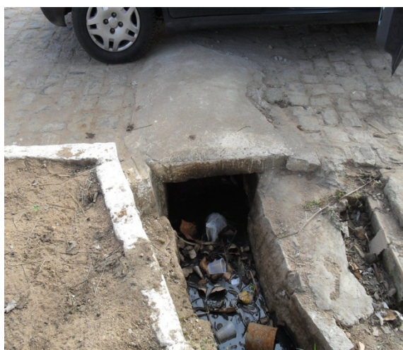
Foto 4: Canaleta de drenagem com esgoto e lixo.
