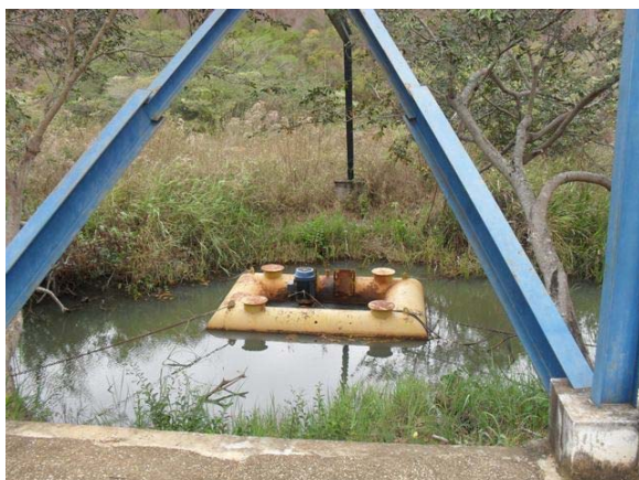
Foto 5: Captação de água – EMBASA.
