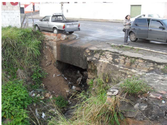
Foto 31: Canal 8 – Final do trecho revestido em alvenaria de pedra do canal que se inicia no Poço Escuro apresentando péssima conservação.
