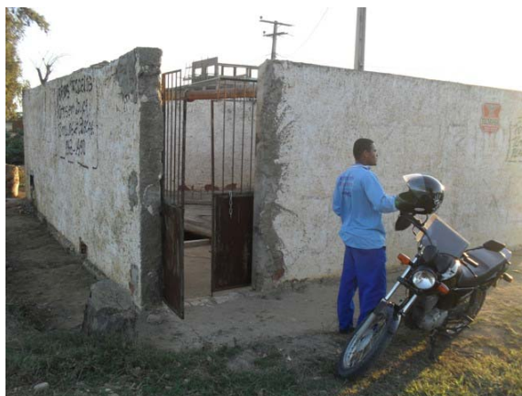
Foto 4: Entrada da Estação Elevatória de Esgoto Coveima operada pela Embasa.
