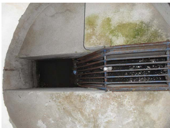
Foto 9: Unidade de gradeamento da Estação Elevatória de Esgoto Alegria.
