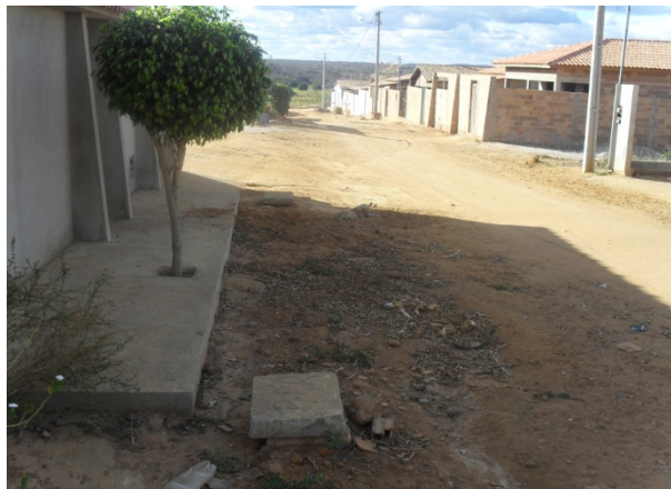
Foto 7: Detalhe das caixas de passagem da rede coletora para coletar esgoto secundário.
