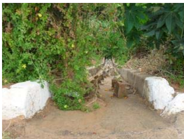
Foto 4: Dissipador de energia na barragem do Zé Ferrugem
