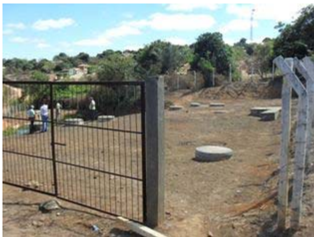
Foto 1: Estação de tratamento de esgotos que serve pequena parte da cidade
