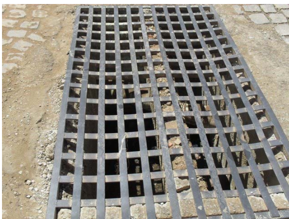
Foto 3: Av. Orlando Fontes - caixa coletora com grelha.
