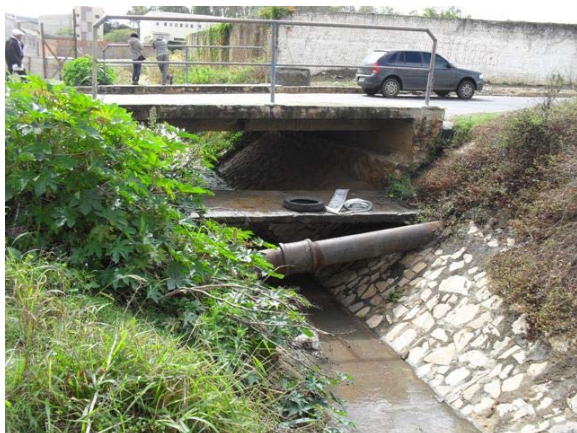
Foto 19: Canal 4 – Travessia transversal de estruturas físicas causando obstrução.
