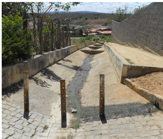
Foto 2: Residências lançando esgotos secundários a céu aberto próximo ao canal de macrodrenagem existente.
