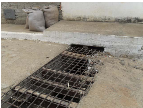
Foto 3: Rua Rio Pardo – caixa coletora de água pluvial com grelha.
