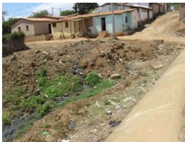
Foto 7: Sangradouro do açude recebendo contribuição de esgotos
