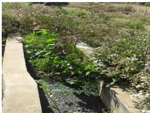
Foto 4: Detalhe da caixa de areia da ETE completamente tomada pela vegetação e cheia de esgoto sanitário.
