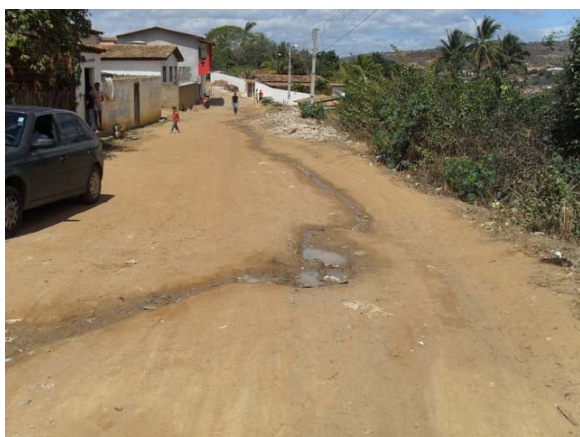
Foto 5: Bairro Casinhas Populares – lançamento de esgoto a céu aberto.
