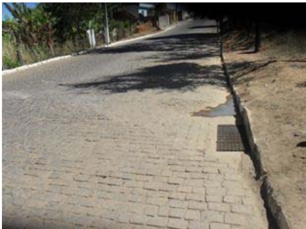
Foto 5: Sarjeta com escoamento de água servida
