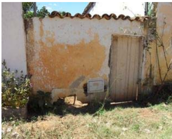
Foto 7: Área crítica 2, sujeita a alagamento. A abertura no muro foi feita para a passagem das águas
