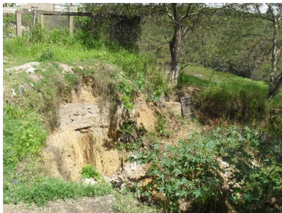
Foto 2: Av. Vitoria da Conquista – erosão.
