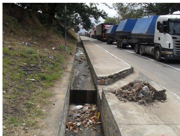
Foto 10: Lançamento de drenagem da BR-116 para o Córrego Parque Vaquejada.
