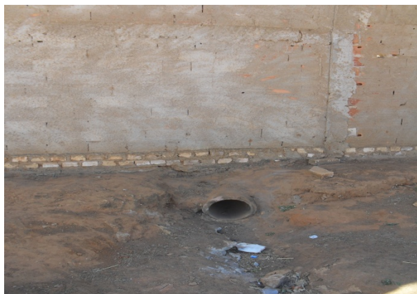
Foto 3: Ponto de lançamento do pequeno trecho de rede de microdrenagem que se inicia na rua Cleriston Andrade e desemboca atrás de uma oficina. Tubulação de concreto de 200 mm de diâmetro.
