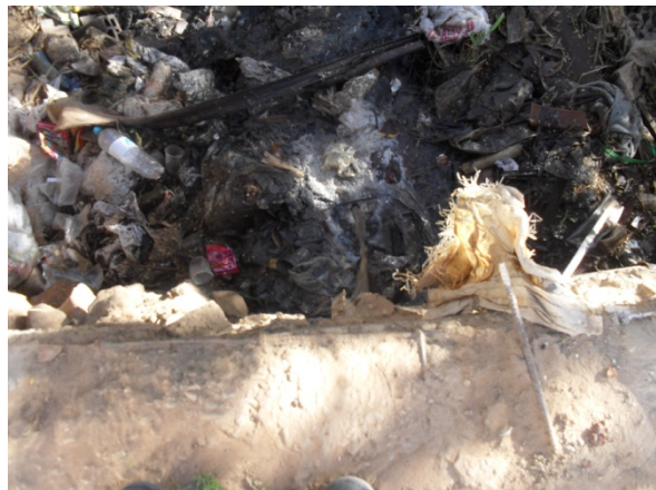
Foto 8: Ponto de lançamento de esgoto sanitário no terreno natural próximo a praça Getúlio Vargas. Tubulação de PVC de 150 mm.
