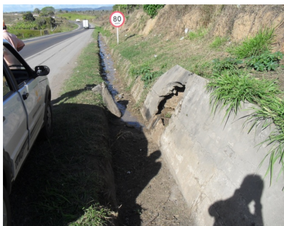
Foto 4: BR – 116. Após a rede de drenagem que transporta esgoto lançar os efluentes na valeta da pista, os esgotos sanitários e as águas pluviais desembocam na lagoa de Periperi.
