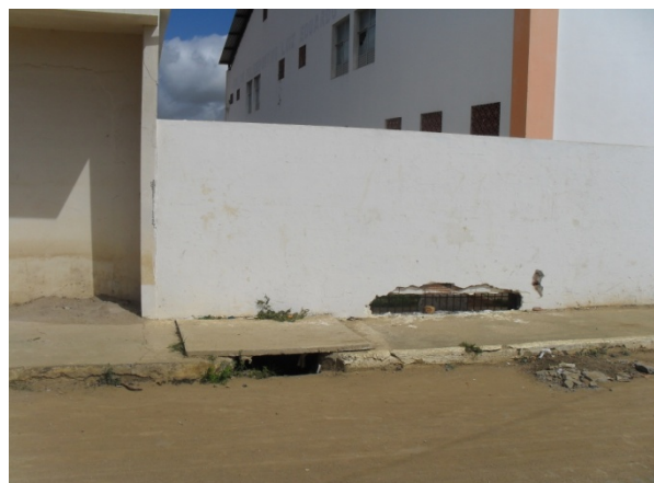
Foto 12: Rua Joaquim Sales, antiga rua Rui Barbosa. Área crítica por conta da ocorrência de alagamento. Área crítica 6.
