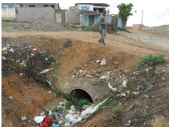
Foto 11: Canal 4 – Trecho em manilha, utilizada para travessia de ruas, repleto de terra, lixo e vegetação.
