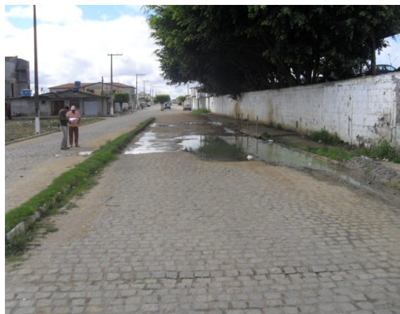
Foto 2: Avenida John Kennedy. Fossas do posto de gasolina estouradas transbordando esgoto na rua.
