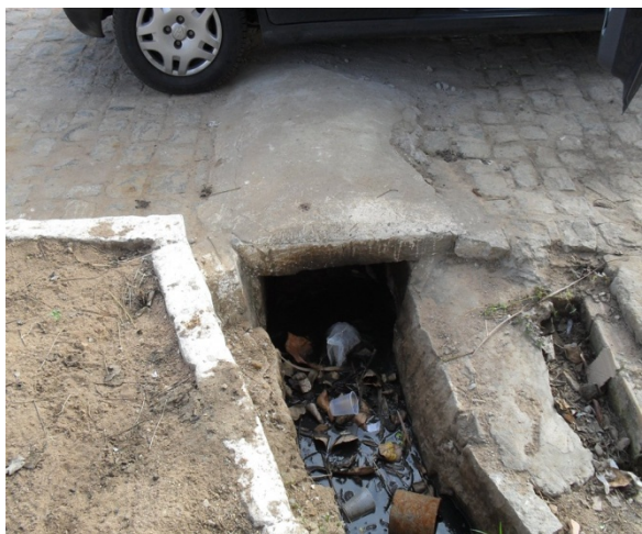
Foto 5: Canaleta de drenagem com presença de esgoto e lixo.
