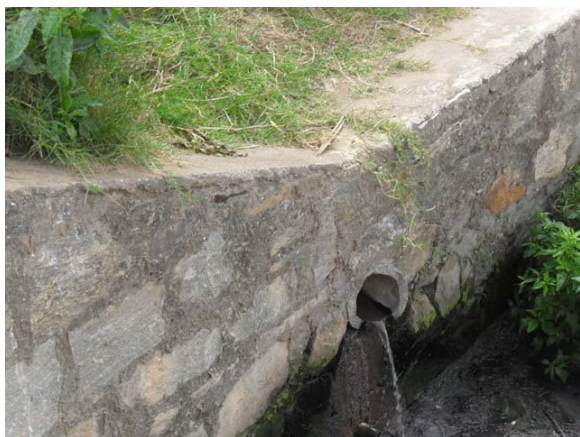
Foto 1: Lançamento de esgoto secundário no Rio São José.
