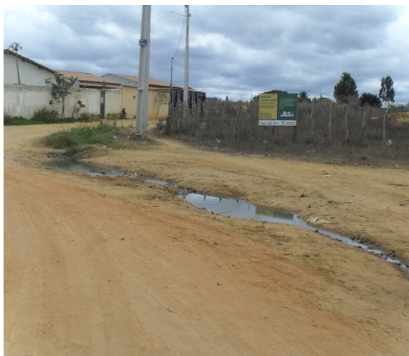
Foto 1: Esgoto secundário a céu aberto
