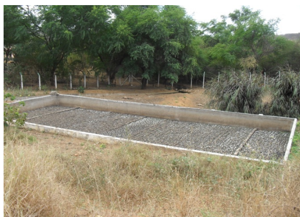
Foto 6: Detalhe de leito de secagem da ETE.
