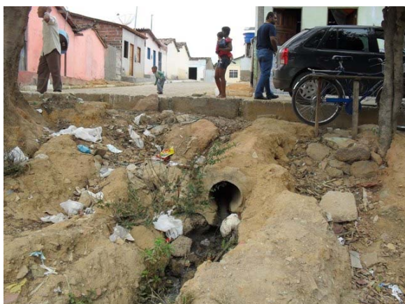
Foto 5: Travessa Aclamação – Lançamento de esgoto bruto no Rio Pardo.
