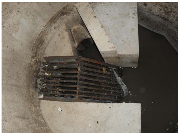
Foto 13: Unidade de gradeamento da Estação Elevatória de Esgoto Santa Cruz.
