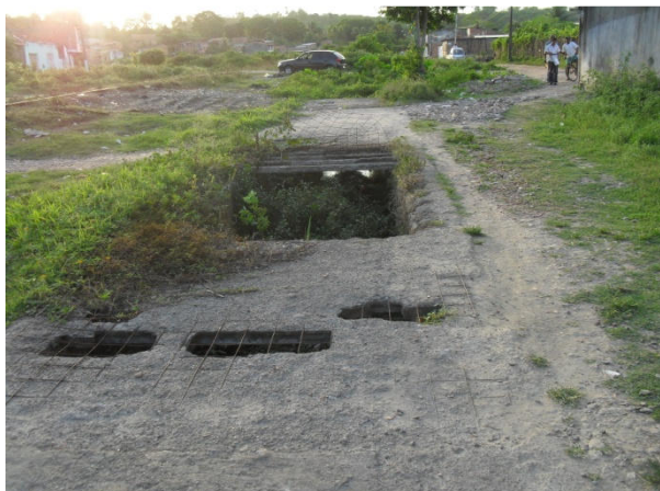
Foto 13: 4ª Travessa da Caixa D'água. Vista de outro ângulo do pequeno trecho coberto por placas de concreto do riacho que provoca o alagamento na área crítica.
