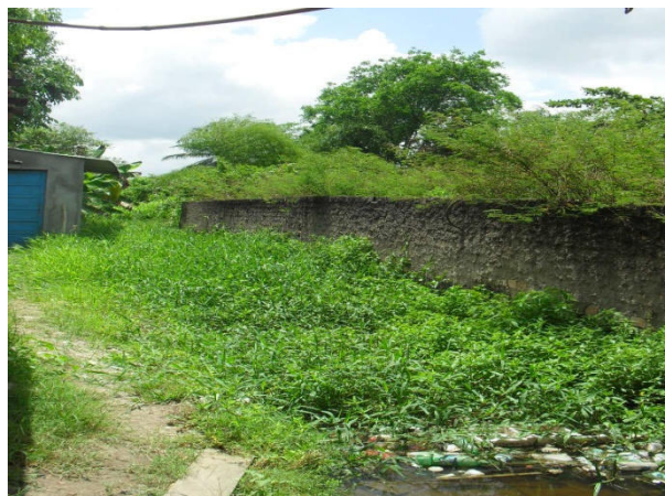
Foto 20: Avenida Garcia. Trecho de jusante do riacho bastante assoreado dificulta o escoamento das águas pluviais e influencia para a ocorrência de alagamento.
