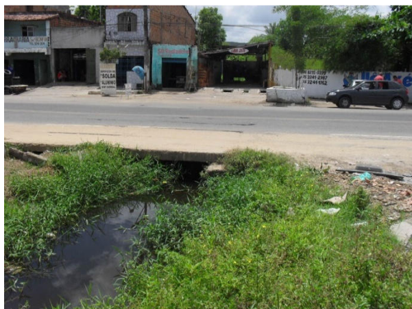
Foto 19: Avenida Garcia. Riacho que influencia diretamente na ocorrência de alagamento na área crítica.
