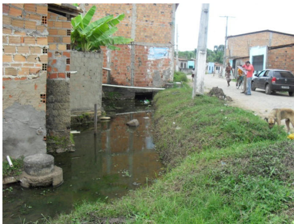
Foto 45: Ilha do Dendê. Área crítica por conta da ocorrência de alagamento. Área crítica 20.
