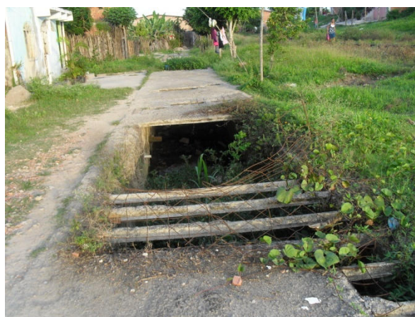
Foto 12: 4ª Travessa da Caixa D'água. Área crítica por conta da ocorrência de alagamento. Área crítica 6.
