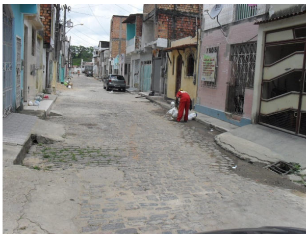
Foto 29: Rua Professor Pedro Santos. Área crítica por conta da ocorrência de alagamento. Área crítica 14.
