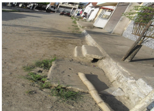
Foto 4: Largo do Riachuelo. Alguns dispositivos de drenagem superficial encontram-se obstruídos e agravam ainda mais o problema na região.
