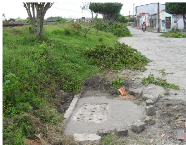
Foto 32: Rua Nestor de Oliveira, próximo ao DERBA. Área crítica por conta da ocorrência de alagamento. Área crítica 15.
