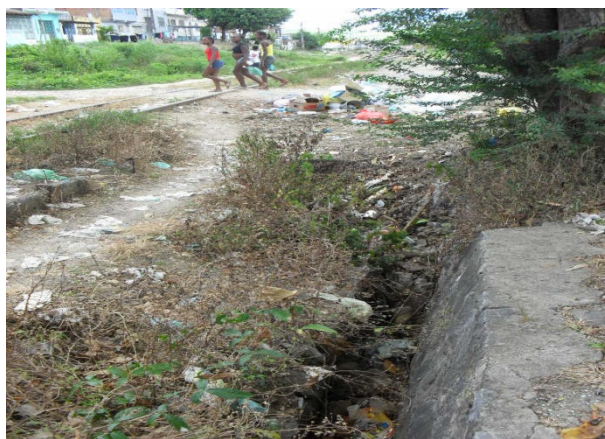
Foto 28: Detalhe da valeta que realiza a drenagem junto a linha férrea próxima a Travessa Presidente Vargas bastante obstruída.
