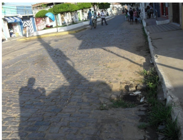
Foto 7: Rua Santa Luzia. Vista do dispositivo de drenagem responsável pelo escoamento no local afetado.
