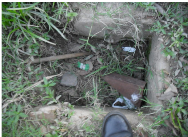
Foto 15: Rua Natalício Wanderley. Dispositivos responsáveis pelo escoamento das águas pluviais estão bastante obstruídos.
