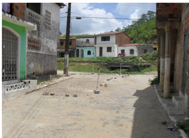
Foto 21: Rua Manoel Marques. Área crítica por conta da ocorrência de alagamento. Área crítica 10.
