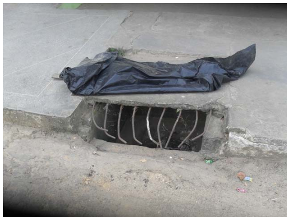
Foto 10: Boca de lobo – Rua São José.
