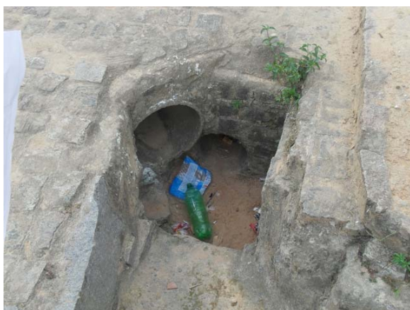
Foto 7: Caixa de reunião – Av. Santa Rita com a Rua Manoel Rodrigues.
