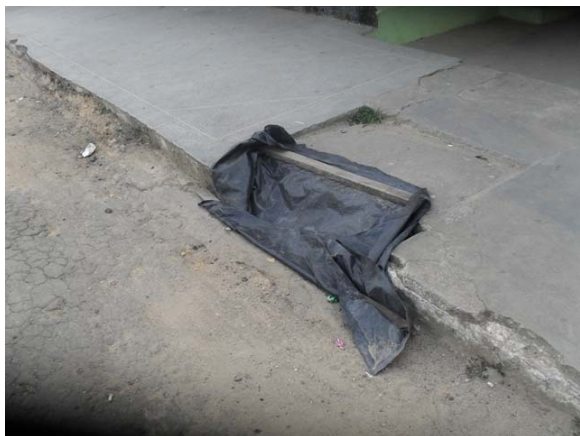
Foto 9: Boca de lobo – Rua São José.
