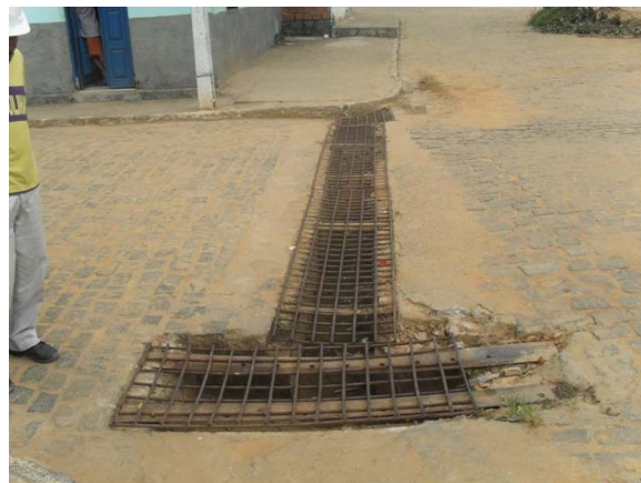
Foto 2: Loteamento Luiz Muniz – vala com grelha.
