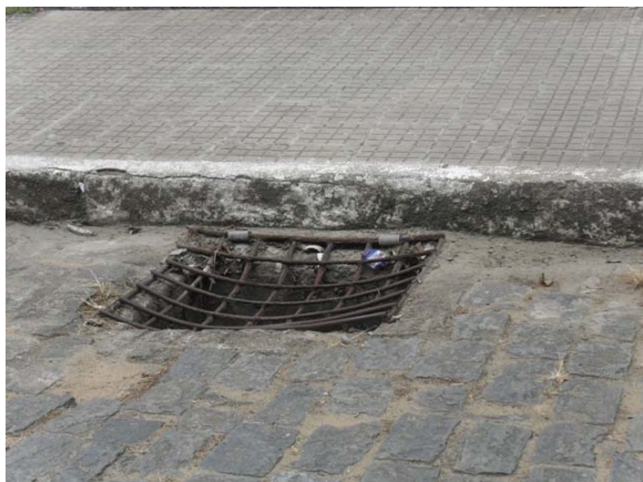
Foto 1: Rua Jequié – caixa com grelha.
