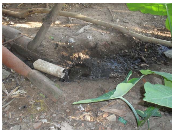
Foto 6: Ponto de lançamento de esgoto a céu aberto.
