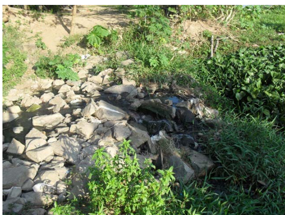
Foto 9: Lançamento de águas pluviais e esgotos no Rio de Contas.
