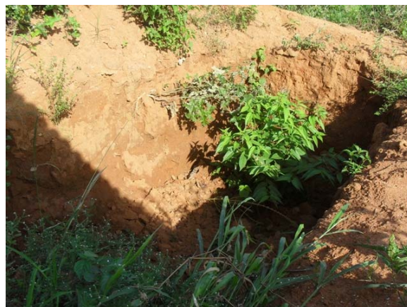
Foto 8: Loteamento Gilda Fonseca – processo erosivo do terreno.
