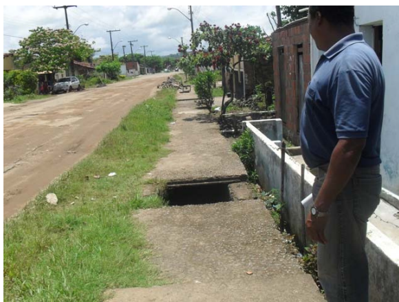
Foto 3: Av. Senhora Santana – esgoto canalizado.
