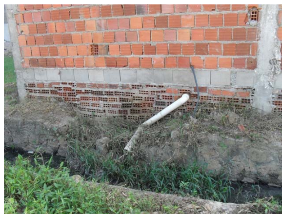
Foto 4: Canal revestido próximo ao Hospital – conduz águas pluviais e recebe lançamento direto de esgotos.
