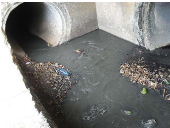
Foto 1: Canais de drenagem Santa Luzia conduzindo esgoto bruto.
