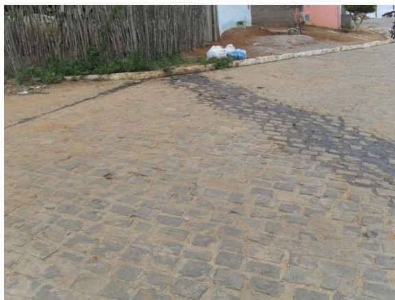
Foto 2: Rua Almir Pereira com a Rua Nova - esgoto a céu aberto.
