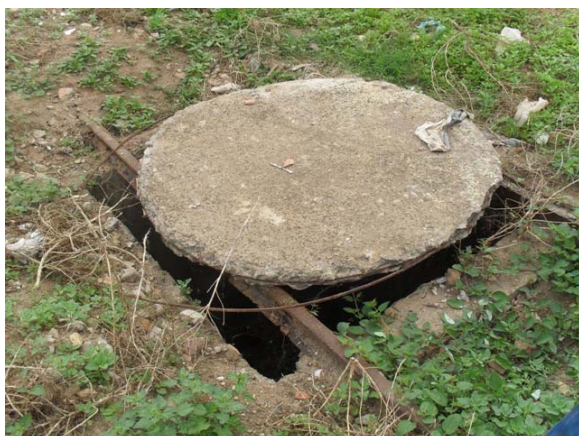
Foto 5: Caixa de passagem – Rua Almir Pereira com a Rua Nova.
