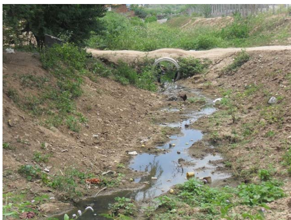
Foto 9: Bairro Mandacaru – esgoto a céu aberto correndo em direção ao Rio de Contas.
