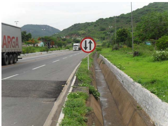
Foto 7: Canaleta de drenagem – margem da DR-116.
