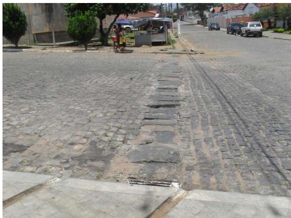
Foto 1: Área Crítica – proximidades do hospital – área de alagamento.
