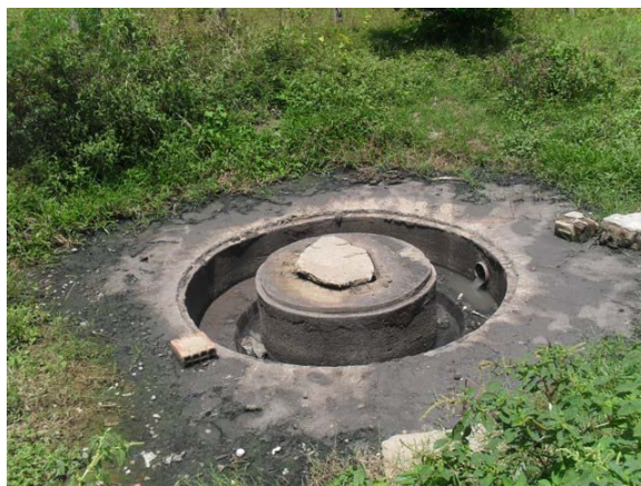
Foto 6: Bairro Firmo ferreira – ETE sem controle operacional.
