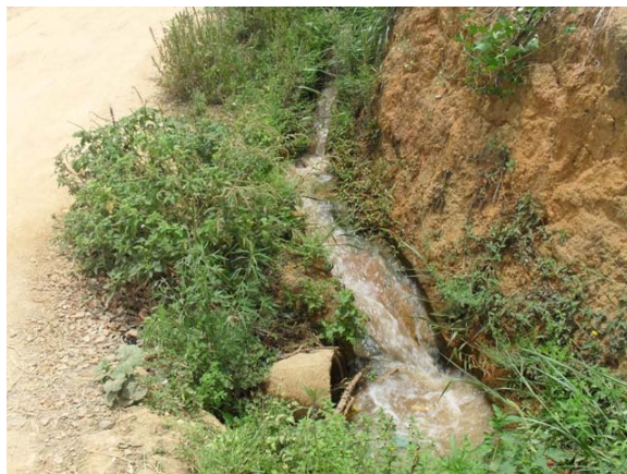
Foto 2: Lançamento de água de lavagem da ETA EMBASA – processo erosivo.
