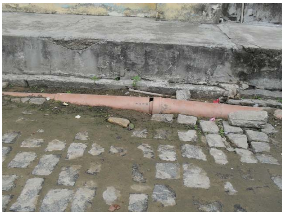
Foto 1: Rede de esgoto aflorando no solo.
