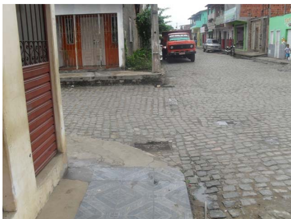
Foto 7: Área Crítica – Mirario – área de alagamento.
