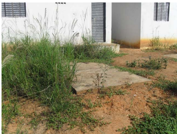
Foto 3: Loteamento Gilda Fonseca – fossa e filtro para transporte de esgotos.
