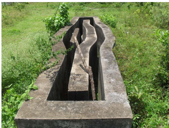
Foto 5: Bairro Firmo ferreira – ETE sem controle operacional.
