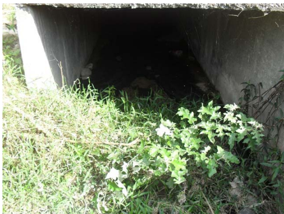
Foto 1: Canal revestido, próximo ao Ginásio de Esportes – conduzindo água pluvial e esgotos – repleto de vegetação.
