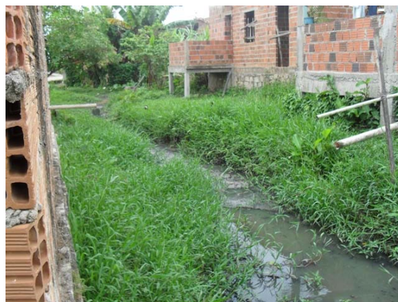
Foto 4: Córrego Barro Branco – Rua Lane Andrade – lançamento direto de esgotos.
