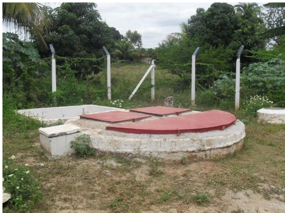
Foto 7: Estação Elevatória da EMBASA – Vila Esperança.
