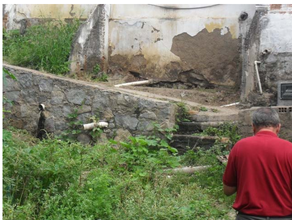
Foto 3: Lançamento direto de esgotos no Canal Santa Luzia.
