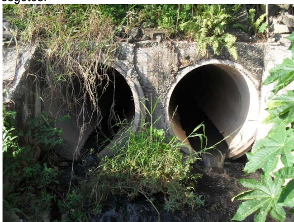
Foto 7: Lançamento de águas pluviais e esgotos no Rio de Contas.
