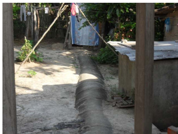
Foto 6: Lançamentos de esgotos no Riacho Barroquinha.
