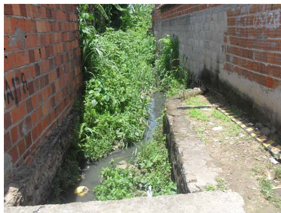
Foto 4: Av. Senhora Santana – pequeno córrego conduzindo esgoto..
