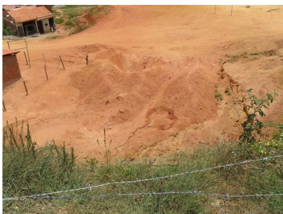
Foto 3: Lançamento de água de lavagem da ETA EMBASA – processo erosivo.
