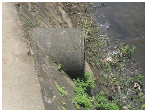
Foto 6: Descarga no Rio Gongogi.
