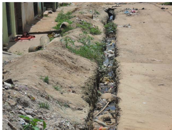
Foto 2: Valeta em via pública conduzindo esgoto secundário a céu aberto.
