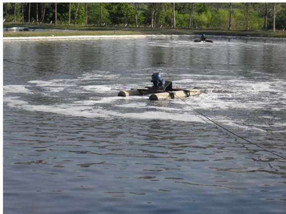
Foto 20: Aerador na Lagoa Anaeróbica.
