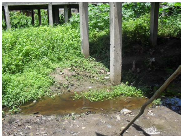
Foto 8: Construções irregulares sobre o Rio Gongongi.
