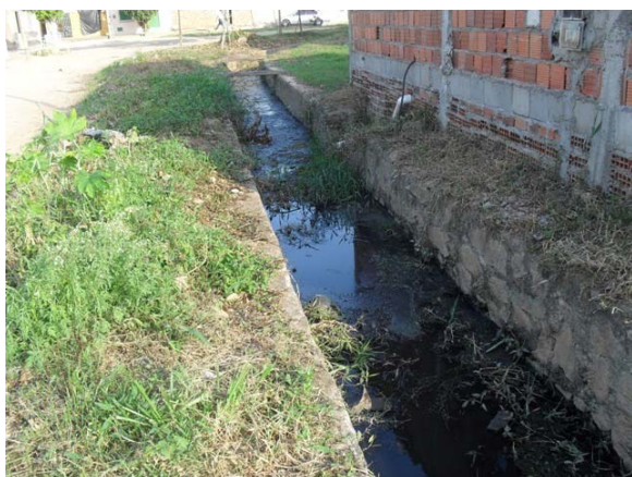
Foto 5: Canal revestido próximo ao Hospital – conduz águas pluviais e recebe lançamento direto de esgotos
