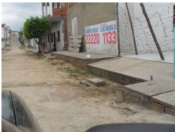
Foto 5: Área Crítica 1 – Rua Manoel Costa neto e adjacências – área de alagamento.
