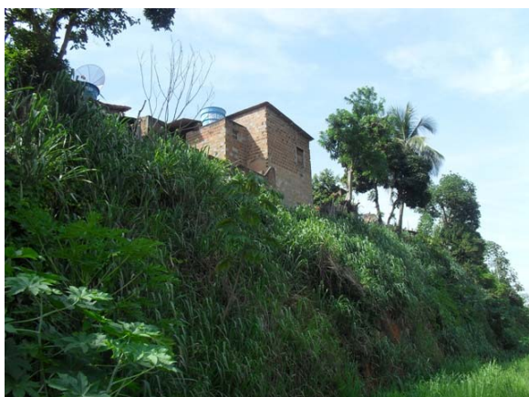
Foto 3: Área de risco de desabamento – fundos da Rua Castro Alves.
