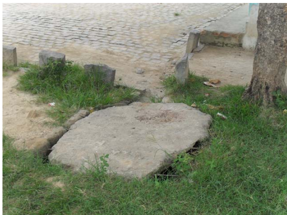
Foto 1: Caixa de passagem com tampa.
