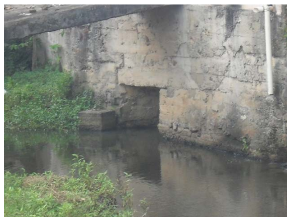
Foto 4: Galeria - lançamento de águas pluviais e esgotos no Rio Preto do Costa – Rua 21 de Abril.
