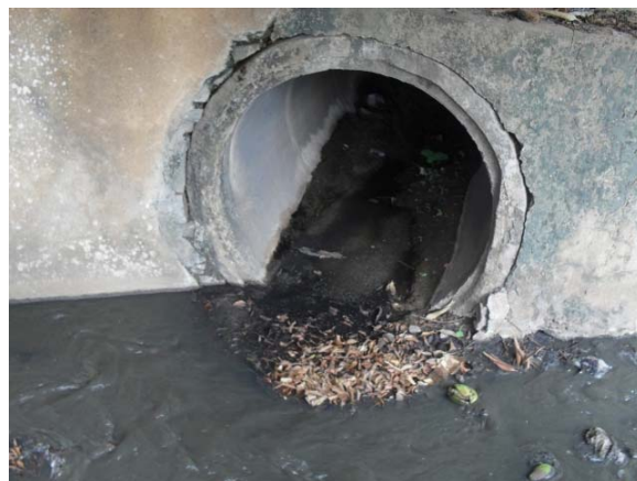
Foto 2: Canais de drenagem Santa Luzia conduzindo esgoto bruto.
