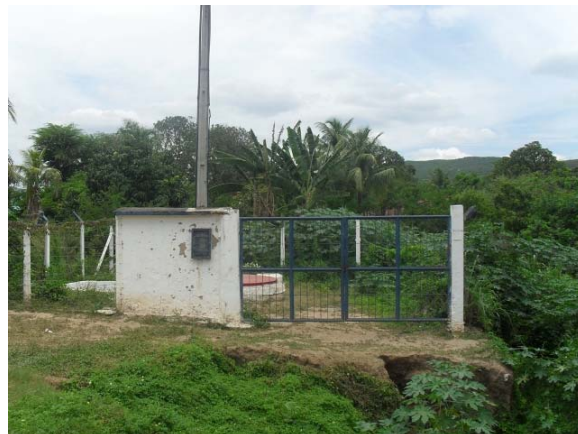
Foto 8: Estação Elevatória da EMBASA – Vila Esperança.
