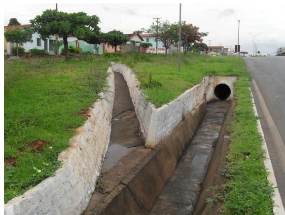
Foto 8: Canaleta de drenagem – margem da DR-116.
