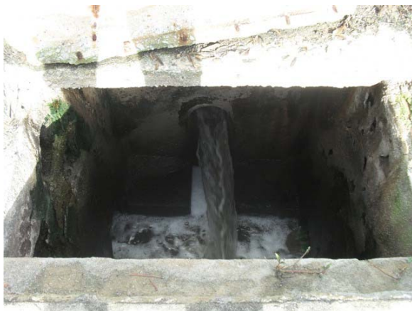
Foto 1: Aspecto do efluente na saída das lagoas.
