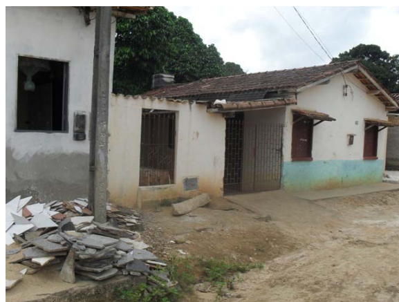
Foto 34: Área Crítica 6 – Rua do Asilo – área de alagamento.
