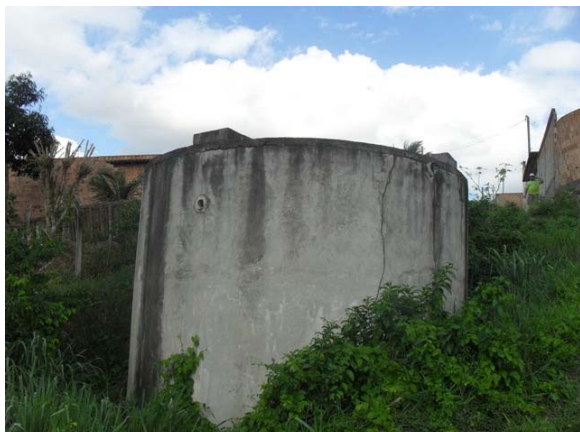
Foto 7: DAFA abandonado do Bairro Edgar Trancoso.
