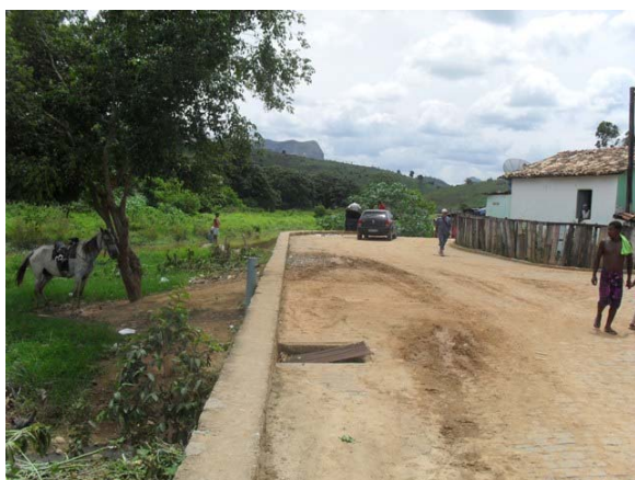
Foto 9: Área Crítica 2 – Rua Airton Senna – área de inundação ribeirinha.
