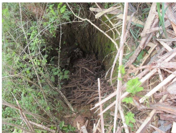
Foto 8: Ponto final da microdrenagem necessitando de conservação e manutenção.
