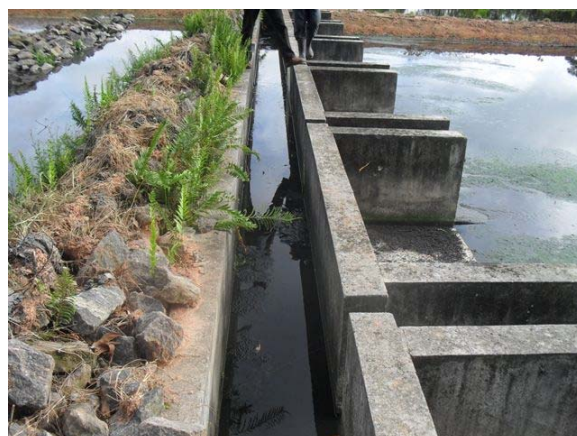
Foto 12: Lagoas de Macrófitas da ETE.
