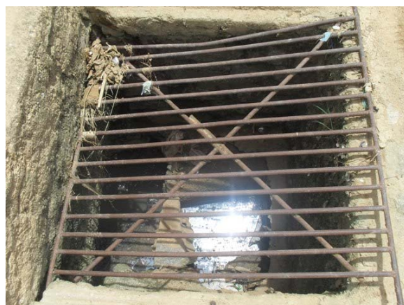
Foto 4: Estrutura de microdrenagem mal conservadas.
