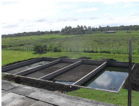
Foto 6: Leitos de secagem da ETE.
