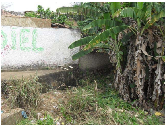
Foto 3: Lançamento difuso de esgoto no Córrego do Fradim.
