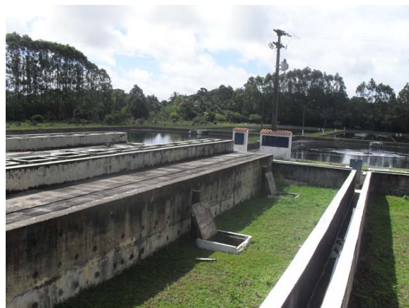
Foto 8: DAFA da ETE.
