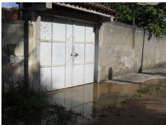
Foto 15: Área crítica 3 – Rua Paraju – área de alagamento.
