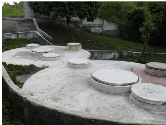
Foto 14: Tanque Imhoff da ETE Urbis III.
