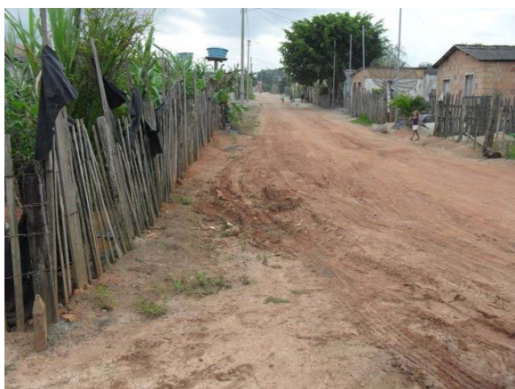
Foto 53: Área Crítica 12 – Rua C – área de alagamento.
