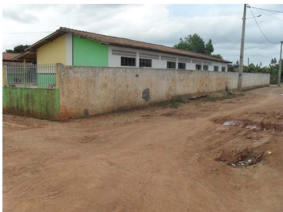
Foto 49: Área crítica 11 – Rua do Colégio – área de alagamento.
