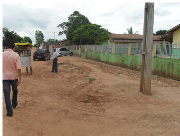
Foto 50: Área crítica 11 – Rua do Colégio – área de alagamento.
