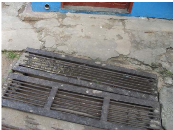
Foto 1: Grelhas totalmente assoreadas na Rua Frei Henrique Coimbra.
