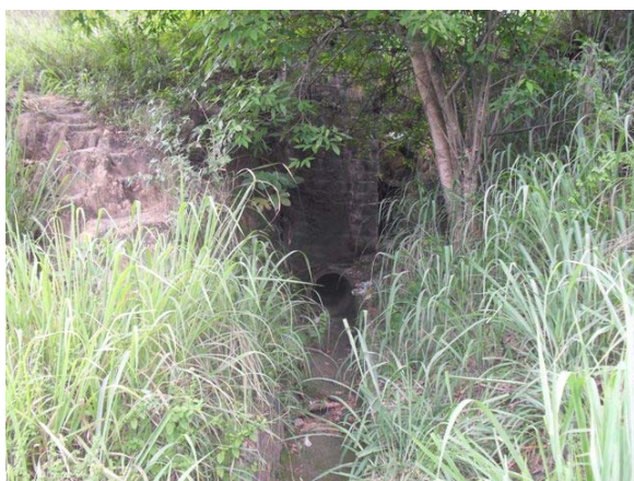
Foto 11: Ponto final da microdrenagem necessitando de conservação e manutenção.
