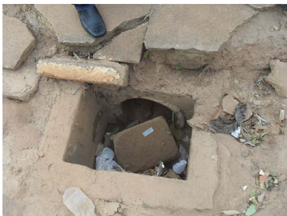
Foto 7: Interferência física na caixa de entrada da microdrenagem.
