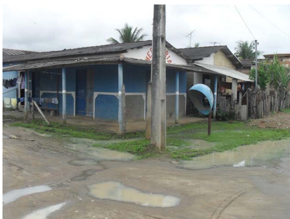
Foto 9: Área Crítica 4 – Rua 02 – área de alagamento.
