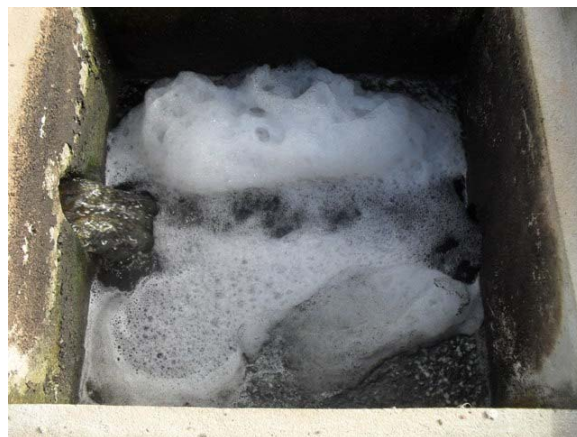
Foto 2: Aspecto do efluente na saída das lagoas.
