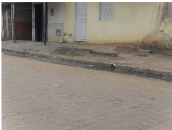
Foto 5: Lançamento de esgoto secundário na sarjeta.
