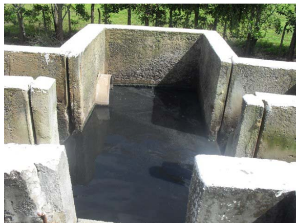
Foto 2: Caixa de distribuição do afluente.
