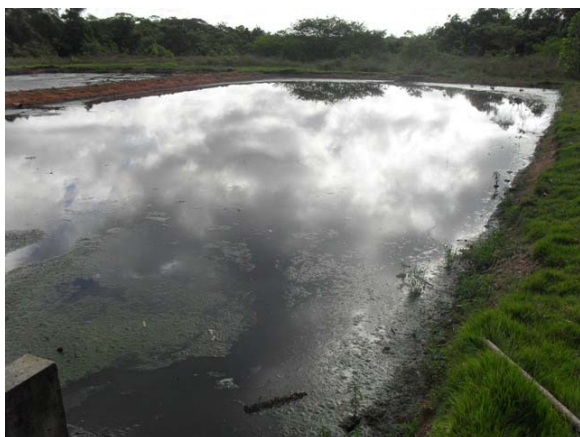
Foto 9: Lagoas de Macrófitas da ETE.
