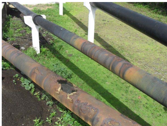
Foto 14: Tubulação de esgoto desgastada com necessidade de reparação.
