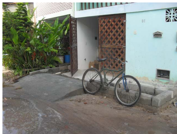
Foto 16: Área crítica 3 – Rua Paraju – área de alagamento.
