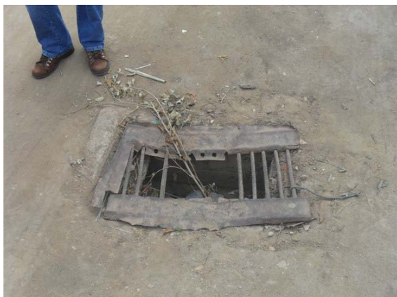
Foto 13: Área Crítica 1 – obstrução da caixa coletora causando problema de alagamento no Centro.
