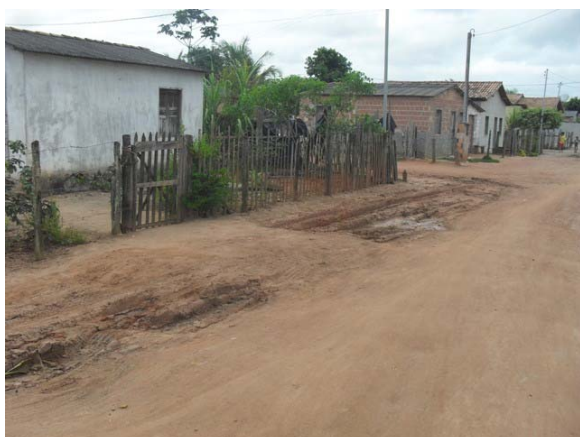
Foto 51: Área Crítica 12 – Rua C – área de alagamento.
