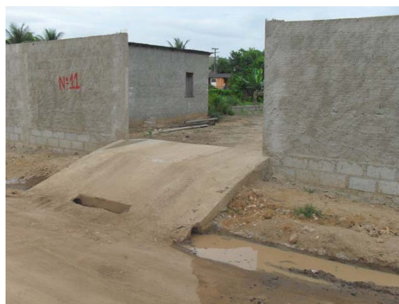
Foto 48: Área Crítica 10 – Rua E – área de alagamento.
