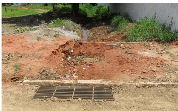
Foto 5: Estrutura de microdrenagem mal conservadas.
