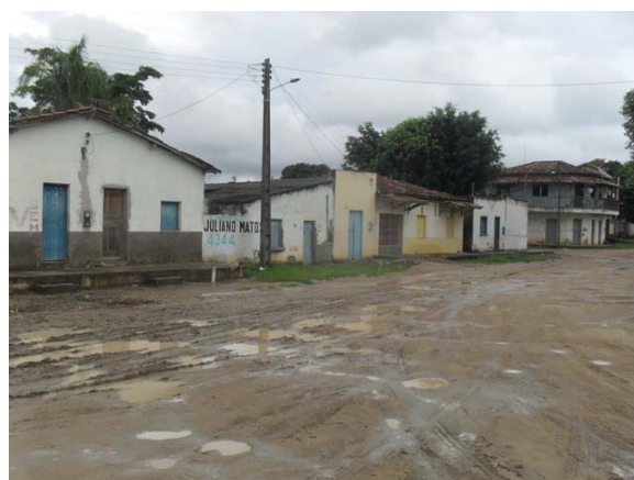
Foto 6: Área crítica 3 – Rua Valfrides Santana – área de alagamento.
