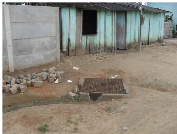
Foto 44: Área Crítica 9 – Rua da Felicidade – área de alagamento.
