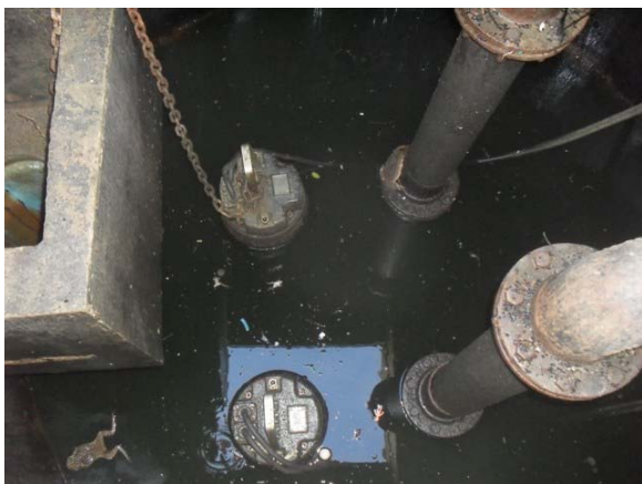
Foto 11: Poço de sucção da EE localizada dentro da área da ETE.
