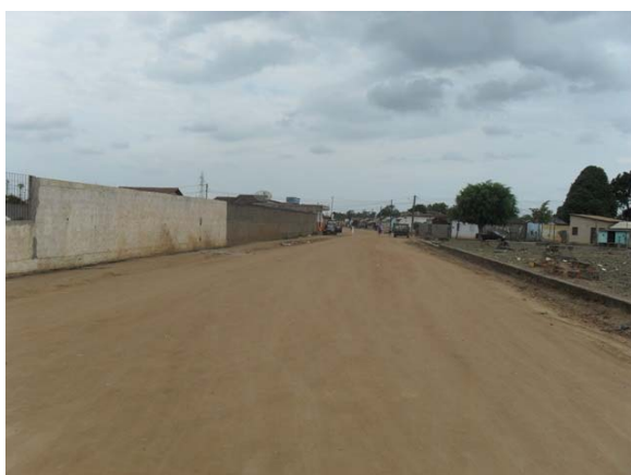
Foto 29: Área crítica 5 – Rua Porto Seguro – área de alagamento.
