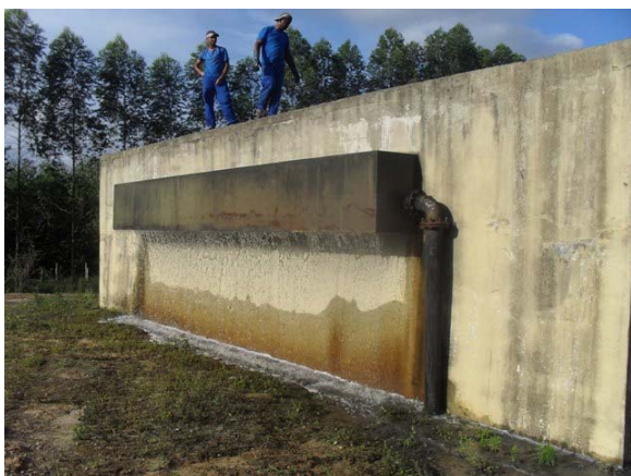
Foto 9: Extravasão do DAFA devido a obstrução na saída.
