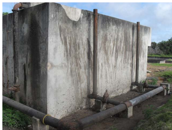
Foto 8: Visão da DAFA da ETE.
