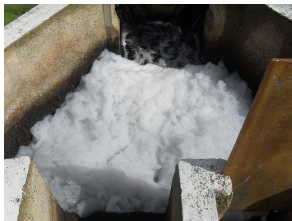
Foto 4: Caixa de distribuição para as lagoas.
