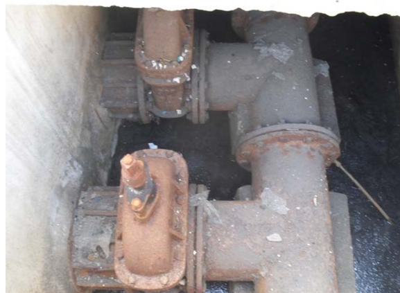
Foto 8: Má execução do barrilete da EE – tubulação chumada na parede.
