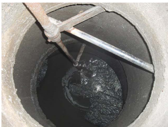
Foto 5: Aspecto geral de uma das elevatórias do SES.
