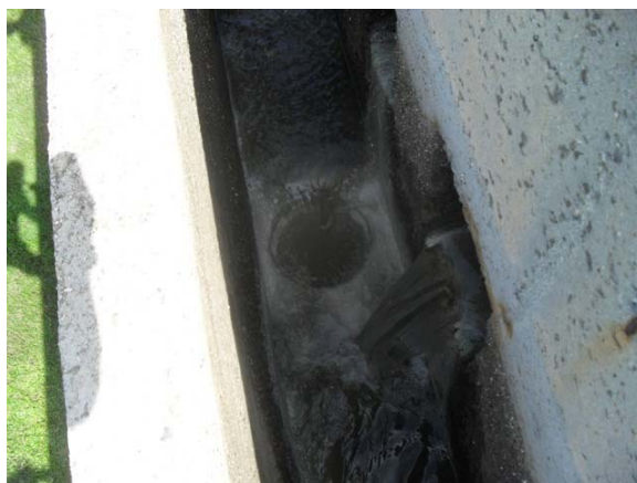
Foto 4: Aspecto geral do efluente do DAFA da ETE.
