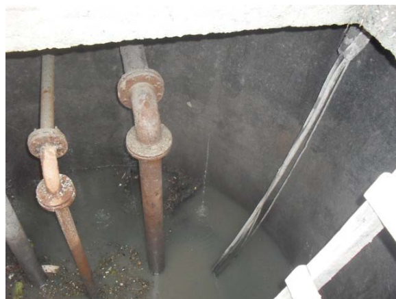
Foto 12: Vazamento detectado em uma das elevatórias.
