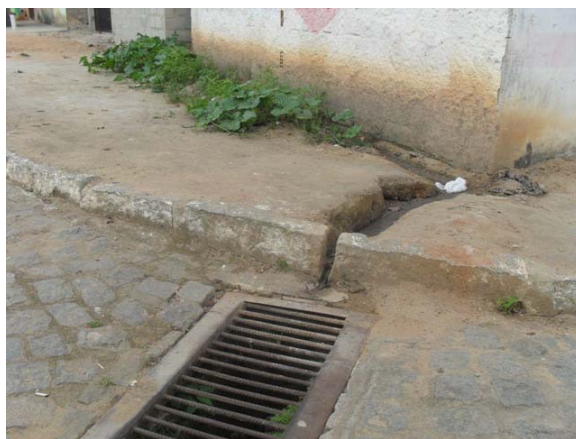
Foto 4: Esgoto secundário sendo lançado na microdrenagem.
