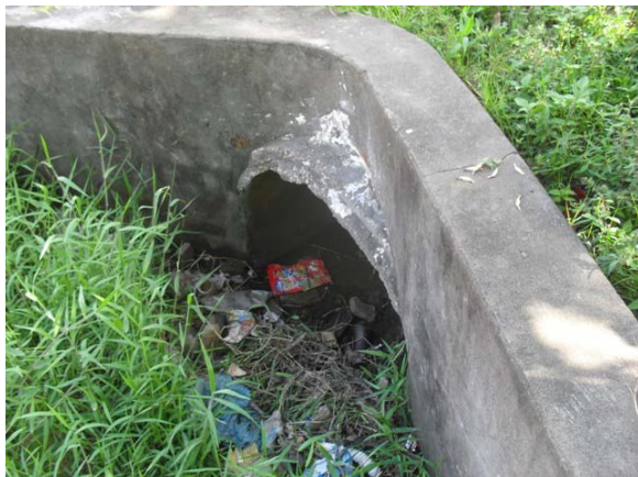
Foto 1: Bueiro com grande quantidade de resíduos e bastante assoreado.
