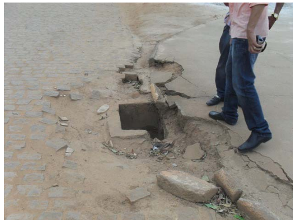
Foto 2: Estruturas de boca de lobo mal conservadas.
