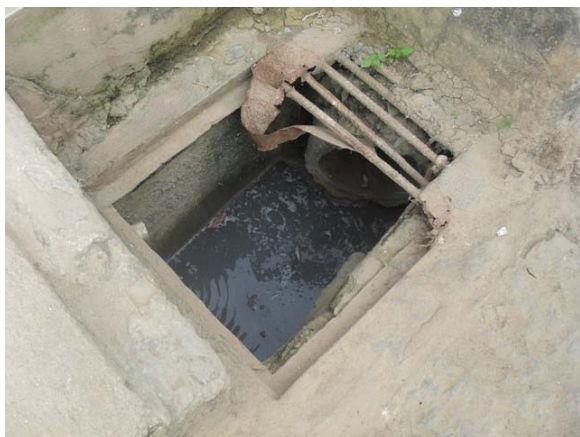
Foto 1: Contribuição de esgoto no sistema de drenagem.
