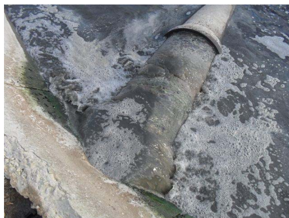
Foto 6: Tubulação na chegada da lagoa aerada necessitando manutenção.
