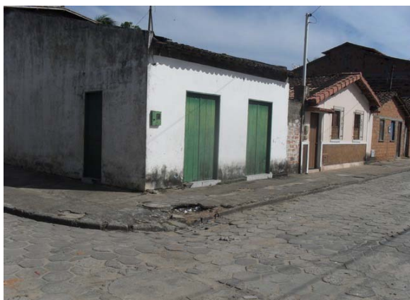
Foto 5: Área Crítica 1 – Rua do Farol – área de alagamento.
