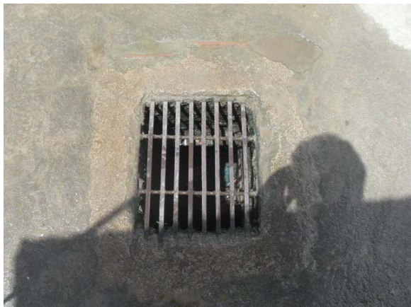
Foto 1: Caixa com grelha do sistema de microdrenagem.
