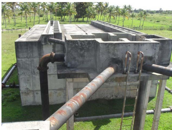
Foto 17: Vista geral do DAFA da ETE.
