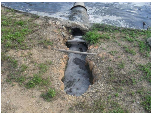
Foto 7: Tubulação na chegada da lagoa aerada necessitando manutenção.
