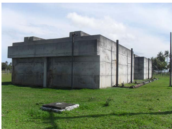
Foto 11: Vista geral do DAFA da ETE.
