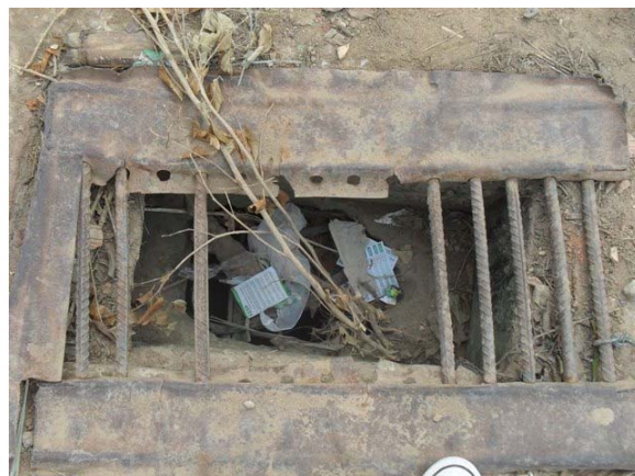
Foto 14: Área Crítica 1 – obstrução da caixa coletora causando problema de alagamento no Centro.
