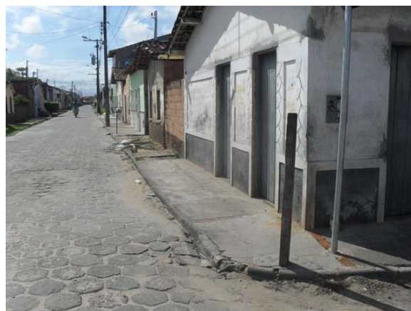
Foto 8: Área Crítica 1 – Rua General Osório – área de alagamento.
