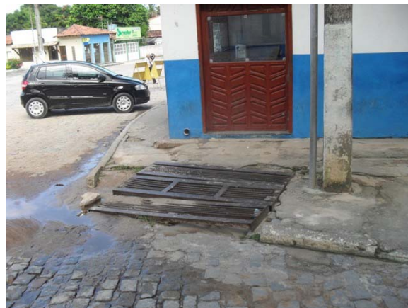
Foto 2: Grelhas totalmente assoreadas na Rua Frei Henrique Coimbra.
