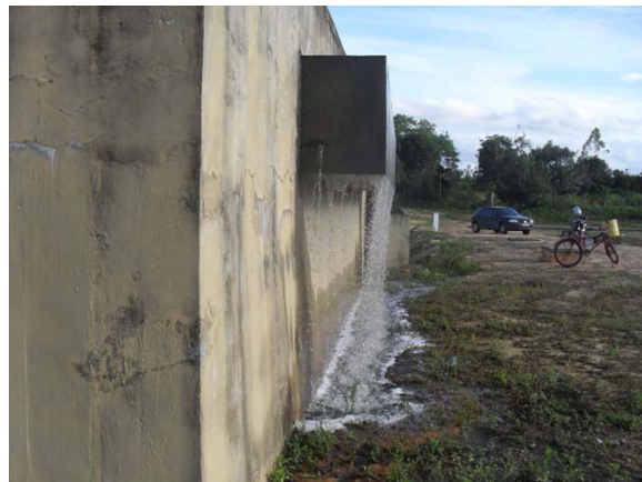
Foto 8: Extravasão do DAFA devido a obstrução na saída.
