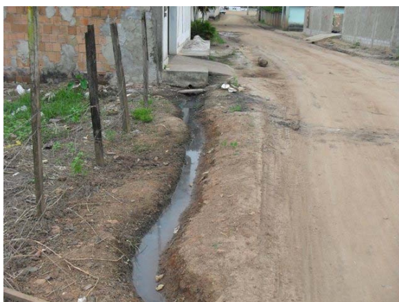
Foto 47: Área Crítica 10 – Rua E – área de alagamento.
