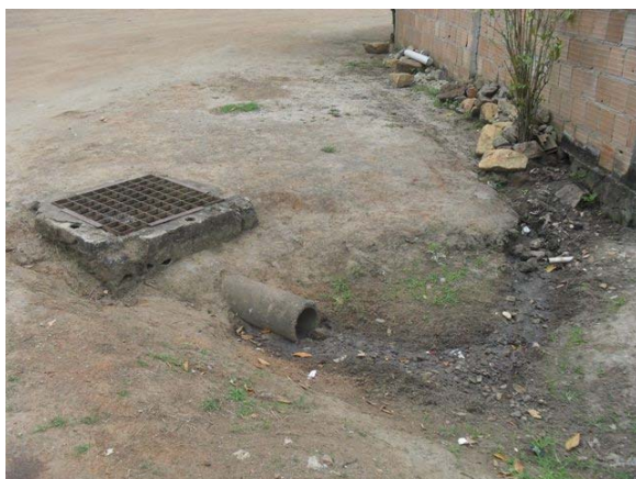
Foto 43: Área Crítica 9 – Rua da Felicidade – área de alagamento.
