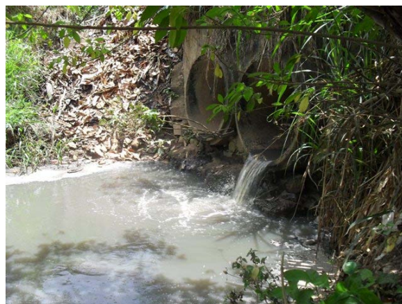
Foto 4: Ponto de saída das duas manilhas de DN 1000mm com contribuição de esgoto.
