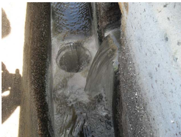
Foto 5: Aspecto geral do efluente do DAFA da ETE.
