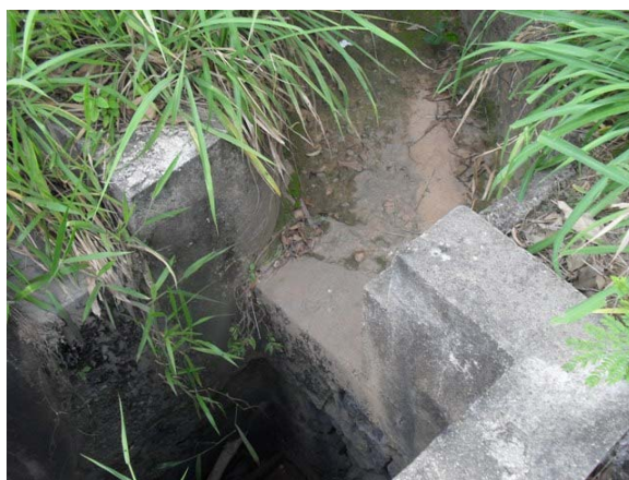
Foto 12: Ponto final da microdrenagem necessitando de conservação e manutenção.
