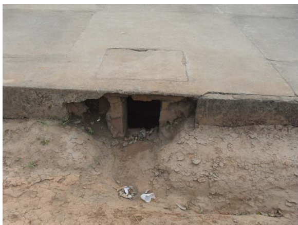
Foto 3: Estruturas de boca de lobo mal conservadas.
