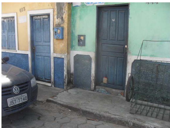
Foto 7: Área Crítica 1 – Rua General Osório – área de alagamento.
