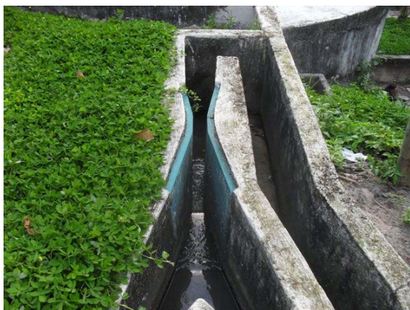
Foto 15: Tratamento preliminar da ETE Urbis III.
