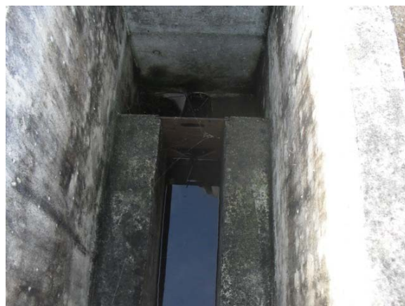
Foto 6: Aspecto geral do Afluente da ETE.
