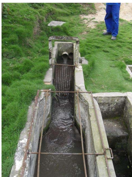
Foto 17: Tratamento preliminar – gradeamento e caixa de areia da ETE Urbis II.
