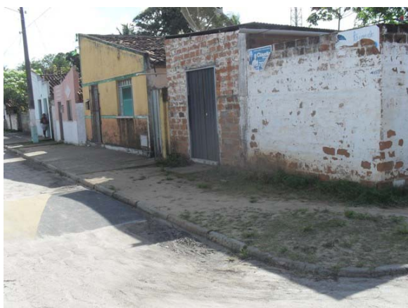
Foto 13: Área Crítica 3 – Travessa Tamandaré – área de alagamento.
