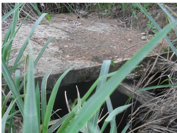
Foto 9: Ponto final da microdrenagem necessitando de conservação e manutenção.
