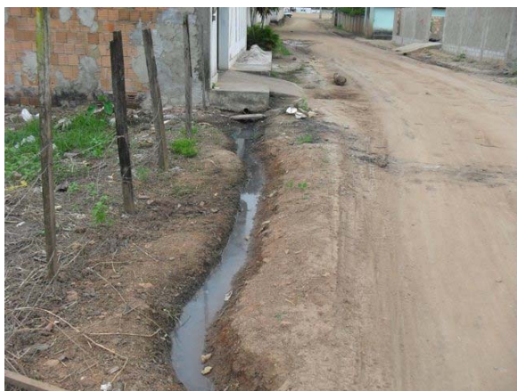
Foto 3: Esgoto correndo a céu aberto.
