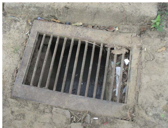
Foto 4: Estruturas de microdrenagem mal conservadas.
