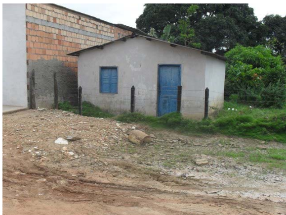
Foto 25: Área Crítica 3 – Rua do Bairro Bandeirante – área de alagamento.
