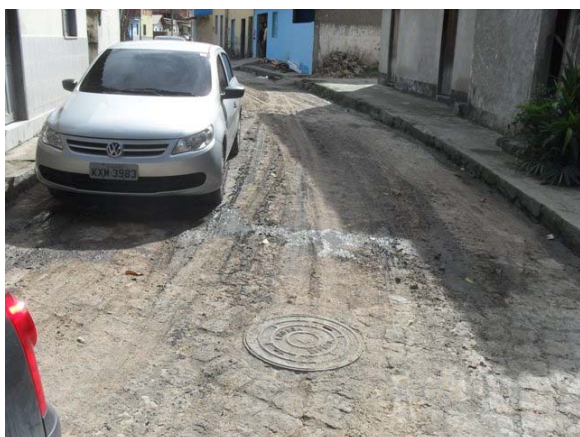
Foto 5: Índícios de extravasamento do PV próximo da EE-03.
