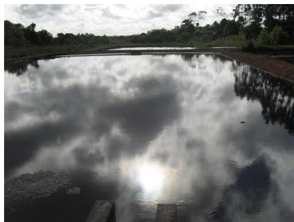
Foto 10: Lagoas de Macrófitas da ETE.
