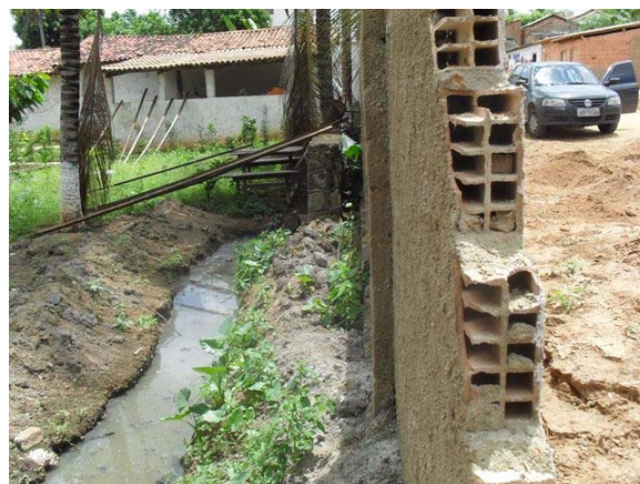
Foto 12: Área Crítica 3 – Rua Marcelino Senna – área de alagamento.
