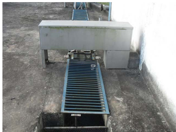
Foto 8: Unidade de tratamento complementar com lâmpada UV – fora de funcionamento.
