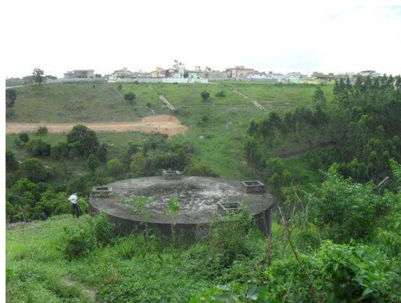
Foto 6: DAFA abandonado do Bairro Edgar Trancoso.
