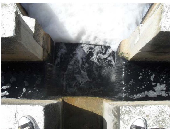
Foto 5: Caixa de distribuição para as lagoas.
