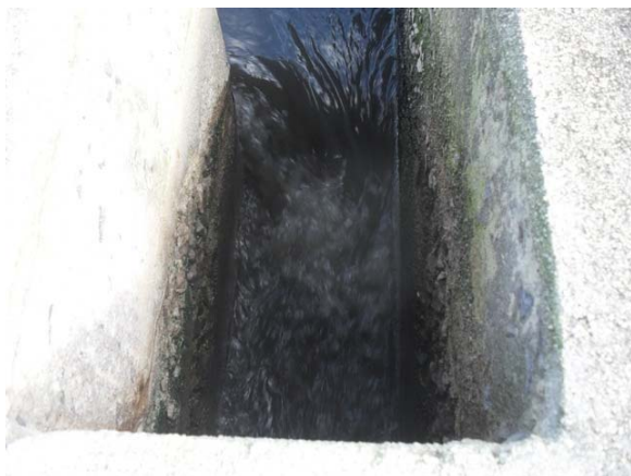
Foto 1: Aspecto geral do afluente da ETE.
