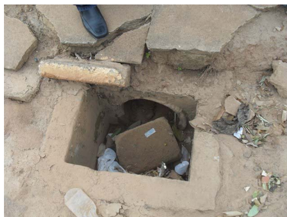
Foto 40: Área Crítica 7 – Praça do Fórum – área de alagamento.
