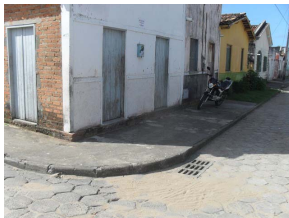
Foto 4: Área Crítica 1 – Rua do Farol – área de alagamento.
