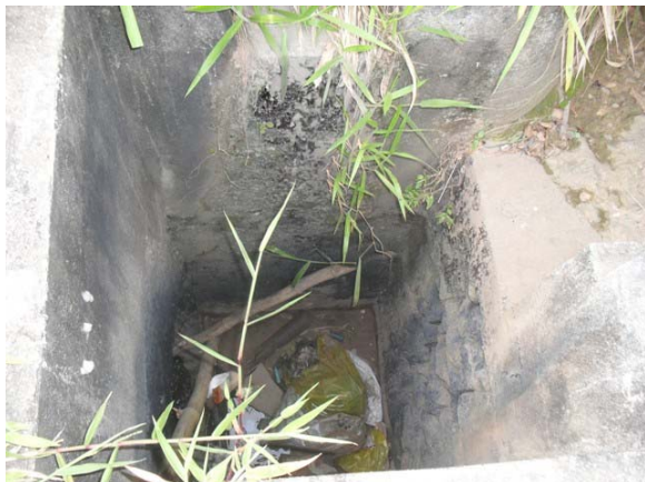
Foto 1: Ponto final da microdrenagem necessitando de conservação e manutenção.
