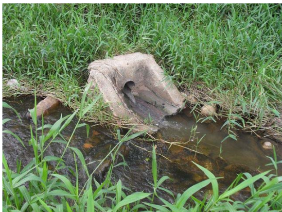
Foto 1: Lançamento de efluente no Córrego Ribeirão do Prata.
