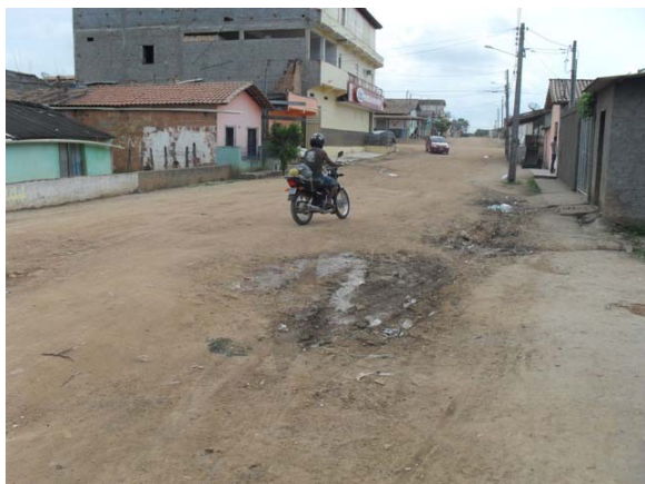
Foto 19: Área Crítica 3 – Rua do Bairro Bandeirante – área de alagamento.
