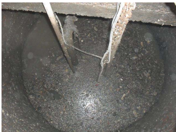
Foto 3: Aspecto geral de uma das elevatórias do SES.
