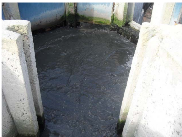
Foto 3: Caixa de distribuição da ETE.
