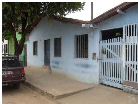
Foto 32: Área Crítica 6 – Rua do Asilo – área de alagamento.
