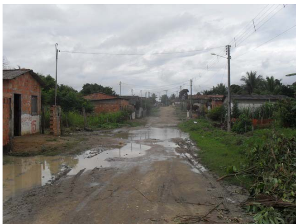
Foto 7: Área Crítica 4 – Rua 02 – área de alagamento.
