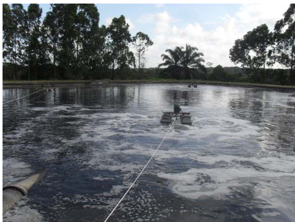
Foto 1: Aerador funcionando na ETE.
