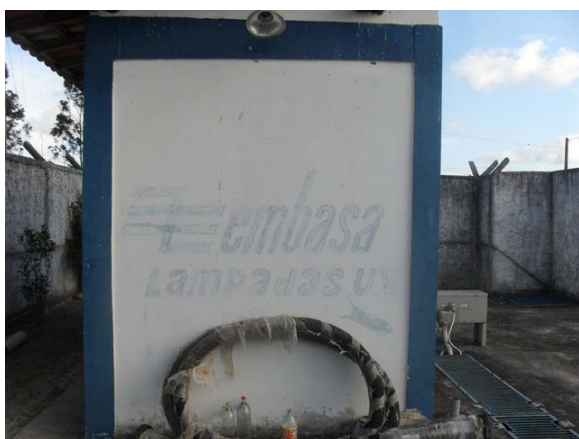
Foto 9: Unidade de tratamento complementar com lâmpada UV – fora de funcionamento.
