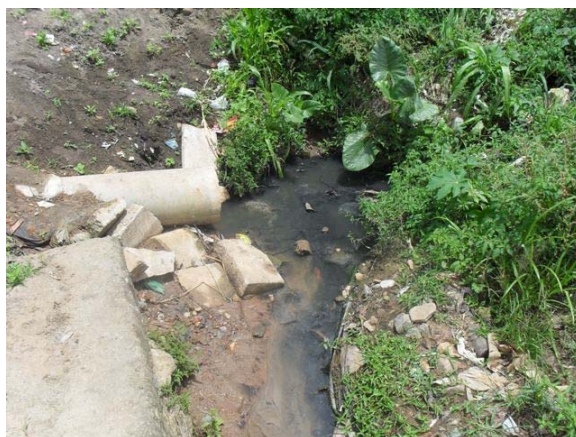
Foto 4: Manilha lançando esgoto no Rio Limoeiro.
