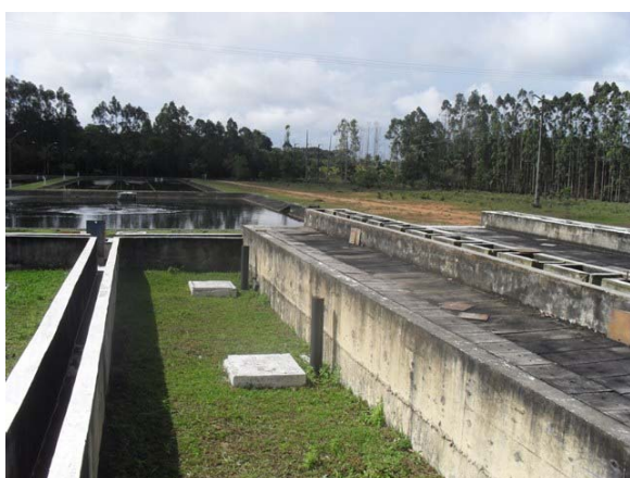
Foto 9: DAFA da ETE.
