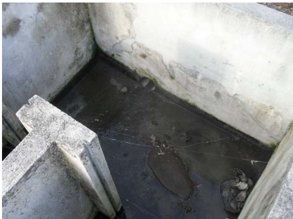
Foto 7: Aspecto geral do Afluente da ETE.
