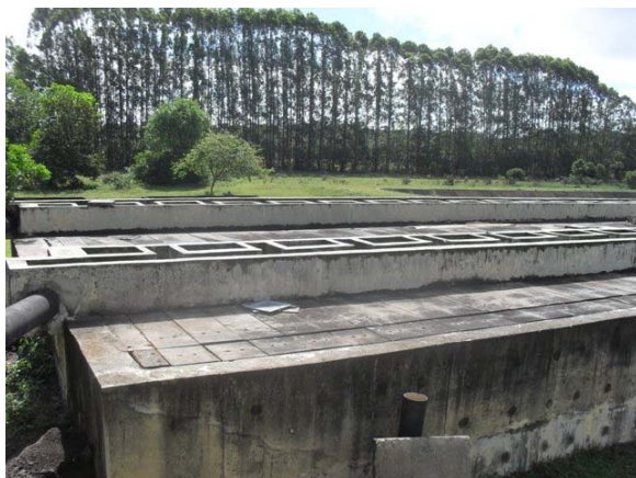
Foto 7: DAFA da ETE.
