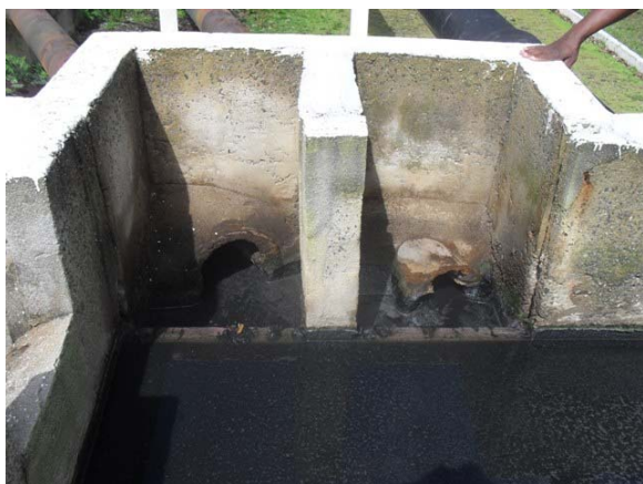
Foto 3: Caixa de distribuição do afluente.
