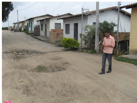
Foto 26: Área Crítica 4 – Rua Caminho 5 – área de alagamento.
