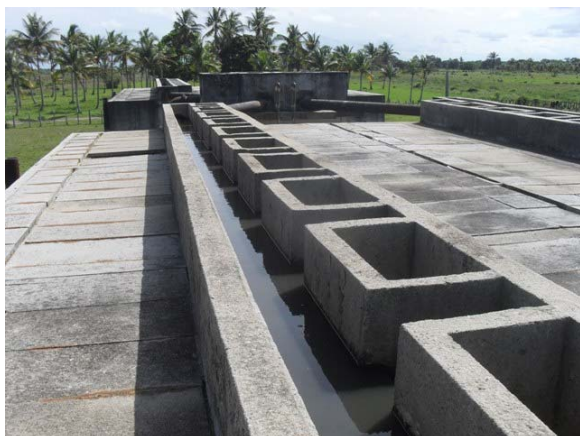
Foto 13: Vista geral do DAFA da ETE.
