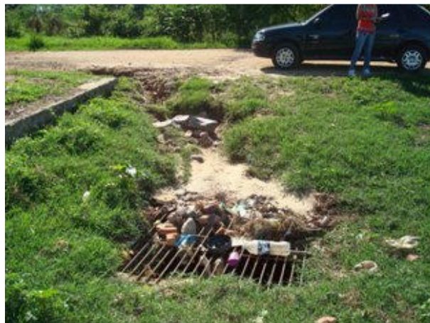
Foto 8: Rua Senhor do Bonfim – Caixa de captação obstruída
