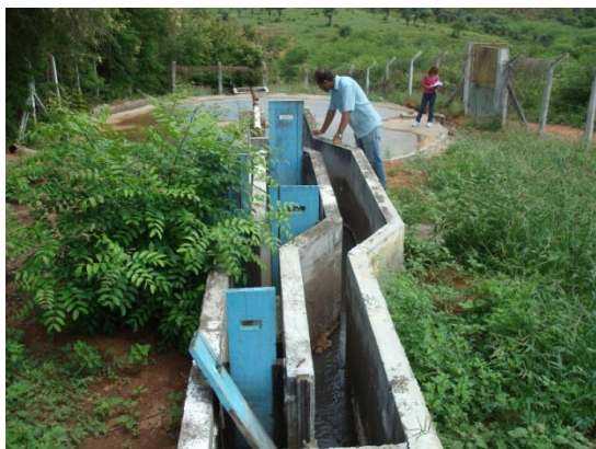
Foto 1: ETE inoperante – Atendia ao tratamento dos esgotos de parte do centro da cidade.
