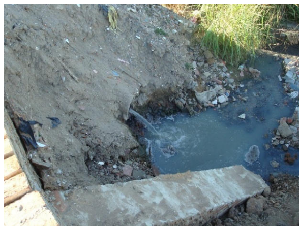
Foto: Ponto de lançamento de esgotos em Córrego
