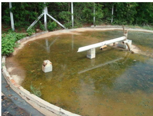
Foto 3: ETE inoperante – Atendia ao tratamento dos esgotos de parte do centro da cidade.
