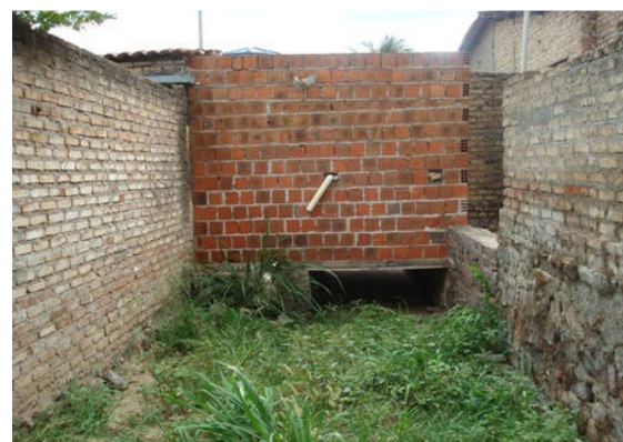
Foto 4: Rua Alto da Serra – estrangulamento da galeria retangular passando por trás dos imóveis
