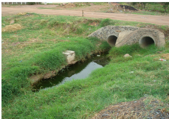
Foto 1: Ponto de lançamento final do sistema de coleta misto.
