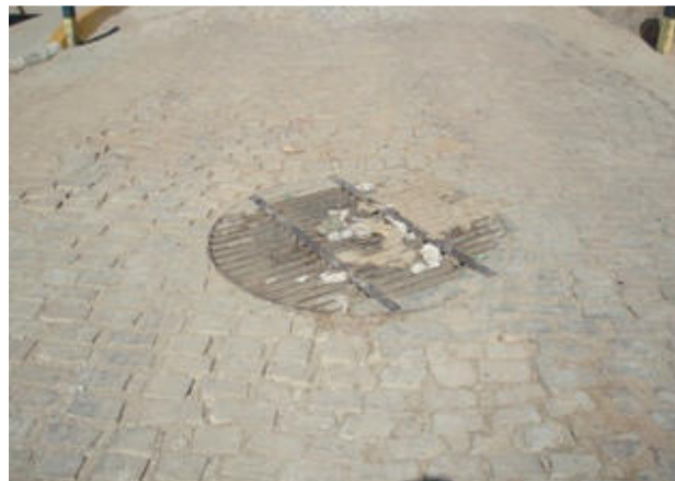
Foto 2: Vista de caixa de captação com grade obstruída.
