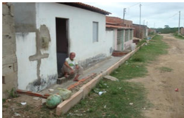
Foto 6: Área crítica 3, casas atingidas por enxurradas.
