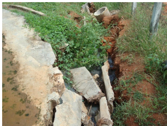
Foto 2: ETE inoperante – Atendia ao tratamento dos esgotos de parte do centro da cidade.
