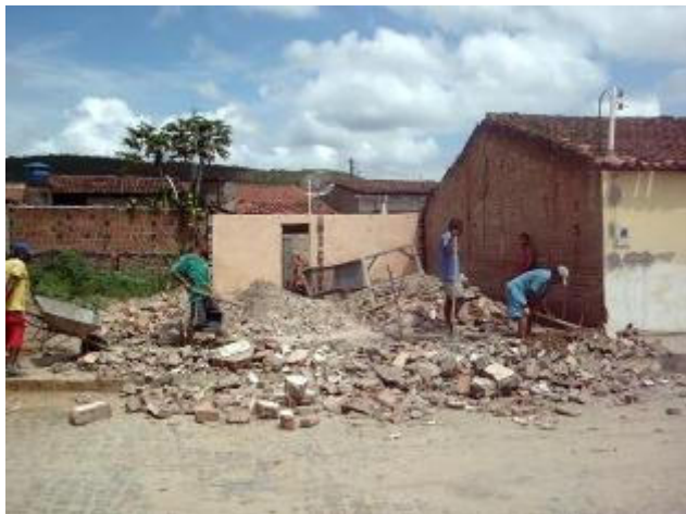
Foto 1: Rua Princesa Izabel - casa derrubada pelas águas.
