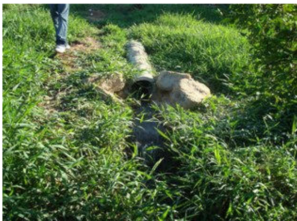
Foto 1: Ponto de lançamento de esgotos em lagoa Coord. N: 365950 Coord. E: 8812 2313
