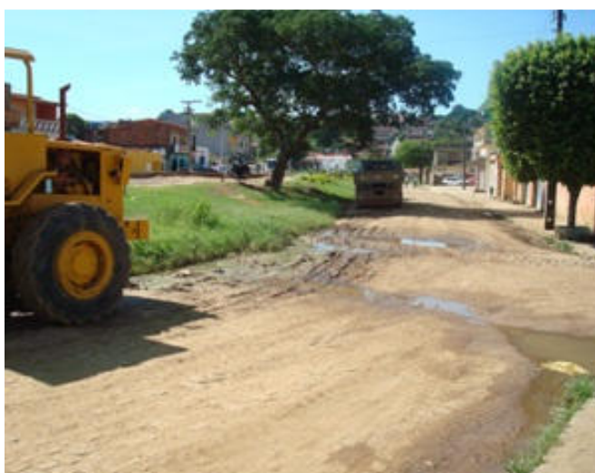
Foto 15: Vista Av Tancredo Neves área crítica 5, caracterizada por freqüentes alagamentos.
