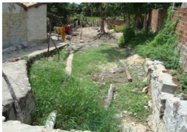
Foto 4: Área crítica 2, atingida por enxurradas.
