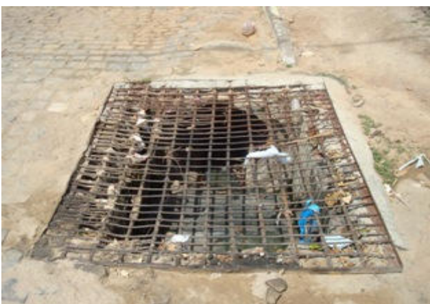
Foto 4: Praça Luiz Eduardo Magalhães- Vista da grelha, área crítica 1 , caracterizada por freqüentes alagamentos.
