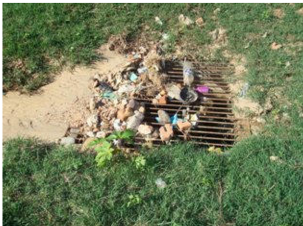
Foto 7: Rua Senhor do Bonfim – Caixa de captação obstruída
