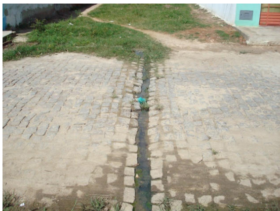
Foto 1: Rua João Bacelar – Águas servidas sendo descartadas a céu aberto.
