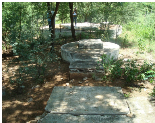
Foto 2: Unidade de tratamento inoperante.
