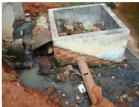
Foto 4: ETE inoperante – Atendia ao tratamento dos esgotos de parte do centro da cidade.
