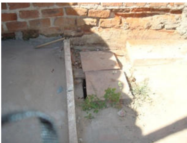
Foto 4: Rua Graciliano de Jesus – Caixa de captação
