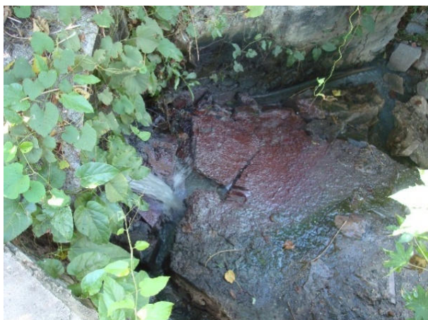
Foto: Ponto de lançamento de esgotos (inclusive do Hospital Regional) em terreno natural na Av. Roberto Santos
