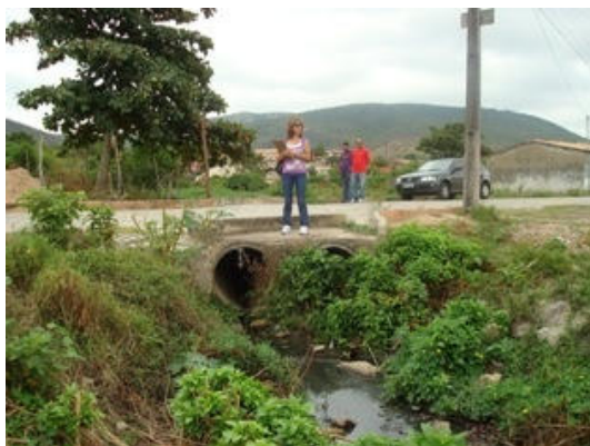
Foto 1: Canal natural com contribuição de esgotos – Rua da Laranjeira.
