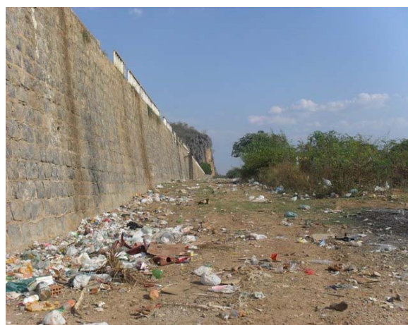
Foto 4: Ponto de lançamento de águas pluviais – muito lixo – calha da Lagoa da Lapa.
