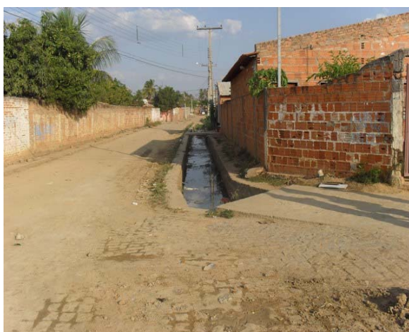
Foto 11: Canal 2 – Bairro Cavallhada – Canal em alvenaria de pedra (1,50 x 1,20) parte aberta e parte coberta – observa-se presença de esgoto.
