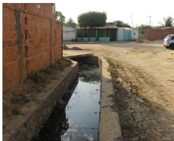
Foto 12: Canal 2 – Bairro Cavallhada – Canal em alvenaria de pedra (1,50 x 1,20) parte aberta e parte coberta – observa-se presença de esgoto.
