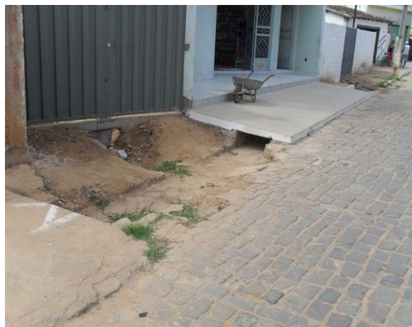
Foto 4: Área crítica 1 – Av. Moreira – em tempo de chuva a água já atingiu 1 m de altura invadindo as casas
