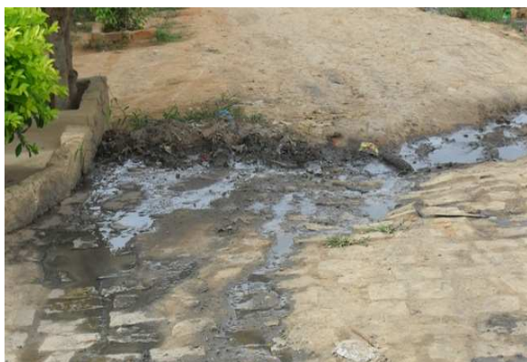
Foto 9: Esgoto secundário lançado a céu aberto sobre pavimentação de paralelepípedo.
