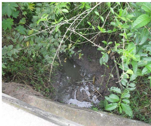
Foto 4: Ponto de lançamento de esgoto – Riacho dos Macacos (bem próximo ao ponto de captação)
