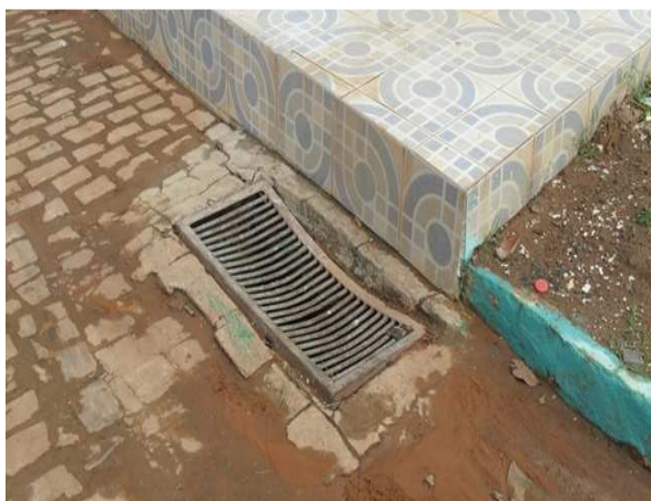
Foto 5: Elemento de microdrenagem – caixa com grelha.
