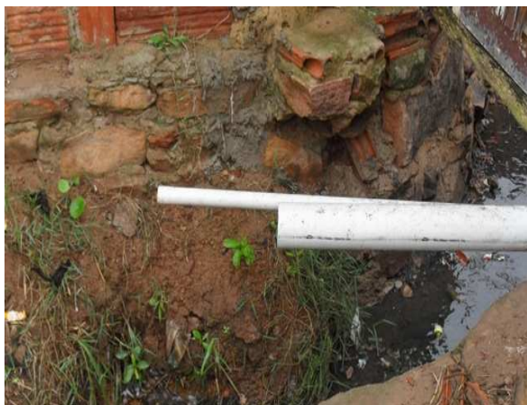
Foto 1: Lançamento de esgoto secundário em canal de drenagem.
