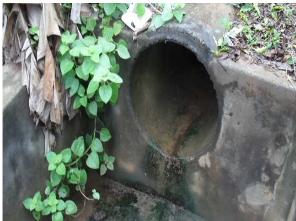
Foto 1: Ausência de esgoto na drenagem pluvial.
