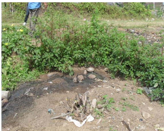
Foto 1: Ponto de lançamento de esgoto – tubo de 60 x 40.
