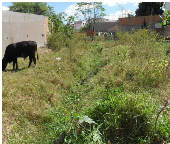
Foto 6: Leito do rio obstruído pela vegetação.
