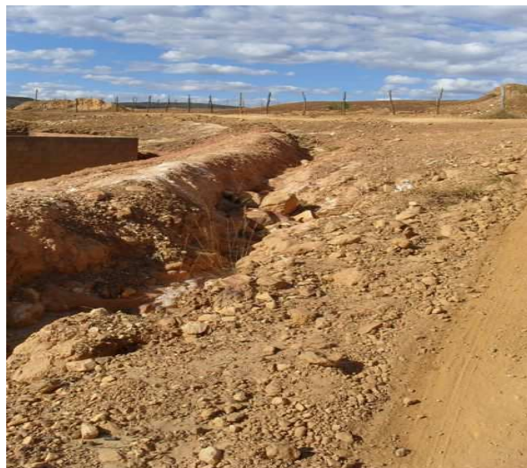
Foto 2: Erosão do solo – terra desce com as chuvas – necessita intervenção no Morro da Coruja.
