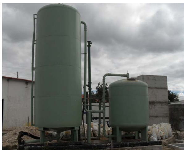
Foto 10: ETE 2 – abandonada – lagoa e DAFA
