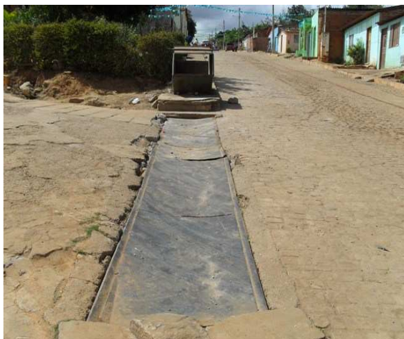
Foto 1: Canaleta de esgoto com tampa metálica.
