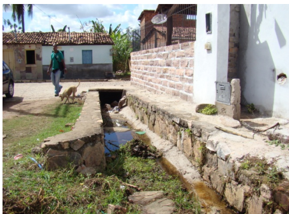
Foto 1: Canal de drenagem com presença de lixo e vegetação.
