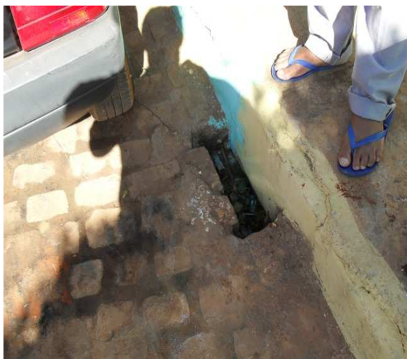
Foto 3: Drenagem pluvial – caixa sub dimensionada.
