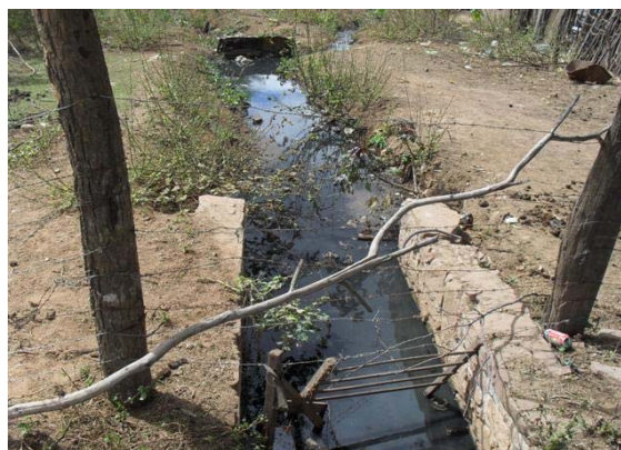
Foto 6: Outro ponto de lançamento de esgoto na galeria que escorre para o rio.
