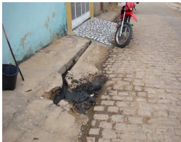
Foto 2: Rua Erminio José dos Santos – esgoto a céu aberto.
