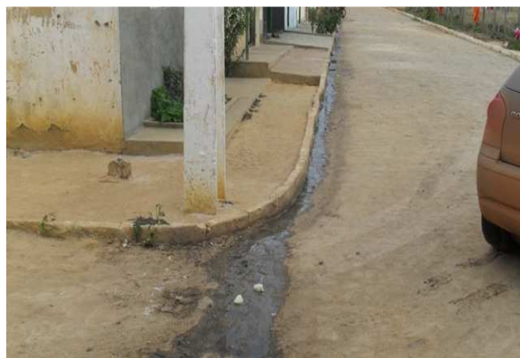
Foto 4: Esgoto a céu aberto na sarjeta.
