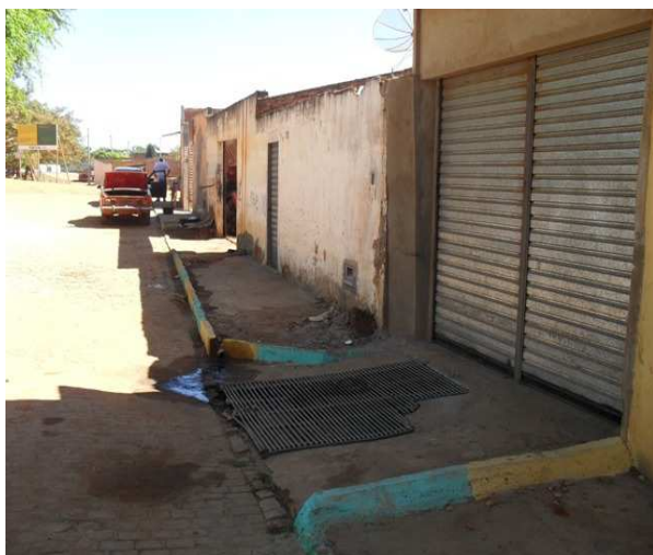
Foto 5: Elemento de microdrenagem – caixa com grelha.
