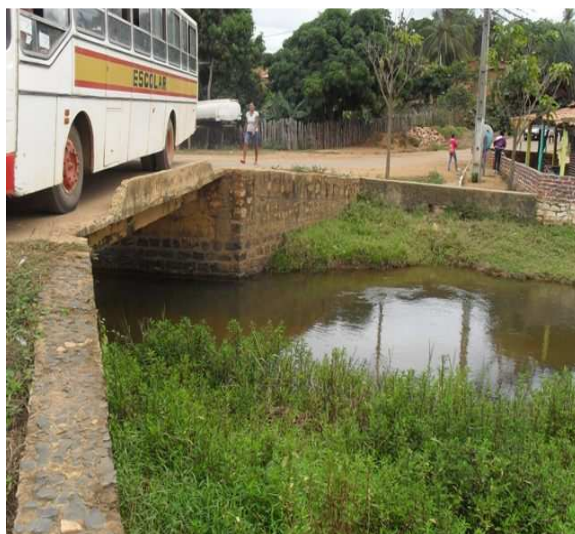
Foto14: Rio Utinga – ponte para o colégio – área crítica de inundação.
