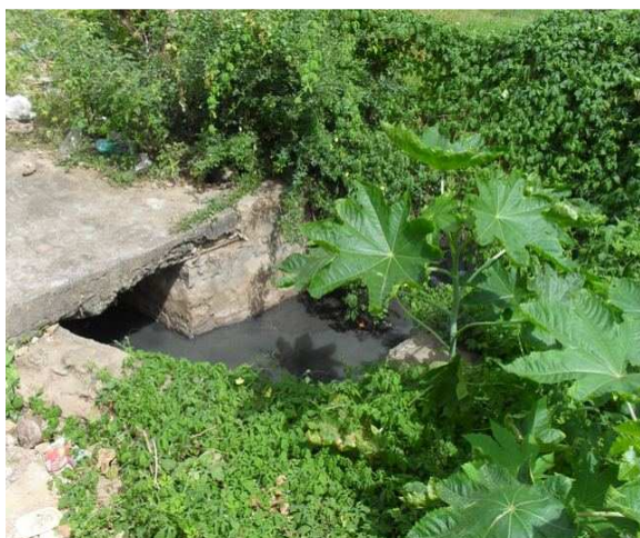
Foto 7: Galeria apresentando esgoto e água de chuva
