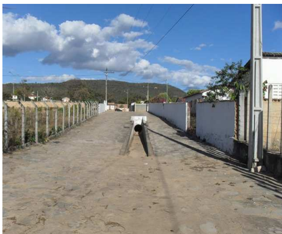
Foto 3: ponto de lançamento de macro drenagem – Ø1,0m – a mais ou menos 100m do Rio Brumado.
