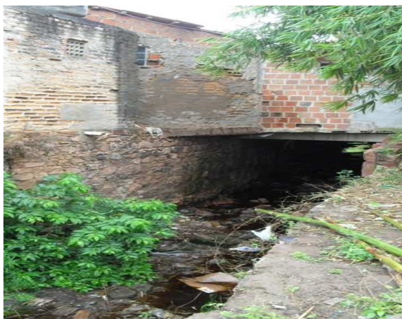
Foto 7: Construção irregular sobre canal.
