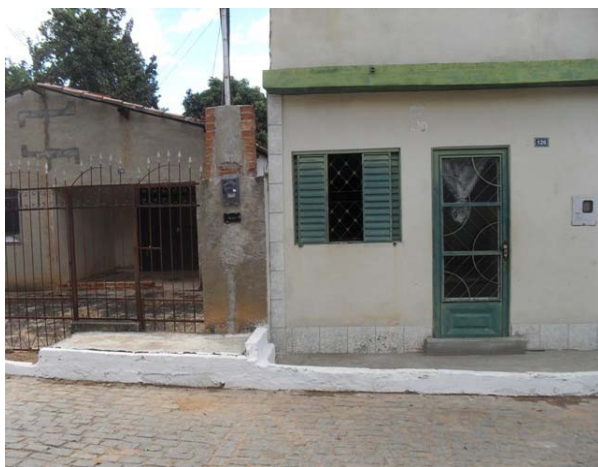
Foto 5: Área crítica 2 – Rua Dr. Lafaiete Coutinho – local de enxurrada
