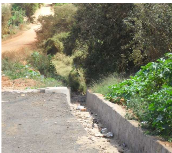
Foto 3: Canaleta de drenagem – interface revestida x céu aberto.
