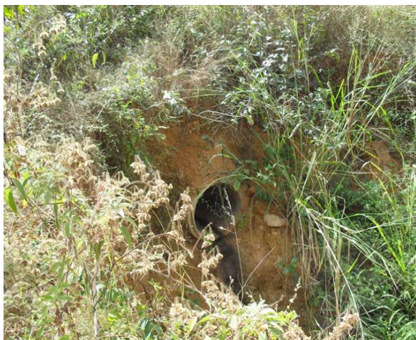
Foto 3: Lançamento de esgoto a céu aberto.
