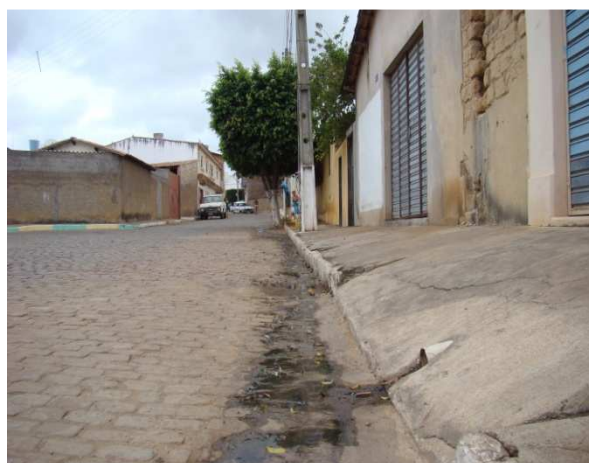
Foto 4: Rua Horizonte, altura do nº 79 – esgoto a céu aberto.
