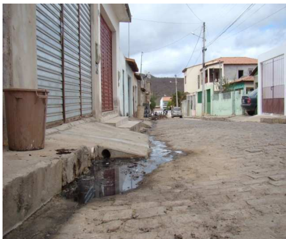
Foto 1: Rua 2 de Julho – altura do nº 162 – esgoto a céu aberto
