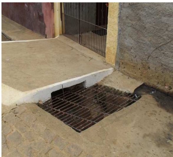
Foto 7: Elemento de microdrenagem – caixa com grelha.
