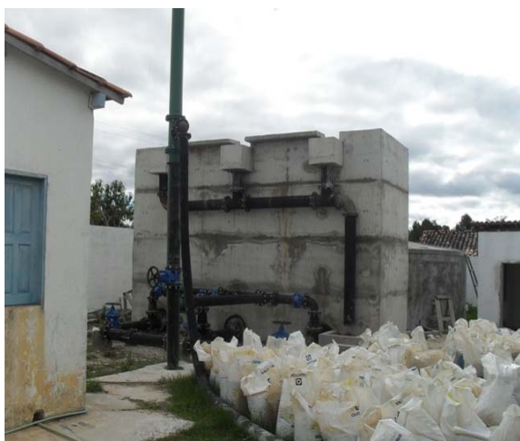
Foto 9: ETE 2 – abandonada – lagoa e DAFA
