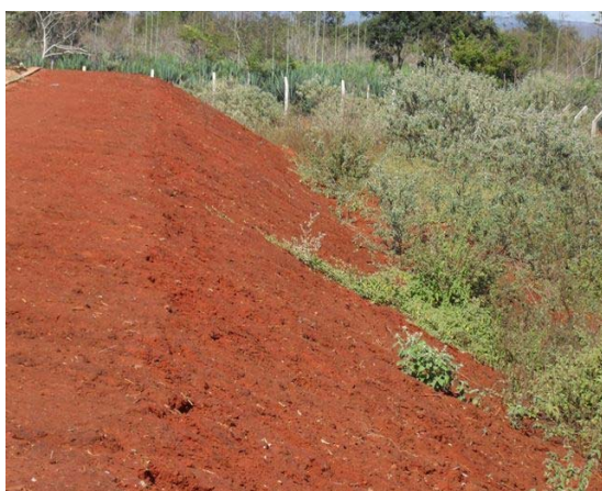
Foto 11: ETE – taludes externos sem cobertura vegetal, sujeitos a erosão.
