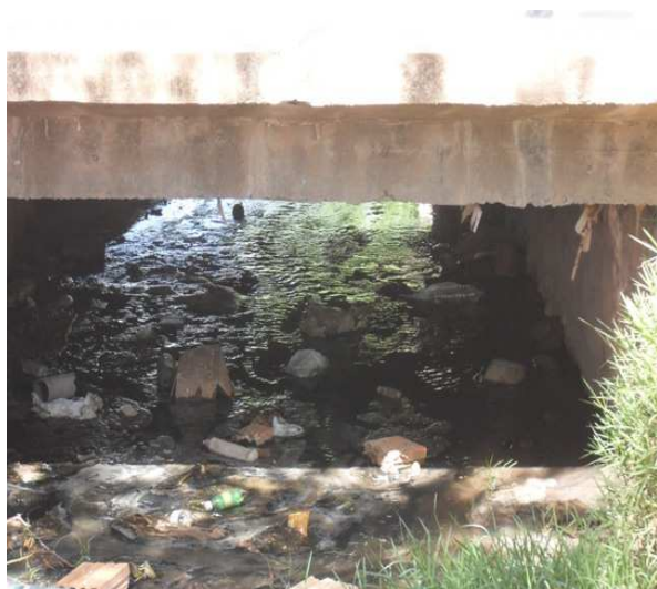
Foto 1: Lixo e esgoto no rio.
