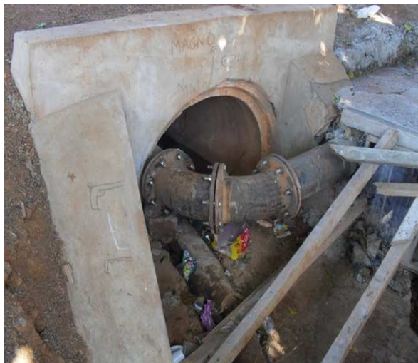
Foto 1: Bueiro sob a rodovia, obstruído pela rede da EMBASA.
