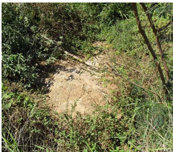
Foto 15 – Fossa Comunitária executada pela Prefeitura – 70,00m.
