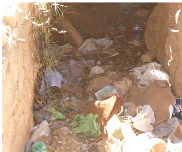
Foto 8: Presença de lixo na rede de drenagem.
