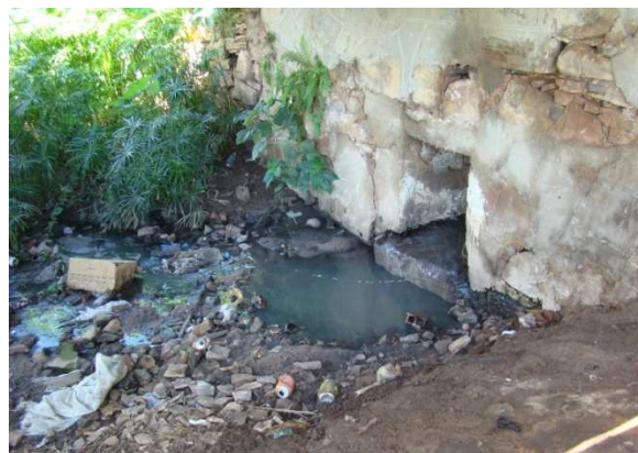
Foto 2: Lançamento direto de esgoto no Rio Gafanhoto
