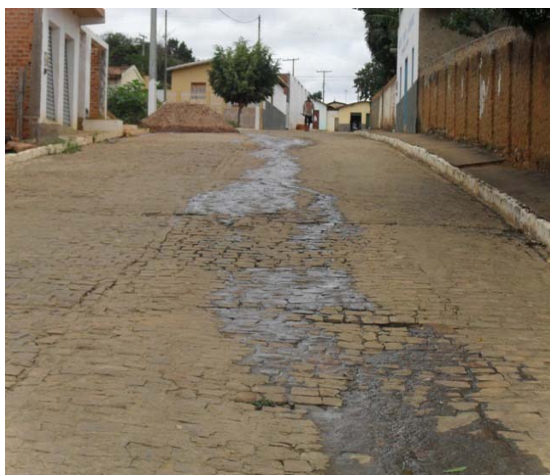
Foto 5: Esgoto secundário a céu aberto.
