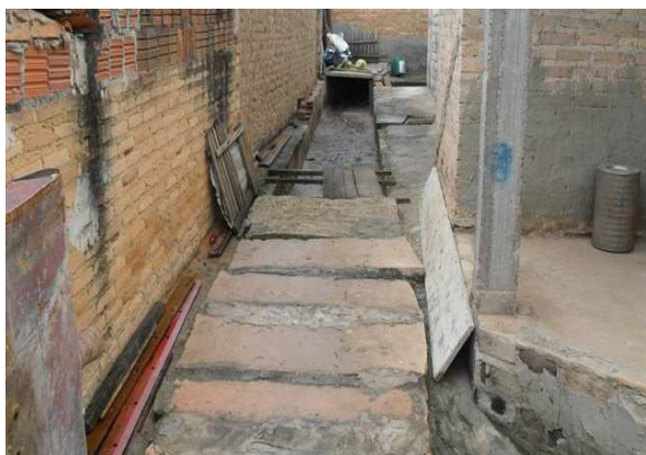
Foto 5: Construções irregulares sobre canal.
