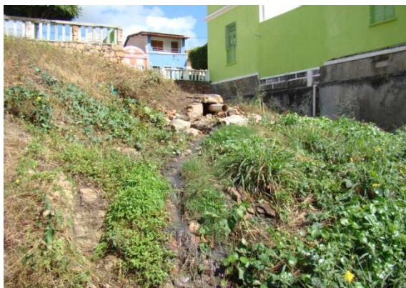
Foto 3: Rua da Glória – lançamento de esgoto secundário no Rio Baiano
