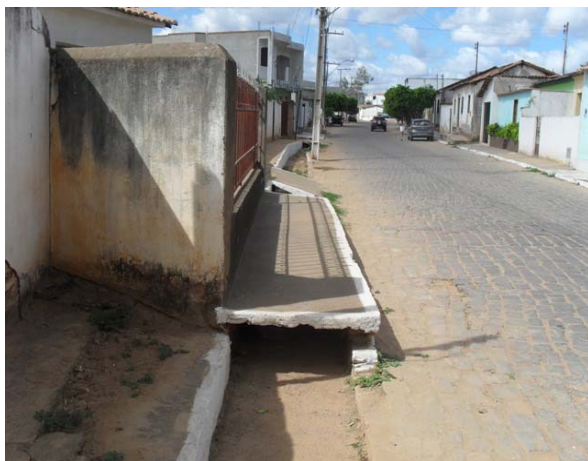
Foto 3: Área crítica 1 – Av. Moreira – em tempo de chuva a água já atingiu 1 m de altura invadindo as casas
