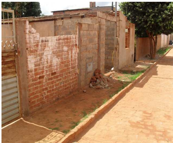
Foto 1: Ausência de esgoto nas sarjetas.
