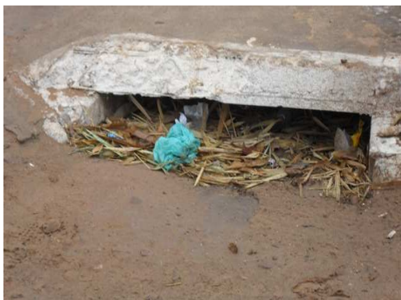
Foto 9: Elemento de microdrenagem – abertura lateral na guia.
