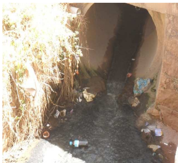
Foto 2: Presença de lixo e esgoto em estrutura de drenagem.
