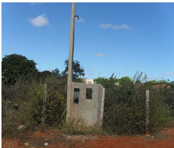
Foto 1: Área da EE – poste, base de comando e poço enterrado sob o matagal.
