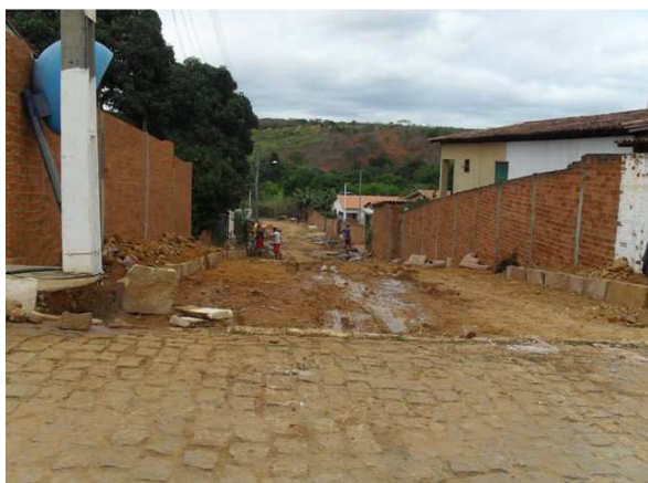
Foto 5: Drenagem superficial em direção ao rio.
