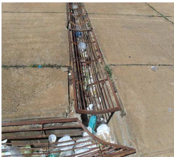
Foto 4: Elemento de microdrenagem – calha com grelha – pátio da feira.
