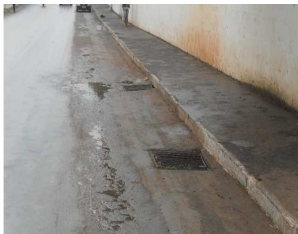
Foto 8: Elemento de microdrenagem – caixas com grelha.
