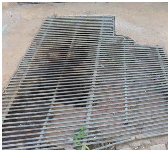
Foto 6: Elemento de microdrenagem – caixa com grelha.
