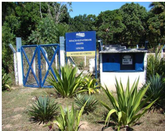
Foto6: Estação elevatória de esgoto.
