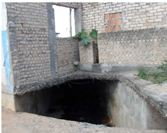
Foto 3: Construção irregular sobre estrutura de drenagem.
