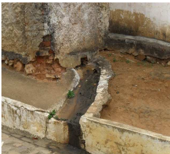
Foto 13: Galeria de drenagem recebendo esgoto secundário.
