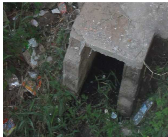
Foto 4: Elemento de drenagem.
