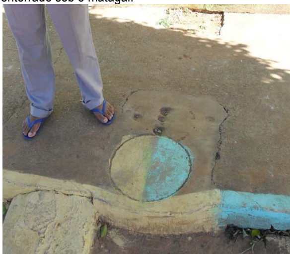
Foto 3: Caixa de ligação.
