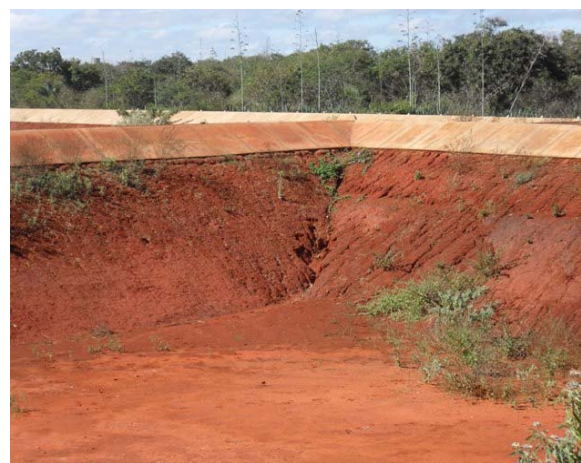
Foto 10: ETE – processo erosivo nos taludes externos.
