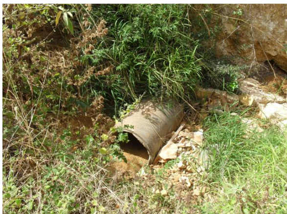
Foto 9: Tubulação de drenagem pluvial assoreada.
