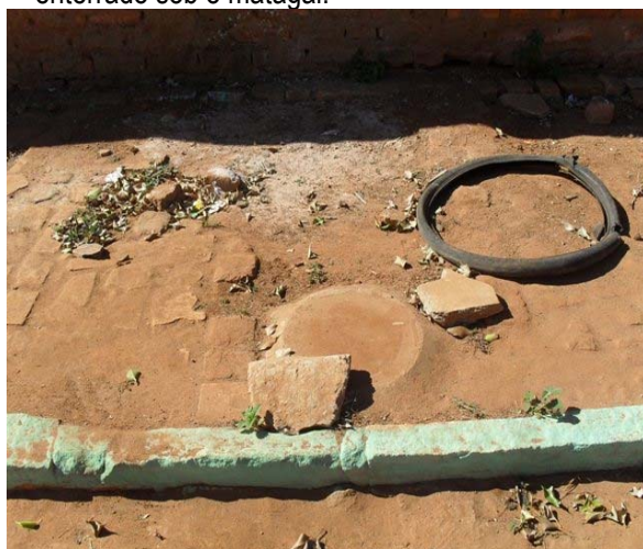
Foto 4: Caixa de ligação.
