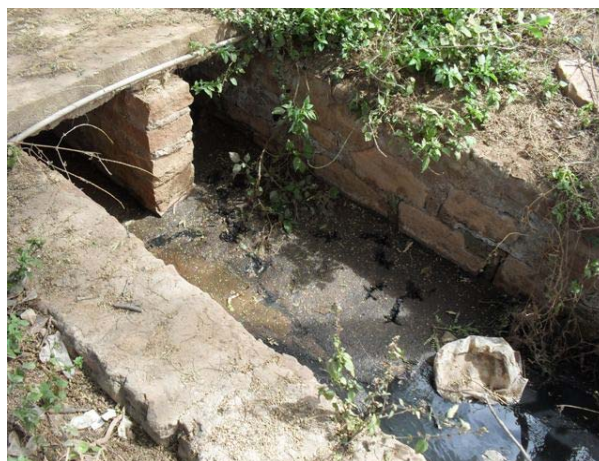
Foto 4: Vista da galeria com presença de esgoto (água servida) – lançamento no Rio.
