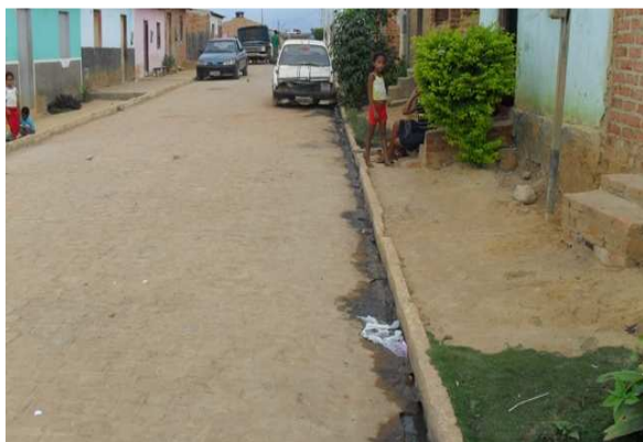
Foto 3: Esgoto a céu aberto na sarjeta.
