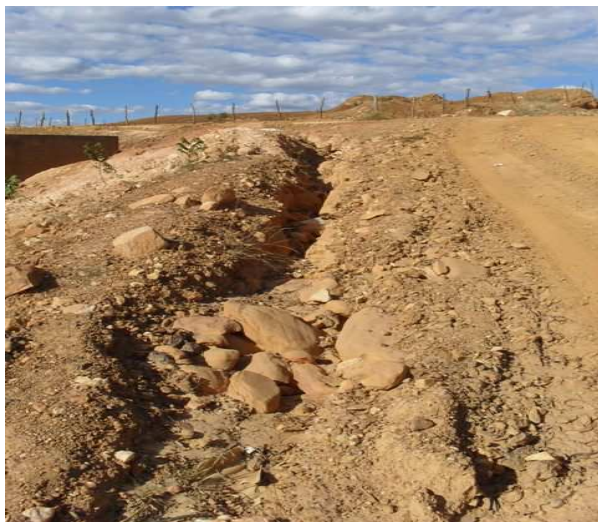
Foto 1: Erosão do solo – terra desce com as chuvas – necessita intervenção no Morro da Coruja.
