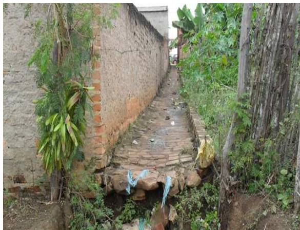
Foto 2: Descida de água superficial – final da calha com erosão
