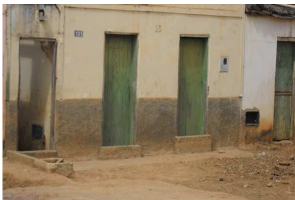
Foto 27: Proteção em casa contra alagamento.
