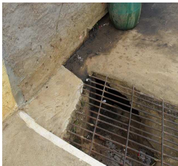
Foto 8: Elemento de microdrenagem – caixa com grelha.
