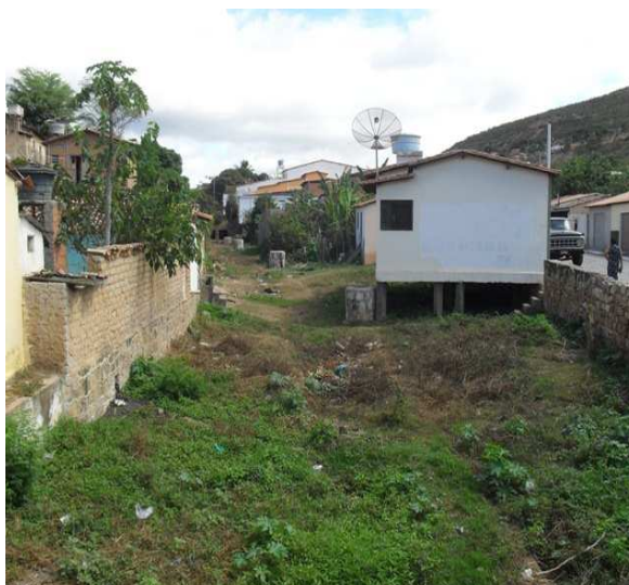
Foto 8: Canal de macrodrenagem com construções irregulares e interceptor de esgoto da EMBASA.
