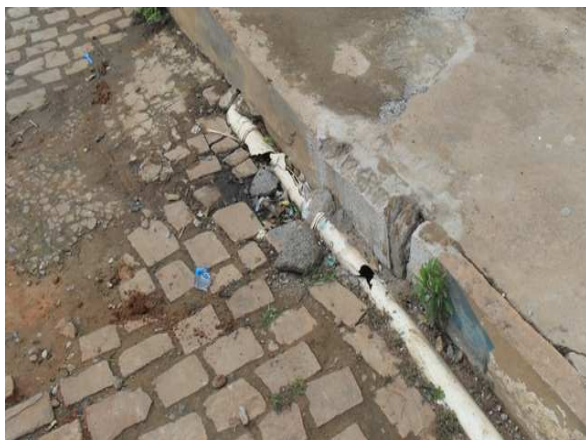
Foto 1: Coletor de esgoto secundário com tubo PVC 100mm – superficial.
