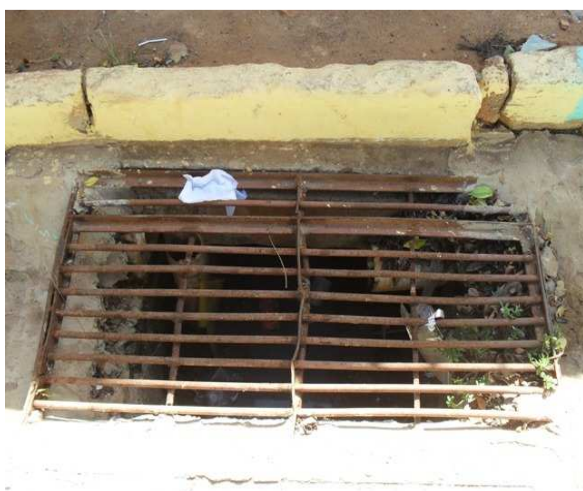
Foto 7: Elemento de microdrenagem – caixa com grelha.
