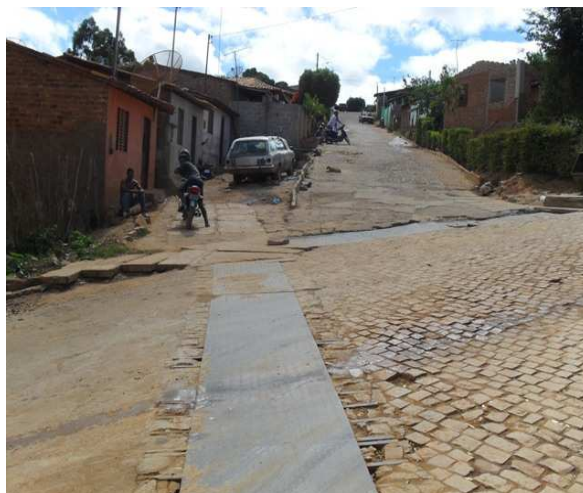
Foto 2: Canaleta de esgoto com tampa metálica.
