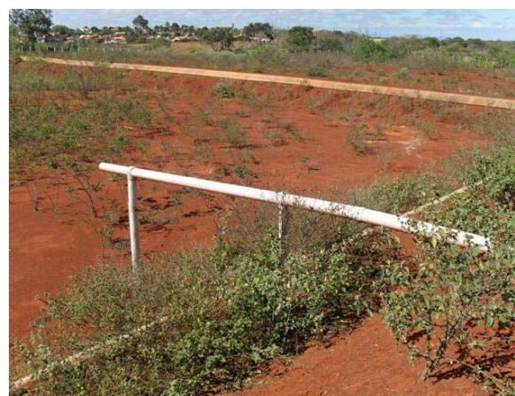
Foto 12: ETE – tubulação de ligação entre lagoas – PVC exposto ao sol.
