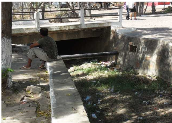
Foto 5: Canal de macrodrenagem, bueiro e tubulação de água obstruindo.
