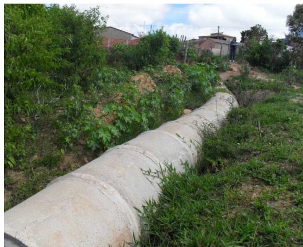
Foto 2: Ponto de lançamento de drenagem (Ø1,0m) com presença de esgoto.
