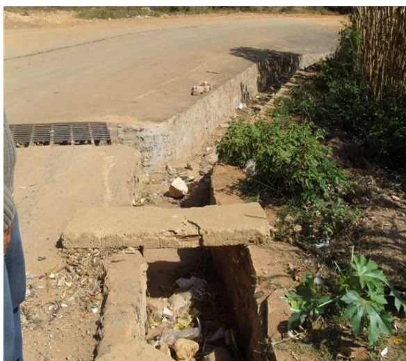
Foto 4: Canaleta de drenagem com presença de lixo.
