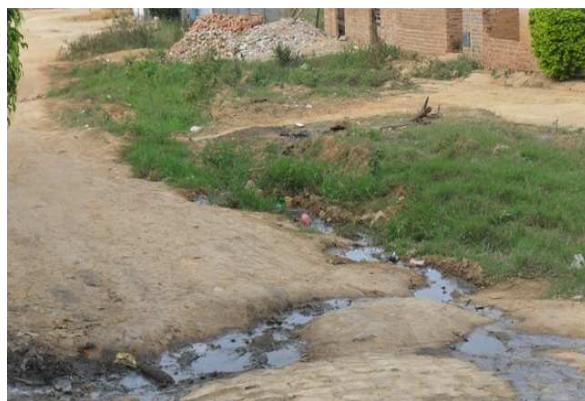
Foto 10: Esgoto secundário lançado a céu aberto sobre pavimentação de paralelepípedo.
