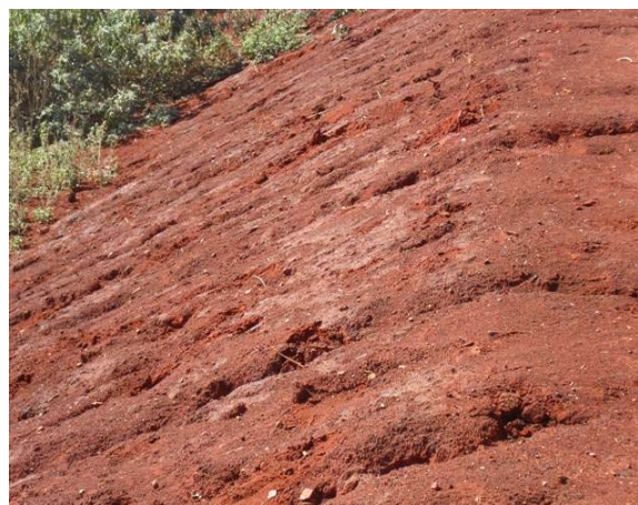
Foto 8: ETE – processo erosivo nos taludes externos.
