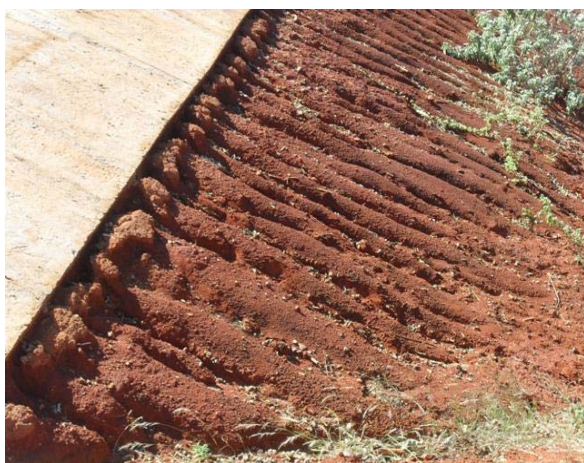
Foto 9: ETE – processo erosivo nos taludes externos.
