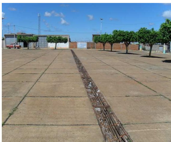
Foto 8: Elemento de microdrenagem – calha com grelha – pátio da feira - longitudinal.
