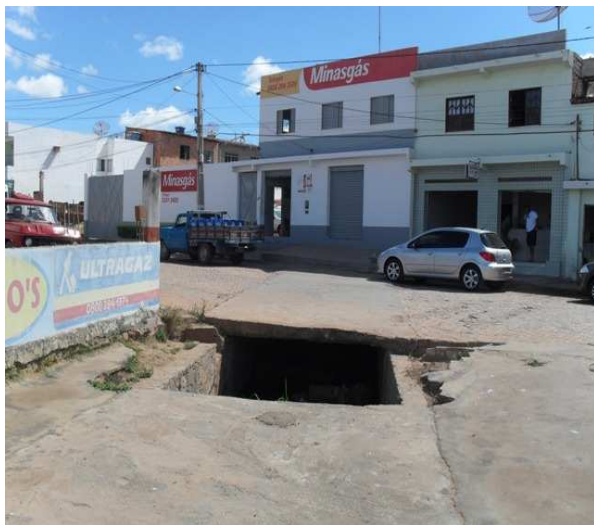
Foto 1: Canal de drenagem – abertura sem proteção.
