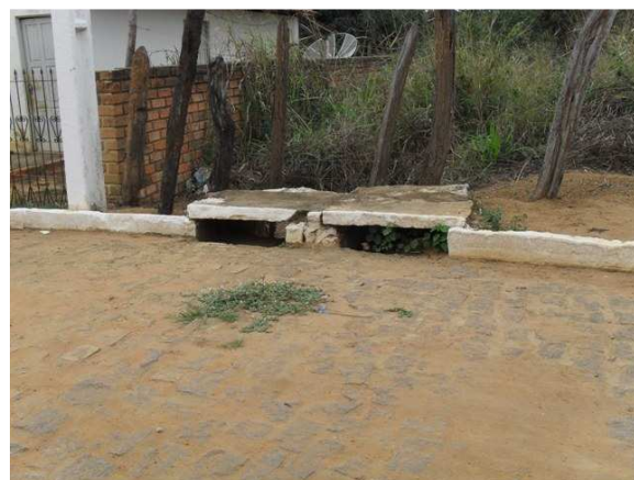
Foto 6: Elemento de microdrenagem – abertura na guia.
