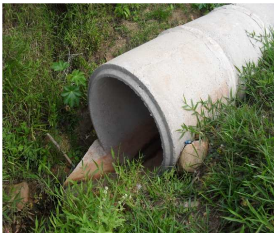
Foto 1: Ponto de lançamento de drenagem (Ø1,0m) com presença de esgoto.
