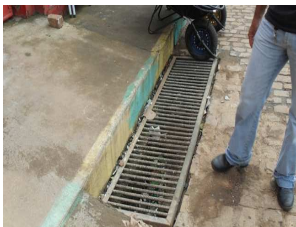
Foto 4: Elemento de microdrenagem – caixa com grelha.
