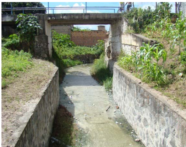
Foto 3: Galeria – Rua 1º de Janeiro – com bomba.
