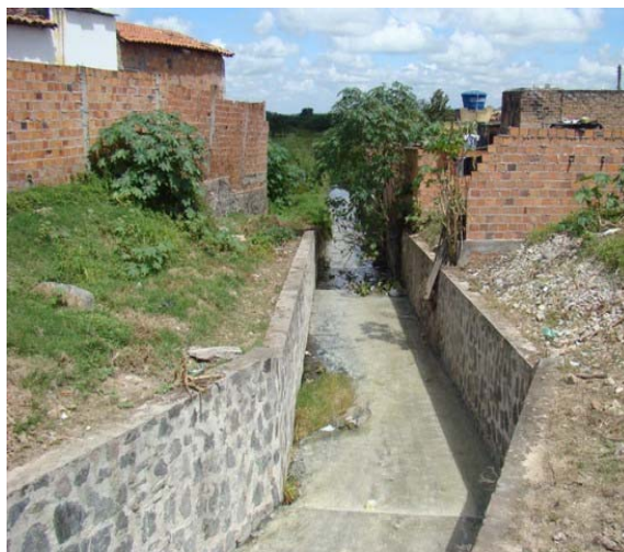
Foto 3: Galeria – Rua 1º de Janeiro – com bomba.
