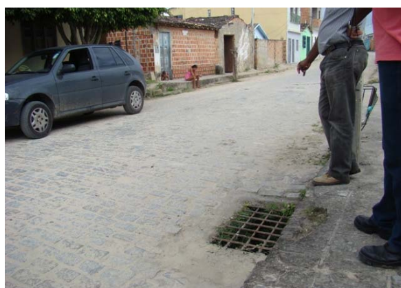
Foto 12: Passagem da rede mista de diâmetro de 1000 mm com relato de inundação – Rua 25 de Dezembro – Bairro Abóbora.
