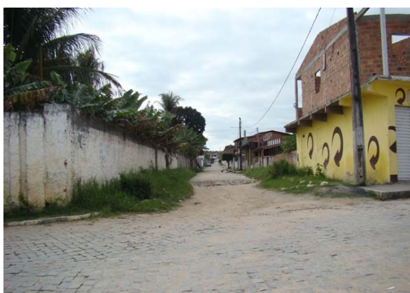
Foto 11: Ponto de alagamento na Rua Leobino Bacelar – Bar do César ao lado do Parque Maria do Carmo.
