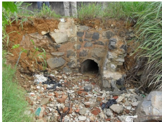
Foto 8: Descarga de galeria pluvial no oceano, conduzindo esgotos sanitários em pequena quantidade.
