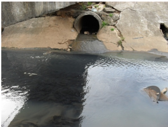
Foto 7: Descarga de galeria pluvial no Canal do Malhado, conduzindo esgotos sanitários.
