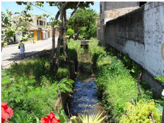
Foto 1: Canal convergente ao Canal da Urbis, com a presença pouco acentuada de esgotos sanitários.
