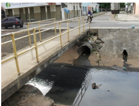
Foto 13: Descarga pluvial com esgotos no Canal do Malhado.
