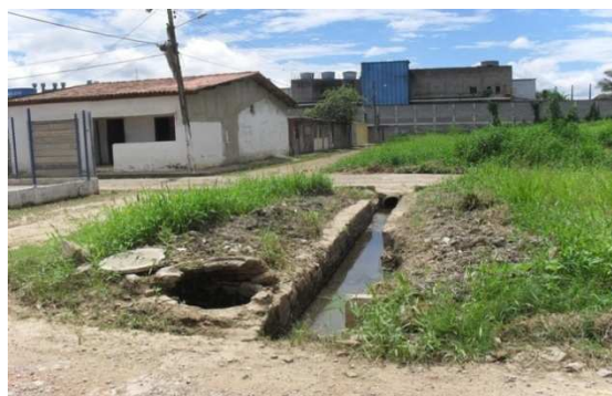
Foto 14: Canal obstruído na periferia da cidade.
