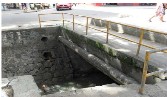
Foto 5: Descarga de galerias pluviais no canal do "Lava-Pés", que se desenvolve na área central da cidade.
