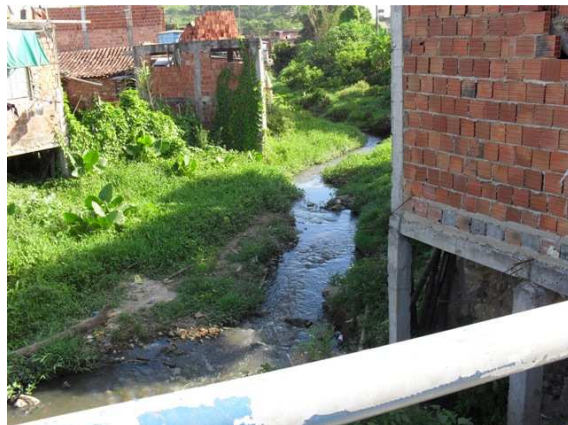
Foto 8: Canal de macrodrenagem não retificado, conduzindo esgotos sanitários nas proximidades dos bairros Novo Horizonte e São Roque. (Registro fotográfico E em planta)
