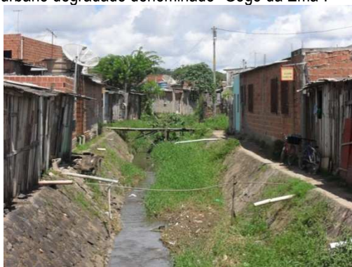
Foto 15: Canal aberto de macrodrenagem, recebendo águas servidas das casas próximas, no setor urbano degradado denominado "Gogó da Ema". (Registro fotográfico H em planta)
