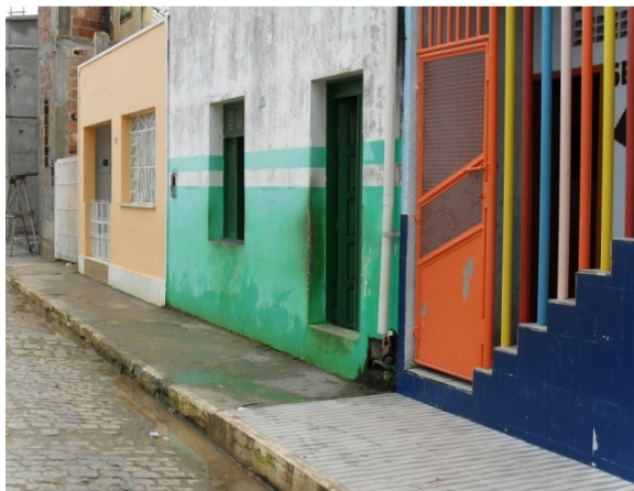
Foto 5: Rua Landulfo Alves. Área crítica por conta das chuvas de enxurrada.
