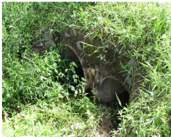
Foto 2: Bueiros de travessia do canal natural sem revestimento que conduz os esgotos sanitários e águas pluviais de quase toda a sede municipal e desemboca no rio Gandu.
