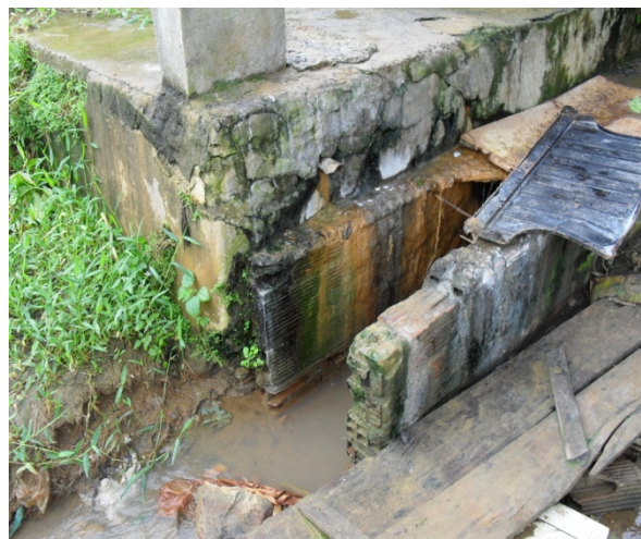
Foto 7: Esgoto escoando ao lado da parede de um chafariz que era utilizado para o abastecimento da população local.
