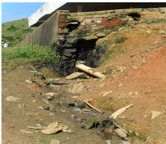
Foto 7: Péssimo estado de conservação das instalações que coletam os efluentes do matadouro operando irregularmente.
