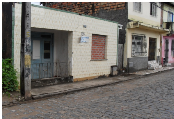
Foto 4: Caixa coletora e canal natural que extravasa, inundando a rua Área Crítica 5.
