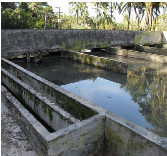
Foto 9: Estação de Tratamento de Esgoto
