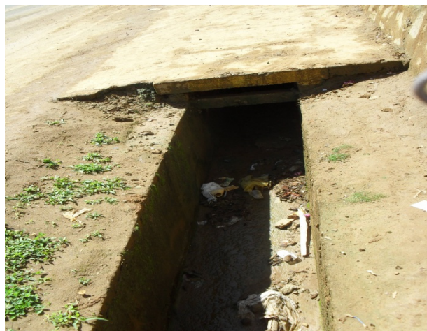
Foto 6: Valeta passando por baixo do passeio transporta as águas pluviais coletadas através de bocas de lobo feitas na guia. Solução de drenagem bastante comum na sede municipal.
