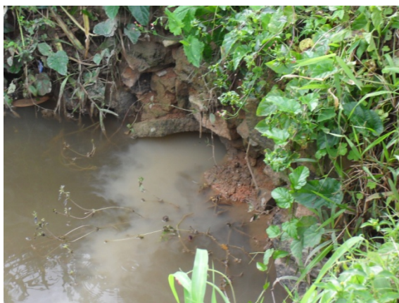
Foto 6: Ponto de lançamento de esgotos sanitários e águas pluviais no Rio Preto quase totalmente afogado.
