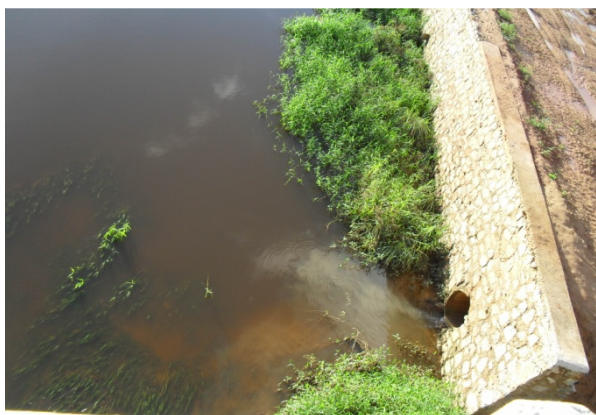
Foto 11: Lançamento pontual de esgotos sanitários e águas pluviais no cais construído para conter a instabilidade do solo na margem do Rio Preto.
