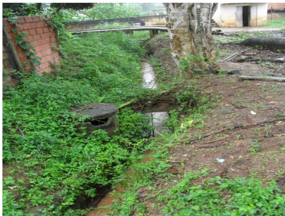
Foto 5: Canal natural retificado. Surgiu a partir do mau funcionamento das redes do sistema de esgotamento sanitário do bairro Arcelino Mamédio que estouraram. Conduz esgotos sanitários e águas pluviais.
