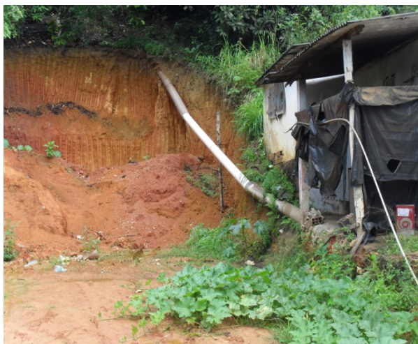
Foto 7: Tubulação de descarga de água de lavagem do reservatório sendo utilizada clandestinamente para entroncamento das ligações pela própria população.
