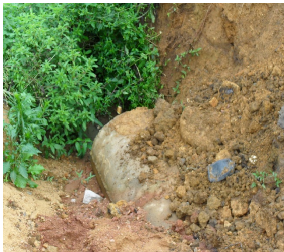
Foto 2: Lançamento de esgoto e águas pluviais no riacho.
