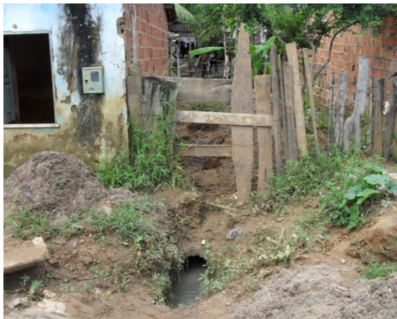
Foto 1: Beco do Corre Nu. A ocorrência de chuvas de enxurrada provoca alagamento da área. Área crítica 2.
