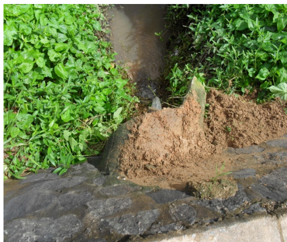
Foto 4: Ponto de lançamento de esgotos sanitários e águas pluviais direto no Rio das Almas. Rua Beira Rio.
