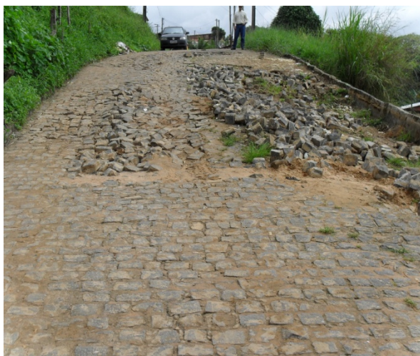
Foto 7: Problemas de erosão por conta das chuvas de enxurrada na rua D. Pedro II
