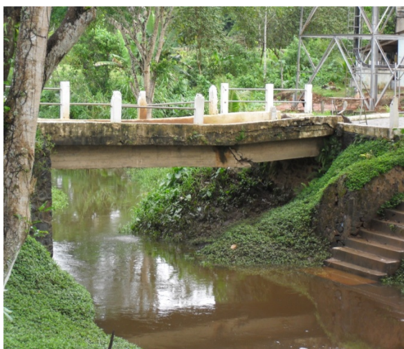
Foto 3: Ponte interditada. Ponte danificada devido à cheia do Rio do Peixe este ano. Município decretou estado de emergência por conta deste evento.
