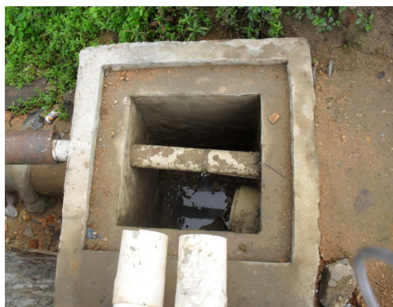
Foto 6: Exemplo de caixa de passagem de esgoto e águas pluviais do sistema misto informal existente.
