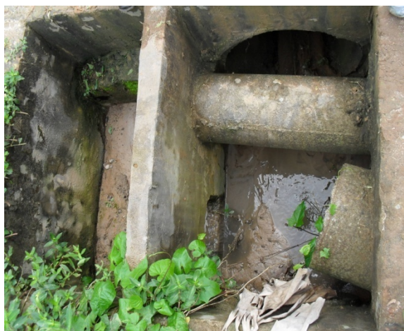
Foto 2: Caixa de passagem com chegada de tubulações de concreto de diferentes diâmetros e direções concentrando os esgotos sanitários e águas de chuva em uma única saída.
