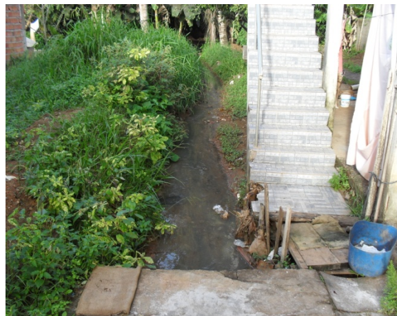
Foto 8: Canal de macrodrenagem assoreado contendo lixo, esgoto e vegetação.
