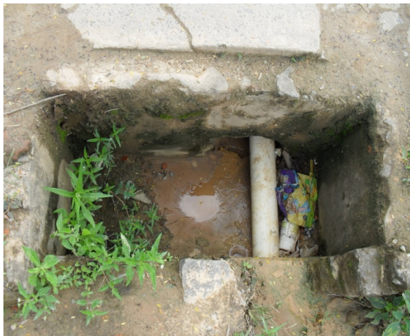
Foto 5: Ligação clandestina da instalação de esgoto residencial na rede coletora. Tubulação de PVC cruzando o dispositivo de drenagem.
