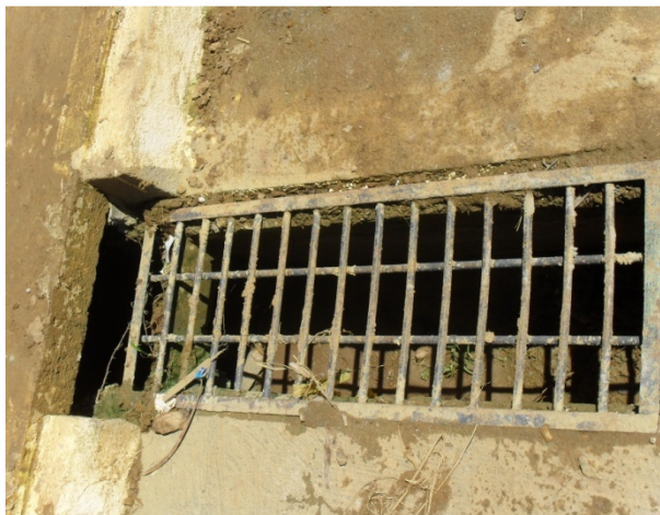
Foto 1: Dispositivo de drenagem “engole tudo” localizado no bairro Centro próximo a entrada da cidade.
