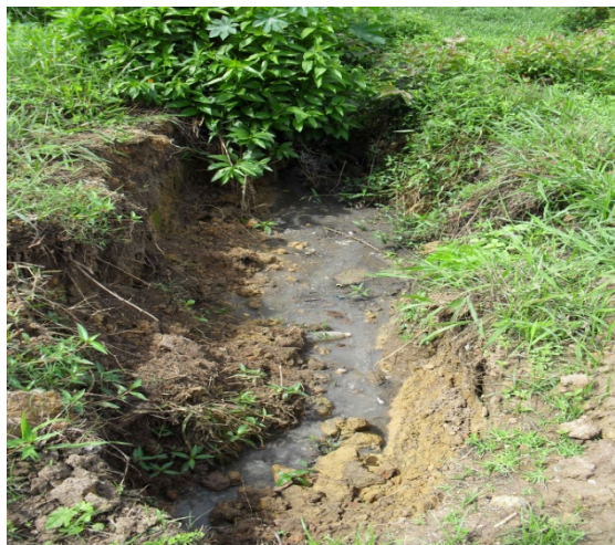
Foto 2: Lançamento de esgotos sanitários e águas pluviais com tubulação recoberta por conta de desmoronamento. Próximo a entrada da cidade.
