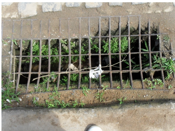
Foto 11: Dispositivo de drenagem em mau estado de conservação.
