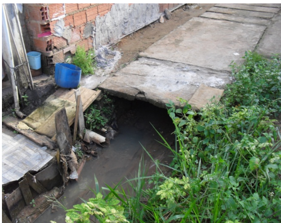
Foto 9: Lançamento difuso de esgoto em canal de macrodrenagem.
