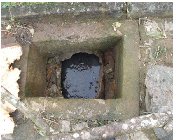
Foto 7: Dispositivo de coleta de águas pluviais servindo também como caixa de passagem da rede coletora.
