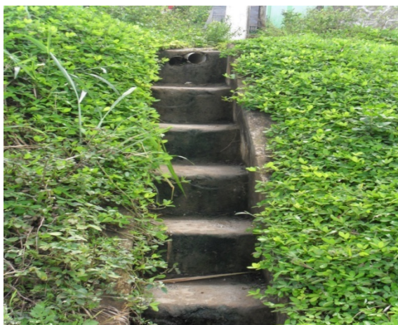
Foto 3: Dispositivos de dissipação para parte da drenagem do bairro Paulo Ribeiro antes de cair na valeta.
