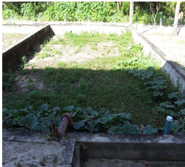
Foto 8: Detalhe do Leito de secagem
