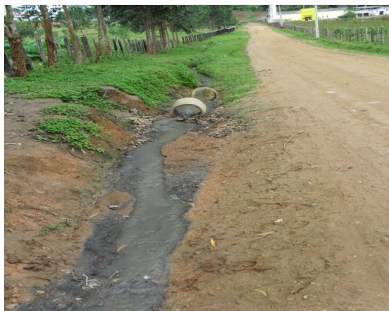
Foto 2: Esgoto a céu aberto próximo a terrenos via de acesso a terrenos particulares.
