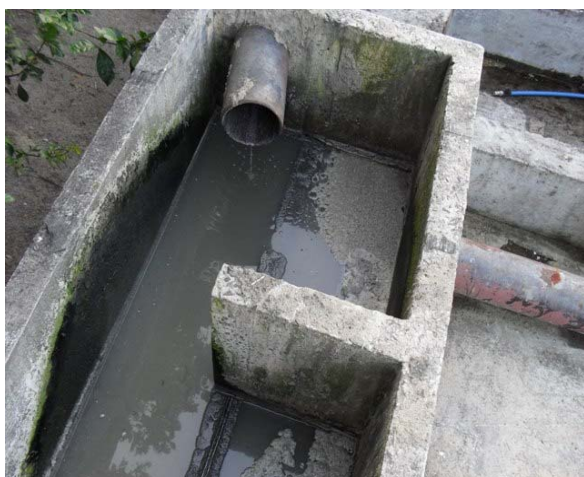
Foto 5: Estação de Tratamento de Esgoto
