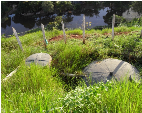
Foto 4: Sistema de fossas sépticas implantadas no Loteamento Cara Nova.
