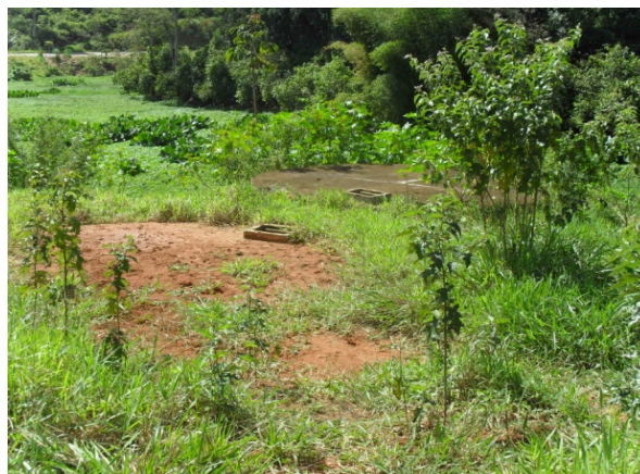
Foto 4: DAFA's existentes. Nunca entraram em operação desde a sua construção devido a falta de interligação das redes coletoras com a ETE.
