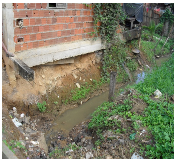
Foto 10: Bueiro com seção insuficiente. Riacho provocando erosão do terreno oferece risco à fundação da casa.
