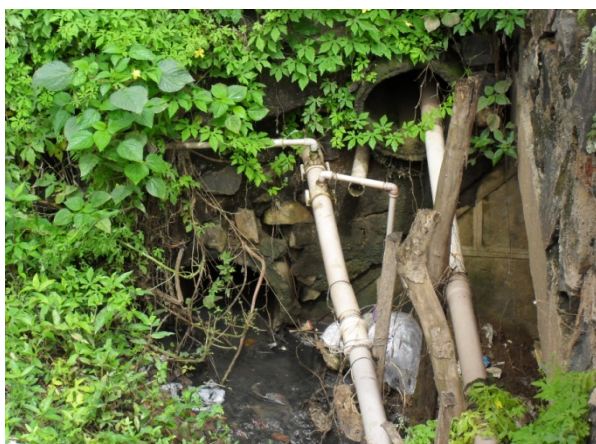
Foto 5: Pontos de lançamento de esgotos sanitários e águas pluviais sendo utilizados como passagem para instalações residenciais clandestinas
