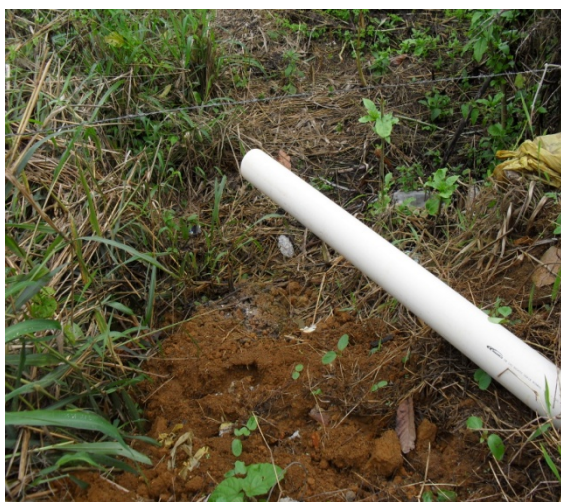
Foto 4: Lançamento de esgotos sanitários mais comum nas proximidades dos riachos.
