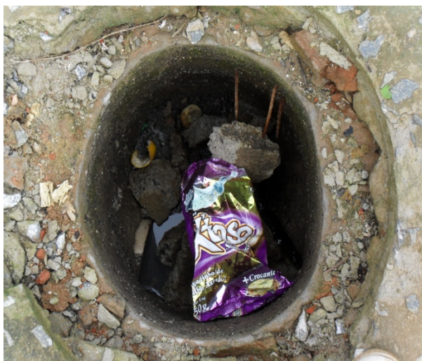
Foto 11: Situação das caixas de passagem de esgoto das ruas periféricas da sede municipal.
