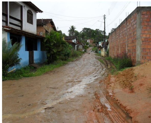
Foto 10: Rua João Damasceno. Dispositivos de drenagem são insuficientes para coletar as águas pluviais durante as chuvas fortes. Área crítica de enxurrada.
