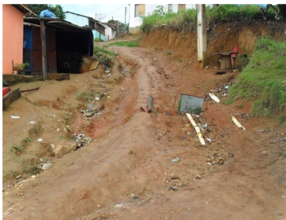
Foto 1: Erosão das ruas por conta das chuvas. Problema de comum ocorrência nas ruas do Bairro Jequitibá.
