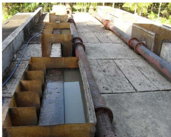
Foto 6: Estação de Tratamento de Esgoto
