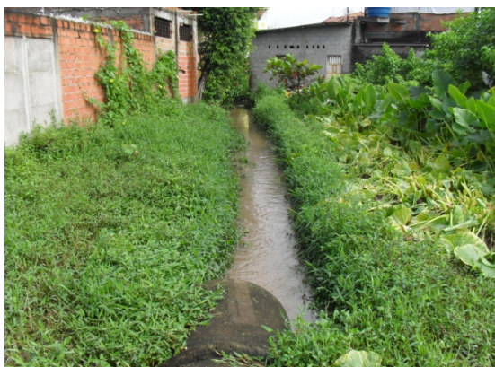
Foto 3: Canal bairro lapa, sem revestimento. Passa por baixo de algumas casas e faz o lançamento no mangue.
