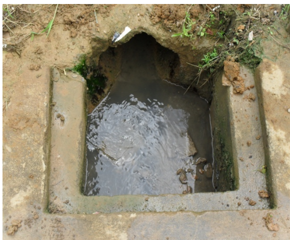
Foto 11: Estado de conservação de caixas de passagem de esgoto das ruas periféricas da sede municipal.
