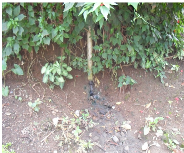
Foto 4: Lançamento de Esgoto a Céu Aberto
