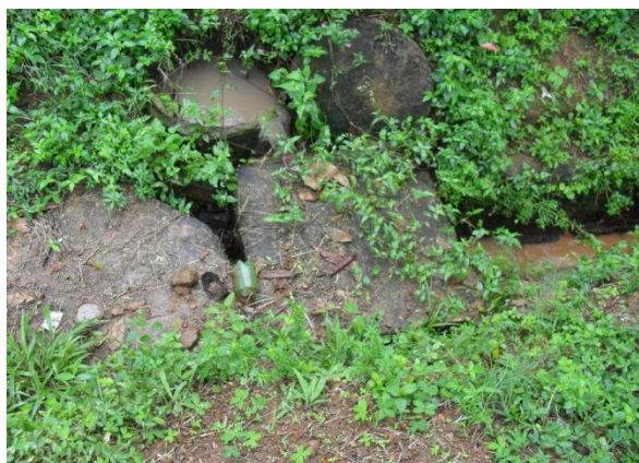
Foto 11: Caixas de passagem de esgotos sanitários extravasando. Escoam para o canal natural retificado juntamente com as águas pluviais.
