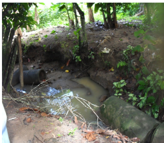
Foto 4: Rede coletora de esgotos sanitários e águas pluviais em péssimo estado de conservação. Efluentes empocando em terreno particular.
