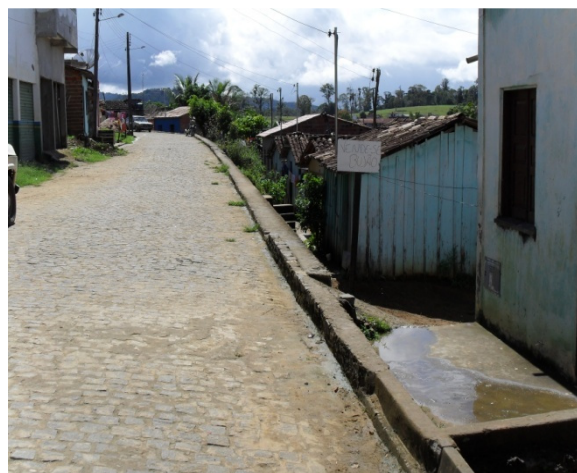
Foto 4: Rua 3 de Julho. Problemas de alagamento devido à insuficiência no funcionamento dos dispositivos de drenagem na ocorrência de enxurrada. Área crítica 3.
