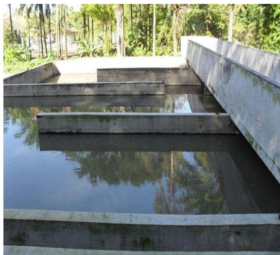
Foto 10: Estação de Tratamento de Esgoto
