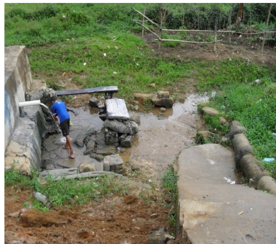
Foto 4: : Lançamento de esgoto e águas pluviais próximo ao chafariz utilizado pela população para diversos fins.
