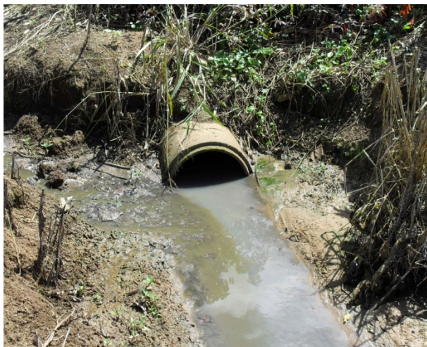
Foto 1: Ponto de lançamento de esgotos sanitários e águas pluviais nas proximidades do rio Gandu.
