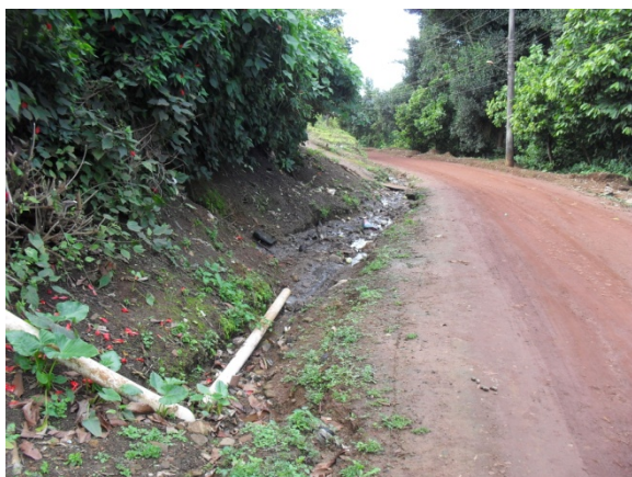
Foto 1: Lançamento de Esgoto a Céu Aberto
