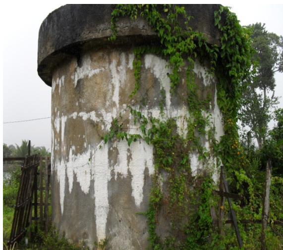
Foto 2: Dispositivo de tratamento de esgotos sanitários (DAFA) abandonado.
