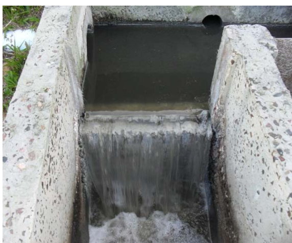
Foto 11 – Estação de Tratamento de Esgoto
