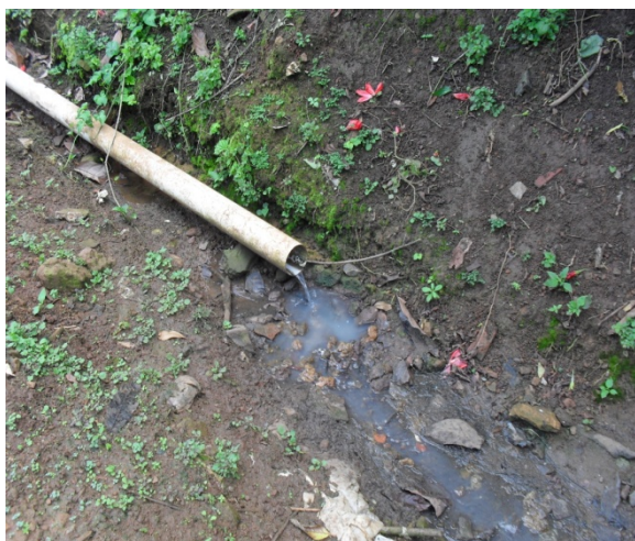
Foto 3: Lançamento de Esgoto a Céu Aberto
