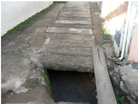
Foto 7: Canal de macrodrenagem transportando significativa contribuição de esgoto.
