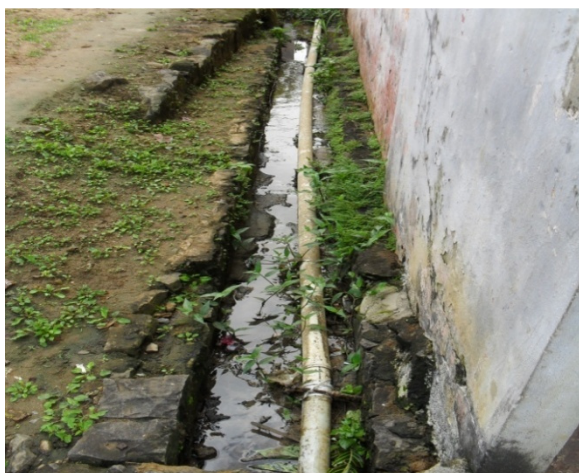
Foto 3: Canaleta de drenagem de águas pluviais sendo utilizada também como passagem para tubulação de esgoto.
