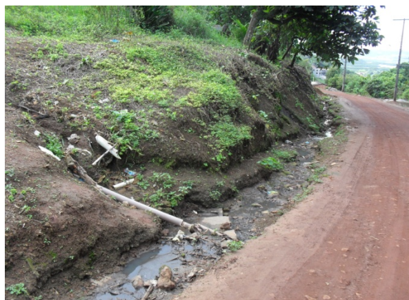
Foto 2: Lançamento de Esgoto a Céu Aberto
