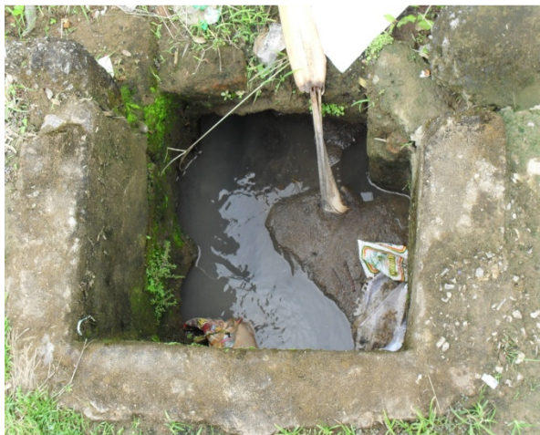
Foto 5: Mau estado de conservação dos dispositivos de drenagem. Acúmulo de sedimentos obstruindo a passagem das águas pluviais e dos esgotos sanitários.
