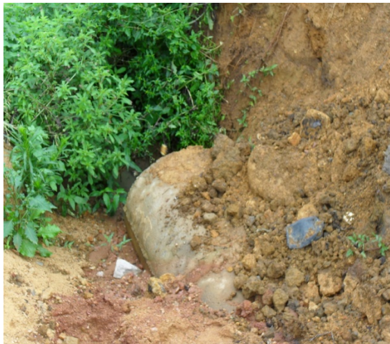
Foto 8: Lançamento de esgoto e águas pluviais
