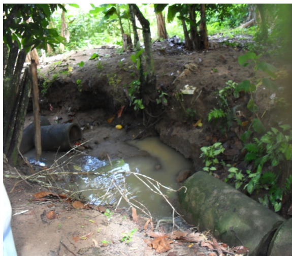
Foto 10: Rede coletora de esgotos sanitários e águas pluviais em péssimo estado de conservação. Efluentes empoçando em terreno particular.
