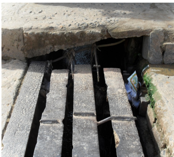
Foto 7: Dispositivos de coleta de drenagem superficial do tipo “engole tudo” localizado na Rua do Mercado.
