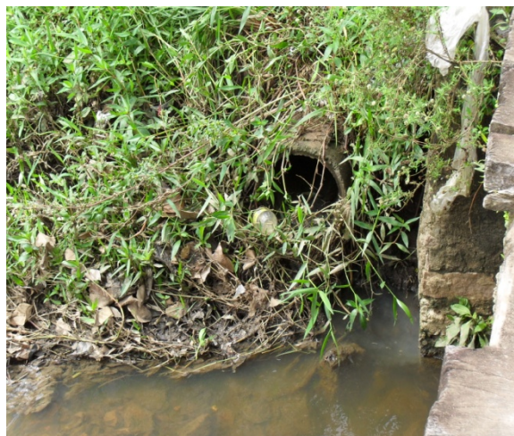
Foto 8: Lançamento direto de águas pluviais e esgotos sanitários no rio Gandu.
