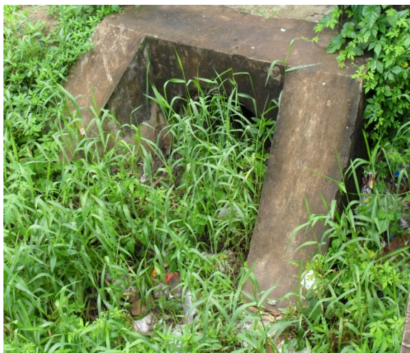
Foto 9: Ponto de lançamento de esgotos sanitários e águas pluviais com pequena obstrução. Característica comumente observada em outros pontos de lançamento ao longo do rio.
