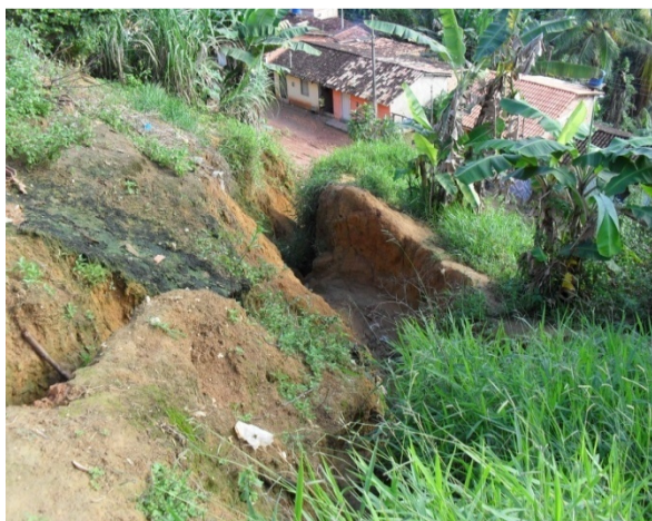
Foto 9: Águas pluviais escoando pelas encostas causando erosão e carreando material para as ruas situadas mais abaixo.
