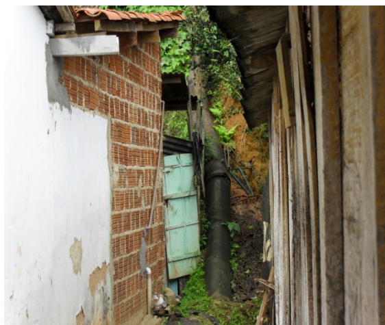
Foto 8: Travessia aérea da rede de esgotos e águas pluviais, em péssimas condições, passando por entre as casas.
