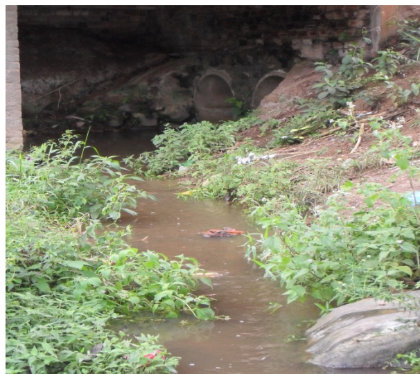
Foto 8: Bueiros de travessia escoando esgotos sanitários e águas pluviais no riacho do Vomitório.
