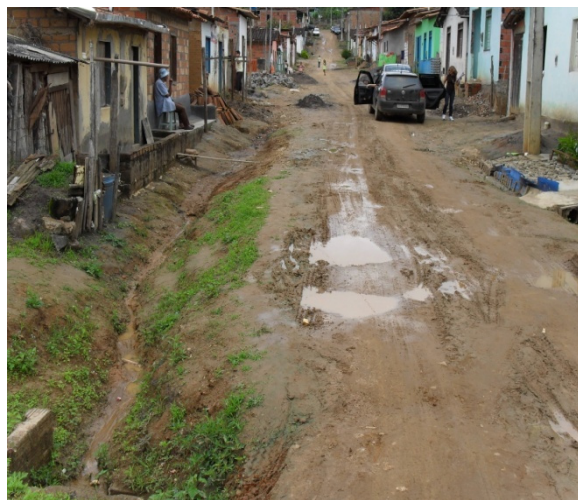
Foto 4: Princípio de erosão ao longo da Rua Dr. Antônio Melo Lobo por conta das chuvas.
