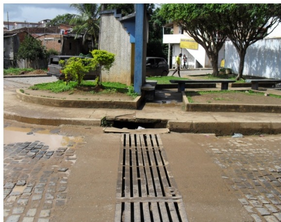
Foto 6: Dispositivos de drenagem “engole tudo” localizados na praça Eliseu Leal.
