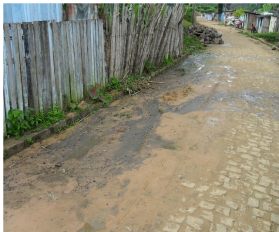
Foto 6: Esgotos sanitários escoando a céu aberto ao longo da antiga rua São Miguel no Bairro ACM.
