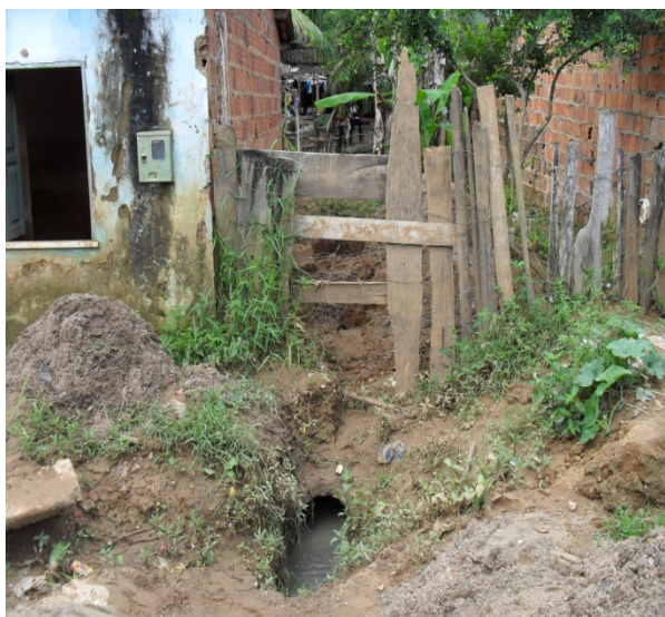
Foto 7: Beco do Corre Nu. Rede coletora do sistema misto descoberta em alguns pontos. Prefeitura constantemente realiza manobras devido a entupimento e transbordamento nas rede.
