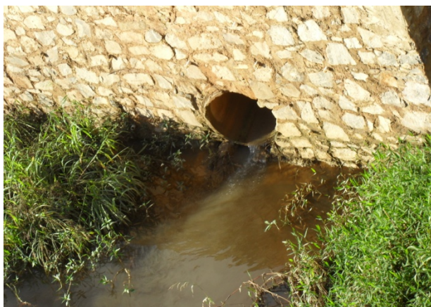
Foto 7: Lançamento de esgotos sanitários e águas pluviais na mureta do cais construído.
