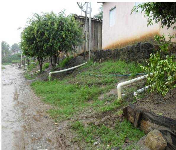
Foto 9: Tipo de ligação da instalação residencial com a rede coletora bastante comum.
