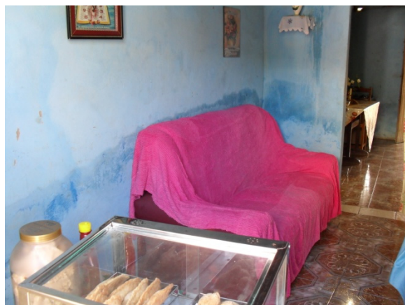
Foto 4: Residência na Rua do Sapo ainda com as marcas da inundação ribeirinha que ocorreu. Área crítica 3.
