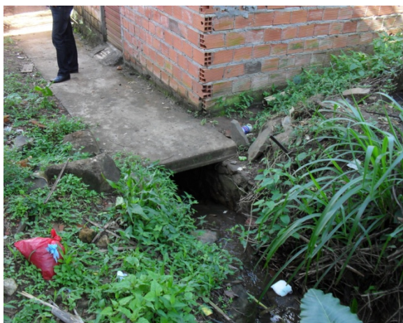
Foto 5: Canal de macrodrenagem assoreado contendo lixo, esgoto e vegetação.
