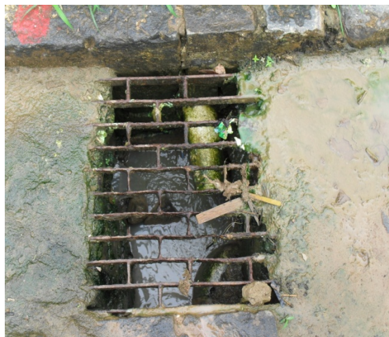
Foto 8: Dispositivos de coleta de águas pluviais sendo utilizados como locais de despejos de esgotos sanitários pela população.
