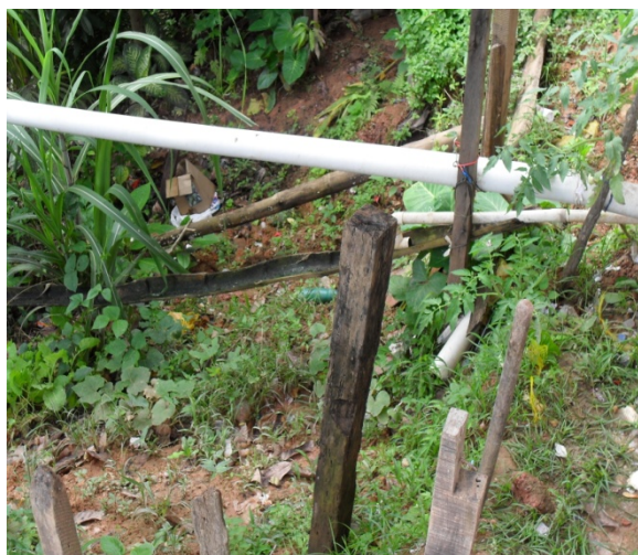
Foto 2: Lançamento difuso de esgoto na encosta. Bairro Zacarias Borges.
