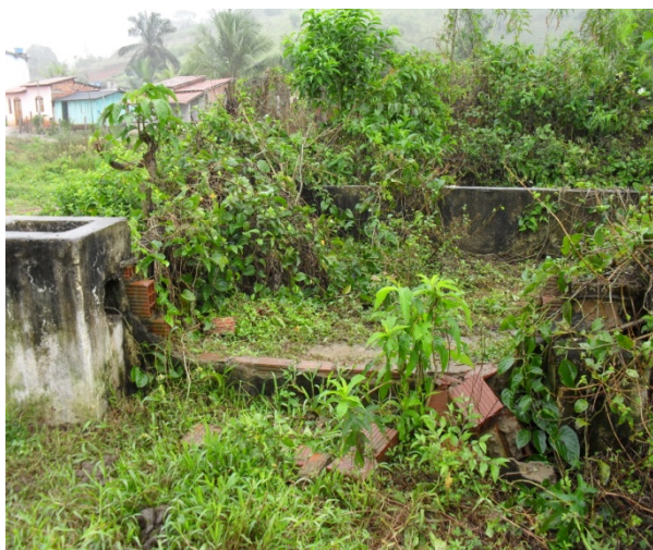
Foto 1: Leito de secagem em péssimo estado de conservação. ETE abandonada.
