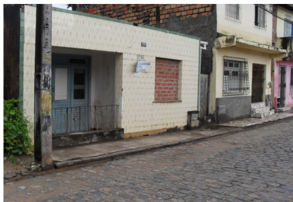
Foto 4: Caixa coletora e canal natural que extravasa inundando a rua Área Crítica 5.
