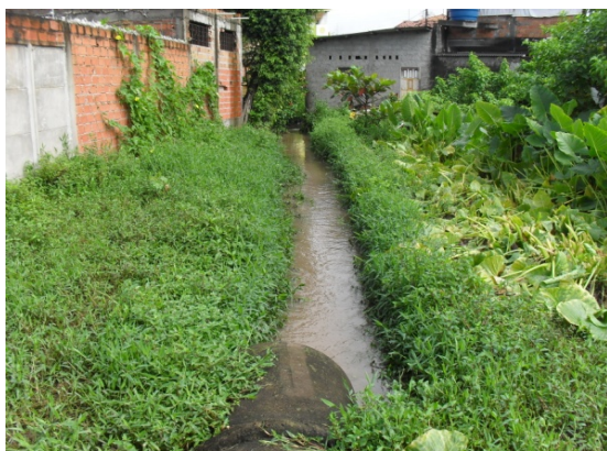
Foto 3: Canal bairro lapa, sem revestimento passa por baixo de algumas casas e lança no mangue
